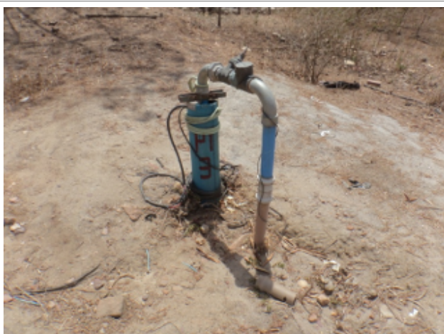
Foto 8 - PT-06: ausência de identificação e sem laje de proteção
