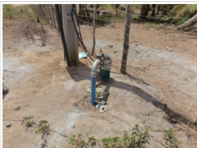
Foto 9 - PT-07: ausência de identificação e sem laje de proteção.
