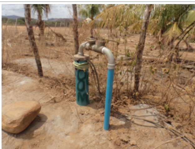
Foto 10 - PT-08: ausência de identificação e sem laje de proteção.
