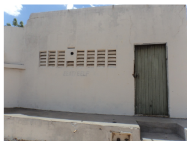
Foto 13 - EEAT-01: identificação pouco visível.
