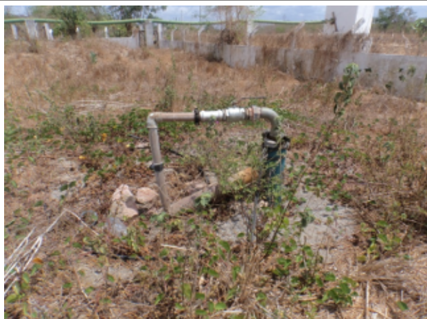
Foto 4 - PT-01: sem identificação e sem laje de proteção.
