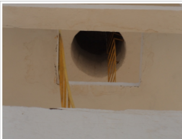
Foto 2 - REL-01: ausência de tampa de inspeção.
