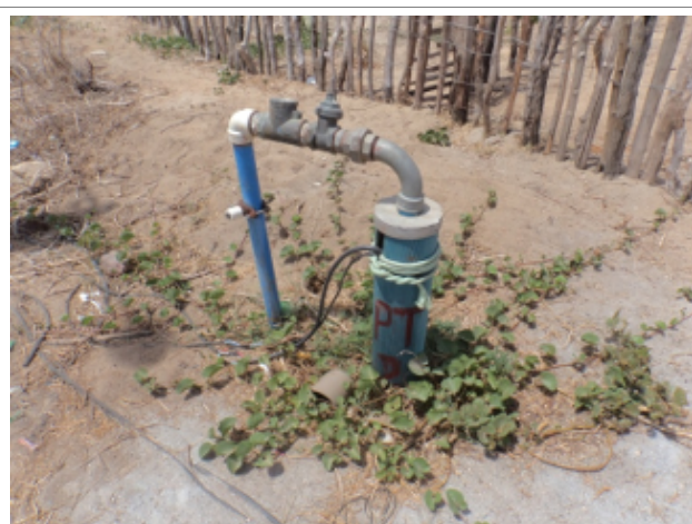
Foto 6 - PT-03: ausência de identificação e sem laje de proteção.
