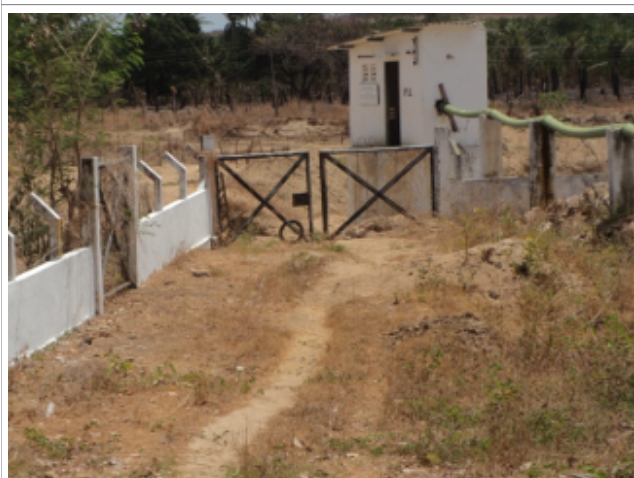
Foto 11 - ETA: portão danificado.
