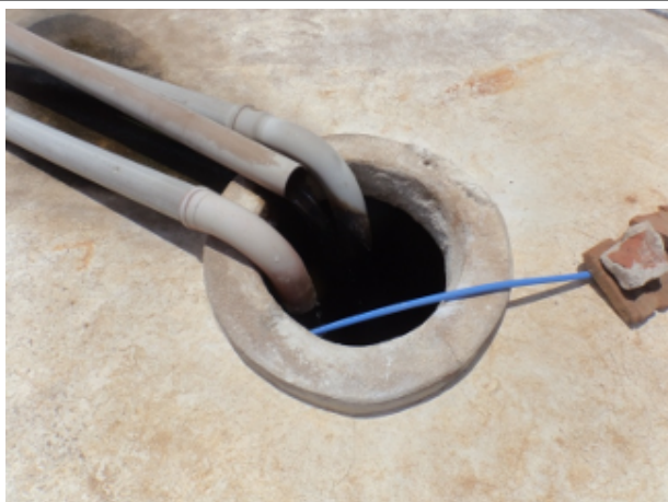
Foto 3 - RAP-01 tubulação de entrada de água impedindo a vedação da tampa de inspeção.
