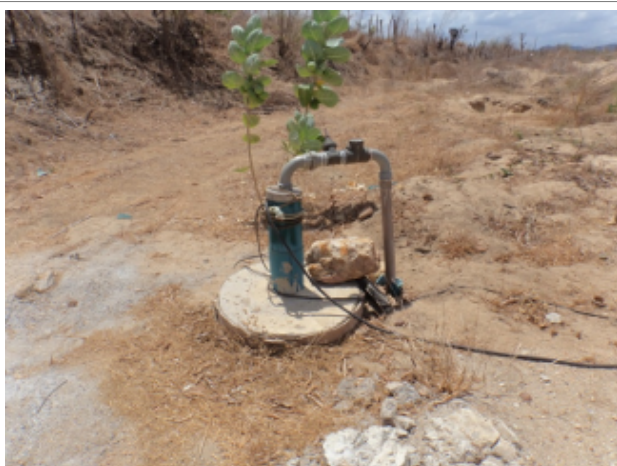
Foto 7 - PT-04: ausência de identificação.
