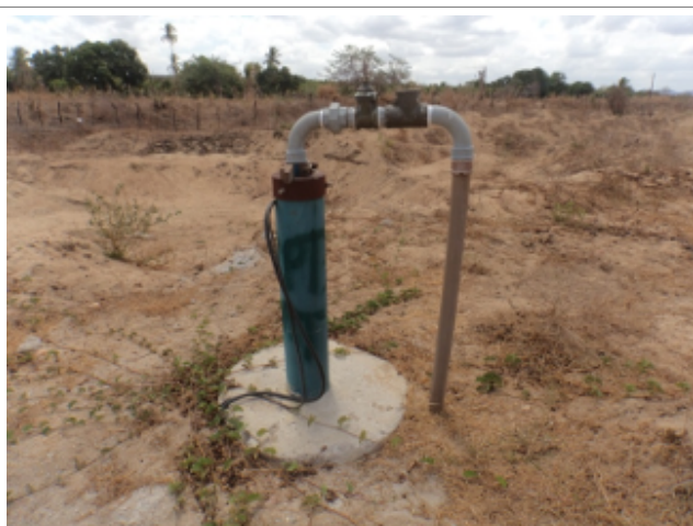
Foto 5 - PT-02: ausência de identificação.
