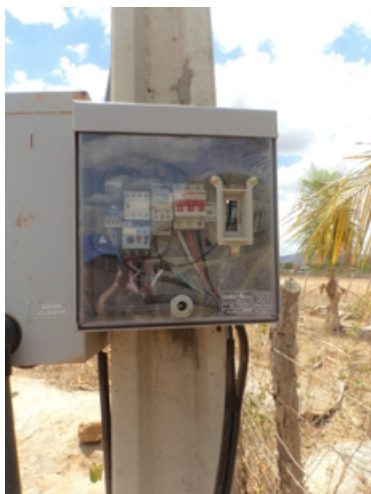
Foto 1 - PT-08: sem horímetro instalado no Quadro de Comando.
