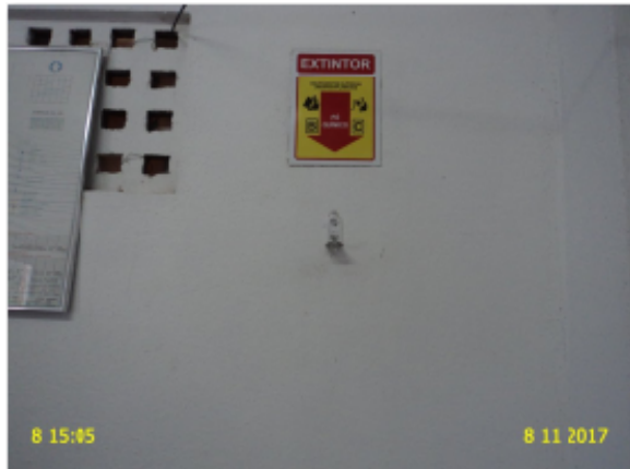
Foto 5 – Escritório de atendimento: ausência de extintor de incêndio.
