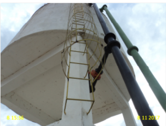
Foto 30 – REL-01 (Sede): guarda-corpos da escada está em processo de corrosão.
