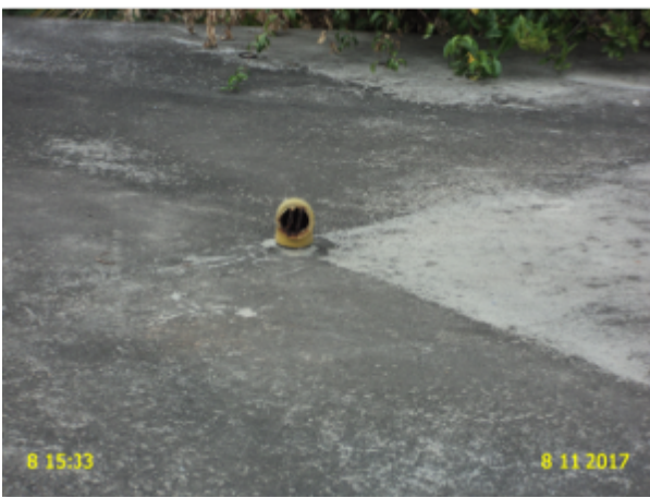
Foto 16 – RSE-02 (Sede): ausência de tela de proteção.
