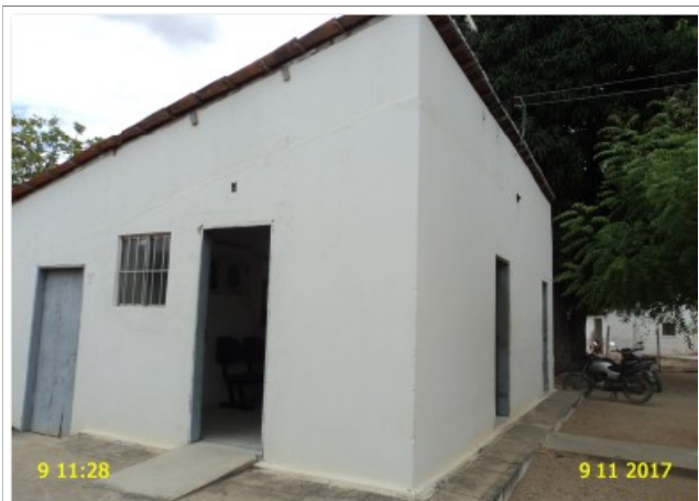
Foto 32 – Loja de Atendimento (Brotas): ausência de identificação.
