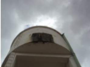
Foto 14 – REL-01 (Brotas): rachadura, sinais de vazamento e ausência de identificação.
