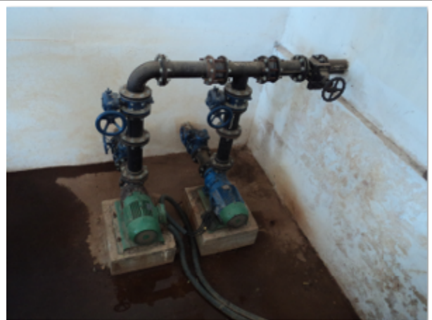
Foto 11 – EEAB (Brotas): ausência de identificação.
