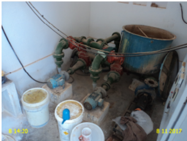
Foto 12 – EEAT-01 (Brotas): ausência de identificação.
