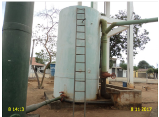
Foto 9 – F-01 (Brotas): escada improvisada e ausência de identificação.
