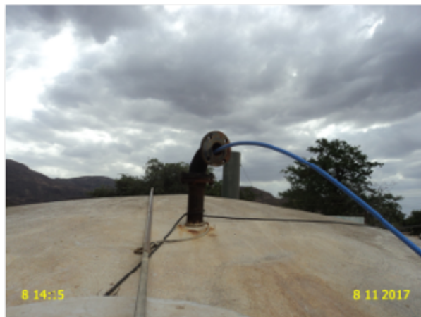
Foto 18 – RAP-02 (Brotas): tubulação inadequada e ausência de tela de proteção.
