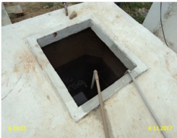
Foto 7 – RSE-01 (Sede): ausência de tampa de inspeção.
