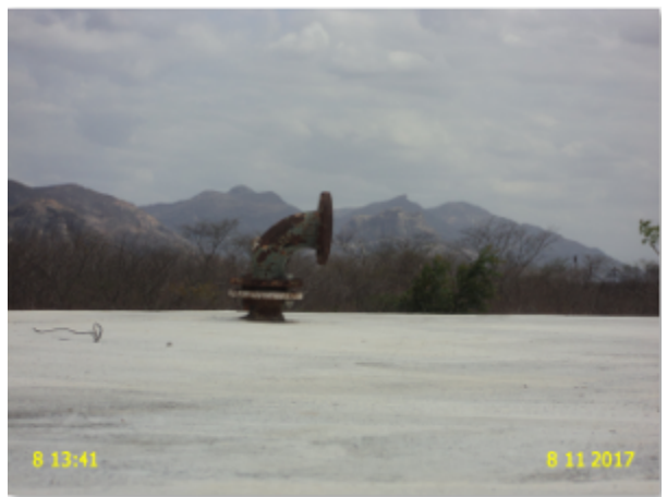
Foto 17 – RSE-01 (Brotas): ausência de tela de proteção
