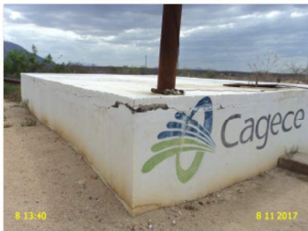
Foto 26 – RSE (Brotas): rachaduras.
