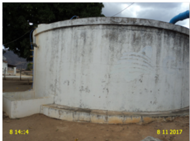
Foto 13 – RAP-02 (Brotas): ausência de identificação.
