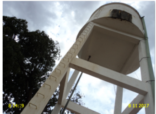
Foto 6 – REL-01 (Brotas): ausência de guarda-corpos na escada e na laje de cobertura.
