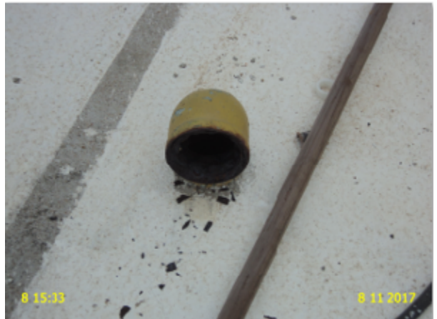
Foto 15 – RSE-01 (sede): ausência de tela de proteção.
