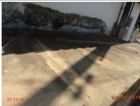
Foto 4 – Reservatório (Cemoaba): RSE-01 não é dotado de tubulação de ventilação.
