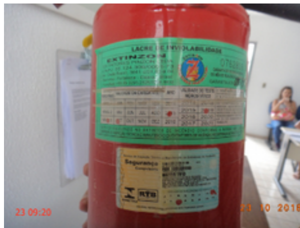
Foto 12 - Comercial (Sede): o extintor da loja de atendimento da Cagece está com a recarga vencida.
