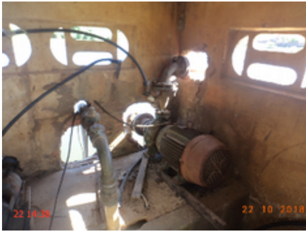
Foto 5 – Captação Superficial (Cemoaba): na EECS-01 não existe bomba reserva.
