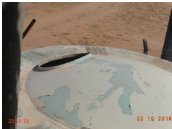
Foto 16 – Filtro (Cemoaba): O filtro está sem tampa de inspeção.
