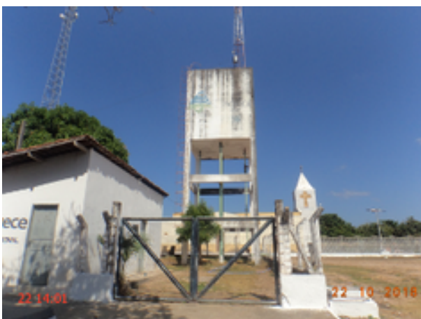
Foto 11 - Reservatório (Cemoaba): REL-01 está com a pintura deteriorada e sem identificação.
