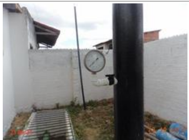
Foto 8 - ETA (Sede): Manômetro do REL-01 está instalado em local inadequado.
