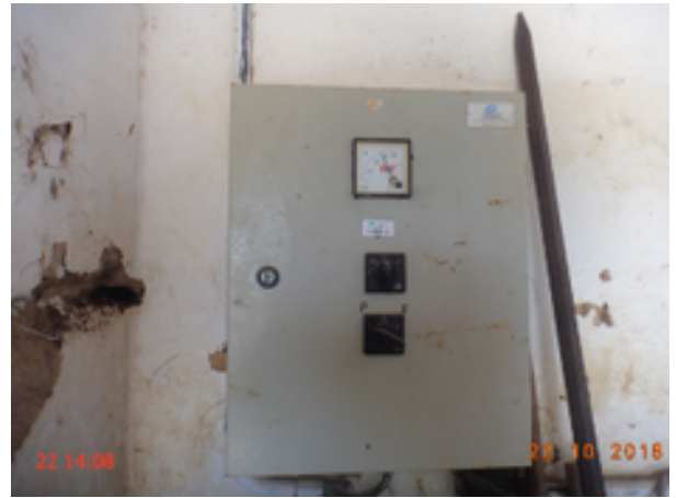
Foto 6 - Elevatória (Cemoaba): Não existe horímetro instalado no quadro de comando da EEAT-01.
