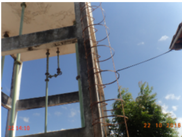
Foto 9 - Reservatório (Cemoaba): REL-01 o guarda-corpo da escada está em processo de corrosão
