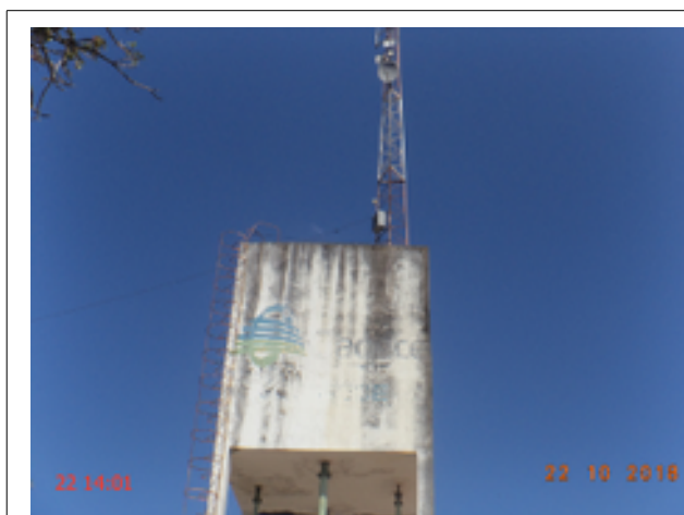
Foto 21 - Reservatório (Cemoaba): Não existe guarda-corpo em toda a área da cobertura do REL-01.
