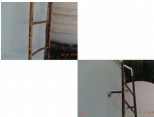
Foto 13 - Filtro (Cemoaba): A escada do filtro está solta e em processo de corrosão.
