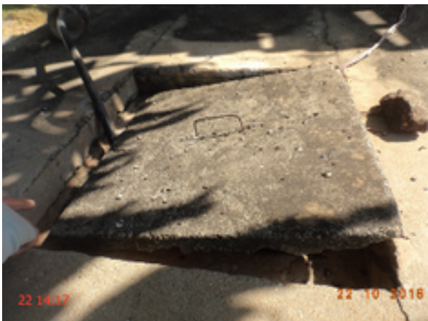
Foto 17 - ETA (Cemoaba): a tampa de inspeção do RSE-01 não garante vedação.
