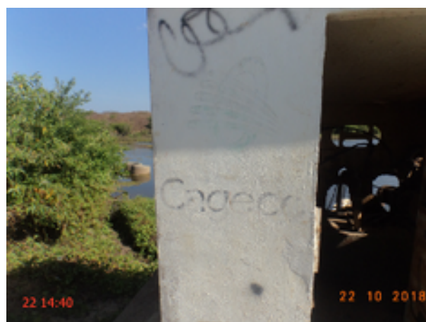
Foto 22 - Elevatória (Cemoaba): A identificação da elevatória EECS-01 está pouco visível.
