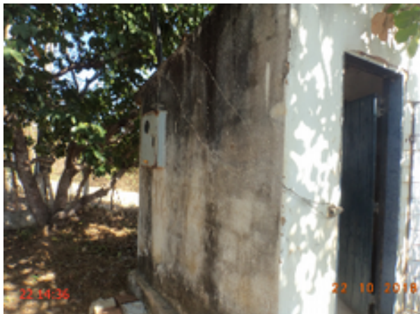
Foto 15 – Captação (Cemoaba): O abrigo do quadro de comando está com a pintura deteriorada e sem identificação.
