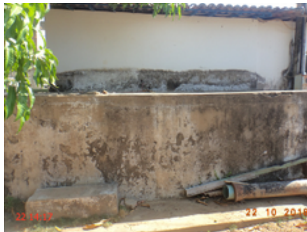
Foto 10 - Reservatório (Cemoaba): RSE-01 está com a pintura deteriorada e sem identificação.
