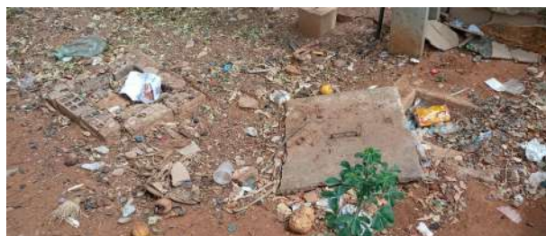
Foto 14 - REL-02: Isolamento danificado e lixo na área, sem iluminação, caixas danificadas.
