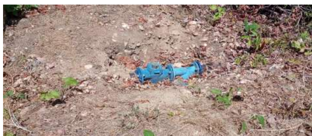
Foto 25 - RAP-04: Macromedidor sem caixa de proteção.
