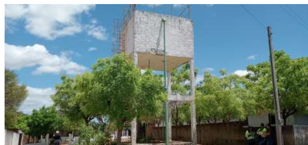
Foto 6 - REL-03: sem identificação e falta de infraestrutura de isolamento.
