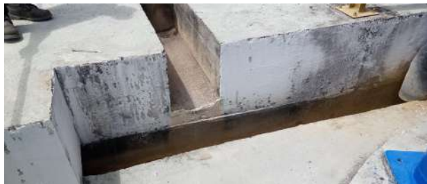
Foto 29 - ETA: Canaleta sem proteção (tampa ou grelha).
