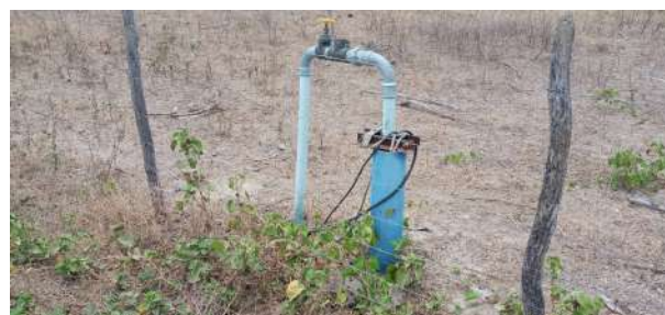
Foto 4 - Captação: PT-06 sem identificação, sem iluminação e falta de infraestrutura de isolamento.
