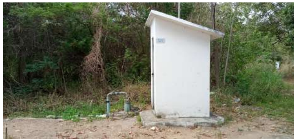
Foto 1 - Captação: PT-01 sem iluminação e falta de infraestrutura de isolamento.
