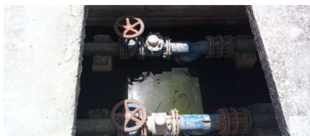
Foto 20 - ETA: Caixa macromedição inundada e sem tampa de proteção.
