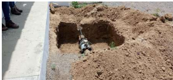
Foto 21 - ETA: Caixa de medição lavagem dos filtros.
