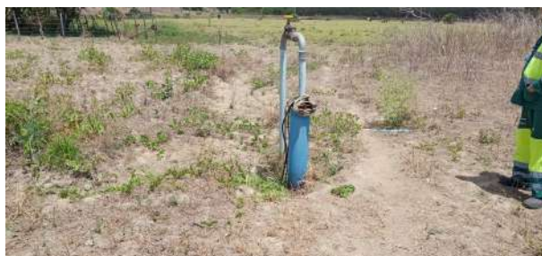
Foto 5 - Captação: PT-07 sem identificação, sem iluminação e falta de infraestrutura de isolamento.
