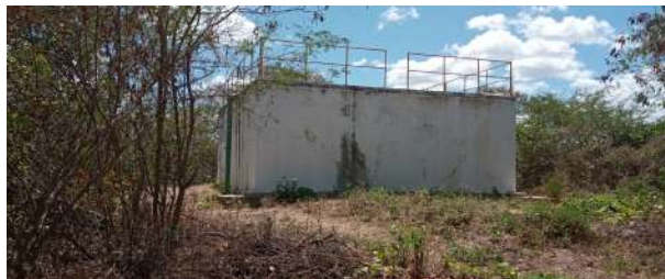
Foto 9 - RAP-04: sem isolamento da área e sem identificação.
