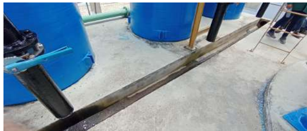
Foto 30 - ETA: Canaleta sem proteção (tampa ou grelha).
