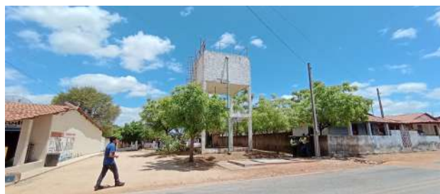
Foto 32 - REL-03: infraestrutura de isolamento da área está danificada
