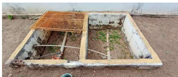
Foto 28 - Escritório: Caixa de macromedidor sem tampa.
