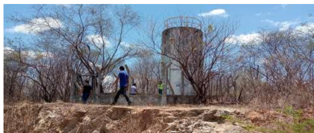
Foto 16 - TAU: Pintura deteriorada
