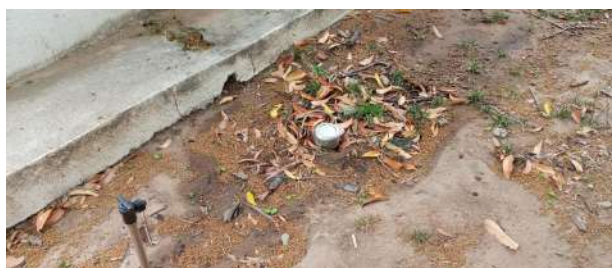
Foto 27 - PT-02/RAP (Poço de Reunião) / ELEVATÓRIA: Macromedidor sem caixa de proteção.
