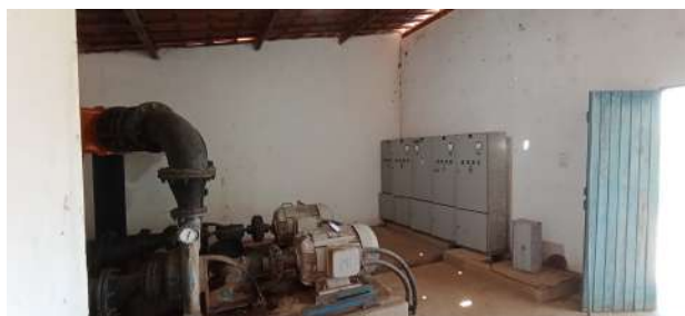
Foto 33 - EEAB-01: Instalações elétricas inadequadas, sem abrigo ou proteção, necessitando de pintura.
