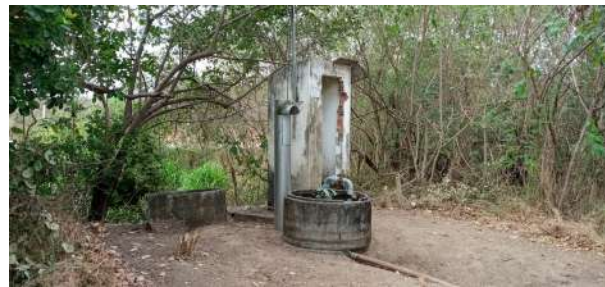
Foto 2 - Captação: PT-02 sem iluminação e falta de infraestrutura de isolamento.
