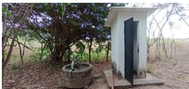
Foto 3 - Captação: PT-04 sem iluminação e falta de infraestrutura de isolamento.
