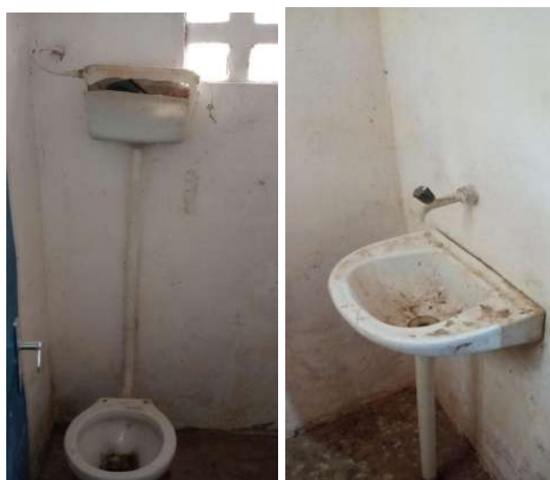
Foto 18 - EAB-01: Banheiro necessitando de limpeza e manutenção.
