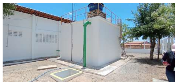
Foto 8 - RAP-03: sem identificação.
