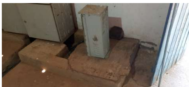
Foto 35 - EEAB-01: fiação exposta ou improvisada tipo “gambiarra” na canaleta elétrica de piso, base de apoio do banco de capacitores.
