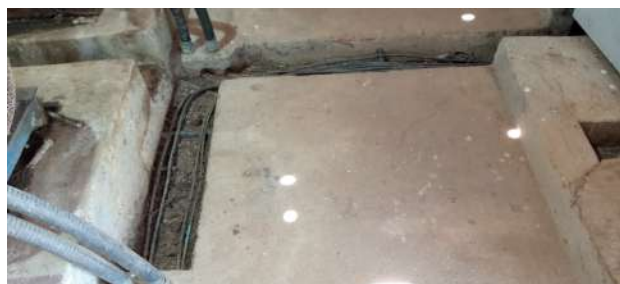
Foto 34 - EEAB-01: fiação exposta ou improvisada tipo “gambiarra” na canaleta elétrica de piso, base de apoio do banco de capacitores.
