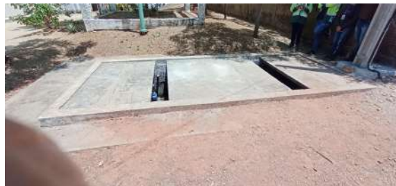
Foto 22 - REL-03: Caixa com aberturas desprotegidas e inundada.
