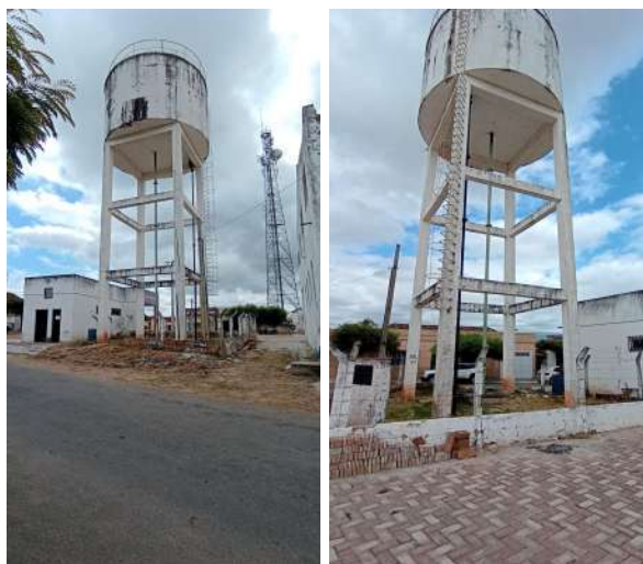
Foto 11 - REL-01: Isolamento da área danificado e sem iluminação.
