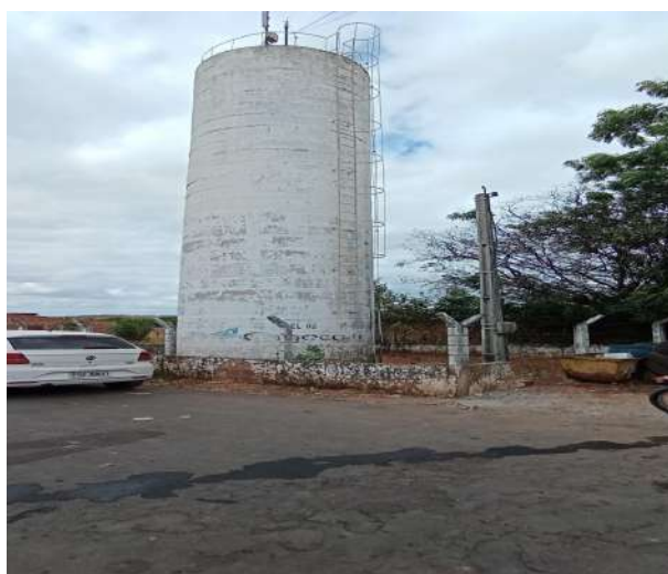
Foto 13 - REL-02: Isolamento da área danificado, pintura deteriorada e sem iluminação.
