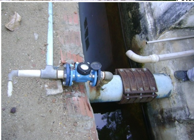
Foto 70 – Medidor proporcional na saída da ETA.
