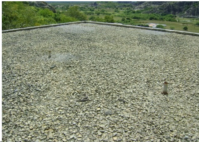
Fotos 54 e 55 – Ventilações do RAP-03.
