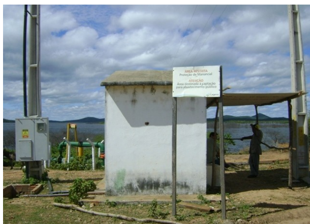
Foto 1 – Sinalização da captação.
