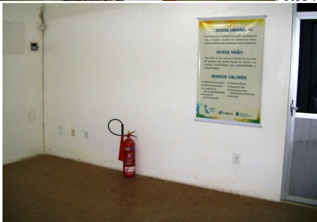
Foto 80 – Extintor de incêndio do escritório.
