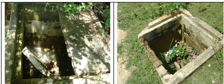
Fotos 29 e 30 – Caixas de proteção sem tampa e danificadas
