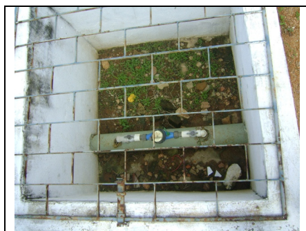
Foto 28 – Medidor proporcional na saída do RAP-01
