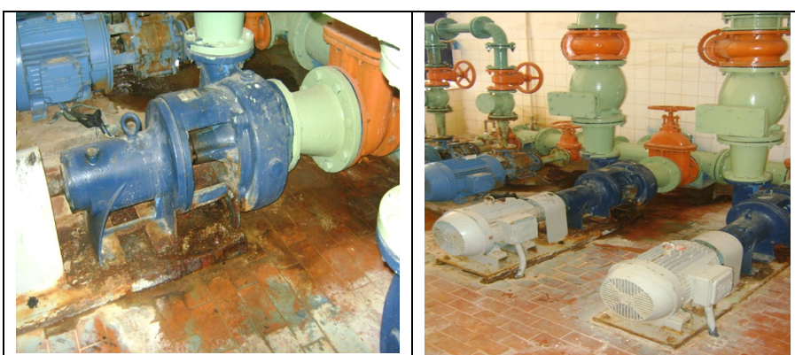
Fotos 17 e 18 - Vazamentos na EEAT-01 e EELF-01
