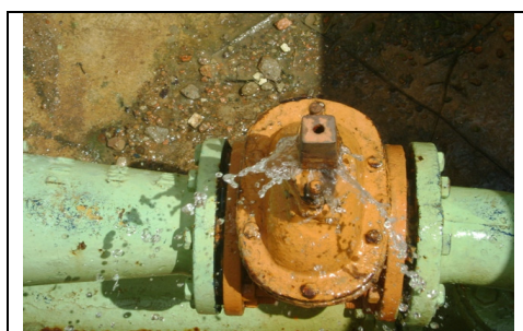
Foto 9 – Registro de saída do filtro com vazamento
