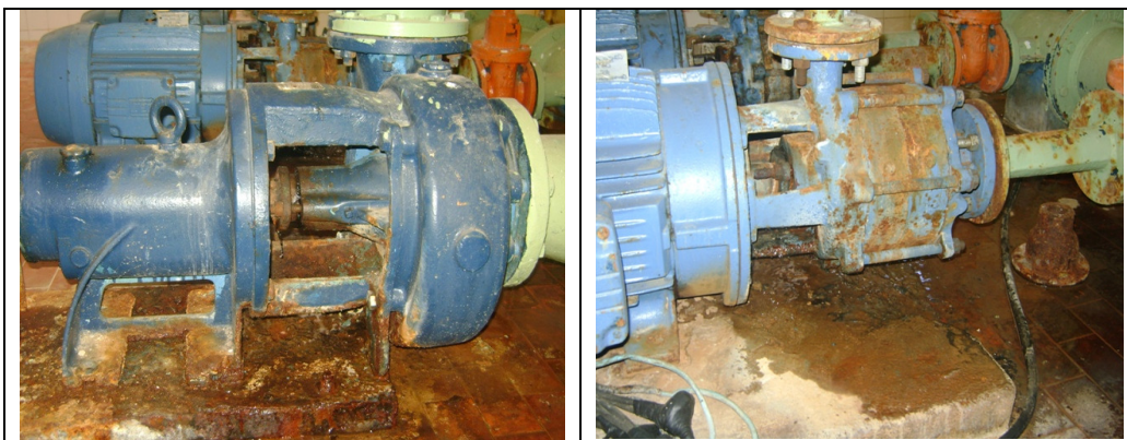
Fotos 19 e 20 – Detalhes dos conjuntos moto-bombas
