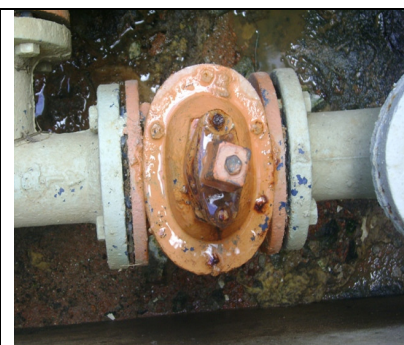
Foto 25 – Vazamento na saída do RAP-01
