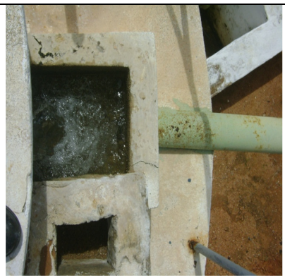
Foto 8 – Calha de saída de água filtrada
