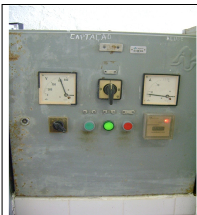
Foto 21 – Quadro de comando da EECS-01
