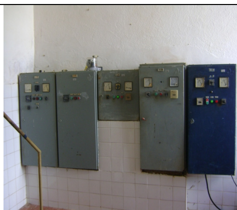
Foto 22 – Quadros de comando da EEAT-01 e EELF-01
