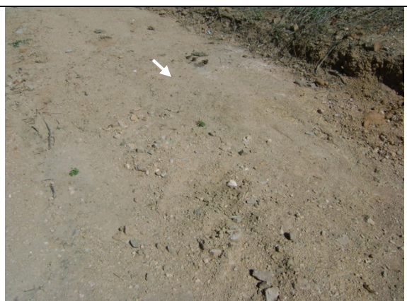
Foto 48 – Registro de descarga soterrado, localizado na Rua Apolônio Luciano.
