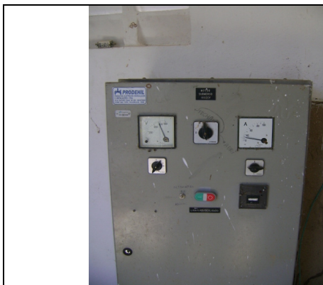
Foto 22 – EECS-01: Quadro de comando.
