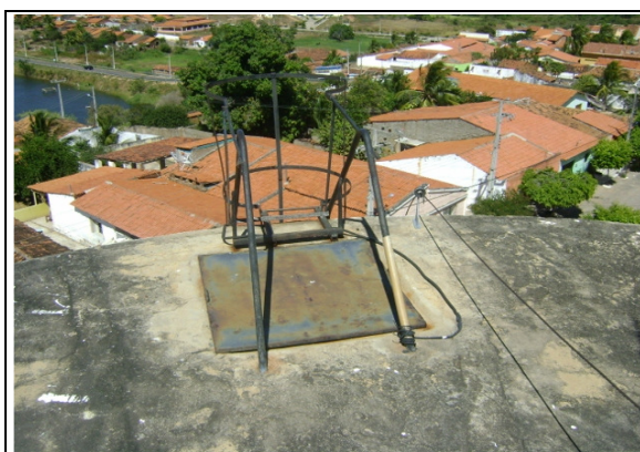
Foto 38 – REL-01: Tampa de inspeção adequada.
