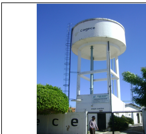
Foto 36 – REL-01: Existência de identificação e ausência de guarda-corpo na laje superior.
