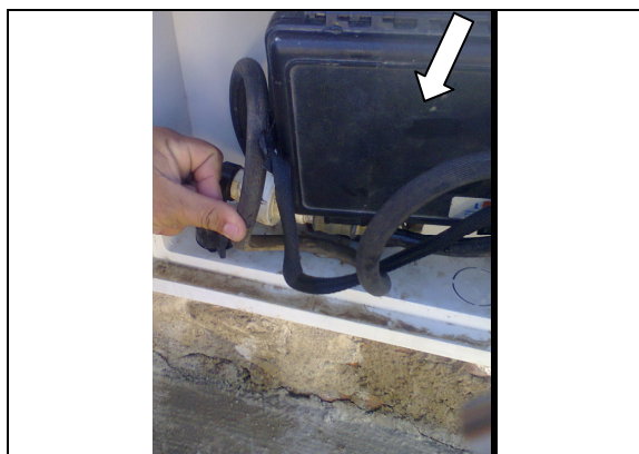
Foto 54 – Medição de pressão na Rua Raimundo Cândido dos Santos, nº 80 - Datalogger.
