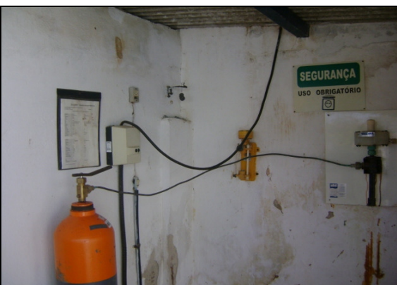
Foto 16 – Dosador de cloro gasoso.
