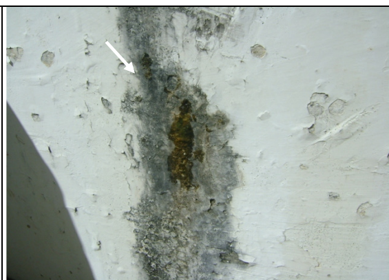
Foto 32 – RAP-01: Vazamento na estrutura lateral
