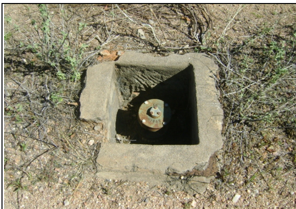
Foto 21 – Adutora de água bruta: Caixa de proteção de ventosa sem tampa.
