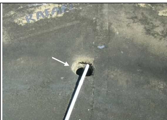
Foto 39 – REL-01: Ventilação inadequada.
