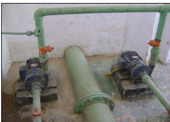
Foto 27 – EEAT-02: Conjuntos moto-bomba.
