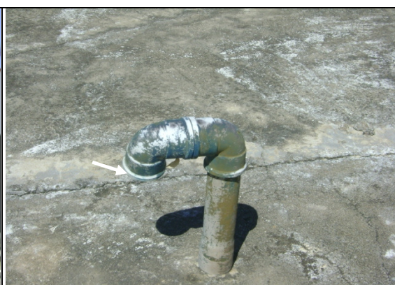
Foto 30 – RAP-01: Tubulação de ventilação sem tela de proteção.
