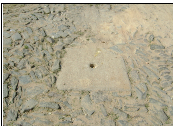
Foto 49 – Registro de descarga localizada na Rua Edmundo Olinda.
