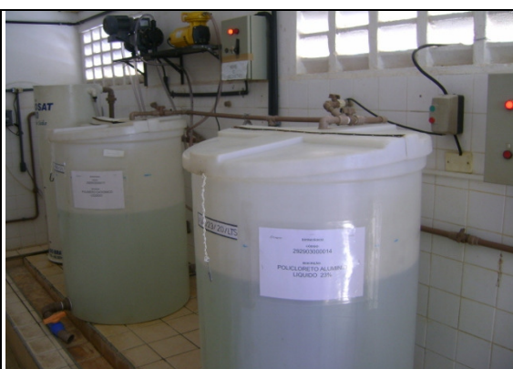
Foto 14 – Tanques de mistura de produtos químicos.
