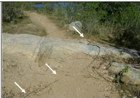
Foto 23 – EECS-01: Cabo exposto na área da captação.
