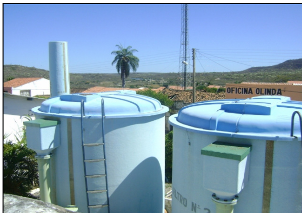
Foto 4 – ETA.:Filtros e torre de nível
