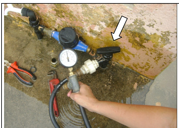
Foto 52 – Medição de pressão na Rua Terezinha Santos, s/n, Sindicato dos Trabalhadores Rurais, antes do hidrômetro.
