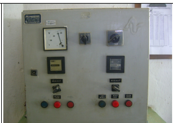
Foto 28 – EEAT-02: Quadro de comando.
