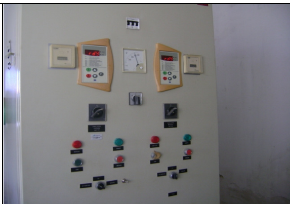
Foto 26 – EEAT-01: Quadro de comando.
