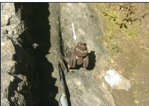
Foto 20 – Adutora de água bruta: Registro de descarga sem caixa de proteção.
