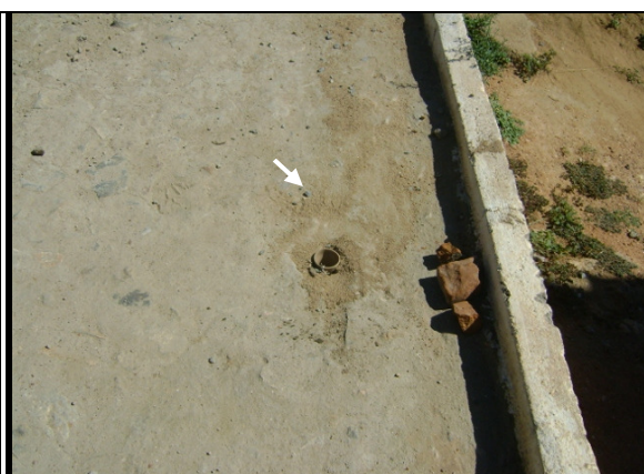
Foto 44 – Registro de descarga localizado na Rua José Augusto Braga Vieira.
