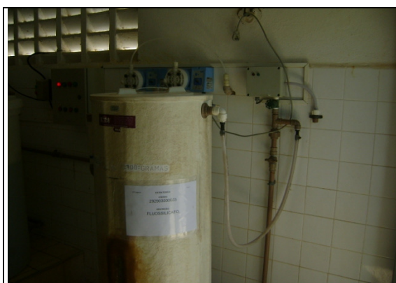
Foto 13 – Dosador de flúor.
