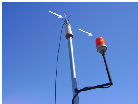
Foto 37 – REL-01: Existência de pára-raio e sinalizador noturno.
