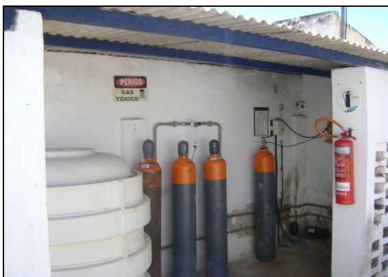
Foto 15 – Cilindros de cloro gasoso.
