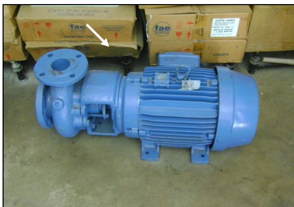
Foto 24 – EECS-01: Conjunto moto-bomba reserva, estocado no almoxarifado.
