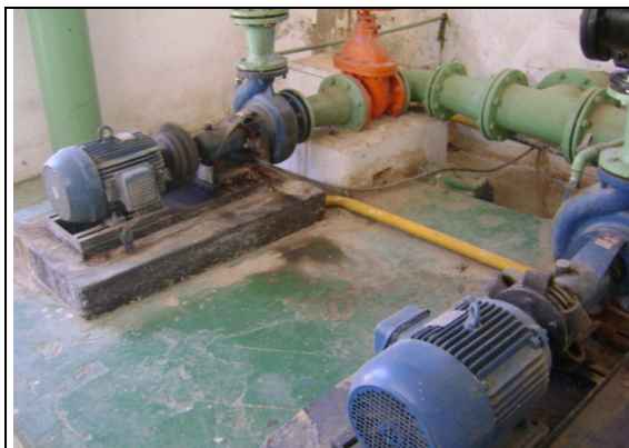
Foto 25 – EEAT-01: Conjuntos moto-bomba.
