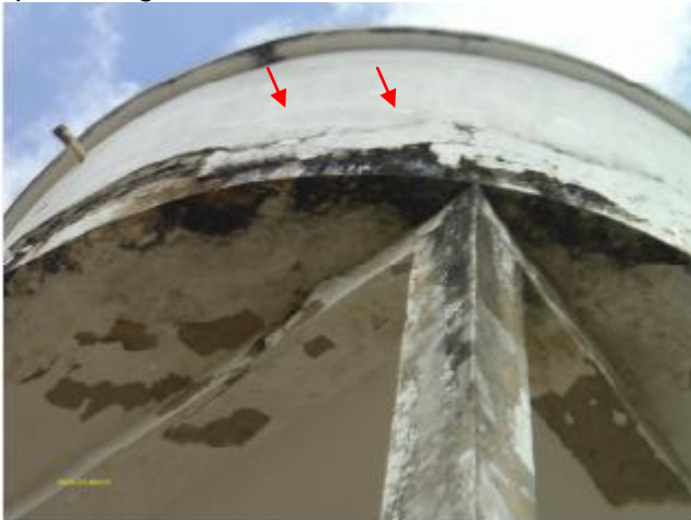
Foto 37 – REL-01: estrutura rachada com vazamento.
