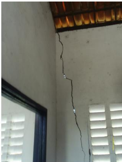
Foto 56 – EEE: estrutura da casa de abrigo do quadro de comando rachada.
