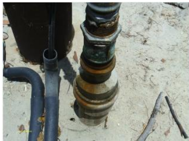
Foto 10 – PT-04: sinais de vazamento.
