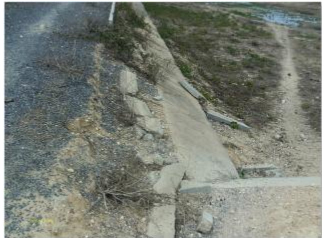
Foto 70 – Talude da lagoa de maturação deteriorado.
