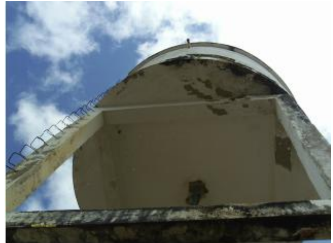
Foto 38 – REL-01: pintura e reboco deteriorados.
