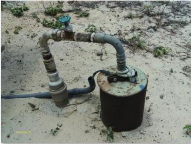
Foto 17 – PT-07: proteção do poço.
