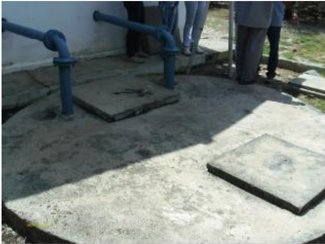
Foto 52 – EEE: poço de sucção.
