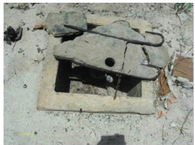
Foto 28 – ETA: caixa de registro com tampa de inspeção danificada.
