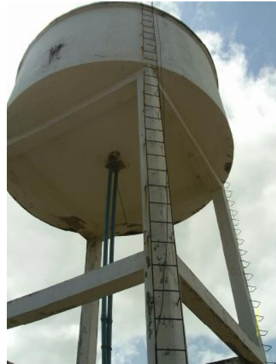
Foto 36 – REL-01: escada sem guarda-corpo.
