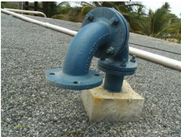
Foto 33 – RAP-01: tubulação de ventilação sem tela de proteção.
