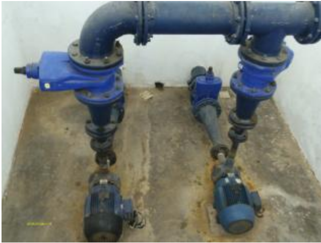
Foto 29 – EEAT-01: conjunto moto-bomba.
