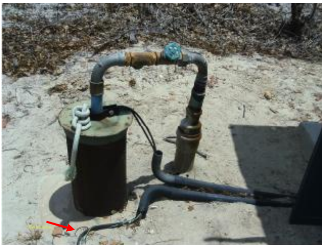
Foto 9 – PT-04: laje de proteção e fiação exposta.
