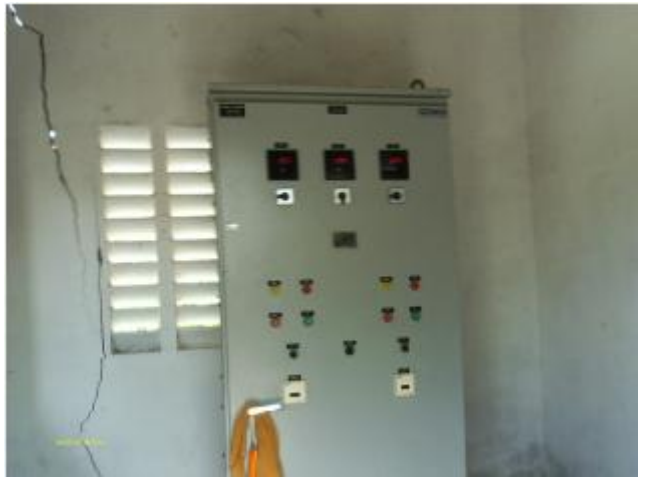
Foto 55 – EEE: quadro de comando.
