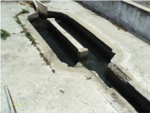
Foto 63 – Caixa de areia.
