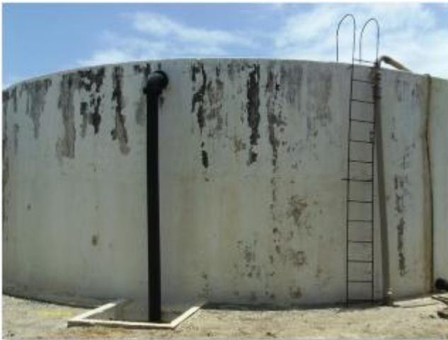
Foto 31 – RAP-01: pintura deteriorada, escada de acesso e ausência de identificação.
