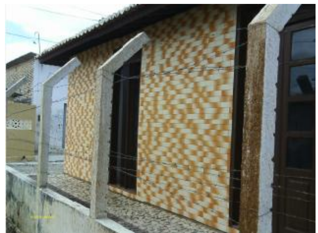
Foto 40 – REL-01: cerca de proteção da área do reservatório danificada.
