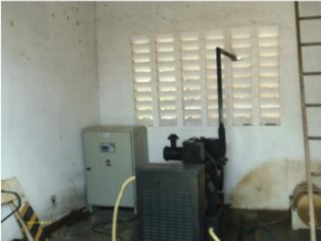
Foto 58 – EEE: grupo gerador de energia parado.
