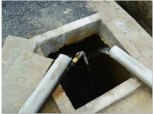
Foto 32 – RAP-01: ausência de tampa de inspeção.
