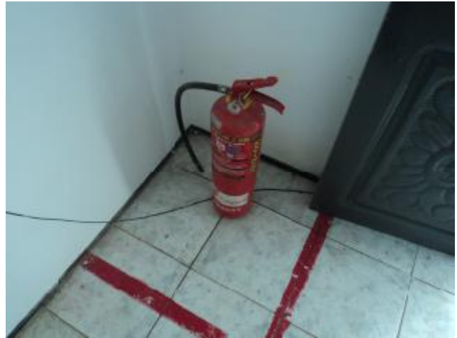
Foto 76 – Loja de atendimento: extintor de incêndio dentro do prazo de validade.
