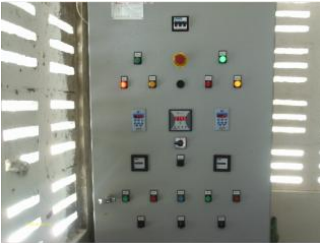
Foto 7 – PT-03: quadro de comando.
