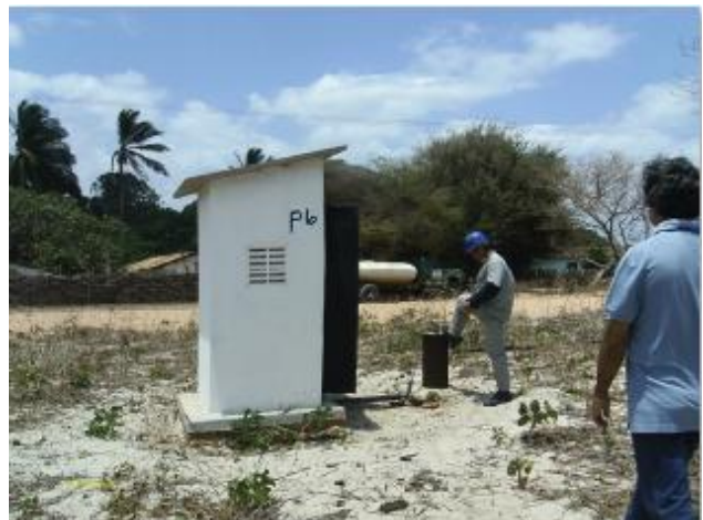
Foto 14 – PT-06 (desativado): identificação, área de acesso sem delimitação e ausência de iluminação para trabalhos noturnos.
