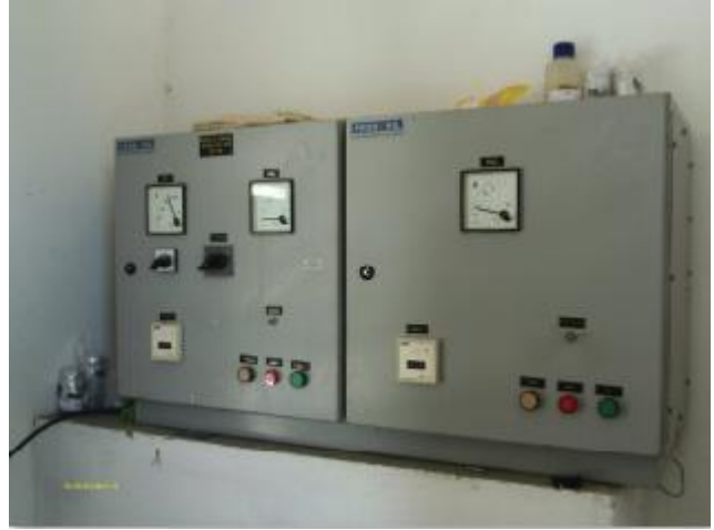
Foto 30 – EEAT-01: quadro de comando e ausência de identificação.
