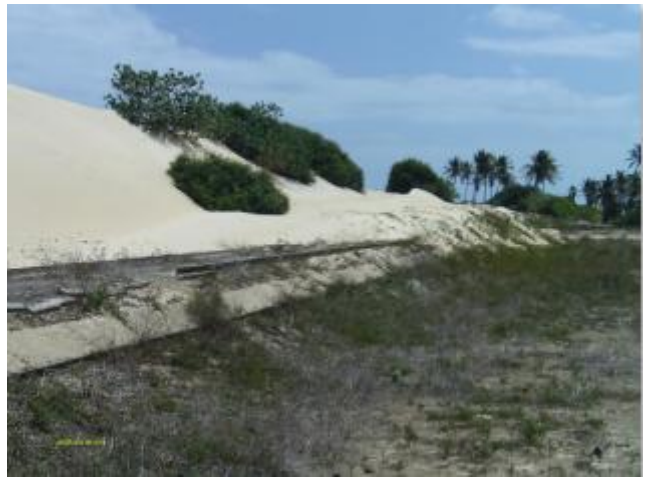
Foto 68 – Taludes da lagoa facultativa invadido pelas dunas.
