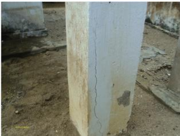
Foto 39 – REL-01: estrutura rachada.
