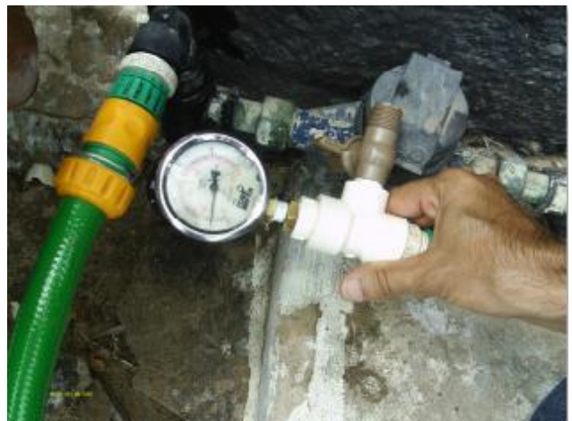
Foto 46 – RDA: medição instantânea de pressão na Rua Boa Vista, FNS 118.
