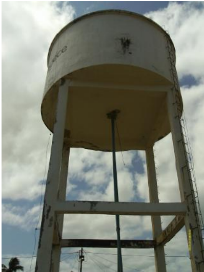
Foto 35 – REL-01: ausência de identificação- apenas logo da CAGECE.
