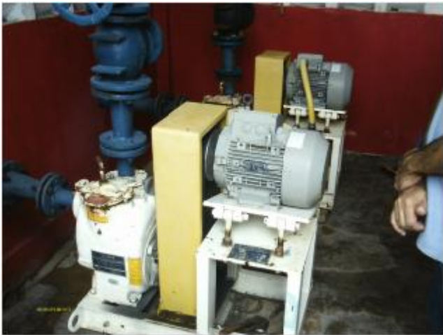
Foto 54 – EEE: conjunto moto-bomba com reserva.
