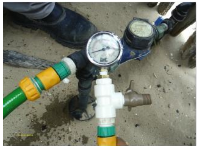
Foto 44 – RDA: medição instantânea de pressão na Rua do Cantinho, FNS 1046.
