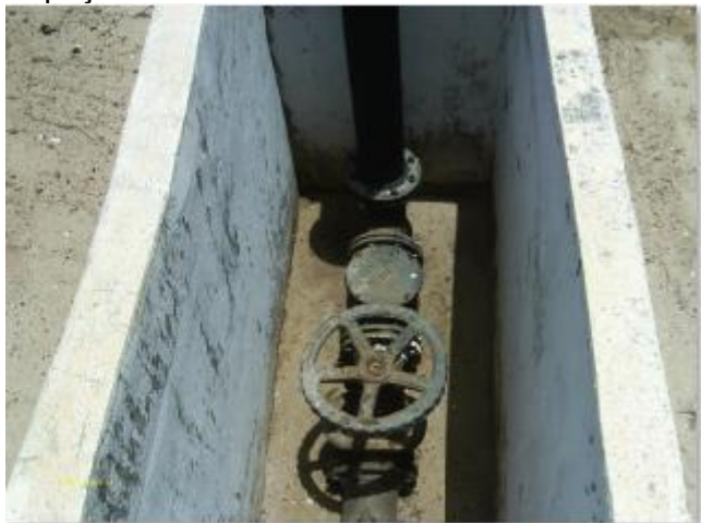
Foto 34 – RAP-01: caixa do registro sem grade ou tampa de inspeção.
