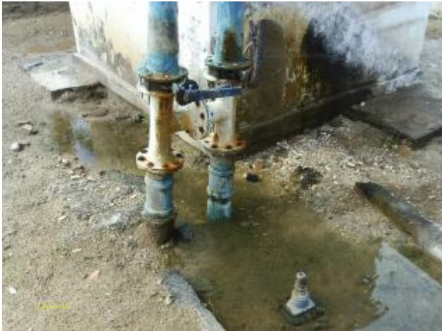
Foto 41 – REL-01: tubulação e registro com vazamento.
