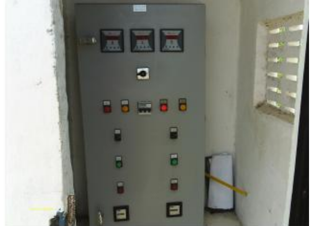
Foto 18 – PT-07: quadro de comando.
