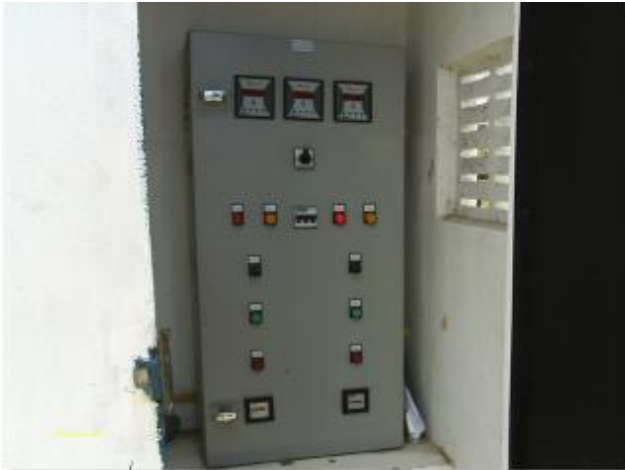
Foto 11 – PT-04: quadro de comando.
