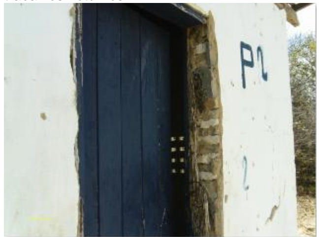
Foto 4 – PT-02 (desativado): porta deteriorada e identificação.
