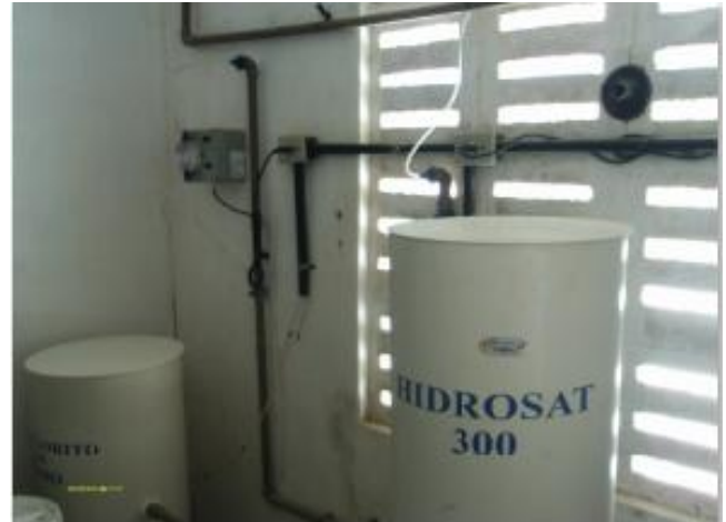
Foto 24 – Laboratório: tanques dosadores e armazenamento de materiais.
