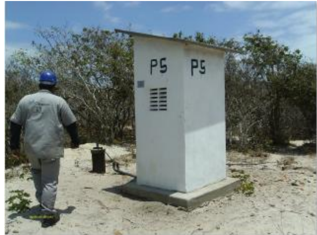
Foto 12 – PT-05 (desativado): identificação, área de acesso sem delimitação e ausência de iluminação para trabalhos noturnos.
