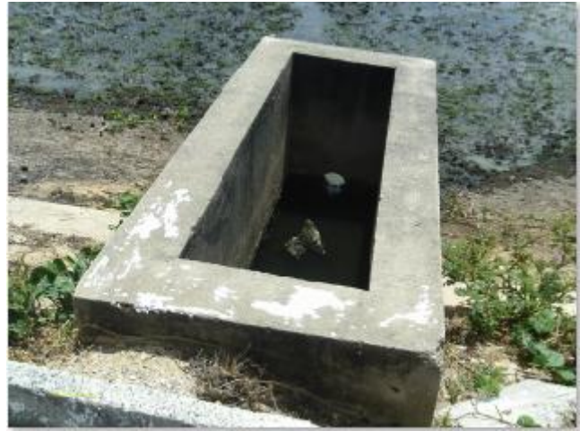
Foto 66 – Caixa de chegada do esgoto na lagoa facultativa.
