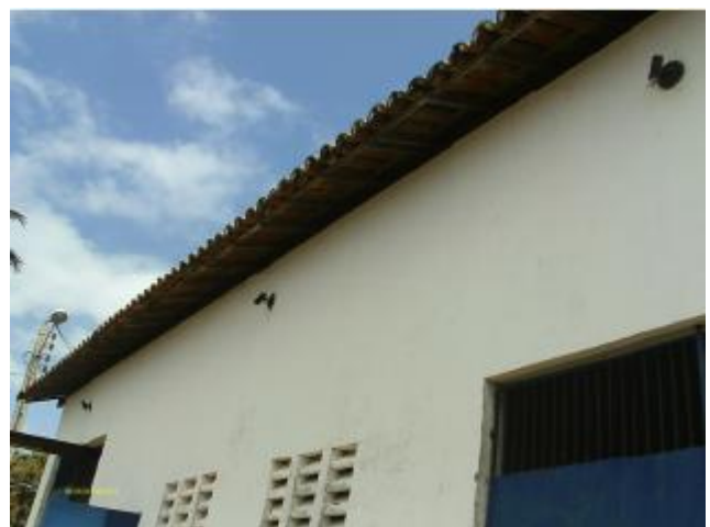
Foto 57 – EEE: ausência de iluminação externa.
