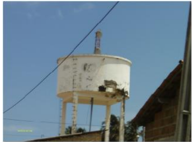
Foto 42 – REL-01: para-raios e ausência de guarda-corpo na laje de cobertura.
