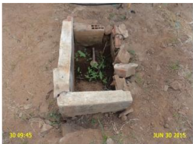
Foto 7 – AAT: caixa danificada.
