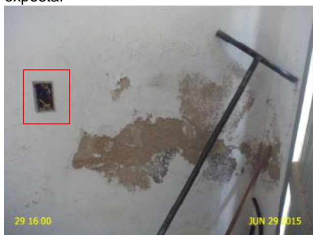
Foto 14 – EERD-01: ausência de interruptor.
