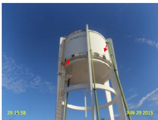
Foto 17 – REL-01: sinais de infiltração, pintura e estrutura deterioradas.
