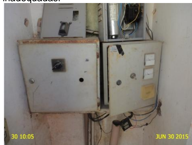
Foto 12 – EEAB-01: amperímetro e voltímetro sem funcionamento e fiação exposta.
