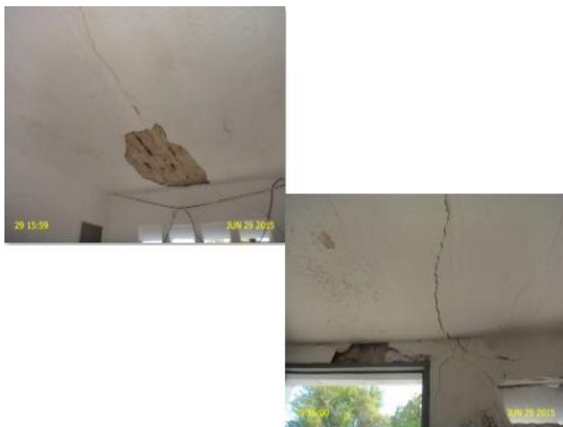
Foto 15 – EERD-01: estrutura danificada.
