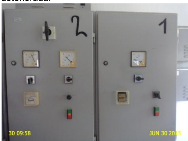
Foto 11 – EEAT-01: amperímetro sem funcionamento.
