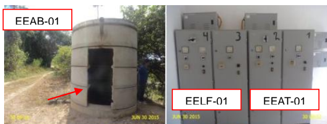
Foto 13 – EEAB-01, EEAT-01, EELF-01 e EERD-01: ausência de identificação.
