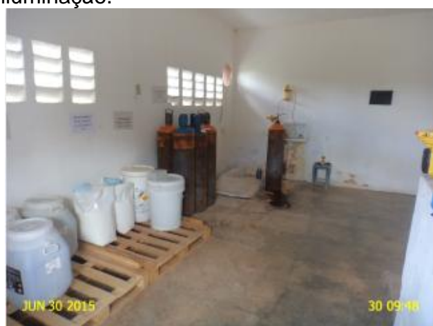
Foto 3 – Casa de química: área do cloro gasoso sem isolamento.
