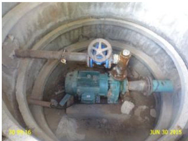
Foto 5 – EEAB-01: ausência de bomba reserva.
