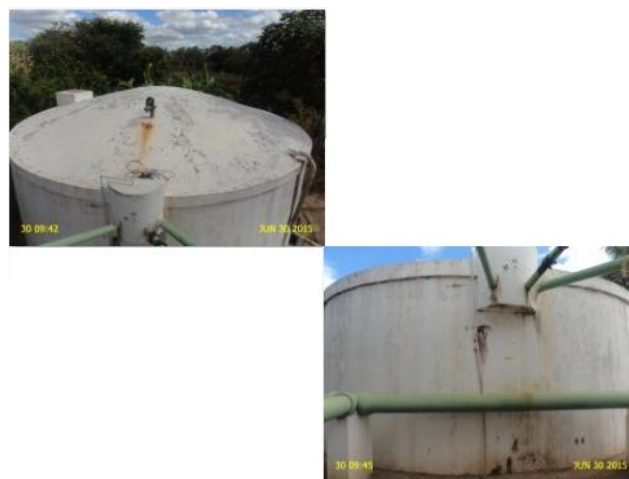
Foto 16 – RAP-01: pintura deteriorada e ausência de identificação.
