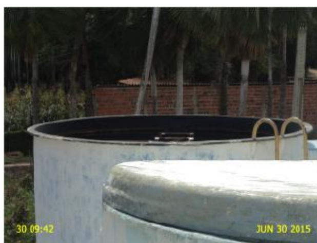
Foto 4 – Filtro F.04: ausência de tampa.
