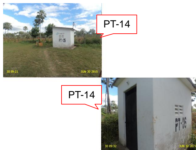
Foto 8 – PT-14 e PT-15: casas de abrigo dos QCs com pintura deteriorada e identificação errada.
