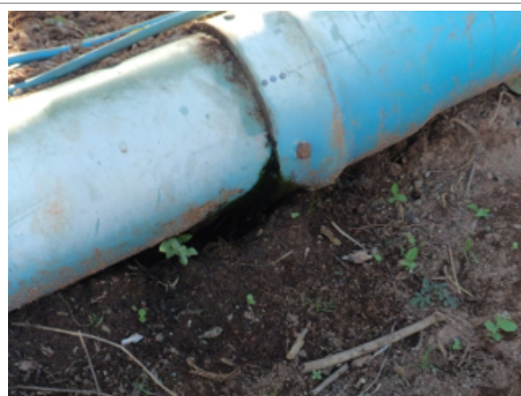
Foto 15 - AAB: vazamento entre a captação e a válvula de retenção (1)
