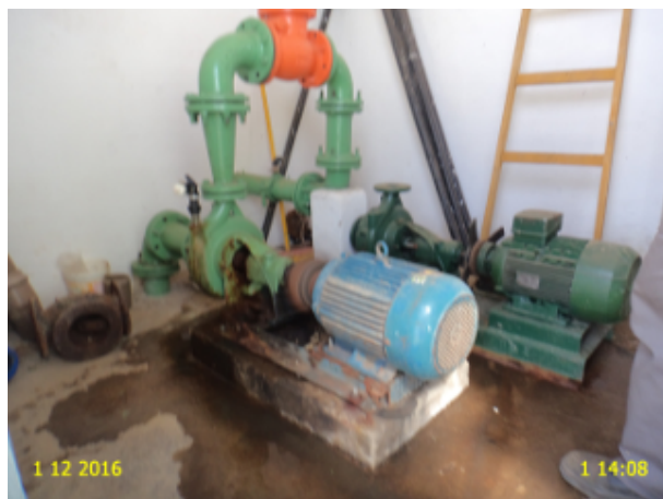
Foto 25 – EERD-01 (Sede): vazamento na gaxeta da bomba (booster).
