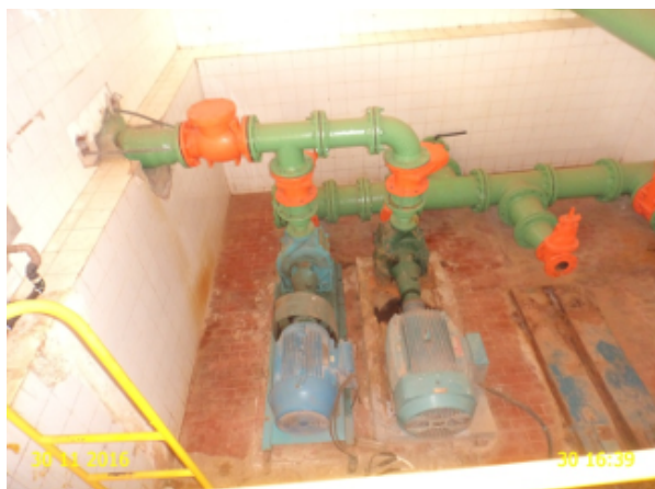
Foto 18 - EEAT-01: sem identificação.
