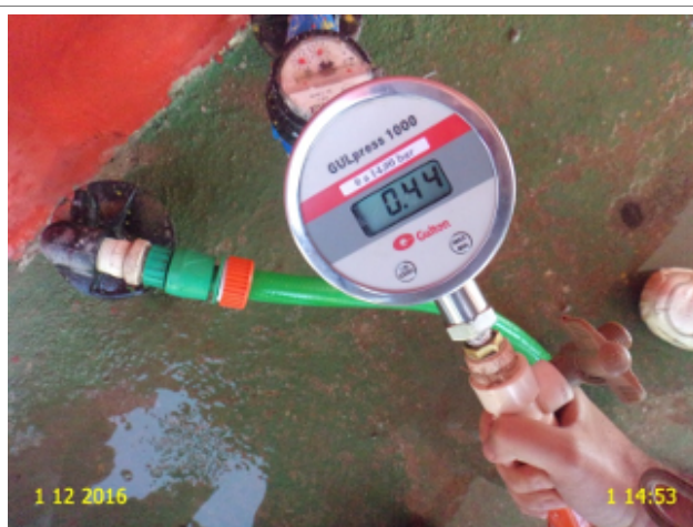
Foto 2 - RDA: medição instantânea de pressão no endereço localizado na Entrada do Cruzeiro, Bairro dos Trabalhadores.
