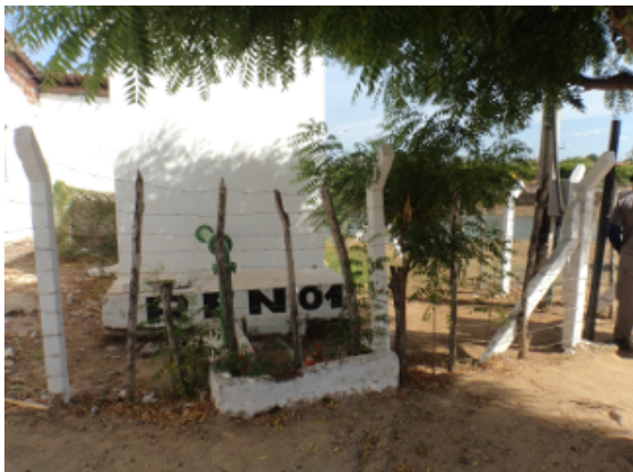
Foto 30 – REN-01 (Sede): A tampa de inspeção do reservatório está danificada.
