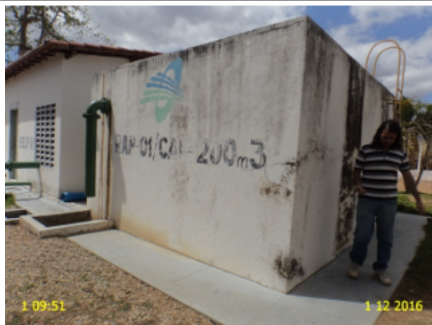
Foto 7 - RAP-01: pintura deteriorada.
