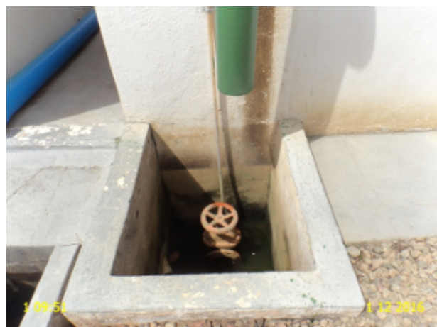
Foto 10 - RAP-01: caixa de registro e descarga de fundo sem tampa ou grade de proteção.
