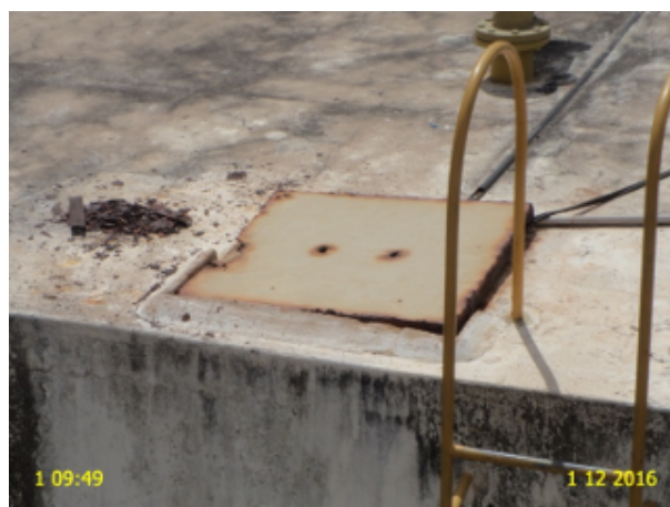
Foto 13 - RAP-01: tampa de inspeção em processo de corrosão.
