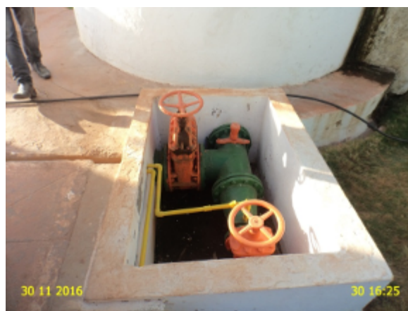
Foto 27 - Filtro F-01: caixa do registro de descarga de fundo sem tampa ou grade de proteção.
