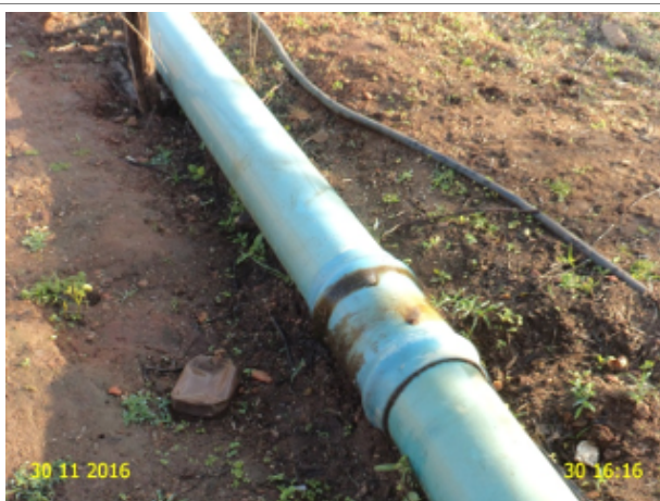
Foto 14 - AAB: vazamento entre a captação e a válvula de retenção (1)
