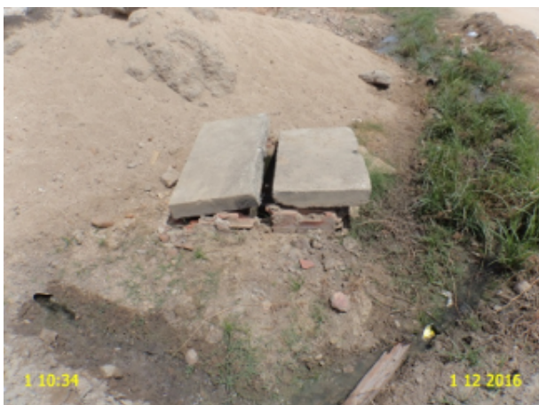
Foto 12 – RDA: registro de descarga com caixa danificada - Rua Sansão Moura.
