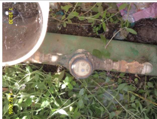
Foto 5 - - REL-01: medidor proporcional com defeito.
