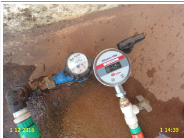
Foto 1 – RDA: medição instantânea de pressão no endereço localizado na Rua Rafael Claudio de Araújo.
