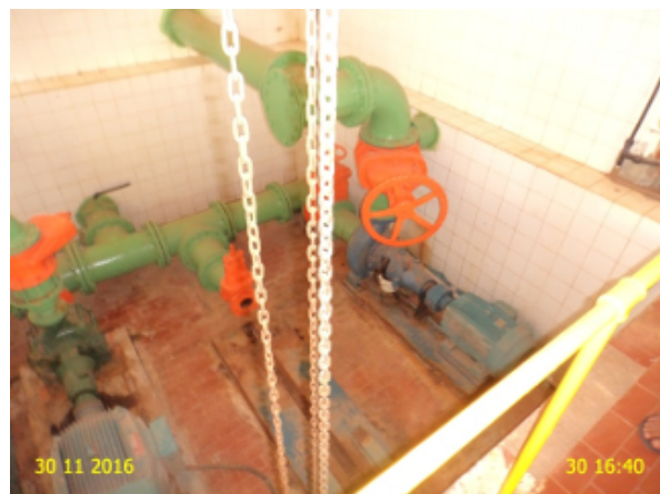
Foto 19 - EELF-01: sem identificação e sem bomba reserva.
