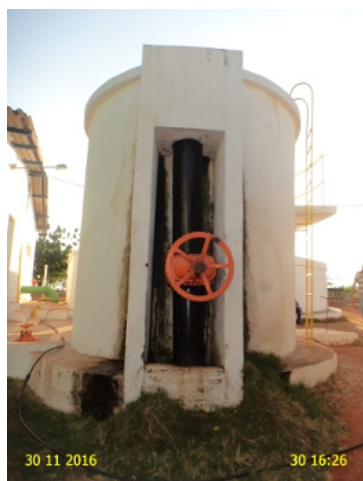
Foto 26 - Filtro F-01: sinais de vazamento no registro.
