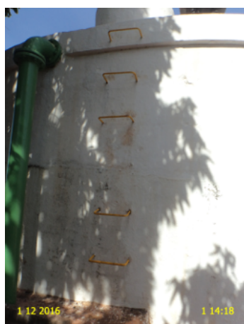
Foto 28 – RAP-01 (Sede): escada sem degrau.
