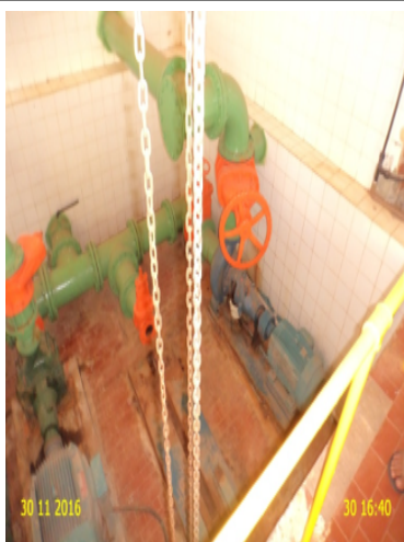
Foto 4 - EELF-01: bomba reserva não instalada.
