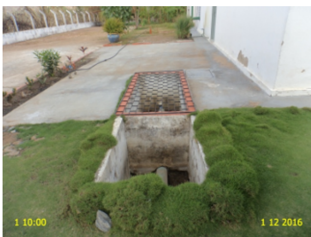
Foto 16 – ETA São Joaquim: caixa de inspeção sem tampa ou grade de proteção.
