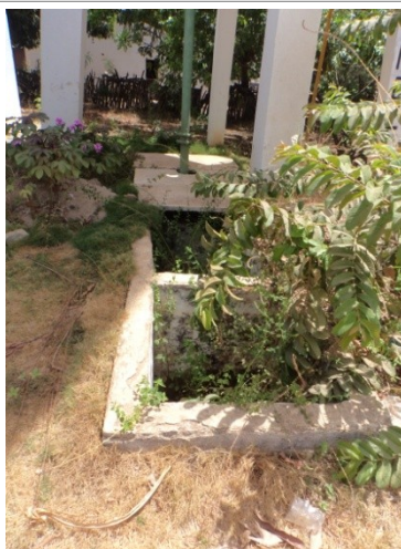
Foto 9 - REL-01: caixa do medidor proporcional sem tampa ou grade de proteção.
