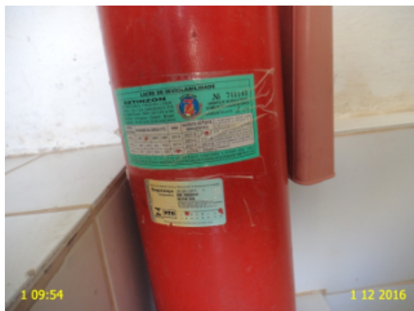
Foto 23 - EEAT-01: extintor de incêndio com data de validade da recarga vencida.
