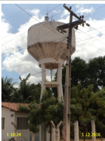
Foto 8 - REL-01: pintura deteriorada.
