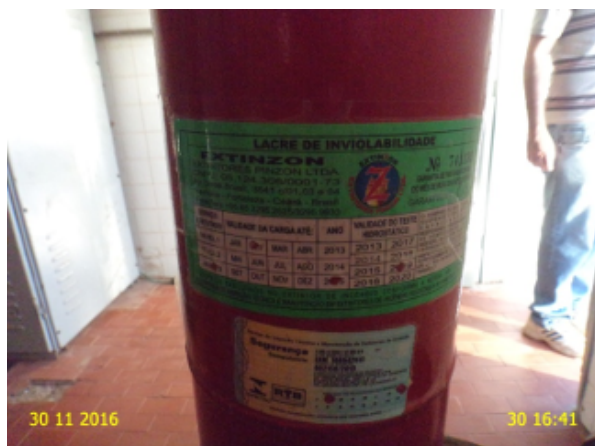
Foto 22 - EEAT-01: extintor de incêndio com data de validade da recarga vencida desde fevereiro/2015.
