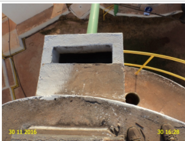
Foto 20 - Filtro F-01: tampa da calha de saída de água sem vedação.
