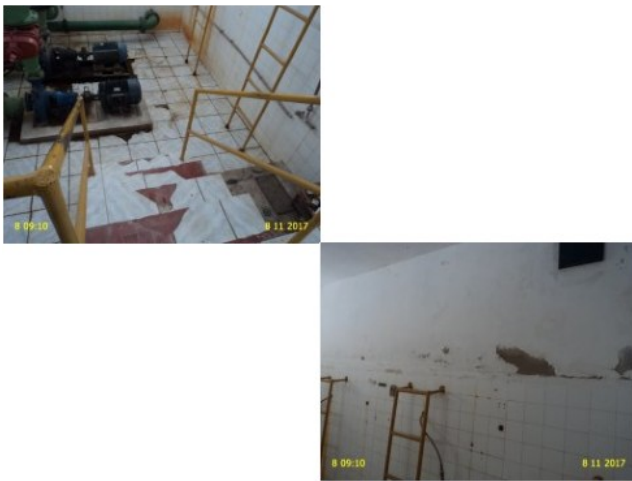
Foto 15 – EEAT-01: piso e reboco da parede deteriorados.
