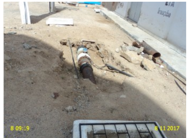
Foto 14 – ETA: macromedidor sem caixa.
