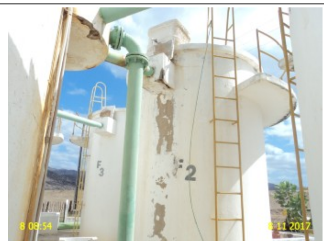
Foto 20 – F-02: reboco e pintura deteriorados e calha de água deteriorada com armadura exposta.
