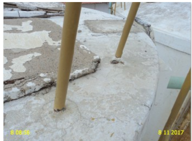
Foto 18 – F-01: escada sem fixação adequada na estrutura do reservatório.
