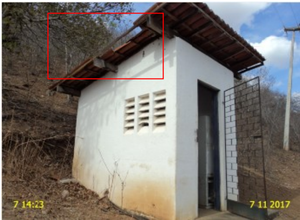
Foto 7 – EECS-01: ausência de identificação e telhado deteriorado.
