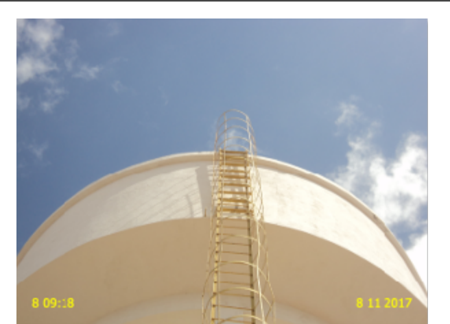
Foto 22 – REL-01: ausência de guarda-corpos na laje de cobertura.
