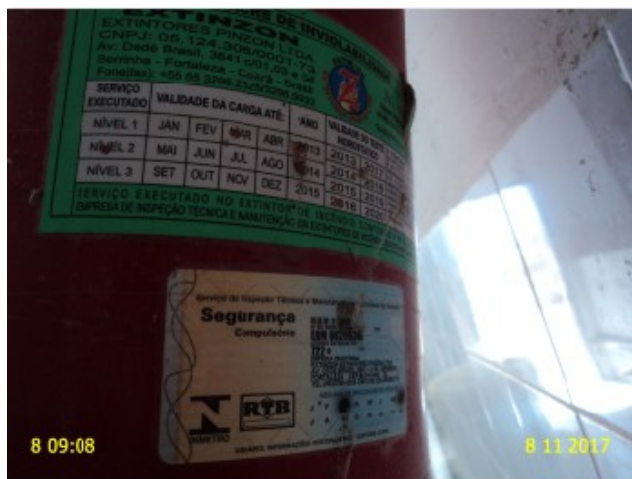
Foto 17 – EEAT-01: carga e teste hidrostático fora do prazo de validade.
