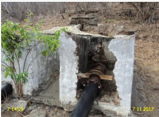
Foto 11 – AAB: caixa de inspeção danificada.
