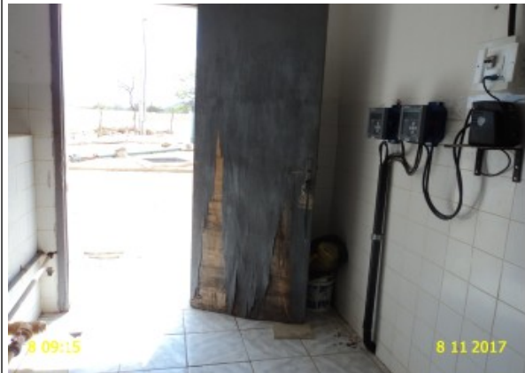
Foto 8 – Casa de química: porta deteriorada.
