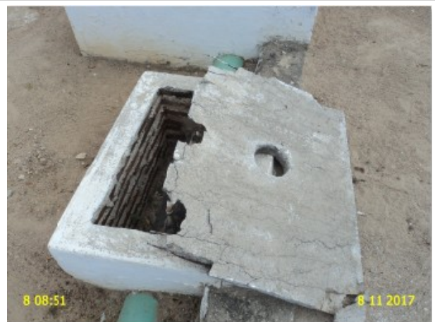
Foto 12 – AAB: tampa deteriorada.
