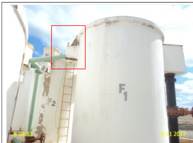
Foto 19 – F-01: calha de água com armadura exposta e tampa em processo de corrosão
