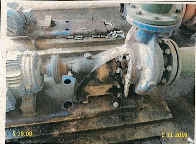
Foto 10 - EEAB-01: vazamento na gaxeta da bomba.
