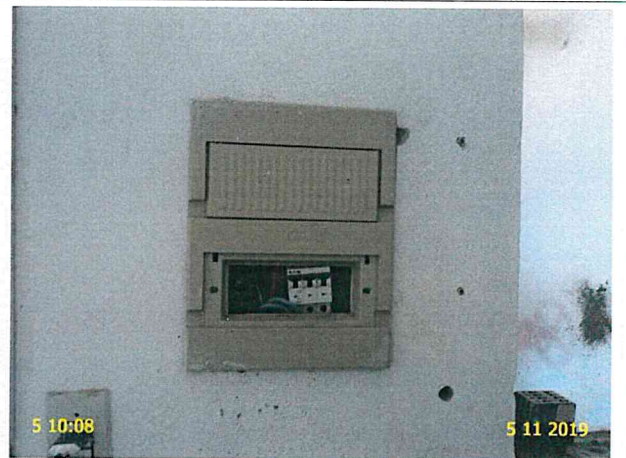
Foto 51 - EEAB-01: quadro de disjuntor sem tampa.
