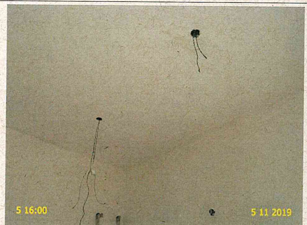
Foto 12 - EEE-01: ausência de lâmpadas instaladas na casa de abrigo do grupo gerador de energia elétrica.
