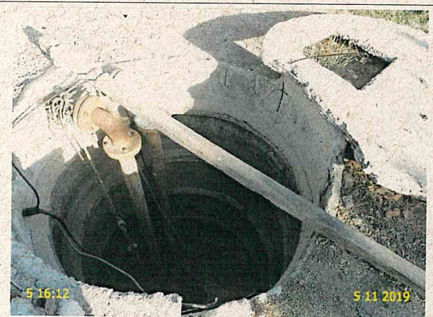
Foto 28 - EEE-08: poço sem tampa.
