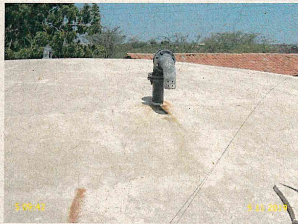
Foto 45 - RAP-02: tubulação de ventilação sem tela de proteção.
