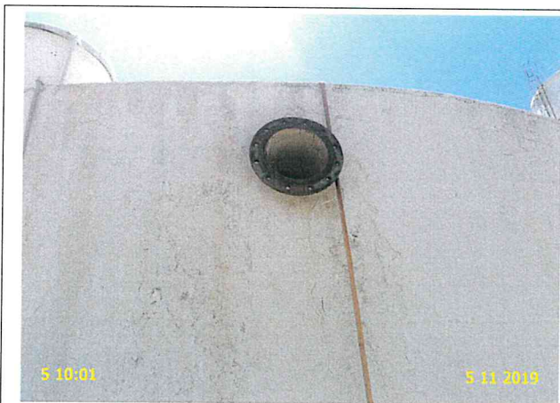
Foto 2 - RAP-03: o tubo extravasor está incompleto.
