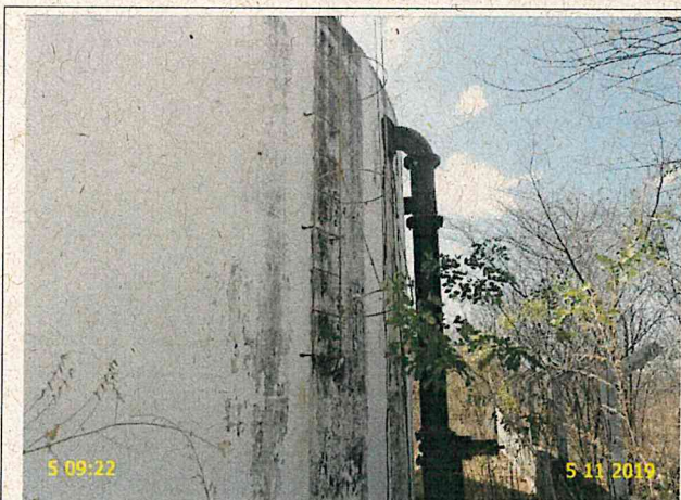
Foto 20 - RAP-01: escada de acesso danificada.
