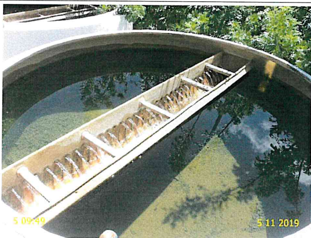
Foto 4 - ETA/Filtração: filtro F-03 sem tampa.
