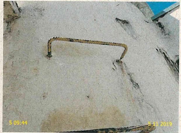
Foto 33 - ETA/Filtração: degrau sem fixação na escada do filtro F-01.
