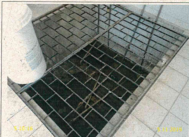
Foto 8 - ETA/Casa de química: acúmulo de água no poço.
