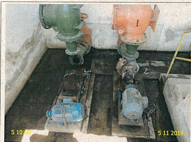
Foto 6 - EEAB-01: sem bomba reserva instalada.
