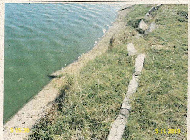
Foto 24 - ETE: placas danificadas na parede da lagoa facultativa.
