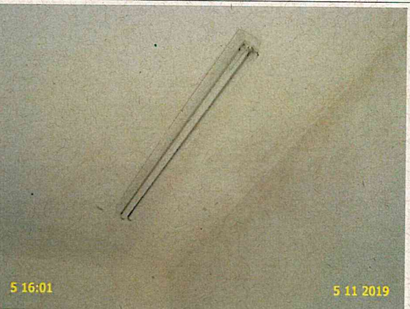
Foto 13 - EEE-01: lâmpada da casa de abrigo do quadro de comando não está acendendo.
