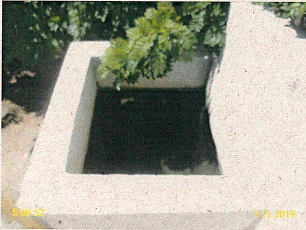
Foto 38 - ETA/Filtração: caixa de inspeção do filtro F-05 sem tampa e com acúmulo de água.
