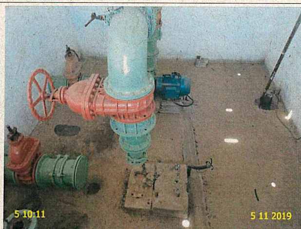
Foto 7 - EEAT-01: sem bomba reserva instalada.
