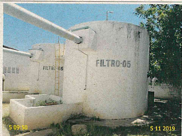
Foto 41 - ETA/Filtração: pintura deteriorada dos filtros F-05 e F-06.
