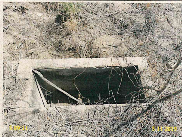
Foto 21 - AAB-01: caixa de registro de descarga sem tampa.
