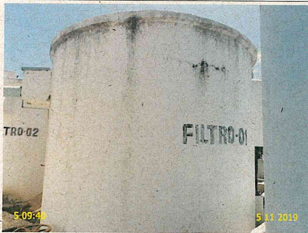
Foto 40 - ETA/Filtração: pintura deteriorada do filtro F-01.
