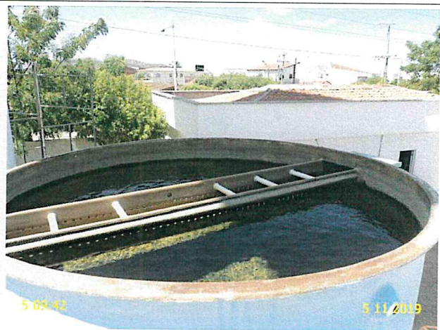
Foto 5 - ETA/Filtração: filtro F-07 sem tampa.
