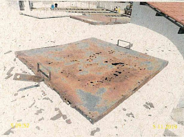
Foto 36 - ETA/Filtração: tampa do filtro F-06 em processo de corrosão.
