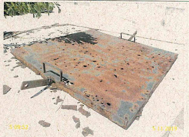
Foto 35 - ETA/Filtração: tampa do filtro F-05 em processo de corrosão.
