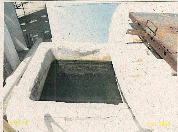
Foto 37 - ETA/Filtração: caixa de inspeção do filtro F-01 sem tampa e com acúmulo de água.
