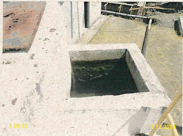
Foto 39 - ETA/Filtração: caixa de inspeção do filtro F-06 sem tampa e com acúmulo de água.
