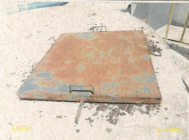
Foto 34 - ETA/Filtração: tampa do filtro F-01 em processo de corrosão.
