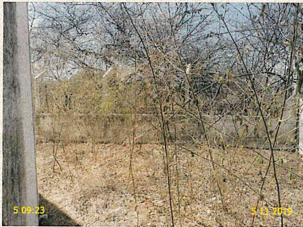
Foto 44 - RAP-01: vegetação excessiva na área do reservatório.
