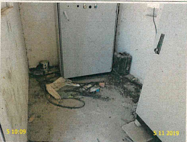
Foto 11 - EEAB-01: lixo acumulado na área da casa de abrigo do quadro de comando.
