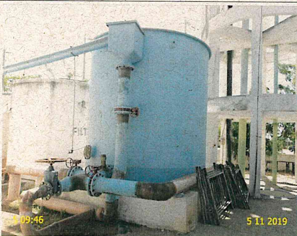
Foto 42 - ETA/Filtração: filtro F-07 sem identificação.
