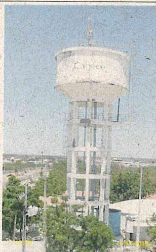
Foto 18 - REL-01: pintura deteriorada, armaduras expostas.
