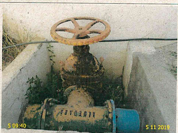
Foto 29 - ETA/Filtração: vazamento no registro do filtro F-01.
