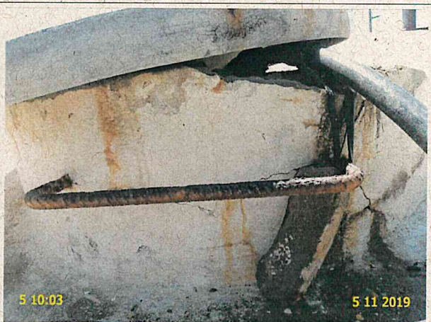
Foto 47 - RAP-02: tampa sem vedação.
