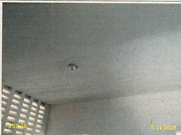
Foto 9 - ETA/Casa de química: ausência de lâmpada no almoxarifado de produtos químicos.
