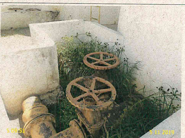
Foto 31 - ETA/Filtração: vegetação excessiva dentro da caixa do registro do filtro F-05.
