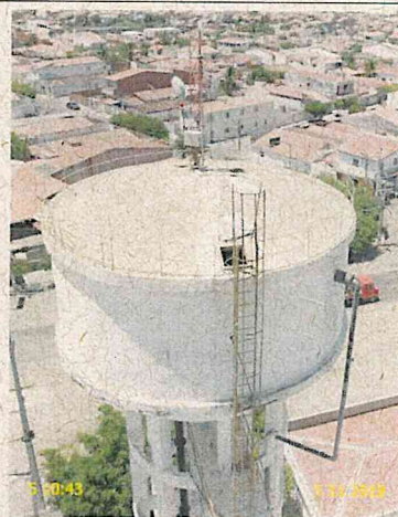
Foto 49 - REL-01: tampa fora do local da abertura de inspeção.
