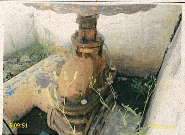
Foto 30 - ETA/Filtração: vazamento no registro do filtro F-06.
