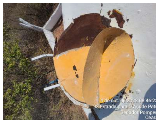
Foto 10 - RAP-02: tampa oxidada.
