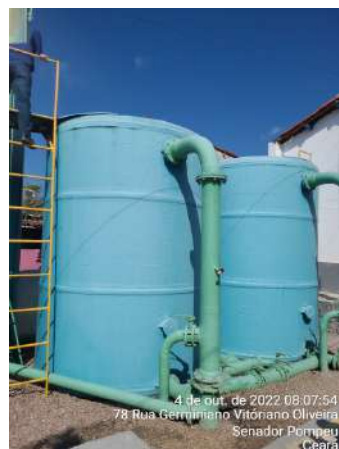
Foto 4 - ETA: ausência de identificação nos filtros .
