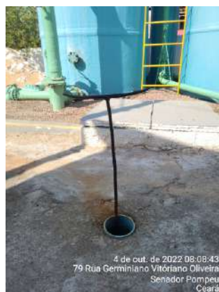
Foto 5 - ETA: registro sem caixa de proteção.
