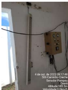
Foto 17 - RAP-03: Luminária solta.
