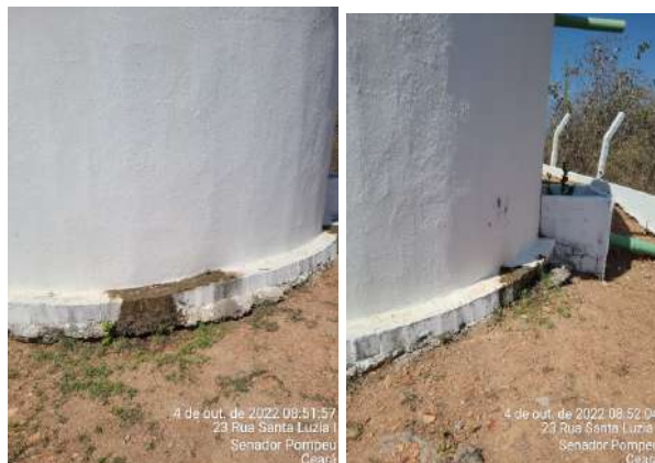
Foto 14 - RAP-02: possui vazamentos.
