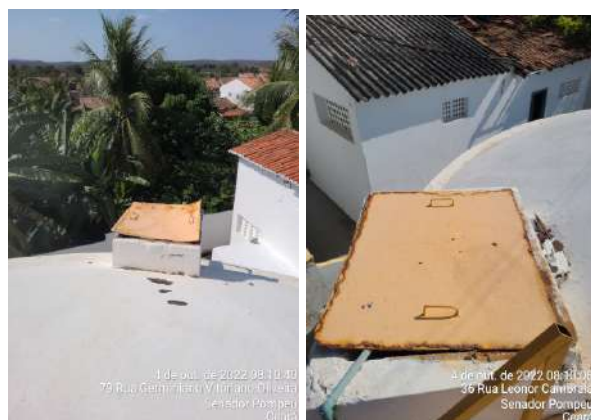
Foto 6 - ETA: as tampas do RSE-01 estão oxidadas e sem vedação.
