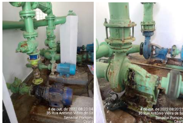
Foto 8 - ETA: vazamentos na EEAT-01 e EEAT-02.
