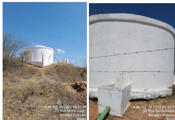
Foto 12 - RAP-02: ausência de identificação.
