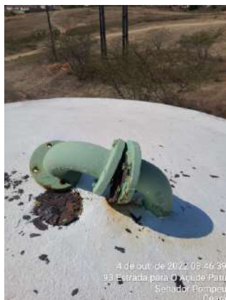
Foto 11 - RAP-02: tubulação do suspiro danificada.
