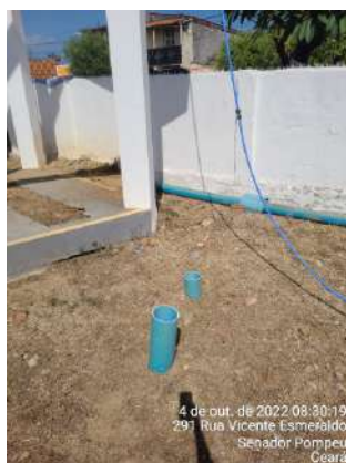
Foto 9 - REL-01: registros sem caixa de proteção.
