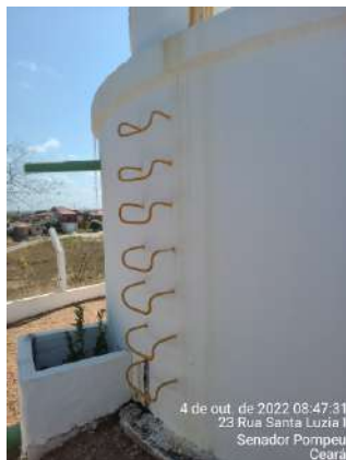
Foto 13 - RAP-02: não possui mangueira de nível.
