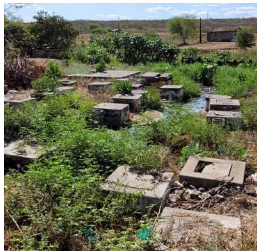
Foto 19 - Esgoto: lançamento in natura.
