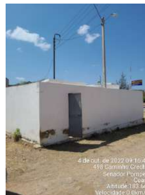
Foto 16 - RAP-03: ausência de identificação.
