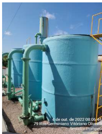
Foto 3 - ETA: ausência de identificação nos filtros
