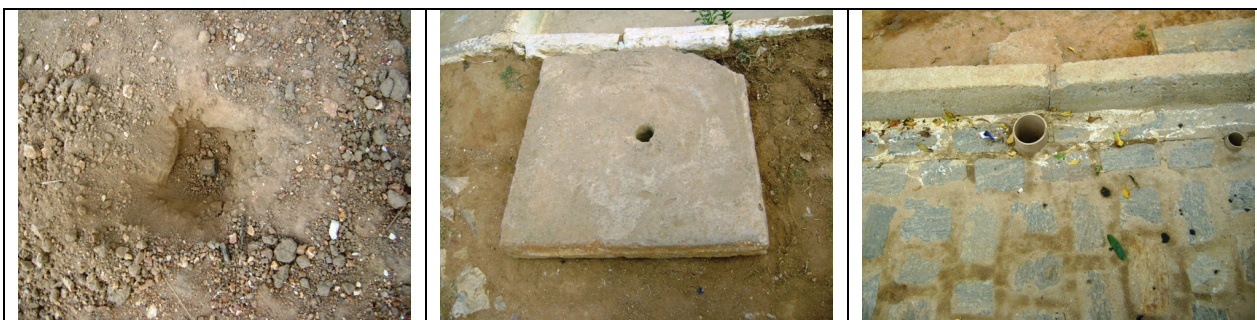
Fotos 28, 29 e 30 – Registros de descarga nas Ruas 01 do Conj. Habitacional, Antonio Alves Guerra e Av. Antonio Sabino Guerra.
