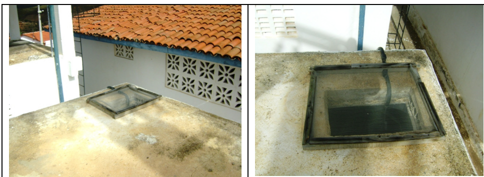
Fotos 19 e 20 – RAP-02: vista parcial da laje superior e detalhe da tampa de inspeção improvisada
