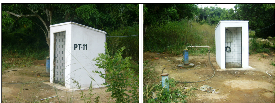
Fotos 4 e 5 – Vistas das instalações do PT-11.
