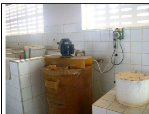
Foto 9 – Tanque e bomba dosadora de hipoclorito de cálcio
