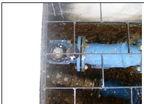
Foto 26 – Macromedidor na saída do REL-01.
