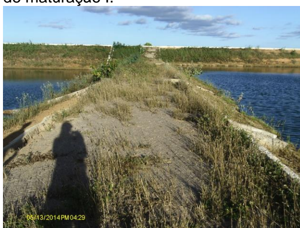
Foto 149 - ETE: vegetação excessiva nas passarelas entre lagoa de maturação I e II.
