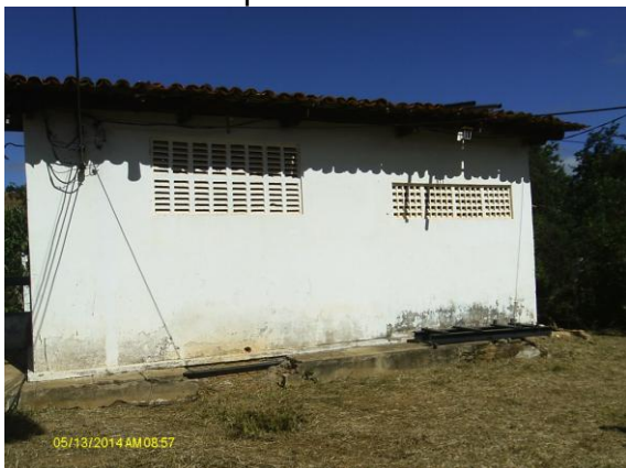
Foto 3 - EEAB-01: ausência de identificação.
