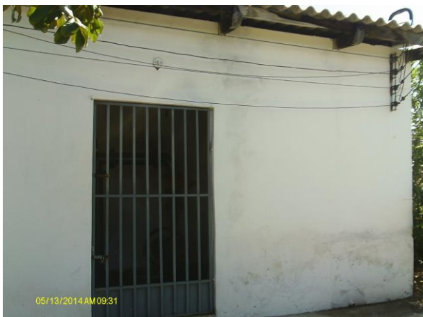
Foto 46 - EEAT-01: ausência de identificação.
