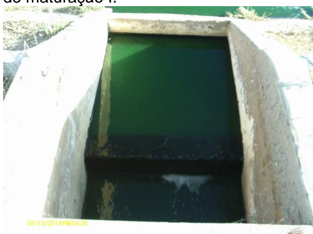
Foto 148 - ETE: saída do esgoto na lagoa de maturação I.
