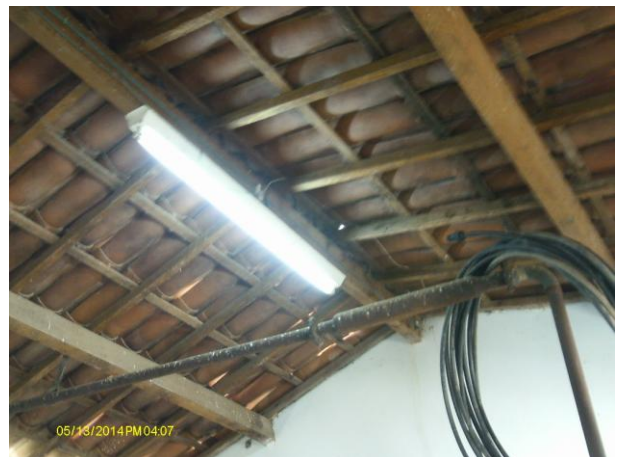
Foto 125 - EEE-06: iluminação interna.
