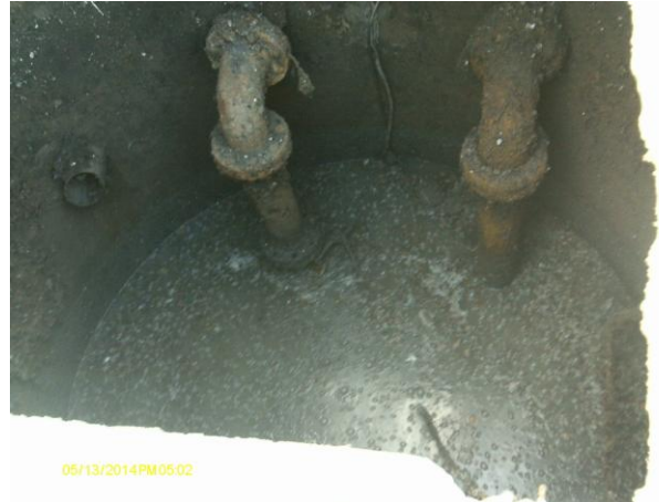
Foto 105 - EEE-01: bombas submersas.
