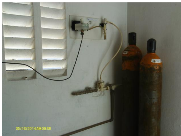
Foto 31 - ETA/Casa de química: dosagem de cloro gasoso.
