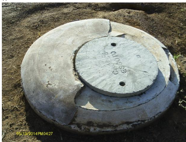
Foto 143 - PV (4) lagoa de maturação I.
