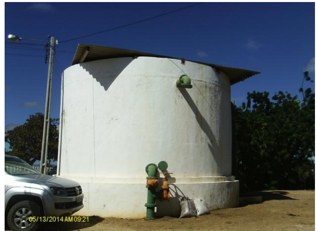
Foto 12 - ETA/Filtração: Pré-filtro sem identificação.
