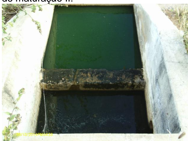
Foto 154 - ETE: saída do efluente final (II).
