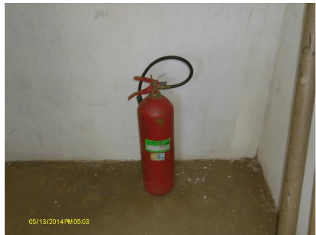
Foto 107 - EEE-01: extintor de incêndio.
