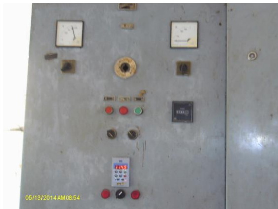
Foto 6 - EEAB-01: quadro de comando.
