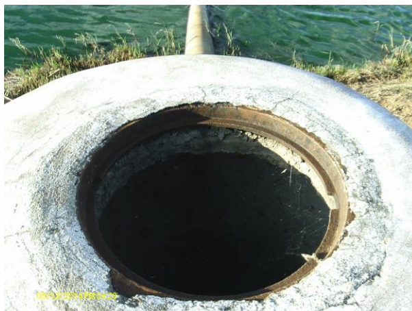
Foto 145 - ETE: PV (5) sem tampa na lagoa de maturação
