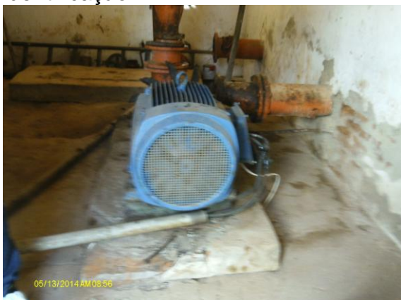
Foto 5 - EEAB-01: bomba reserva.
