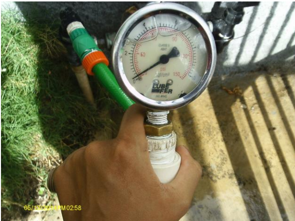
Foto 81 - Medição instantânea de pressão na rede de distribuição: Rua José Severo Cortez, 981.
