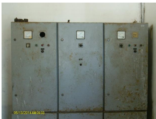
Foto 49 - EEAT-01: quadro de comando.
