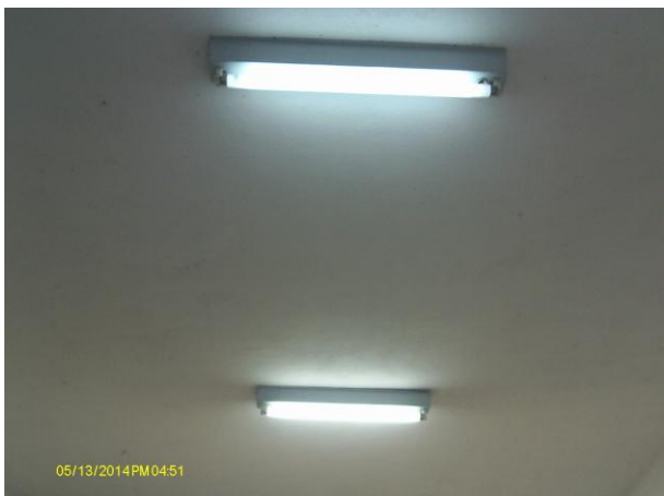
Foto 114 - EEE-02: iluminação interna.
