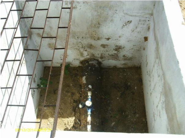
Foto 9 - ETA: medidor proporcional instalado com caixa na chegada da água bruta.
