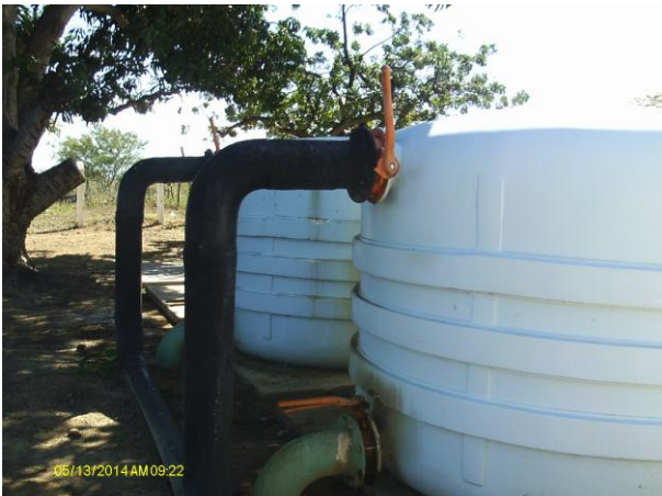
Foto 11 - ETA/Filtração: Tubulações e registros dos filtros de pressão FP-01 e FP-02.
