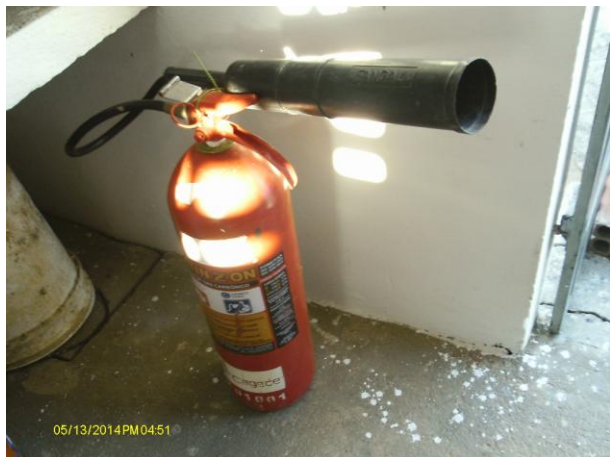
Foto 116 - EEE-02: extintor de incêndio.
