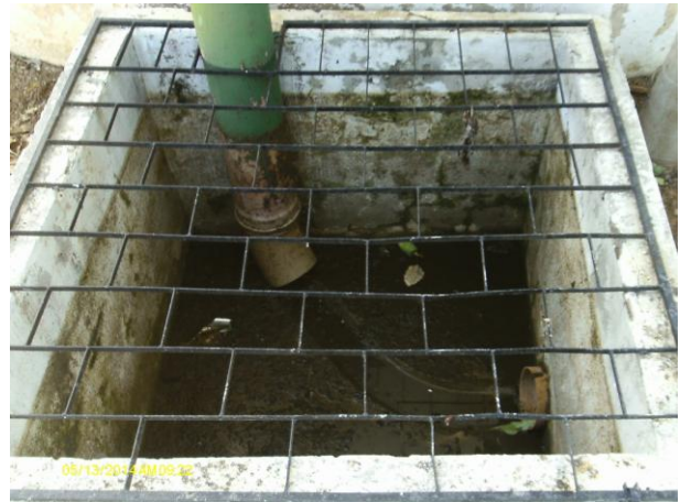
Foto 14 - ETA/Filtração: tubulação e caixa de descarga de fundo do pré-filtro.
