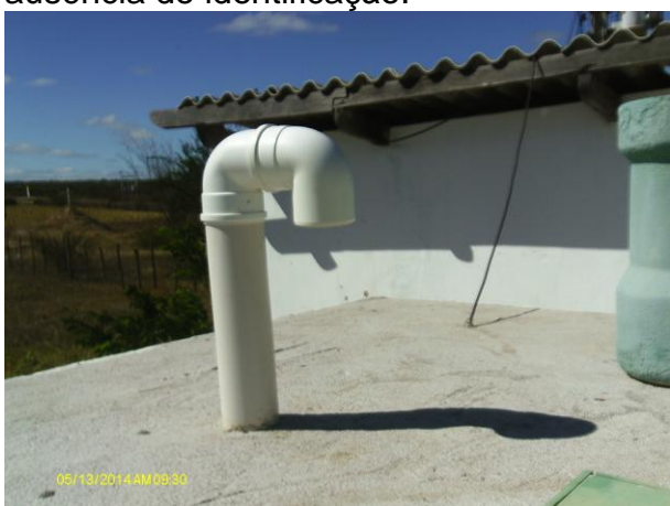
Foto 61 - RAP-01: tubulação de ventilação sem tela de proteção.
