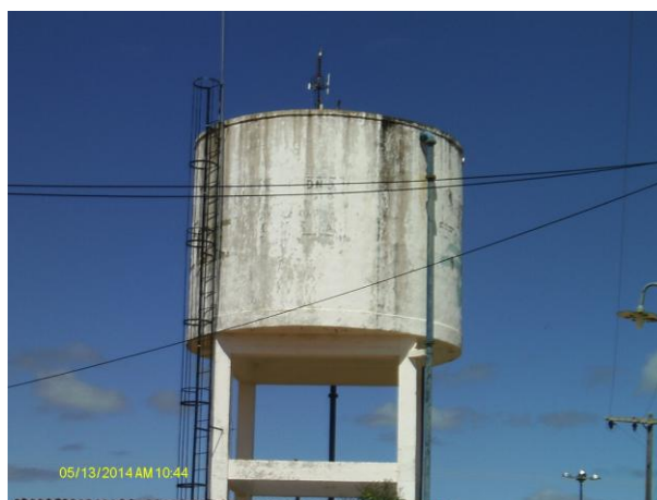
Foto 74 - REL-02: pintura deteriorada, escada de acesso com guarda corpo, pára-raio, ausência de identificação.
