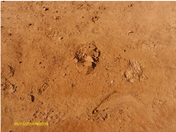
Foto 89 - Registro de descarga na rede de distribuição: Rua Pereira Filgueiras (soterrado).
