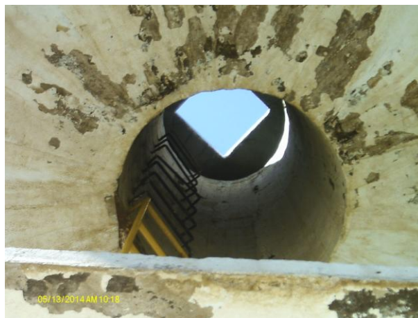
Foto 72 - REL-03: sem tampa de inspeção.
