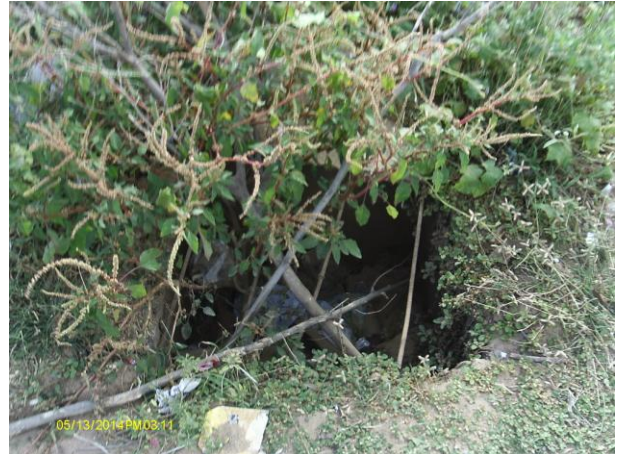
Foto 88 - Registro de descarga na rede de distribuição: Rua da Glória (tampa danificada).
