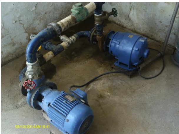
Foto 52 - EERD-01: conjunto moto-bomba com reserva.
