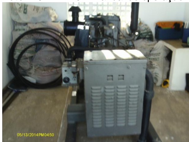
Foto 115 - EEE-02: grupo gerador de energia elétrica com defeito.
