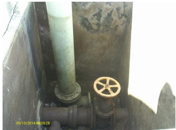
Foto 24 - ETA/Filtração: caixa do registro e da descarga de fundo do F-03 sem tampa ou grade de proteção.
