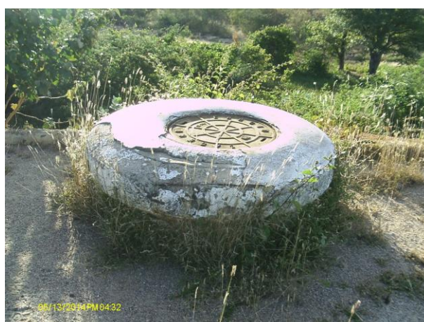
Foto 155 - ETE: PV (6) na saída do efluente final.
