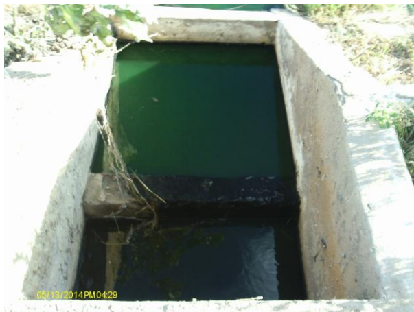
Foto 147 - ETE: saída do esgoto na lagoa de maturação I.
