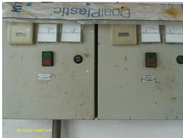
Foto 53 - EERD-01: quadro de comando.
