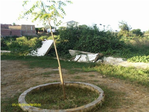
Foto 98 - EEE-01: desmoronamento do muro que delimita a área da EEE.
