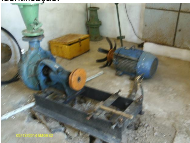
Foto 48 - EEAT-01: bomba reserva.
