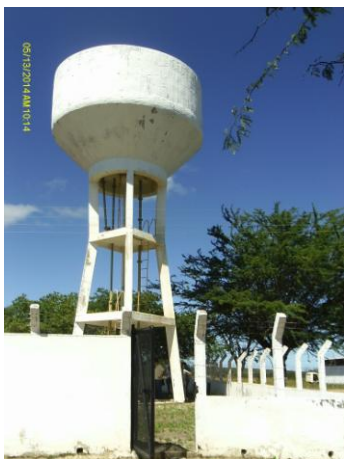
Foto 69 - REL-03: acesso, delimitação da área, ausência de identificação.
