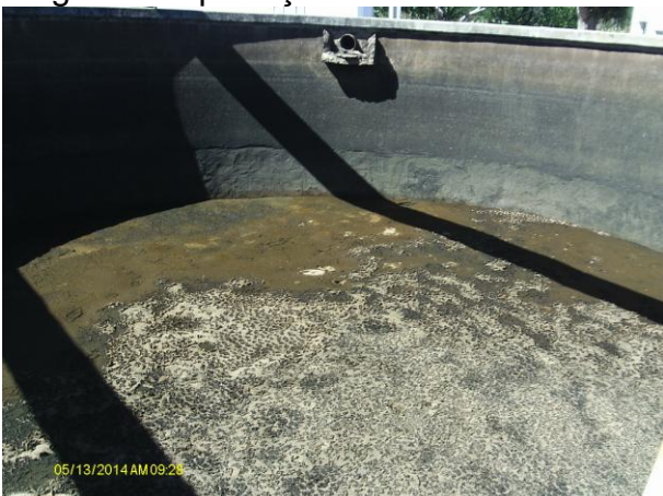
Foto 23 - ETA/Filtração: leito do F-03.
