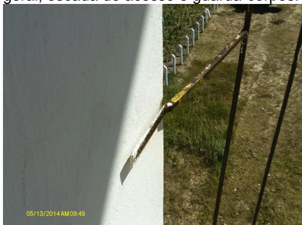
Foto 67 - REL-01: guarda-corpo da escada de acesso sem fixação.
