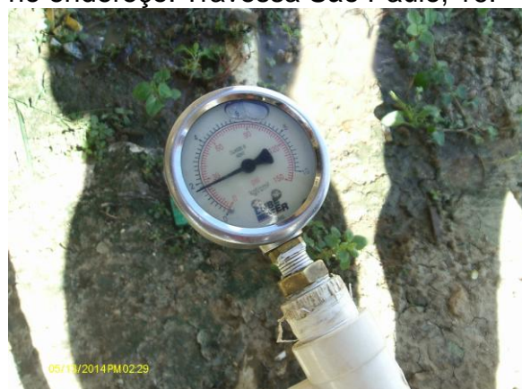
Foto 80 - Medição instantânea de pressão na rede de distribuição: Rua Rosário, 46.
