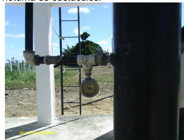
Foto 68 - REL-01: medidor de nível.
