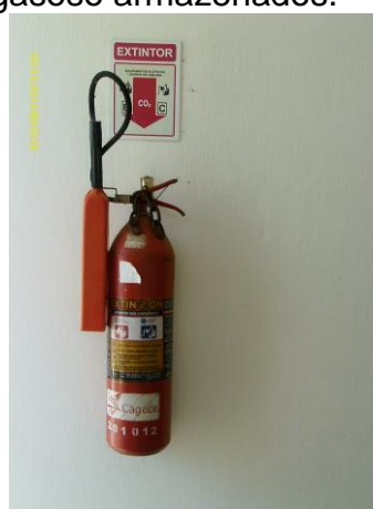
Foto 34 - ETA/Casa de química: extintor de incêndio.
