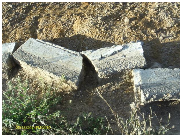
Foto 152 - ETE: talude danificado na lagoa de maturação II.
