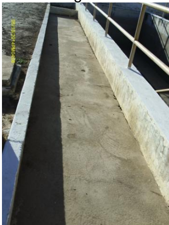
Foto 120 - EEE-06: caixa de areia.
