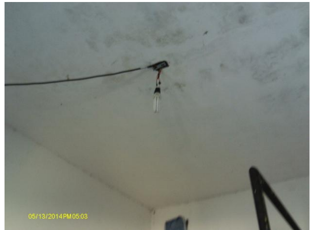
Foto 101 - EEE-01: iluminação interna com defeito e instalações elétricas inadequadas.
