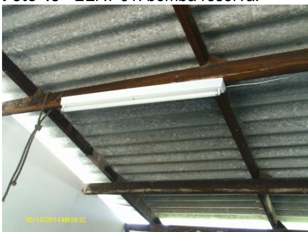
Foto 50 - EEAT-01: iluminação da casa de abrigo com defeito.
