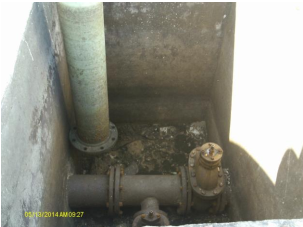
Foto 21 - ETA/Filtração: caixa do registro e da descarga de fundo do F-02 sem tampa ou grade de proteção.
