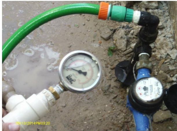
Foto 82 - Medição instantânea de pressão na rede de distribuição: Rua Pereira Filgueiras.
