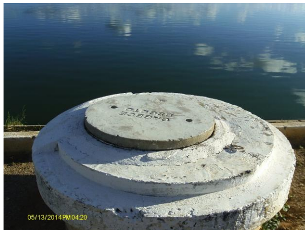
Foto 135 - ETE: PV (1) lagoa facultativa.
