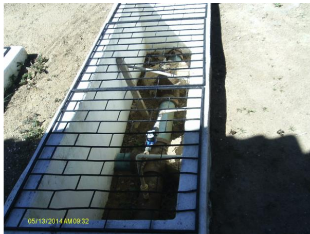
Foto 44 - ETA: medidor proporcional instalado com caixa na saída da água tratada.
