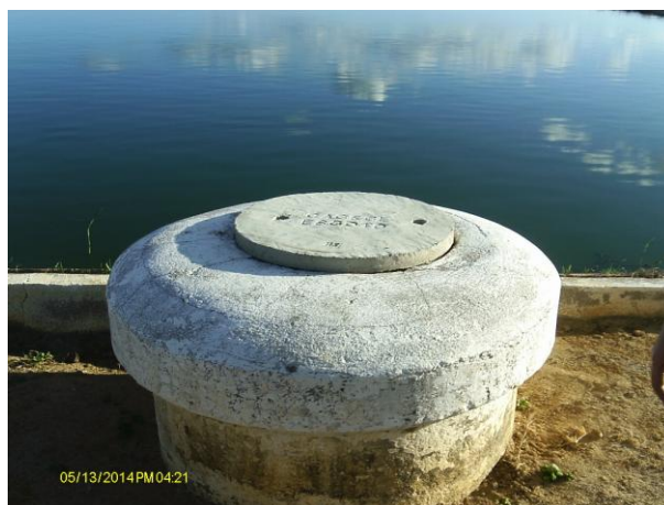
Foto 137 - ETE: PV (2) lagoa facultativa.
