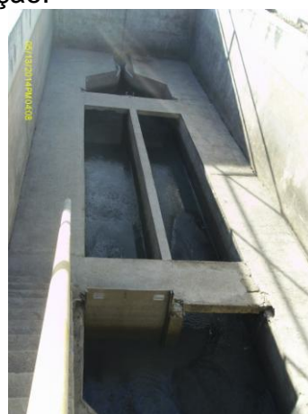
Foto 119 - EEE-06: calha Parshall.
