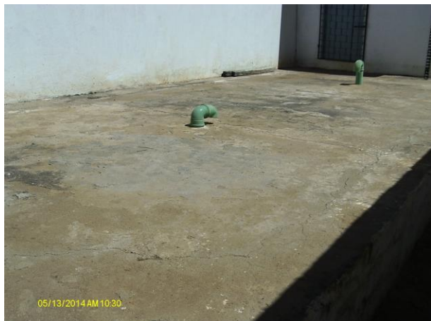
Foto 63 - REN-01: ausência de identificação, cobertura sem tampa de inspeção e tubulação de ventilação sem tela de proteção.
