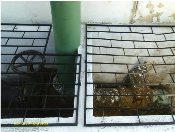
Foto 15 - ETA/Filtração: registros do pré-filtro.
