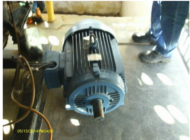
Foto 123 - EEE-06: bomba reserva.
