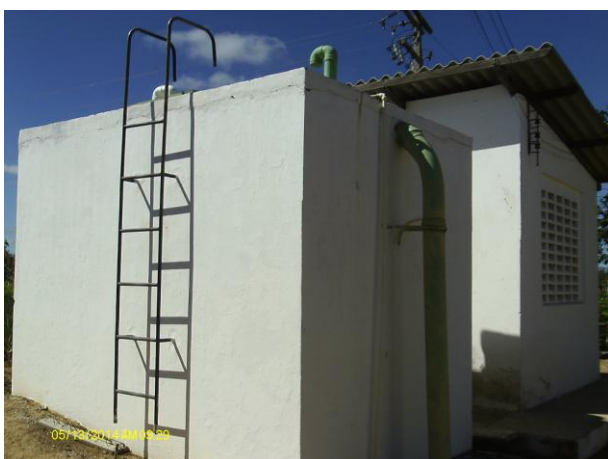
Foto 59 - RAP-01: escada de acesso, medidor de nível, tubo extravasor e ausência de identificação.
