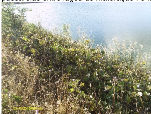
Foto 151 - ETE: vegetação excessiva no talude da lagoa de maturação II.
