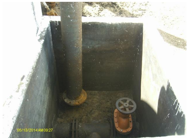
Foto 18 - ETA/Filtração: caixa do registro e da descarga de fundo do F-01 sem tampa ou grade de proteção.
