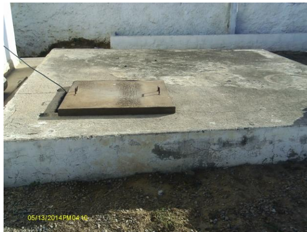
Foto 121 - EEE-06: poço de sucção.
