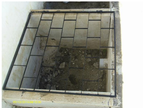
Foto 64 - REN-01: caixa de descarga de fundo.
