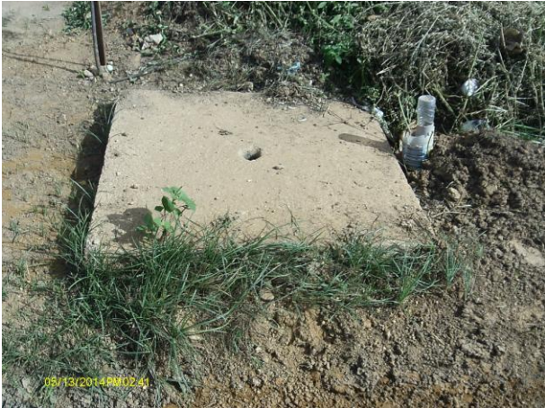
Foto 87 - Registro de descarga na rede de distribuição: Rua Carneiro de Mendonça.
