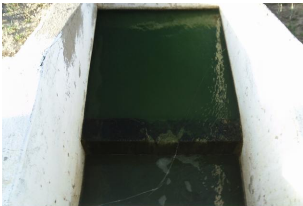
Foto 140 - ETE: saída do esgoto para lagoa de maturação I.
