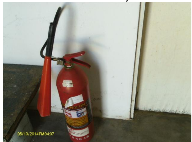
Foto 127 - EEE-06: extintor de incêndio.
