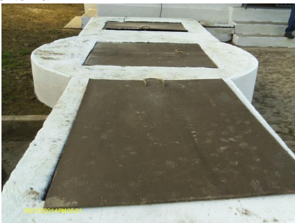
Foto 102 - EEE-01: poço de sucção coberto.
