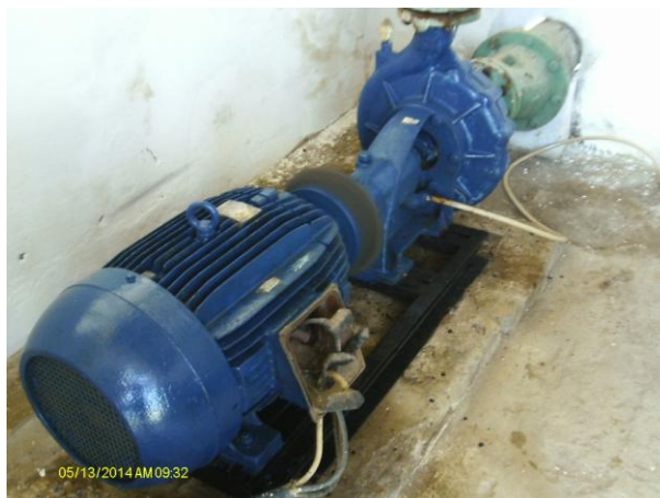
Foto 47 - EEAT-01: conjunto moto-bomba.
