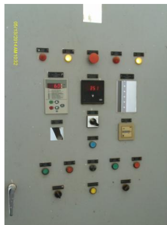
Foto 57 - EERD-02: quadro de comando.
