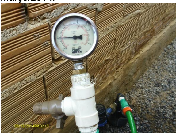
Foto 79 - Medição instantânea de pressão na rede de distribuição: Rua Flamengo, 31.
