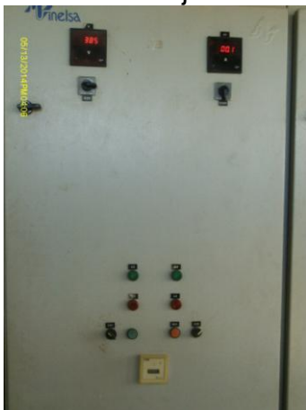
Foto 124 - EEE-06: quadro de comando.
