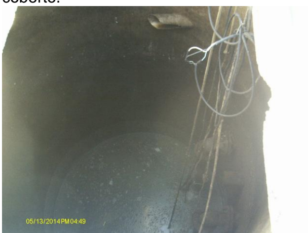
Foto 112 - EEE-02: bombas submersas.
