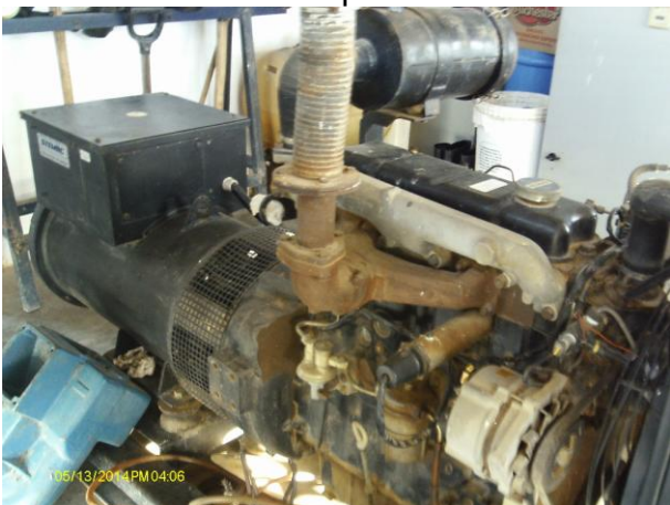
Foto 126 - EEE-06: grupo gerador de energia elétrica com defeito.
