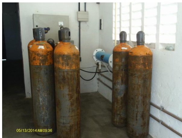
Foto 32 - ETA/Casa de química: cilindros de cloro gasoso armazenados.
