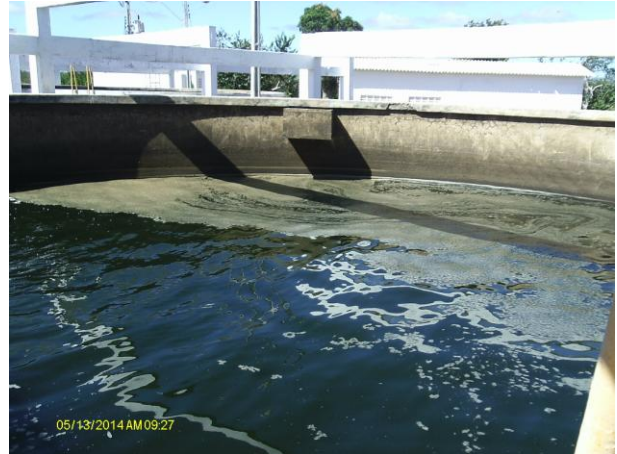
Foto 20 - ETA/Filtração: superfície de filtração do F-02.
