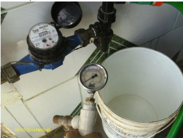
Foto 83 - Medição instantânea de pressão na rede de distribuição: Rua Cecília Meireles, 14.
