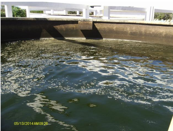
Foto 17 - ETA/Filtração: superfície de filtração do F-01.
