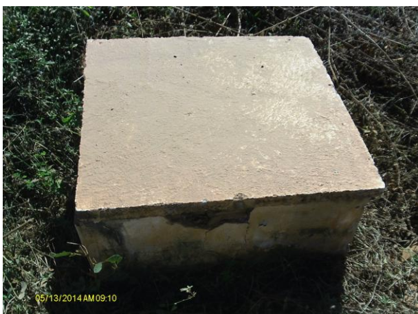
Foto 45 - AAB-01: caixa de descarga.
