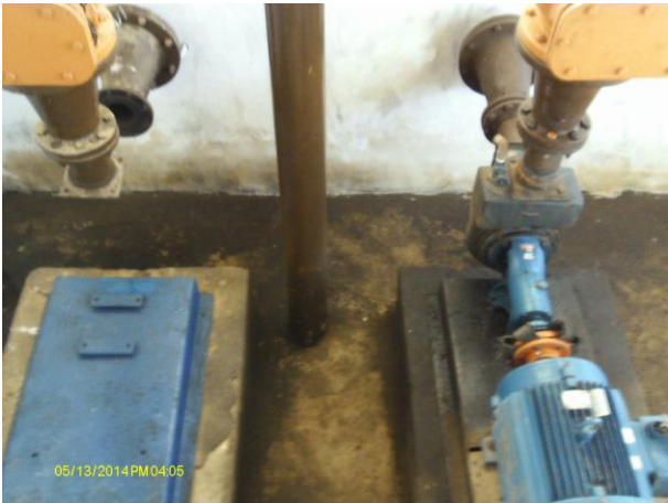
Foto 122 - EEE-06: conjunto moto-bomba.
