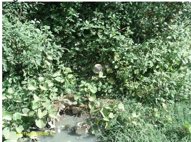
Foto 84 - Registro de descarga na rede de distribuição: Rua Flamengo (sem caixa).
