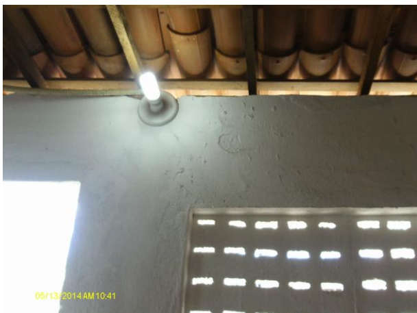
Foto 54 - EERD-01: iluminação da casa de abrigo.
