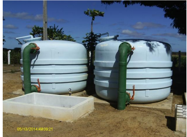
Foto 10 - ETA/Filtração: Filtros de Pressão FP-01 e FP-02 sem identificação.
