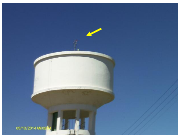
Foto 66 - REL-01: pára-raio e sinalização noturna de obstáculos.
