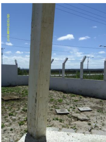
Foto 73 - REL-03: rachaduras na base.
