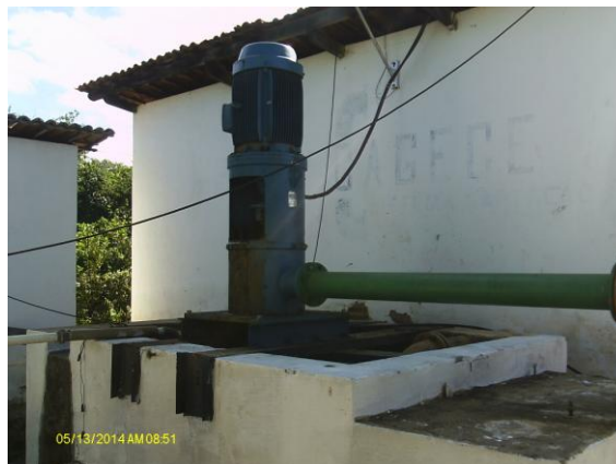
Foto 4 - EEAB-01: conjunto moto-bomba.
