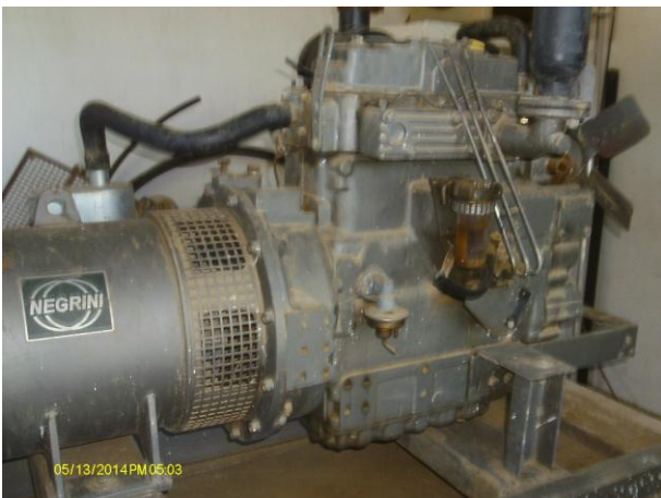
Foto 106 - EEE-01: grupo gerador de energia elétrica com defeito.
