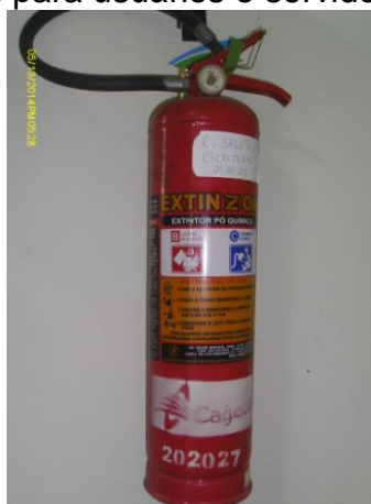
Foto 161 - Comercial/escritório: extintor de incêndio.
