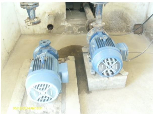
Foto 56 - EERD-02: conjunto moto-bomba com reserva.
