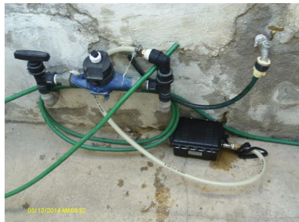
Foto 78 - Equipamento de medição de pressão datalogger instalado no endereço: Travessa São Paulo, 16.
