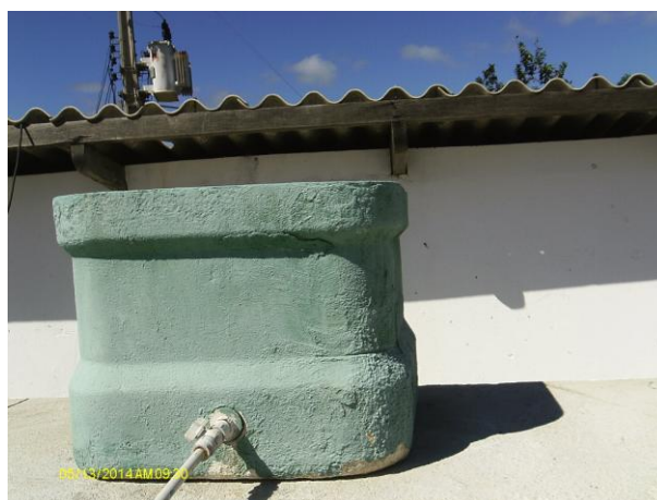
Foto 62 - RAP-01: tanque para aplicação de cloro.
