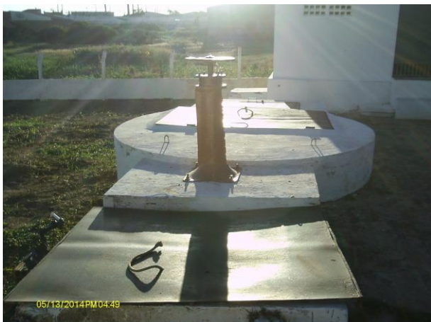
Foto 110 - EEE-02: poço de sucção coberto.
