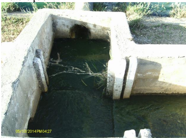
Foto 144 - ETE: caixa de isolamento da lagoa de maturação I sem divisórias.
