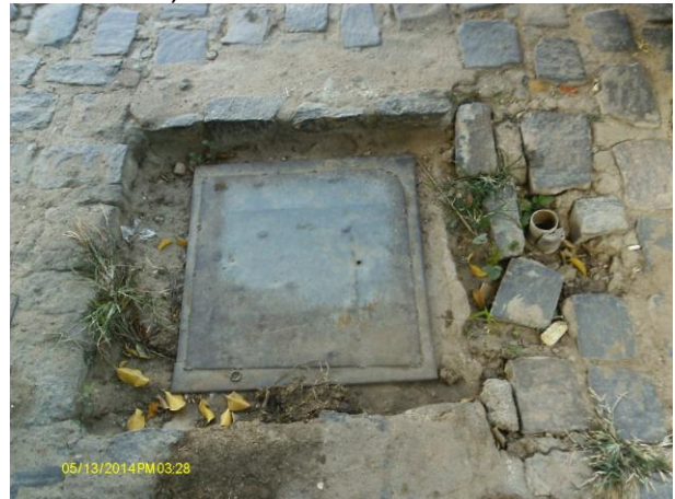
Foto 90 - Registro de descarga na rede de distribuição: Travessa José de Alencar.
