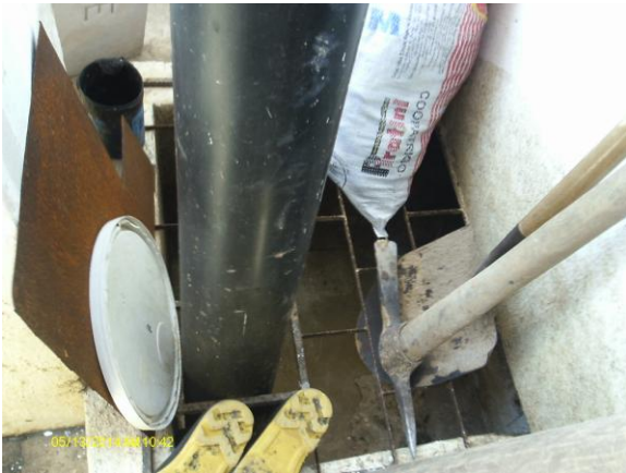
Foto 75 - REL-02: tubo extravasor e materiais armazenados sob a caixa de descarga de fundo.
