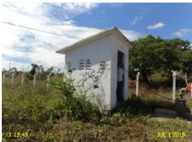
Foto 8 – PT-08: pintura deteriorada.
