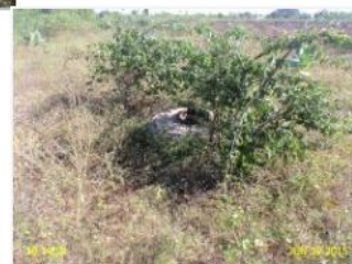
Foto 23 – ETE: poços de visita sem tampas.
