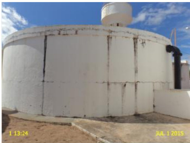
Foto 26 – RAP-03: rachaduras e sinais de infiltração.
