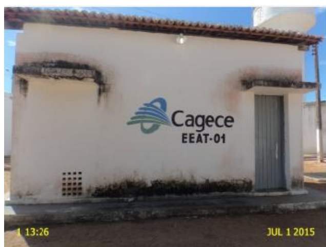
Foto 16 – EEAT-01: pintura deteriorada.
