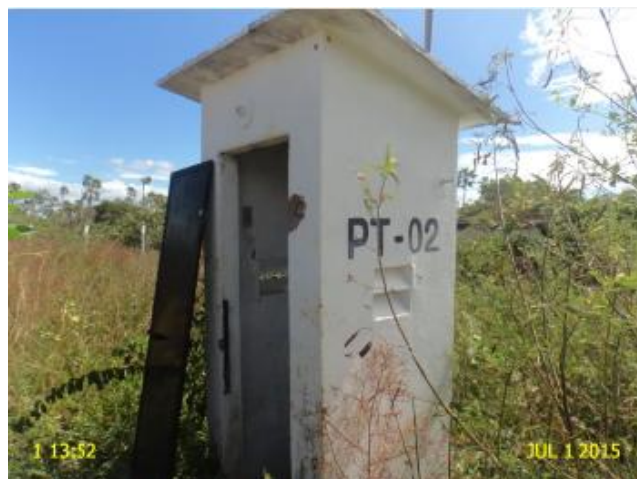
Foto 9 – PT-02: vespas no interior da casa de abrigo do QC, porta e estrutura deterioradas.
