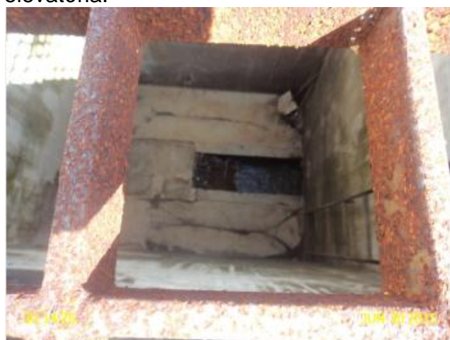
Foto 17 – EEE-02: estrutura do gradeamento deteriorada.
