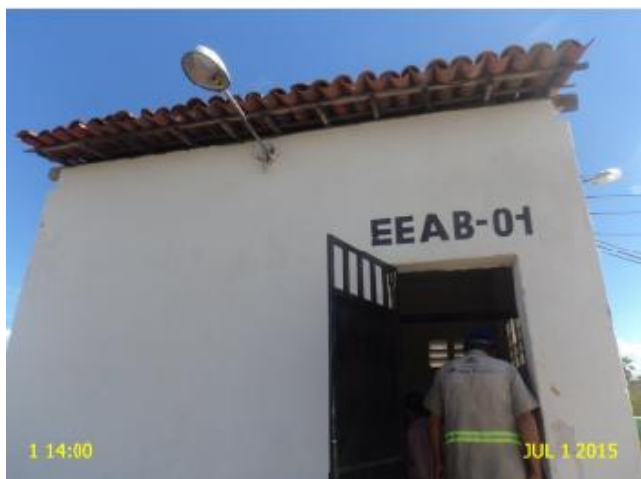
Foto 14 – EEAB-01: ausência de iluminação.
