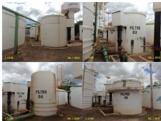
Foto 13 – Filtros F-01, F-03, F-04 e F-05: pintura deteriorada.
