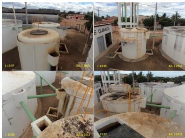
Foto 7 - Filtros F-01, F-02, F-03, F-04 e F-05: ausência de tampas nas calhas de água.
