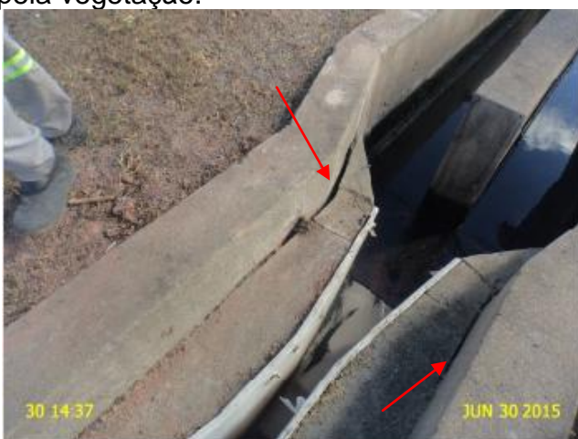
Foto 22 – ETE: estrutura da calha Parshall deteriorada.
