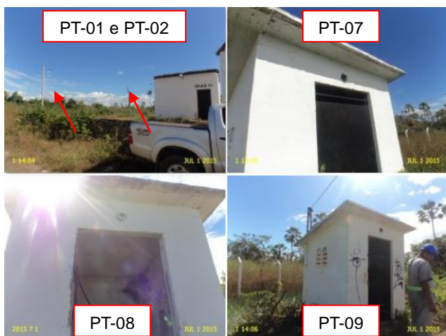
Foto 3 – PT-01, PT-02 , PT-07, PT-08 e PT-09: ausência de iluminação.
