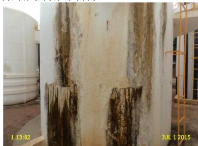
Foto 12 – Filtro F-03: sinais de infiltração.
