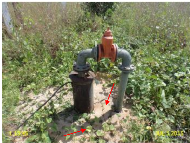
Foto 1 – PT-07: rachadura na estrutura da laje de proteção.
