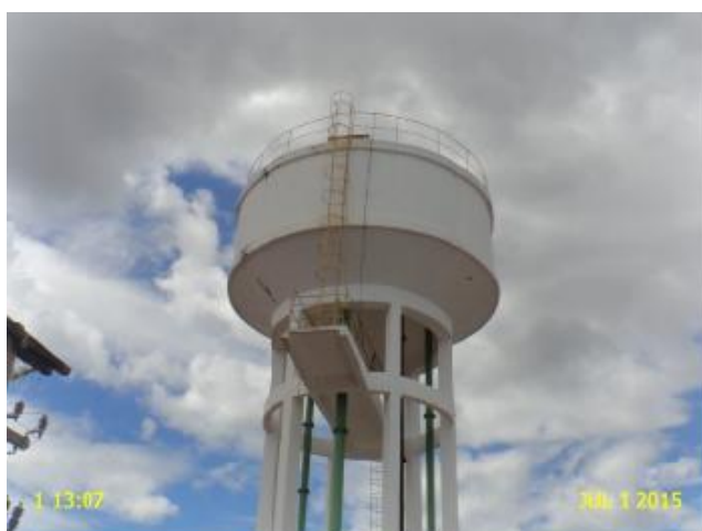
Foto 5 – REL-01: ausência de para raios e de sinalização noturna.
