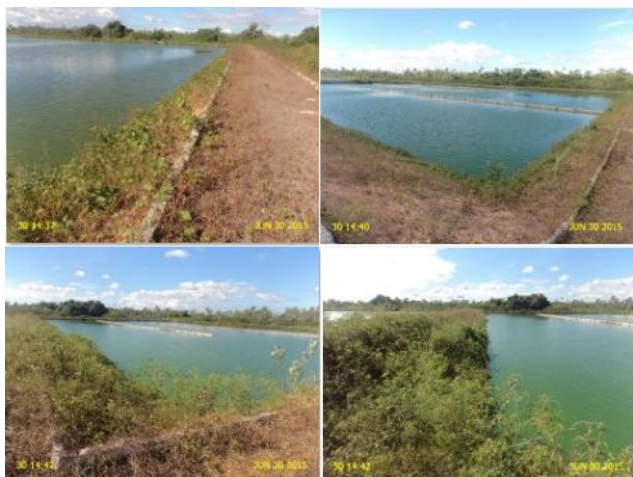
Foto 20 – LF, LM1 e LM2: taludes tomados pela vegetação.
