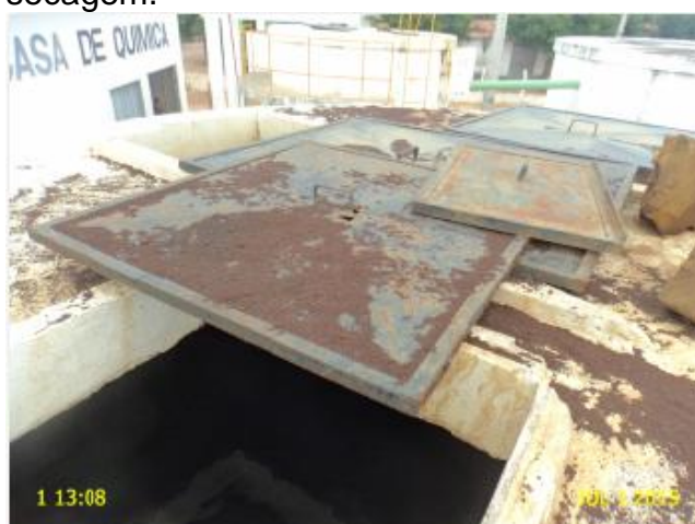
Foto 6 – Filtro F-02: tampas inadequadas.
