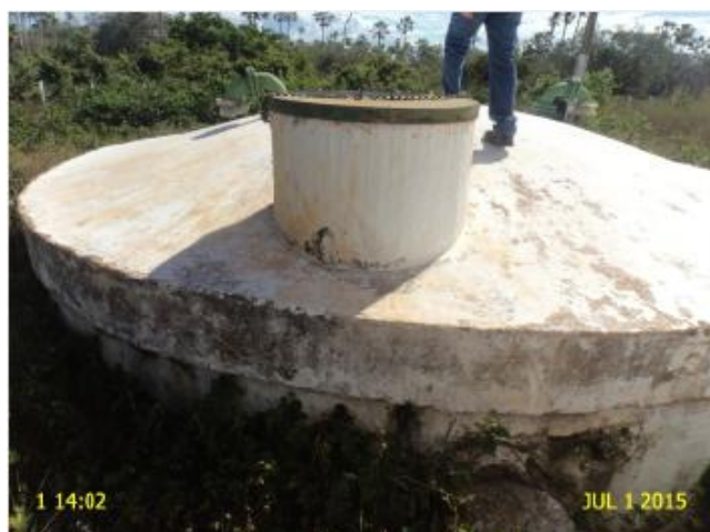
Foto 25 – RAP-01: ausência de identificação e pintura deteriorada.
