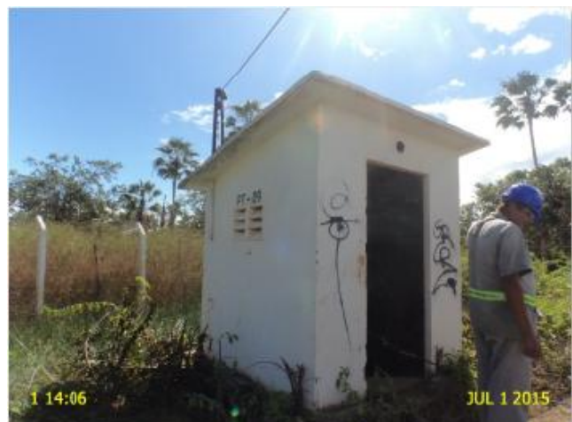
Foto 10 – PT-09: ausência de porta, pintura e estrutura deterioradas.
