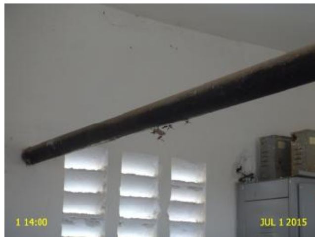
Foto 15 – EEAB-01: vespas no interior da elevatória.
