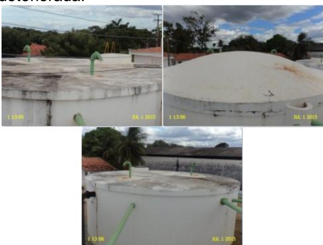
Foto 24 – RAP-02, RAP-03 e RAP-04: tubulações de ventilação sem tela de proteção.
