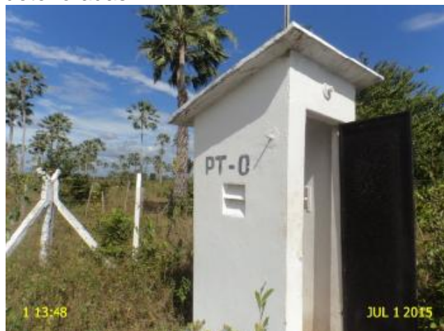
Foto 11 – PT-01: identificação incompleta.
