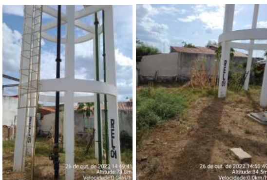
Foto 15 - REL-01: excesso de vegetação.
