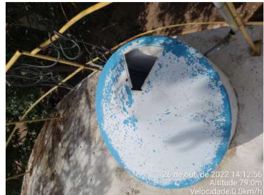
Foto 8 - ETA: RAP-01 com tampa sem vedação.
