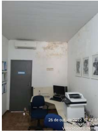
Foto 1 - Escritório: paredes com sinais de infiltração e pintura deteriorada.
