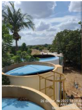
Foto 7 - ETA: filtros F-01, F-02 e F-03 estão com as tampas abertas e F-04 não possui tampa.
