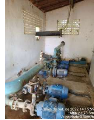
Foto 12 - ETA: casa das bombas EELF-01 e EEAT-01 com alvenaria danificada.
