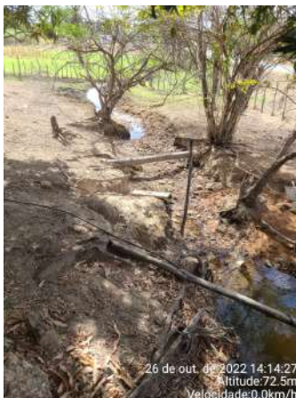
Foto 28 - ETA: água de lavagem dos filtros lançada in natura .
