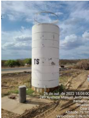
Foto 17 - Tanque de sucção: ausência de cerca de delimitação na área.
