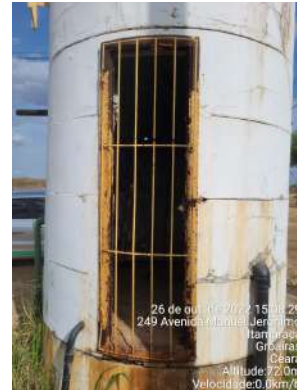
Foto 18 - Tanque de sucção: pintura deteriorada e portão oxidado.
