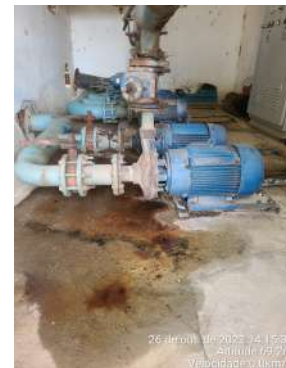
Foto 10 - ETA: EEAT-01 apresenta vazamento na bomba.
