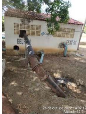
Foto 11 - ETA: EELF-01 com a tubulação não conectada, contudo sem estabilidade.
