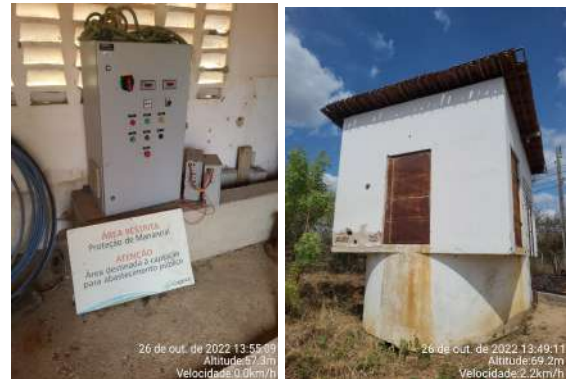
Foto 4 - Captação: pintura e reboco deteriorados na casa do quadro de comando e placa da área da captação.
