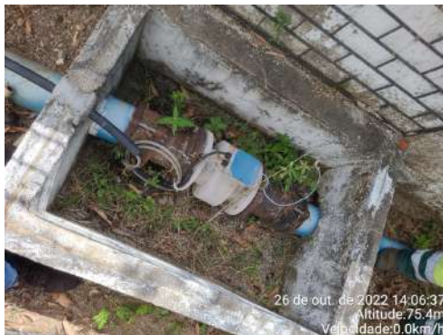
Foto 9 - ETA: Caixa de passagem ao lado do RAP-01 sem tampa.
