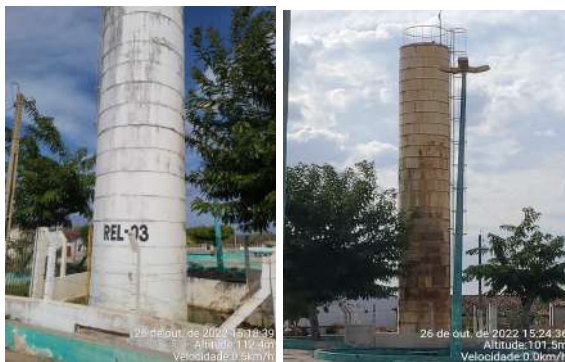
Foto 21 - REL-03: pintura deteriorada.
