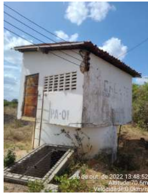
Foto 3 - Captação: acesso difícil ao quadro de comando, pintura e reboco deteriorados.
