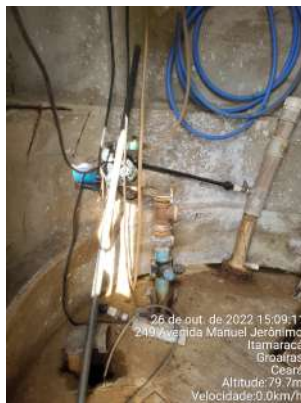
Foto 19 - Tanque de sucção: ausência de bomba reserva.
