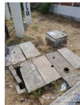
Foto 16 - REL-01: a tampa do registro da saída para a RDA está deteriorada.
