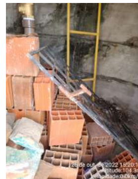
Foto 22 - REL-03: armazenamento de materiais de construção.
