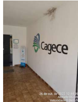
Foto 2 - Escritório: paredes com sinais de infiltração e pintura deteriorada.
