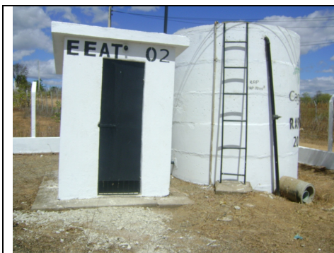
Foto 21 – EEAT-02: ausência de iluminação interna e externa.
