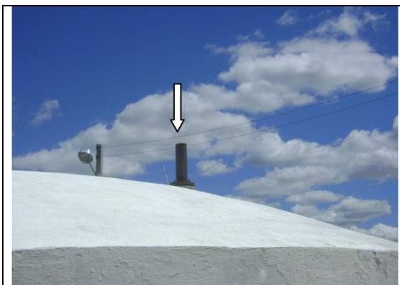
Foto 26 – RAP-01: tubulação de ventilação inadequada e sem tela de proteção.
