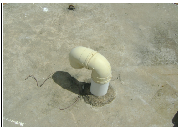
Foto 28 – RAP-02: tubulação de ventilação sem tela de proteção.
