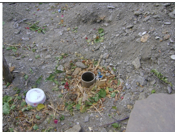
Foto 45 – Registro de descarga localizado na BR-020, Km 324.
