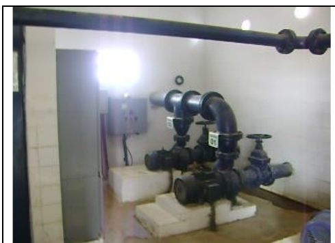
Foto 20 – EELF-01: ausência de identificação.
