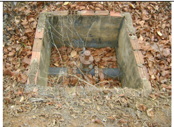
Foto 38 – Caixa de registro de gaveta de descarga danificada e sem tampa.
