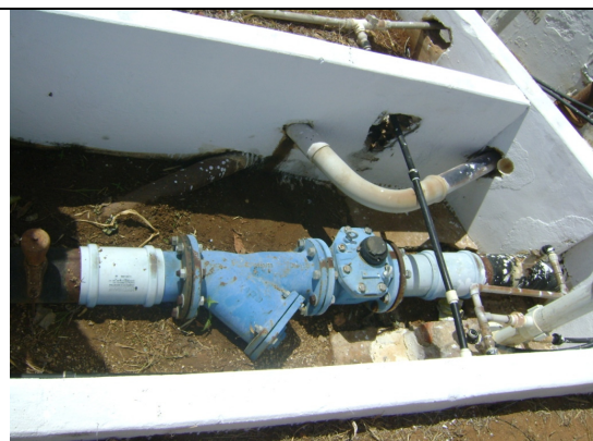
Foto 32 – Macromedidor na chegada do RAP-01.
