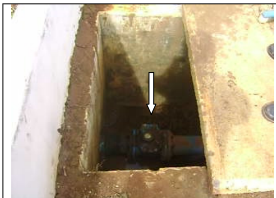
Foto 31 – Macromedidor na saída da ETA.
