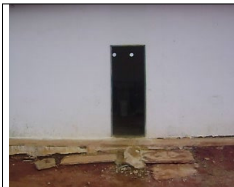
Foto 18 – EEAT-01: ausência de identificação.
