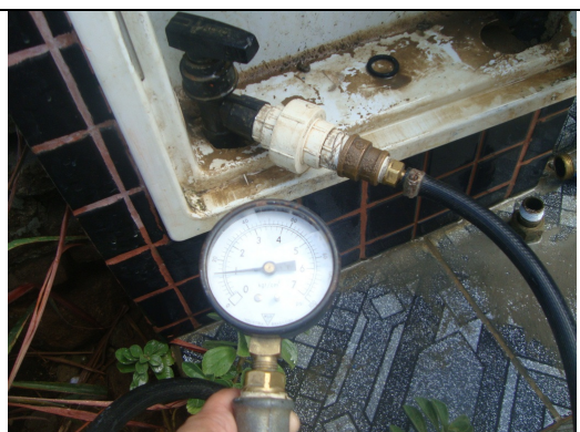
Foto 50 – RDA: medição de pressão no endereço Rua Alto da Bela Vista, 25 – Destacamento da PM.
