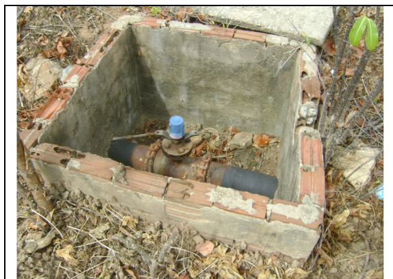
Foto 39 – Caixa de registro de gaveta de descarga danificada e sem tampa.
