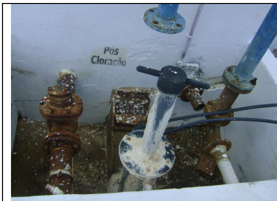
Foto 33 – Caixa de registro e tubulações sem grade de proteção.
