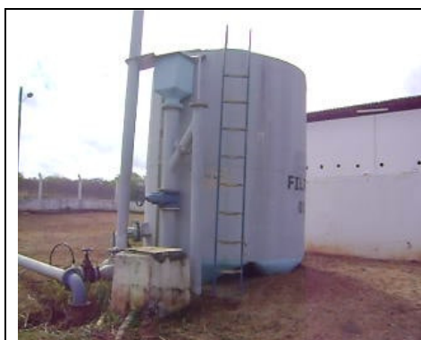
Foto 4 – Vista geral do filtro da ETA de Caridade.
