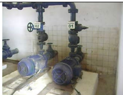
Foto 19 – EEAT-01: ausência de identificação.
