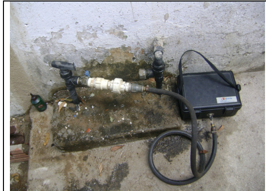
Foto 52 – RDA: medição de pressão contínua no endereço da Rua Plácido Pinho, 521 (FNS) – Centro.
