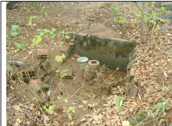
Foto 37 – Caixa da ventosa danificada e sem tampa.
