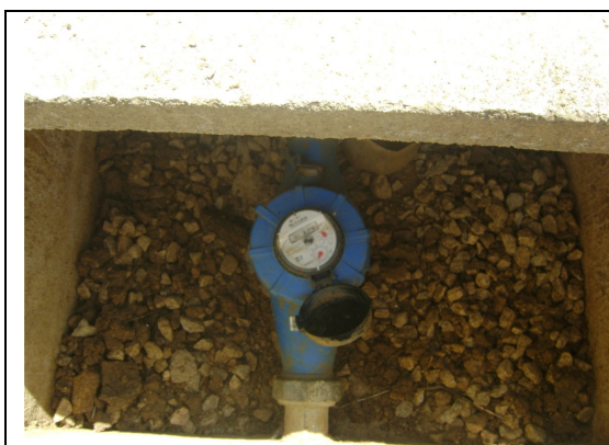
Foto 35 – Macromedidor na chegada do RAP-02.
