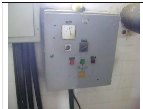
Foto 17 – EECS-01: ausência de horímetro.
