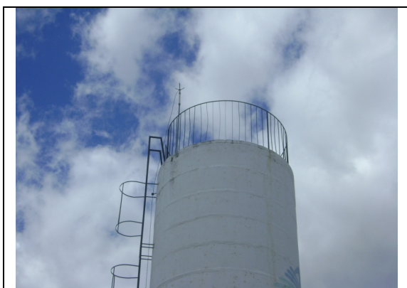
Foto 29 – REL-01: ausência de sinalização noturna.
