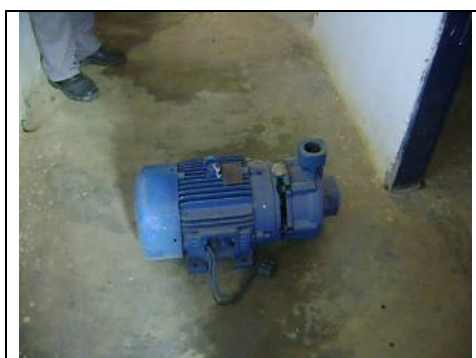
Foto 23 – EEAT-02: conjunto motor-bomba reserva.
