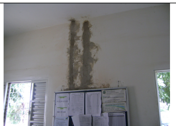
Foto 56 – Pintura interna deteriorada.
