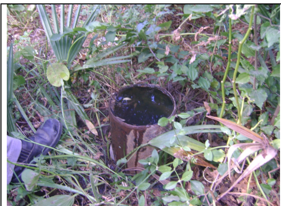
Foto 44 – Registro de descarga localizado na Rua Cel. Francisco Linhares, 775 - Centro.
