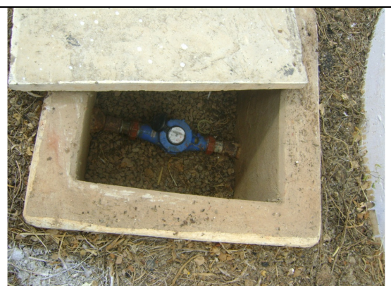
Foto 36 – Macromedidor na saída do REL-01.
