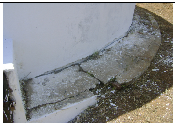
Foto 27 – RAP-01: calçada do contorno do reservatório, danificada.
