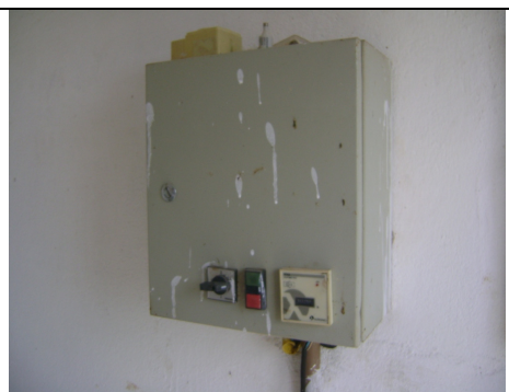
Foto 22 – EEAT-02: ausência de voltímetro e amperímetro.
