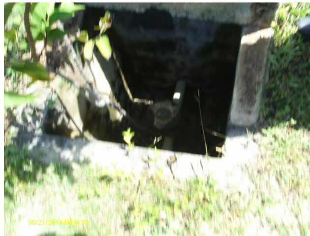
Foto 37 – Caixa de ventosa na rede de água tratada sem tampa na localidade Barra do Mel.
