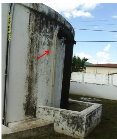
Foto 69 – RAP-02: medidor de nível e tubo extravasor.
