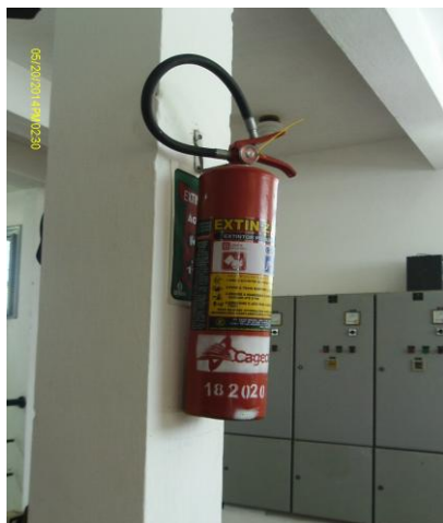
Foto 24 – Extintor de incêndio da ETA com data de validade até mar/2015.
