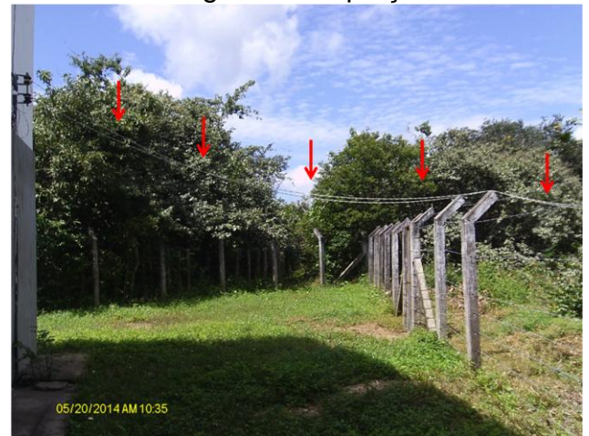
Foto 4 – Fiação baixa na captação.
