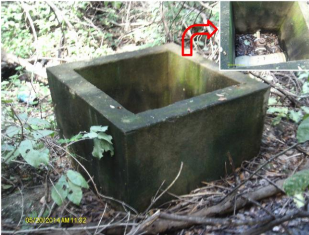
Foto 30 – Caixa de registro da adutora de água bruta na área do RAP-01 está sem tampa ou grade de proteção.
