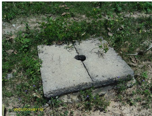
Foto 39 – Caixa de ventosa na rede de água tratada na localidade Barra do Mel.
