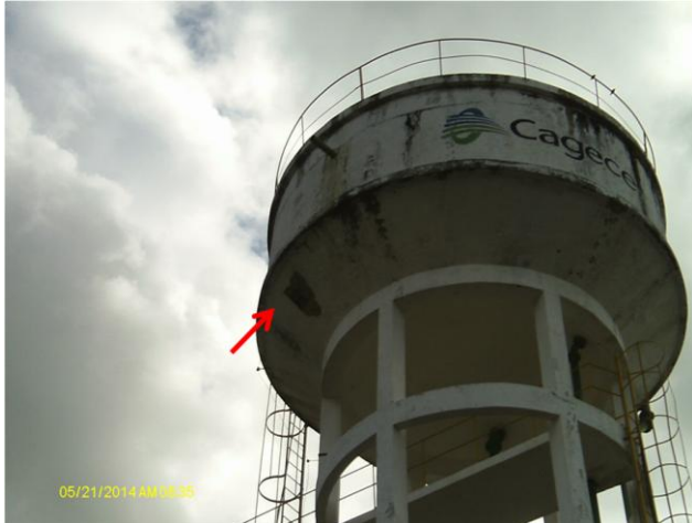
Foto 71 – REL-01: estrutura danificada.
