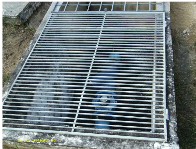
Foto 49 – Macromedidor de água tratada na área da ETA para o REL-01 com grade de proteção.
