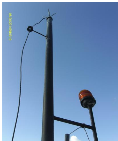
Foto 84 – REL-02: pára-raios e sinalização noturna sem fucionar.
