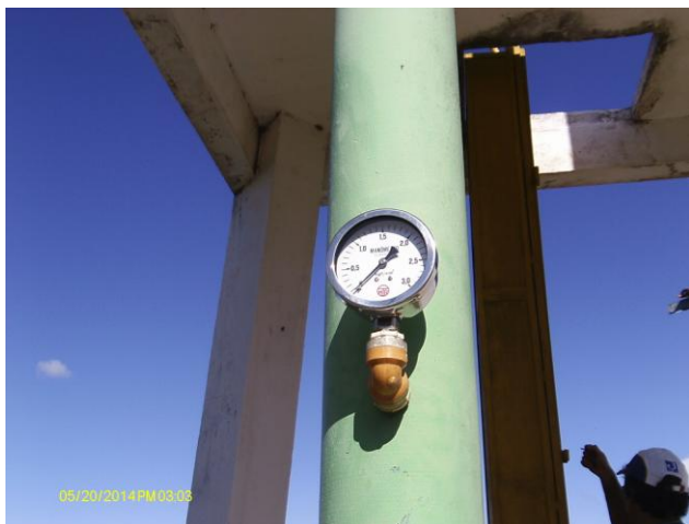
Foto 83 – REL-02: medidor de nível.
