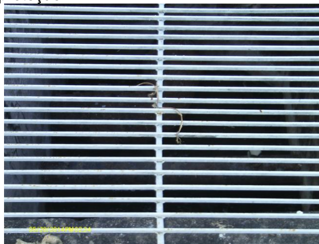
Foto 53 – Caixa de estação pitométrica na adutora de água tratada na saída da ETA.
