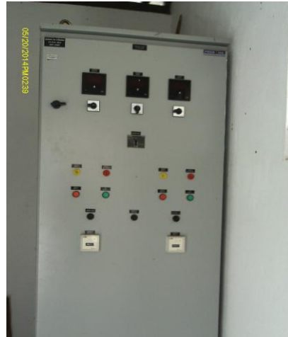
Foto 60 – Quadro de comando da EEAT-02.
