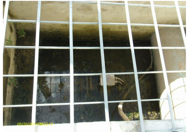
Foto 33 – Macromedidor de água bruta na entrada da ETA.
