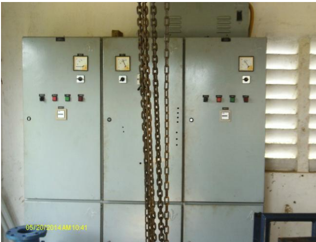
Foto 9 – EEAB-01: quadro de comando.
