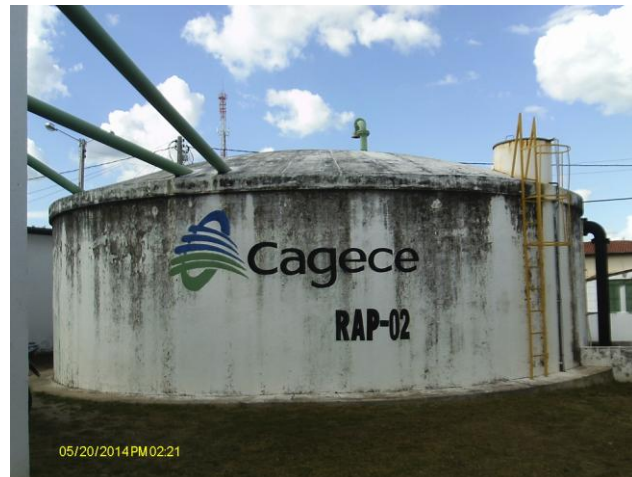
Foto 66 – RAP-02: identificação e escada de acesso.
