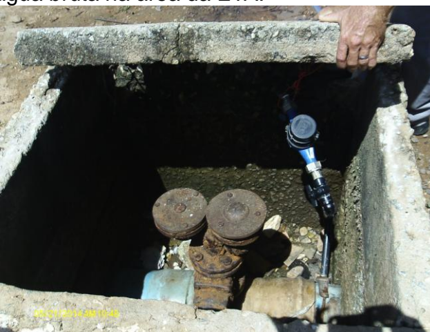
Foto 34 – Caixa de ventosa na adutora de água bruta na localidade Barreiros, com caixa e tampa danificadas.
