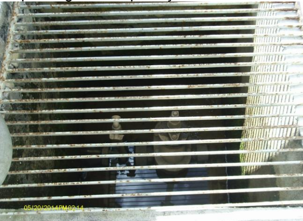
Foto 32 – Caixa de registro na adutora de água bruta na área da ETA.
