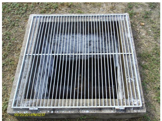
Foto 47 – Caixa de estação pitométrica na adutora de água tratada na área da ETA, com grade de proteção.
