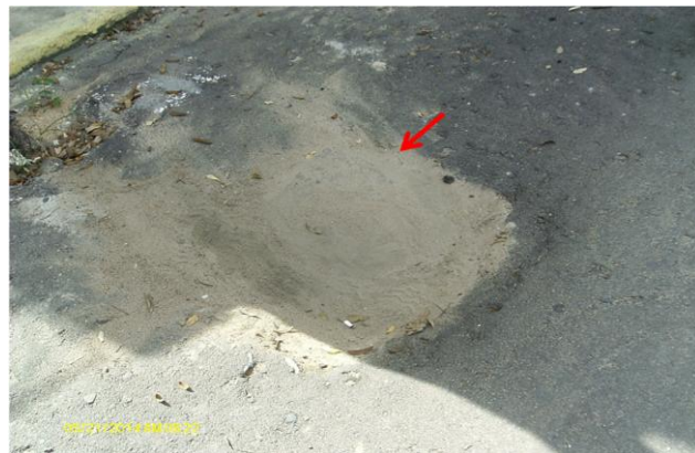
Foto 89 – Registro de descarga na Rua Antônio de Carvalho Rocha.
