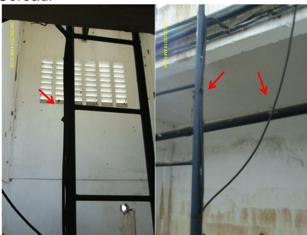
Foto 5 – PA-01: escada de acesso a EEAB-01 sem guarda corpo e com fiação exposta.
