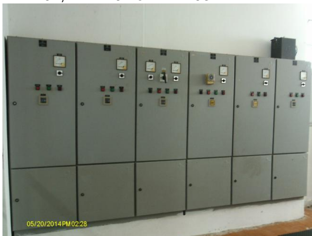
Foto 57 – Quadro de comando das EELF-01, EEAT-01 e EEAT-03.
