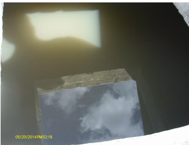
Foto 14 – Filtro-01: leito filtrante.
