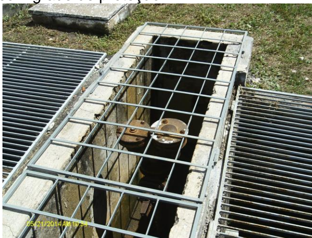
Foto 52 – Caixa de ventosa na adutora de água tratada na área da ETA.
