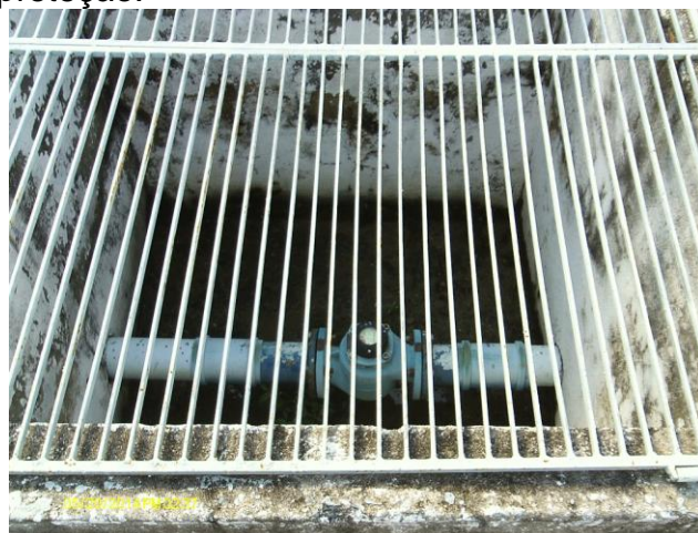
Foto 51 – Macromedidor de água tratada na área da ETA para o REL-02 com grade de proteção.
