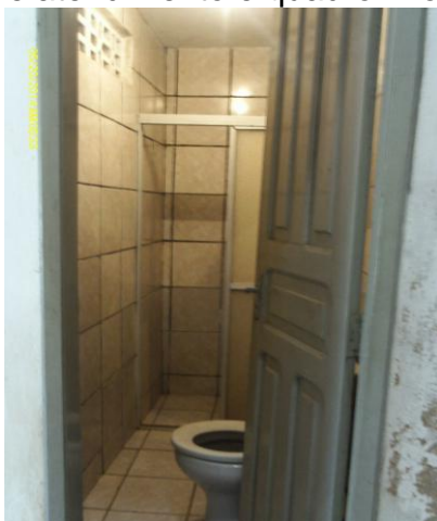
Foto 97 – Instalações sanitárias disponíveis para funcionários e usuários.
