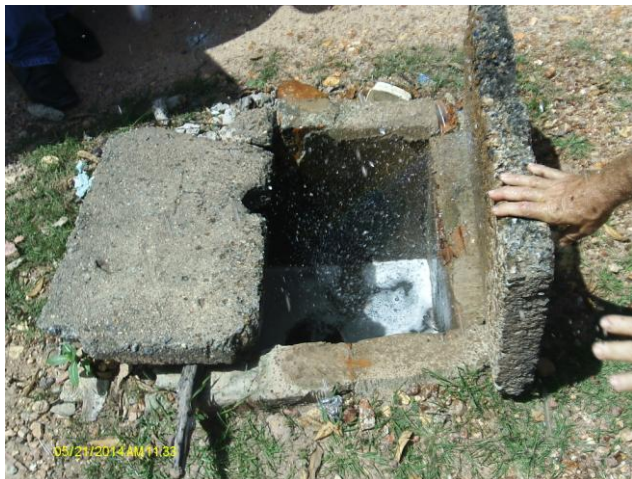
Foto 36 – Caixa de ventosa na rede de água tratada com vazamento na localidade Barra do Mel.
