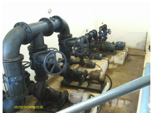
Foto 56 – Elevatórias EELF-01, EEAT-01 e EEAT-03.
