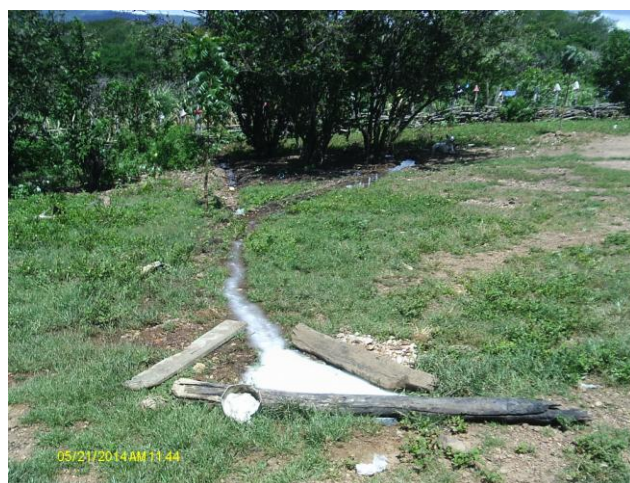
Foto 41 – Vazamento na rede de água tratada na localidade Barra do Mel.
