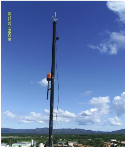
Foto 77 – REL-01: pára-raios e sinalização noturna.
