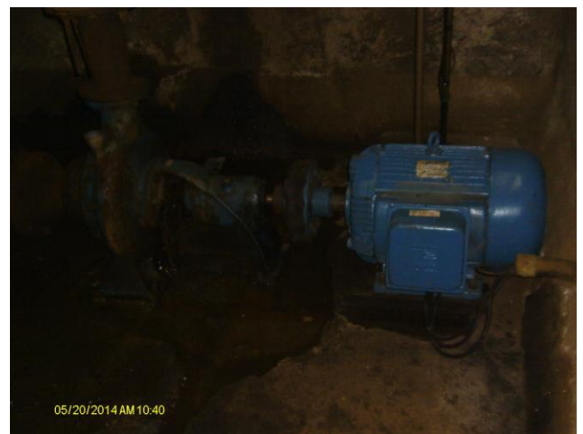
Foto 6 – PA-01: Moto bomba da elevatória EEAB-01.
