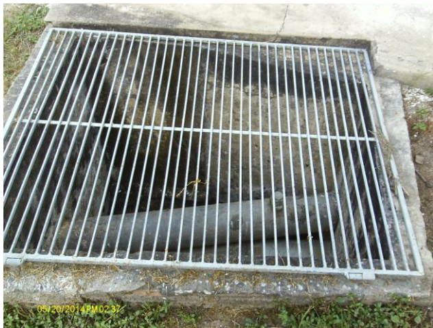
Foto 48 – Caixa de estação pitométrica na adutora de água tratada na área da ETA, com grade de proteção.
