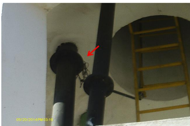
Foto 85 – REL-02: fios da sinalização noturna desconectada.
