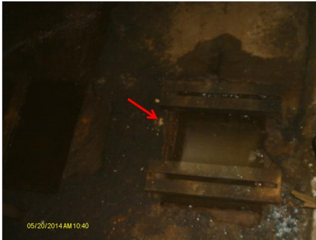
Foto 7 – PA-01: Ausência de bomba reserva na elevatória EEAB-01.
