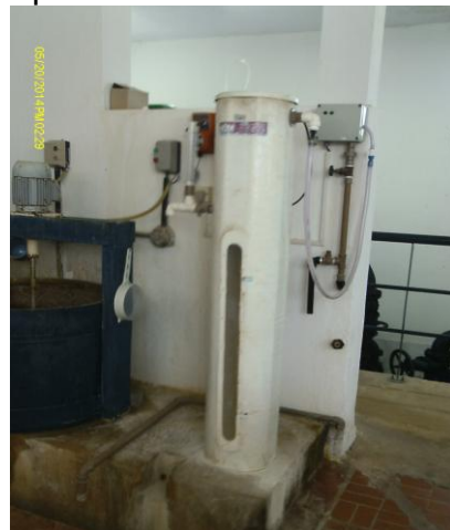
Foto 21 – Casa de química: dosador de flúor parado.
