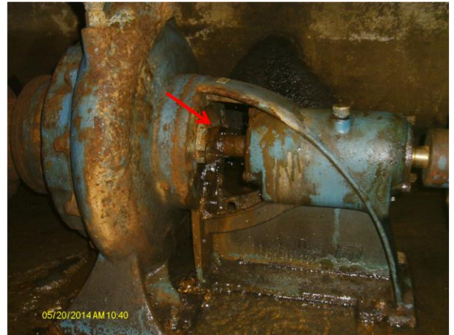
Foto 8 – PA-01: elevatória EEAB-01 com vazamento.
