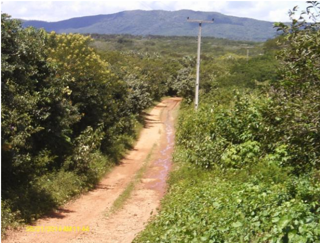
Foto 42 – Vazamento na rede de água tratada na localidade Barra do Mel.
