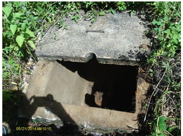
Foto 45 – Caixa de ventosa na adutora de água tratada.
