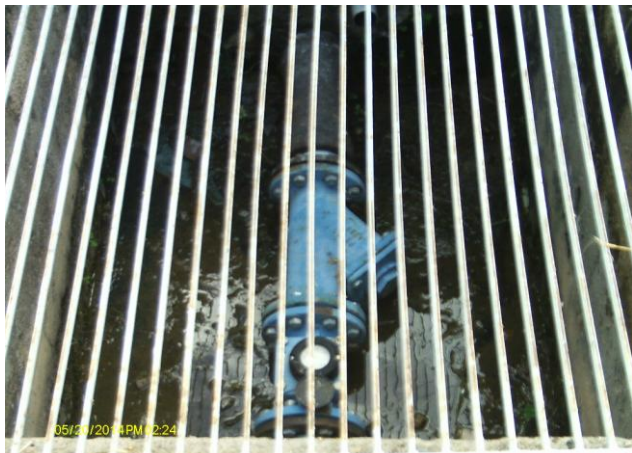
Foto 54 – Macromedidor de água tratada na saída da ETA para o município de Senador Sá.
