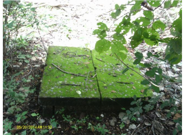
Foto 31 – Caixa de ventosa na adutora de água bruta na área do RAP-01.
