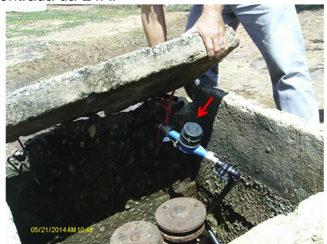
Foto 35 – Caixa de ventosa na adutora de água bruta na localidade Barreiros, com caixa e tampa danificadas.
