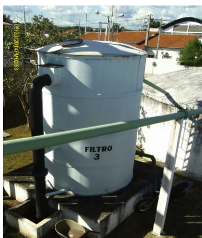
Foto 16 – Vista do Filtro 03 com tampas adequadas.
