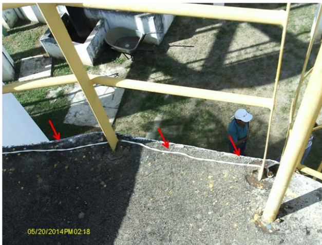
Foto 12 – Fiação exposta no acesso aos Filtros 01 e 02.
