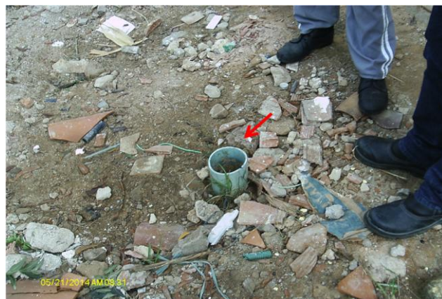
Foto 91 – Registro de descarga na Av. Brasília Alecrim.
