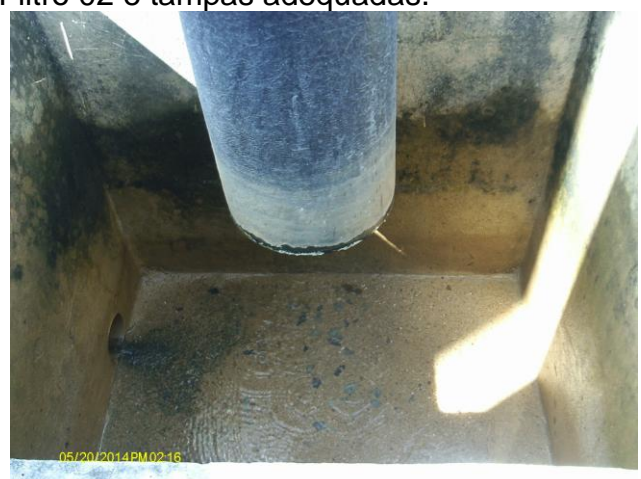
Foto 17 – Filtro 03: descarga e drenagem.
