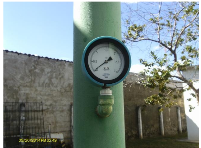
Foto 76 – REL-01: medidor de nível.
