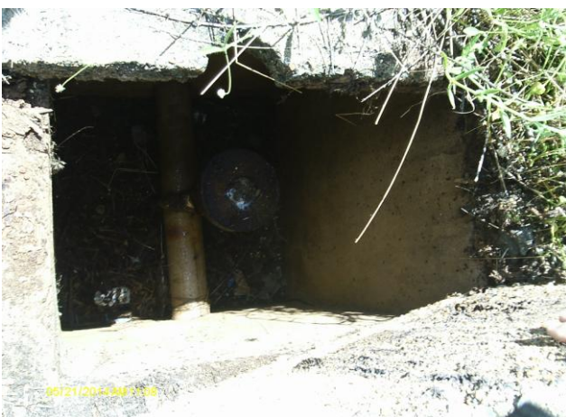
Foto 46 – Caixa de ventosa da rede na localidade Torrões.
