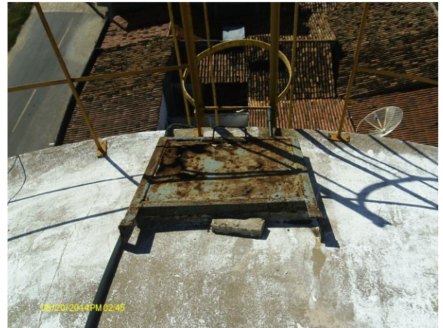
Foto 74 – REL-01: tampa de inspeção em oxidação.
