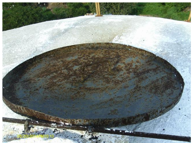
Foto 82 – REL-02: tampa de inspeção em oxidação.
