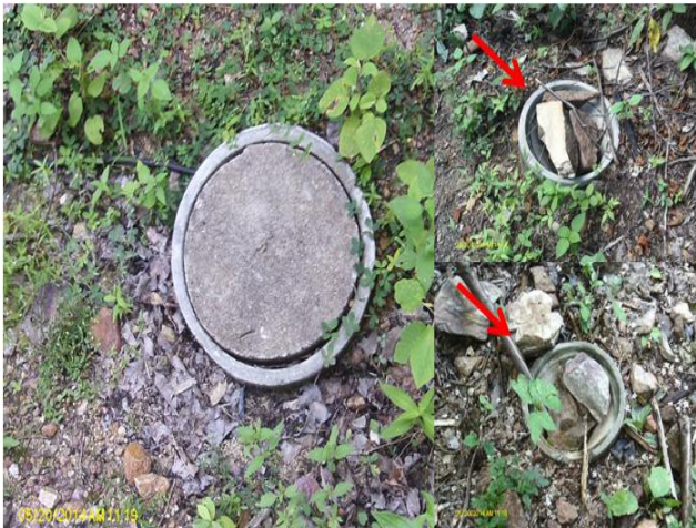
Foto 65 – RAP-01: instalações de enterramento elétrico com tampas das caixas danificadas.
