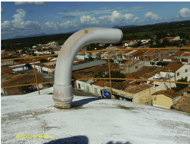
Foto 75 – REL-01: tubulações de ventilação com tela de proteção.
