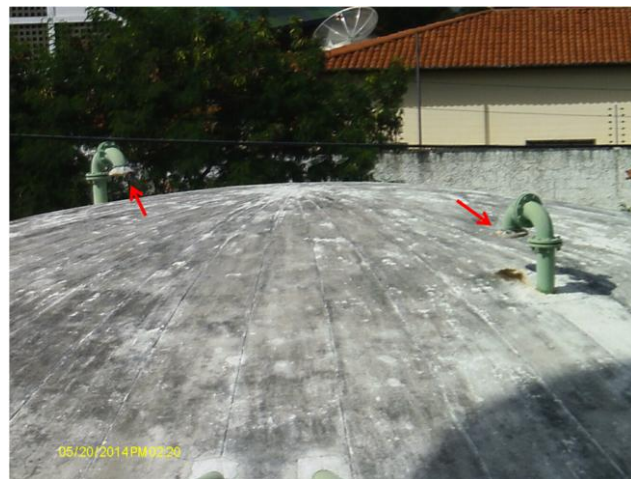
Foto 68 – RAP-02: tubulações de ventilação com tela de proteção.
