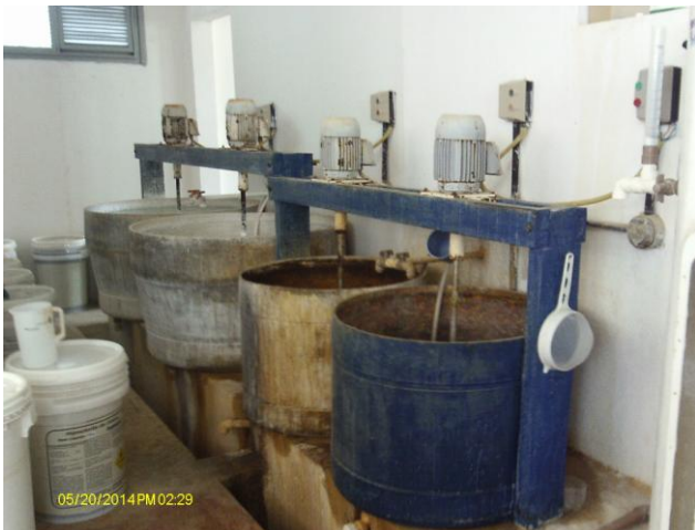
Foto 20 – Casa de química: dosadores de PAC e polímero.
