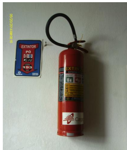
Foto 98 – Extintor de incêndio da loja de atendimento com validade até out/2014.
