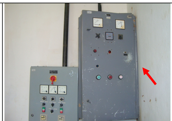
Foto 44 – Quadro de comando da EELF-01 com pintura deteriorada.
