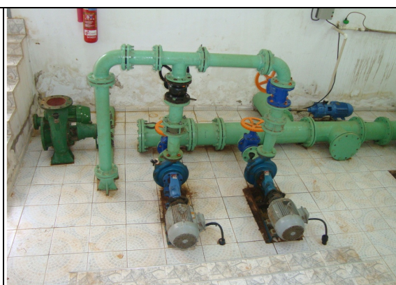
Foto 36 – Estação elevatória EEAT-01.
