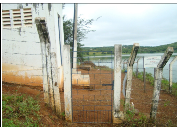
Foto 5 – Cerca de proteção do SAA de Quiterianópolis danificada.
