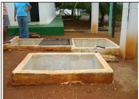
Foto 63 – REL-01: caixas de proteção sem tampa ou grade.
