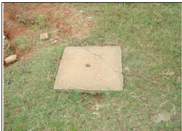
Foto 68 – Registro de descarga localizado na Rua Alexandre Melo em frente ao nº 5.
