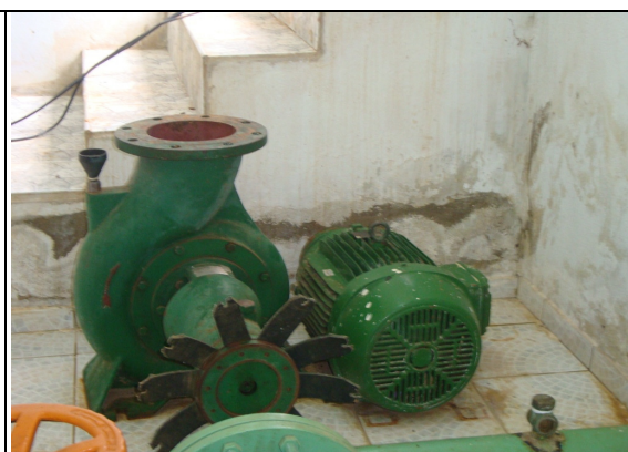
Foto 38 – Motor-bomba reserva da estação elevatória EELF-01.
