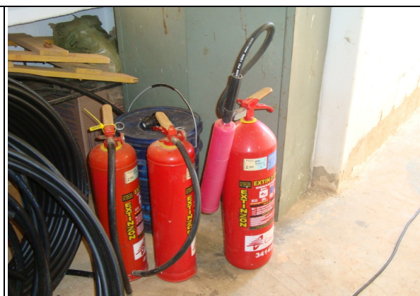
Foto 82 – Extintores de incêndio (localizados no almoxarifado do SAA de Quiterianópolis).
