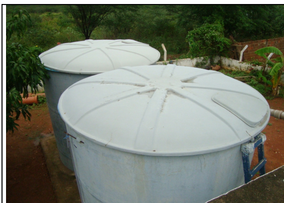
Foto 53 – RAP-02 e RAP-03: sem tubulação de ventilação.
