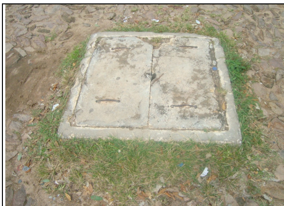
Foto 74 – Registro de manobra localizado na Avenida Laurindo Gomes esquina com a Rua Onorina Moreira Lima.
