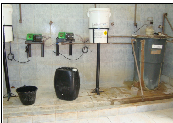
Foto 22 – Tanques de dosagens e bombas dosadoras.
