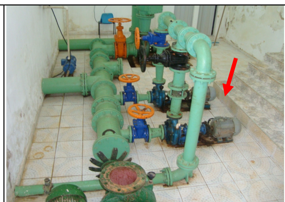
Foto 42 – EEAT-01: sem identificação.
