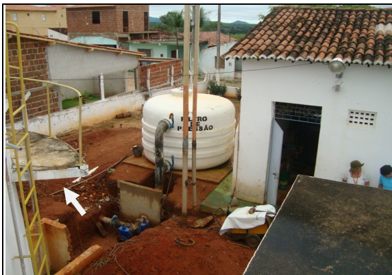
Foto 12 – Filtro: laje do patamar apresentando trincas.
