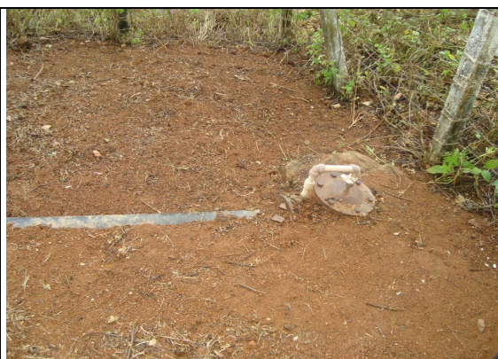
Foto 34 – Ventosa na AAB sem caixa de proteção.
