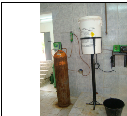
Foto 26 – Estação de cloro gasoso.
