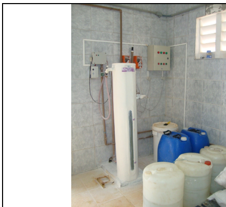
Foto 20 – Sistema de fluoretação instalado em fevereiro de 2010.
