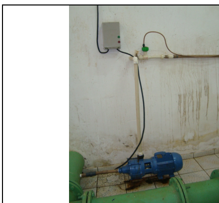
Foto 41 – Bomba dosadora de cloro.
