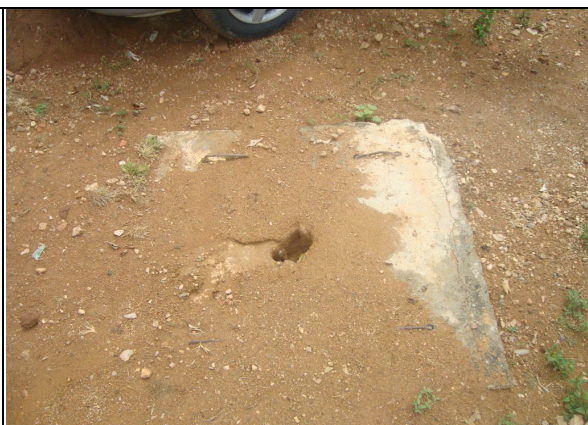
Foto 69 – Registro de descarga localizado na Rua SDO 12, em frente ao nº 189.
