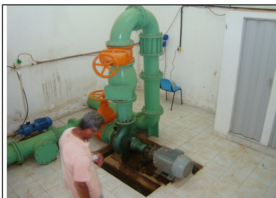
Foto 37 – Estação elevatória EELF-01.
