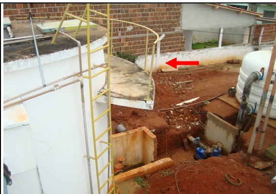
Foto 13 – Filtro: guarda corpo com fixação precária.
