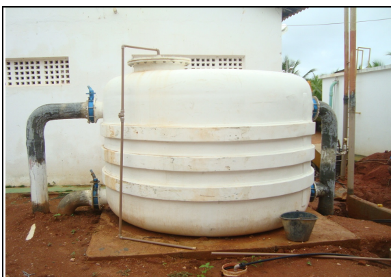
Foto 14 – Filtro de pressão instalado em março de 2011.
