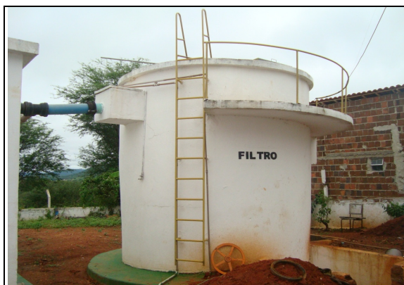
Foto 8 – ETA do SAA de Quiterianópolis: filtro de fluxo ascendente.
