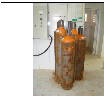
Foto 18 – Cilindros de cloro armazenados na casa de química.
