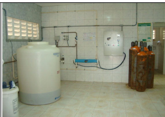
Foto 9 – ETA do SAA de Quiterianópolis: casa de química.
