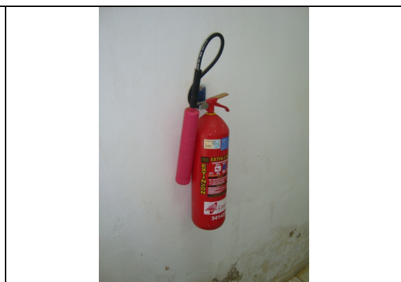
Foto 40 – Extintor de incêndio das estações elevatórias EEAT-01 e EELF-01.
