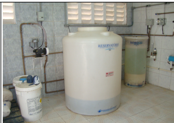
Foto 21 – Equipamentos da fábrica de cloro.
