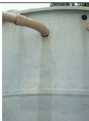
Foto 54 – RAP-02: interligação com o RAP-01 com vazamento.
