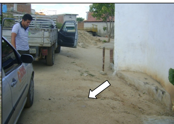
Foto 75 – Registro de descarga sem caixa de proteção, localizado no bairro Paes de Andrade.
