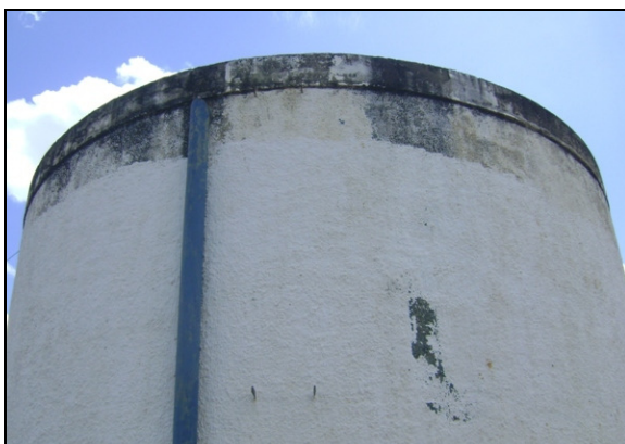
Foto 56 – Pintura deteriorada do RAP-02.
