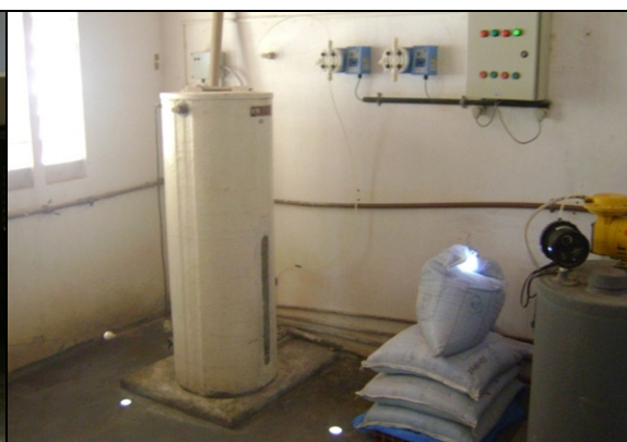
Foto 14 – Dosador de flúor.
