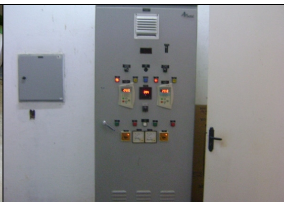
Foto 39 – Quadro de comando da EEAT-01.
