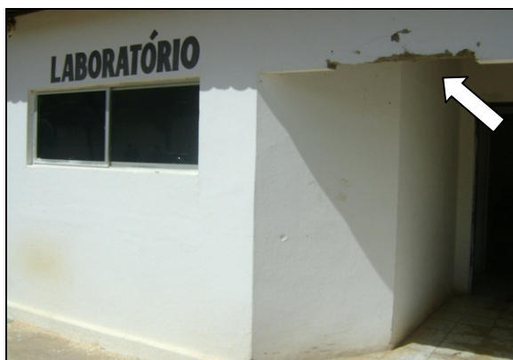
Foto 13 – Vista da casa de química e reboco deteriorado.
