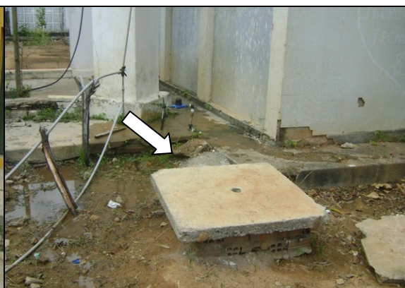
Foto 71 – Registro de descarga localizada na Vila Betânia, Colégio Agrícola.
