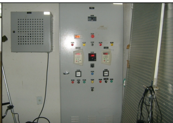
Foto 41 – Quadro de comando da EEAT-02.
