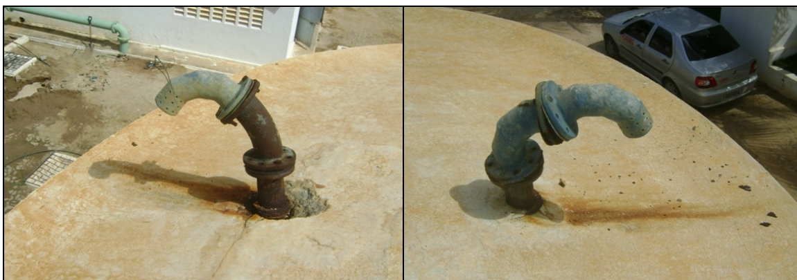
Fotos 49 e 50 – Ventilações do RAP-01 sem tela de proteção.
