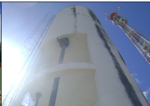
Foto 59 – Pintura deteriorada e escada de acesso do REL-01.
