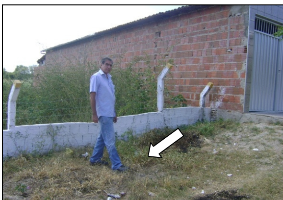
Foto 74 – Registro de descarga soterrado, localizado na Rua Francisco José Oliveira Brasil, Divino Salvador.
