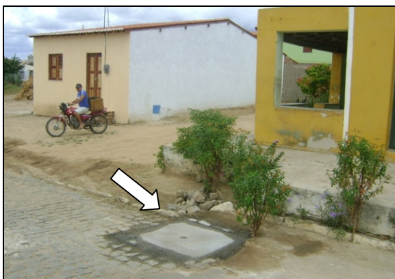
Foto 70 – Registro de descarga localizada na Rua João Alencar, São José.
