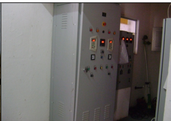
Foto 35 – Quadro de comando da EELF-01.
