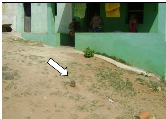
Foto 76 – Registro de descarga sem caixa de proteção, localizado na Rua Monte Carmelo, Recreio.
