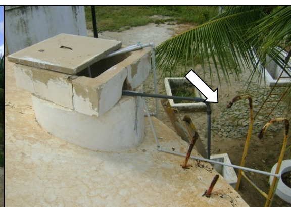
Foto 48 – escada de acesso oxidada e inspeção do RAP-01.
