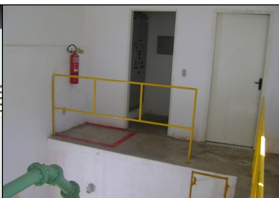
Foto 45 – Extintor de incêndio do booster .
