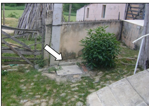
Foto 72 – Registro de descarga localizado no bairro Cemitério.
