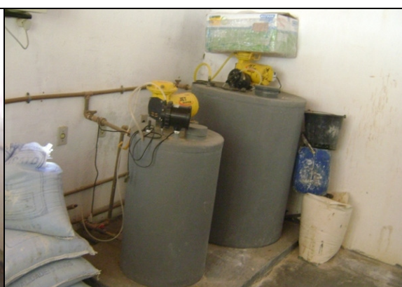
Fotos 16 – Dosador para tratamento da água de reúso.
