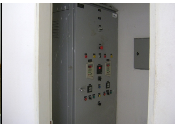
Foto 43 – Quadro de comando do Booster .
