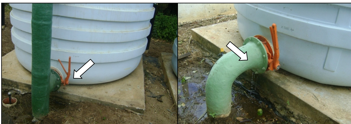
Fotos 5 e 6 – Válvulas dos filtros de pressão 01 e 02, com problema de vedação.
