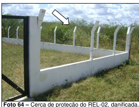
Foto 64 – Cerca de proteção do REL-02, danificada.
