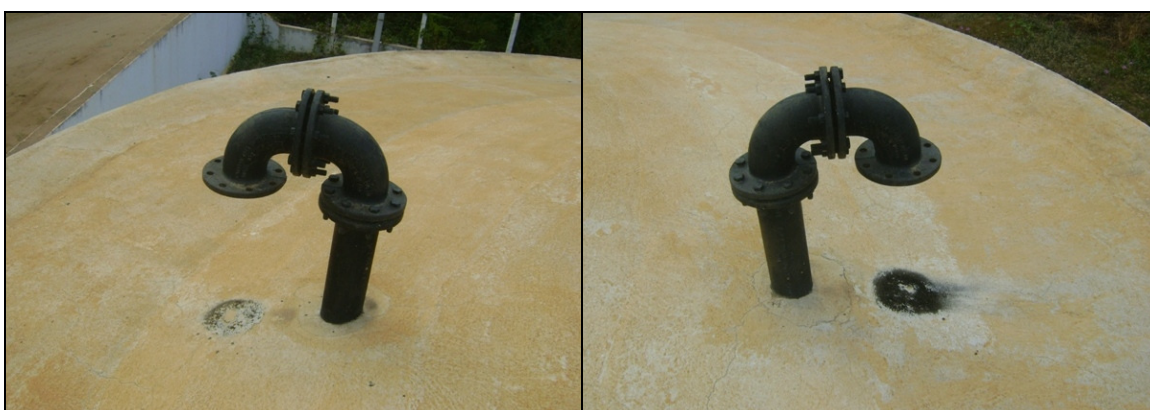
Fotos 53 e 54 – Ventilações sem tela de proteção do RAP-03.
