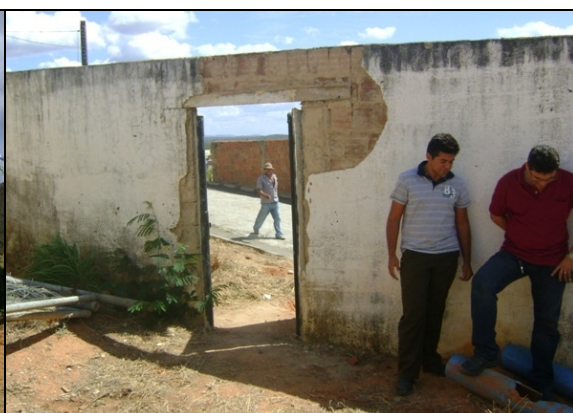
Foto 61 – Muro de proteção do REL-01, com reboco deteriorado.
