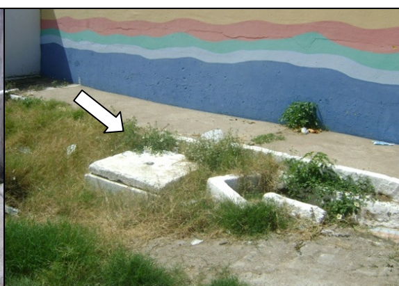
Foto 73 – Registro de descarga localizado na Rua Pe. Pereira, bairro Cemitério.
