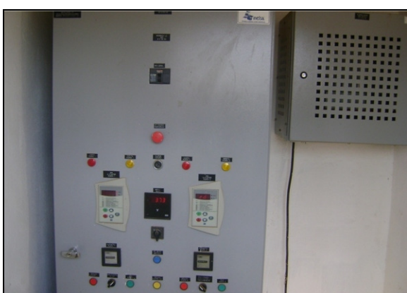
Foto 32 – Quadro de comando da EECS-01.
