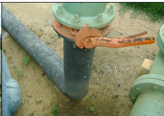
Foto 12 – Problema de vedação na válvula do filtro 04.
