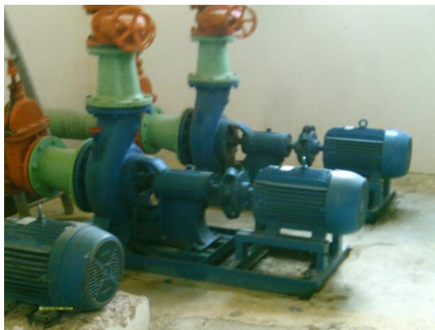
Foto 44 - EELF-01: conjunto moto-bomba.
