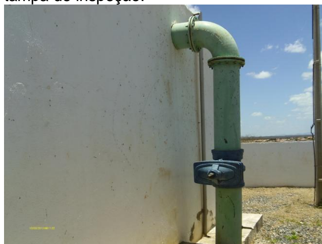
Foto 66 - RAP-03 entrada de água.
