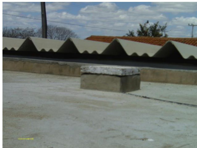
Foto 56 – RAP-01: Tampa de inspeção.
