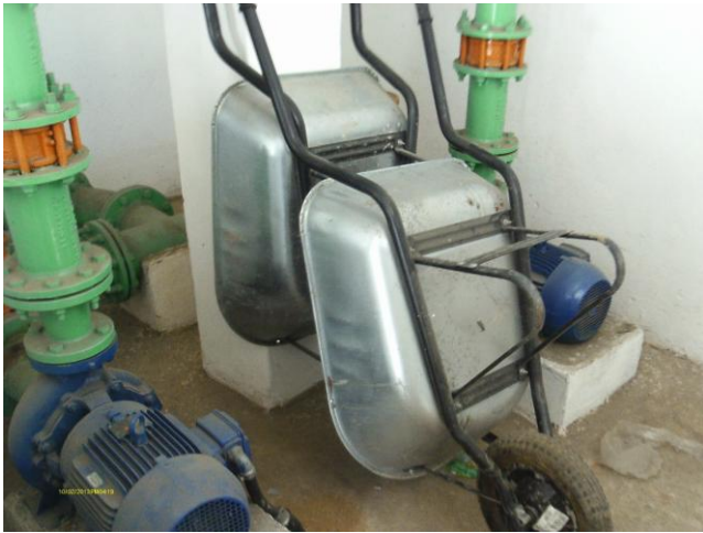
Foto 51 - EEAT-03: conjunto moto-bomba (Desativada).
