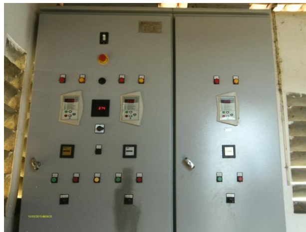
Foto 6 - Quadro de comando da EECS-01.
