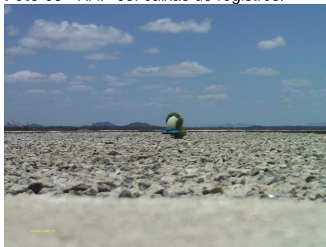
Foto 70 - RAP-03: tubulação de ventilação.
