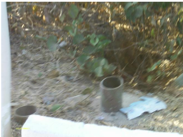
Foto 98 - Registro de Descarga na Rede: Rua Primavera - sem tampa.
