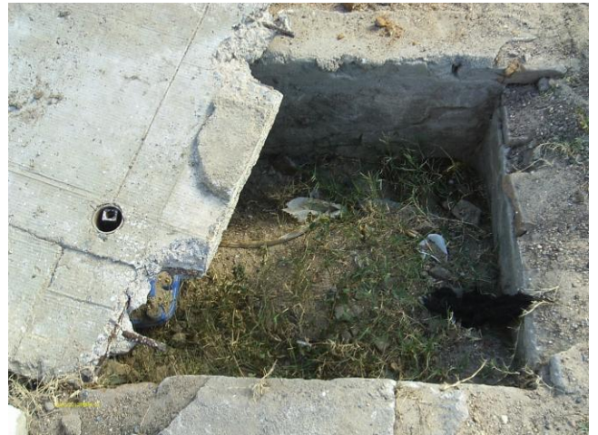
Foto 91 - Registro de Descarga da Rede: Rua Pompeu Lira de Moraes - tampa quebrada.
