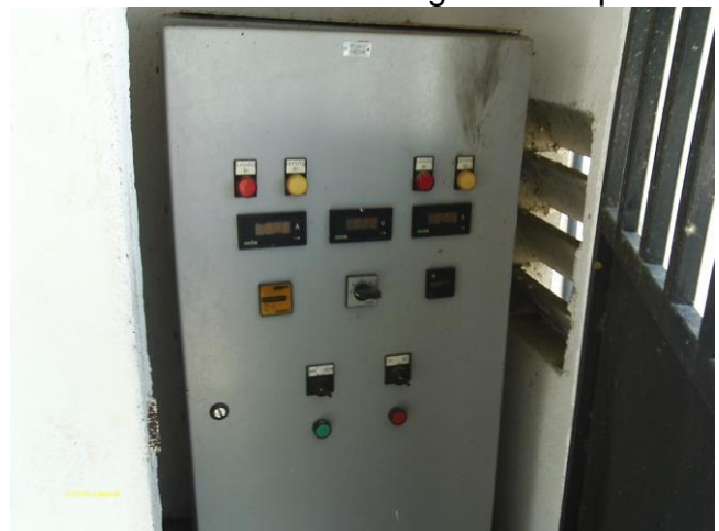
Foto 12 - Quadro de comando da bomba do decantador.
