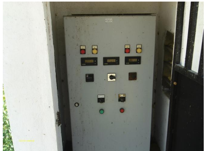
Foto 14 - Quadro de comando da bomba do tanque de equalização.
