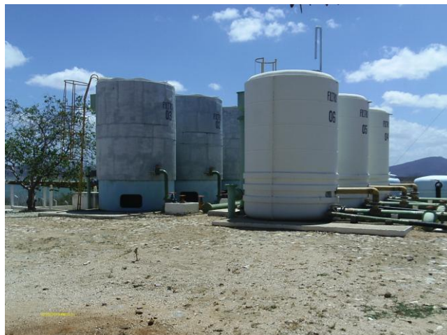
Foto 16 - Vista lateral dos filtros de fluxo ascendente.
