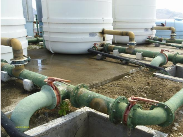
Foto 21 - Tubulações e registros dos Filtros F-04, F-05 e F-06.
