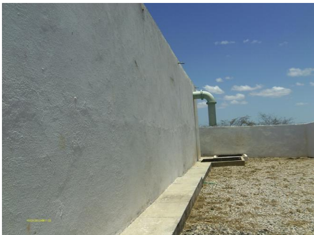
Foto 67 - RAP-03: ausência de escada fixa.
