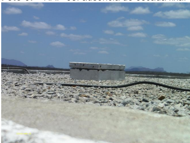
Foto 69 - RAP-03: tampa de inspeção.
