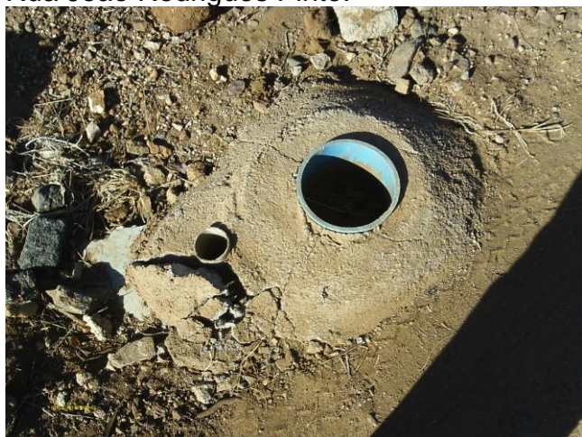
Foto 94 - Registro de Descarga na Rede: Rua SDO, Boa Vida - sem tampa.
