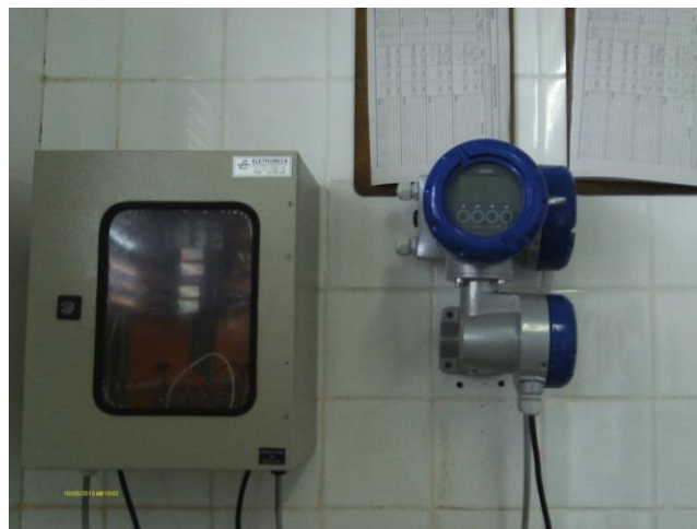
Foto 58 - RAP-01: controle de nível automatizado com defeito.
