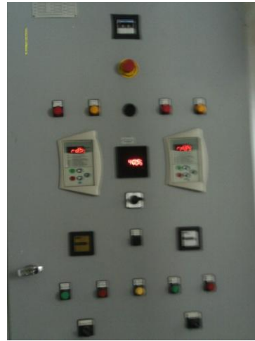
Foto 52 - Quadro de comando EEAT-03.
