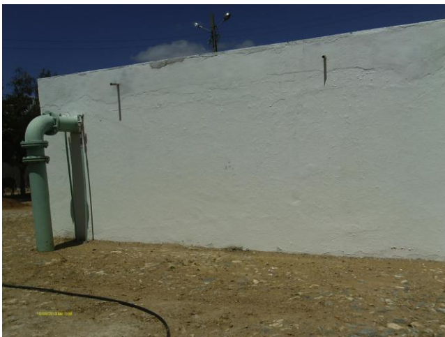
Foto 53 - RAP-01: ausência de identificação.
