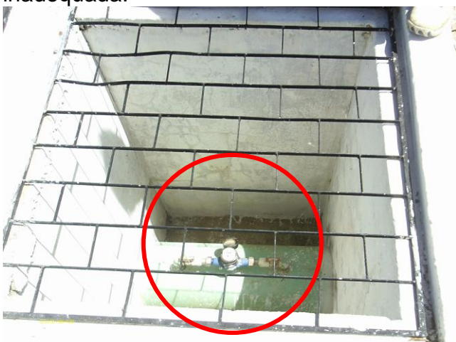
Foto 59 - Medidor proporcional na saída do RAP-01.
