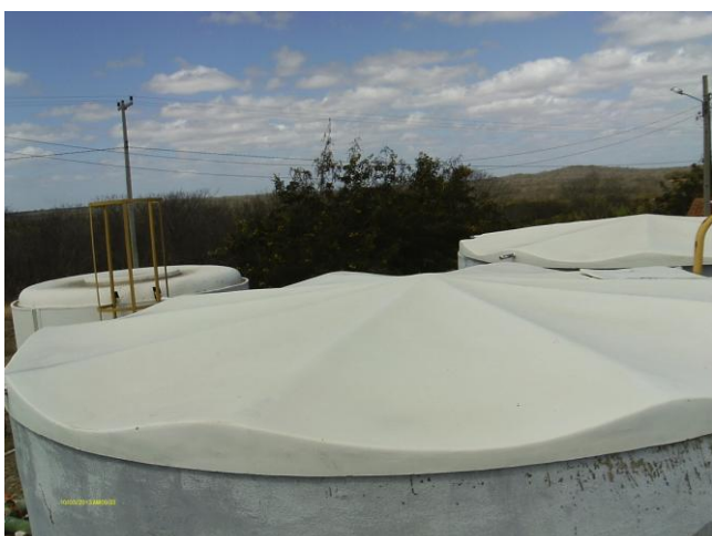
Foto 19 - Tampas dos filtros F-01, F-02 e F-03.
