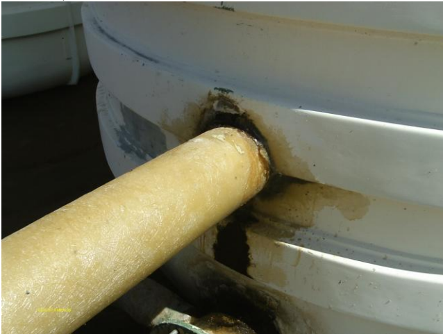
Foto 23 - Vazamento na tubulação do F-05.
