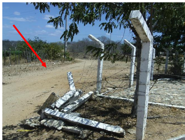
Foto 8 - Cerca de delimitação da área da ETA danificada.
