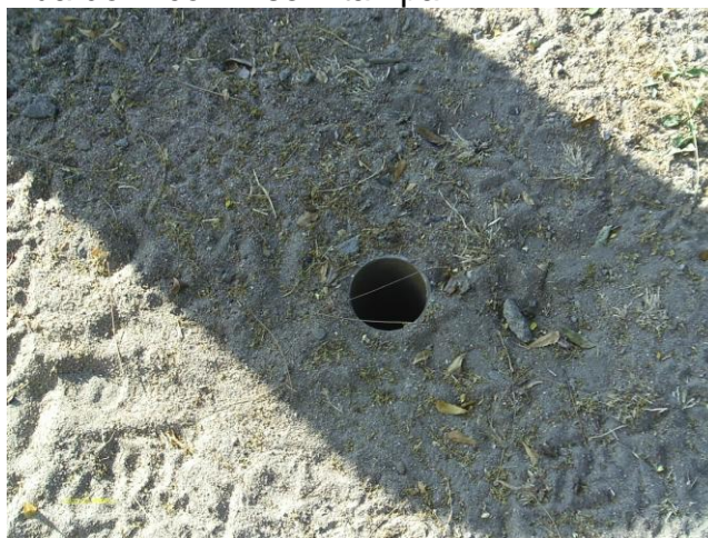
Foto 97 - Registro de Descarga na Rede: Rua Adroaldo Martins - sem tampa.
