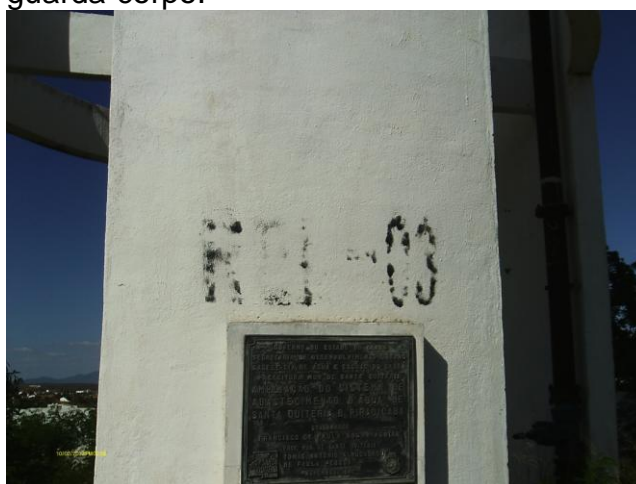
Foto 78 - REL-03: identificação apagada.
