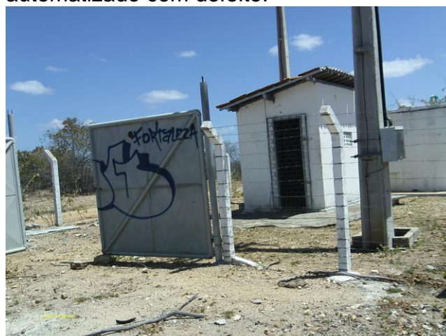
Foto 60 - RAP-02: portão sem cadeado.
