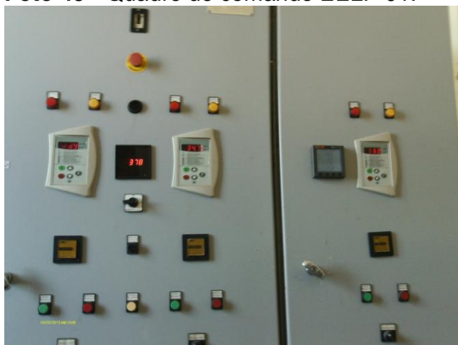
Foto 47 - Quadro de comando EEAT-01 .
