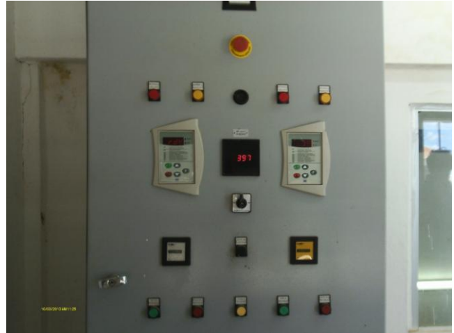
Foto 50 - Quadro de comando EEAT-02.
