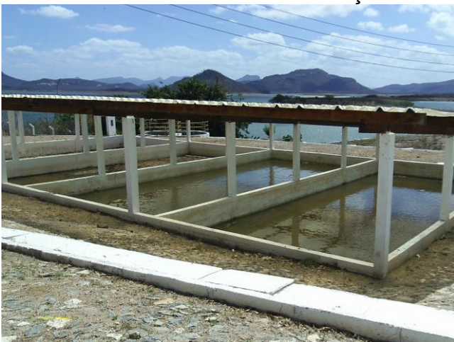
Foto 11 - Tanques de secagem do lodo retido no decantador.
