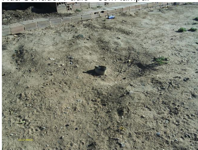
Foto 95 - Registro de Descarga na Rede: Rua do Arco 1 - sem tampa.
