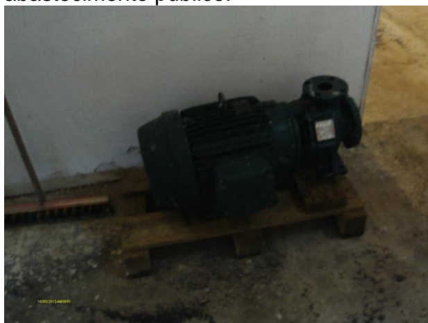
Foto 3 - Bomba reserva da EECS-01.
