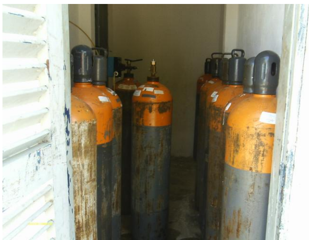
Foto 29 - Casa de química: armazenamento de cloro gasoso.
