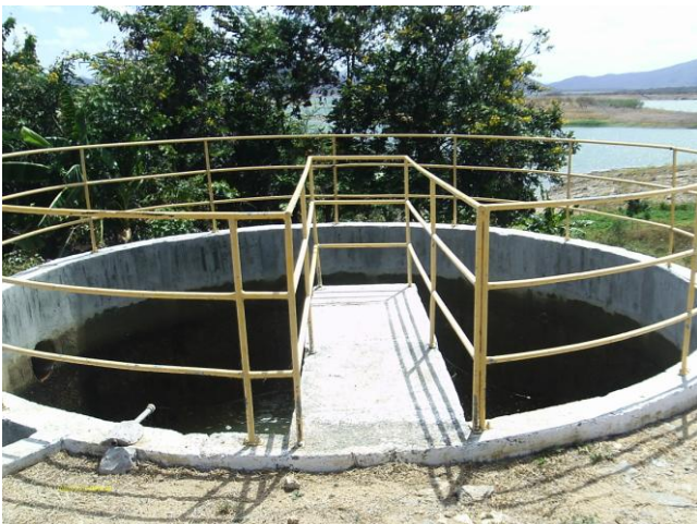
Foto 13 - Tanque de equalização.
