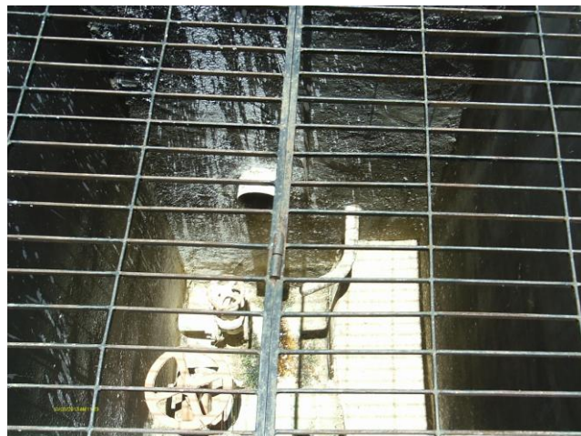
Foto 68 - RAP-03: caixas de registros.
