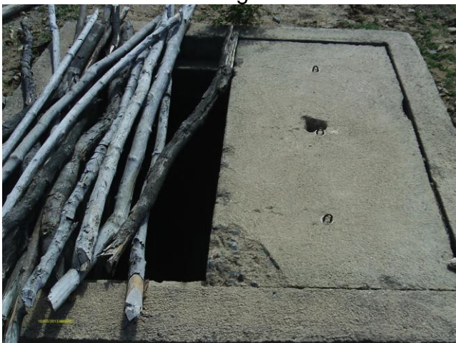
Foto 42 - AAT-01: caixa de descarga com tampa danificada.
