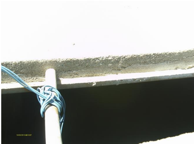
Foto 55 – RAP-01: Ausência de tampa na abertura de entrada de produtos químicos.
