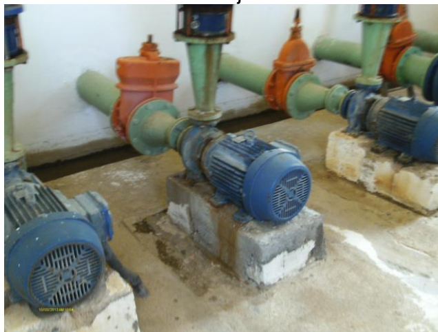
Foto 46 - EEAT-01: conjunto moto-bomba.
