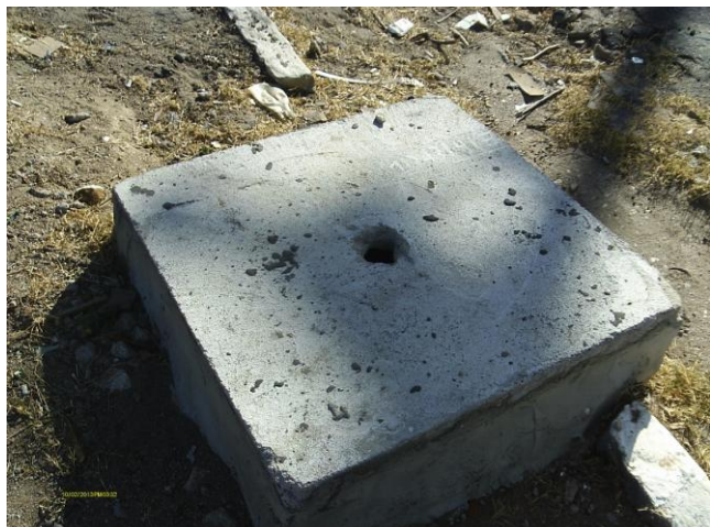
Foto 92 - Registro de Descarga na Rede: Rua João Rodrigues Pinto.
