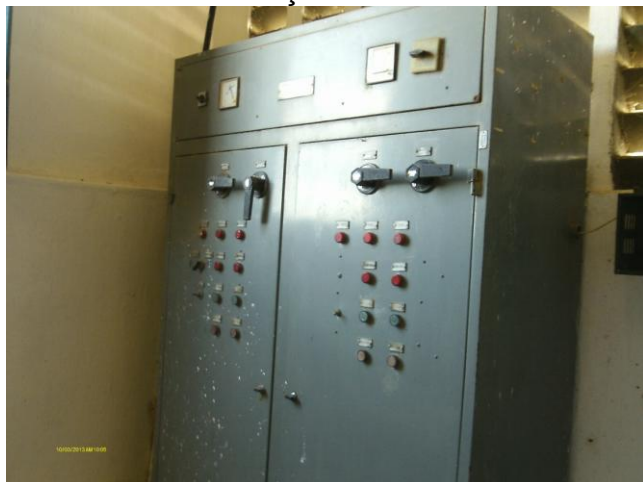
Foto 45 - Quadro de comando EELF-01.
