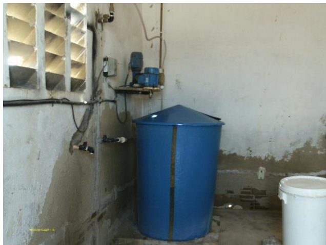
Foto 74 - REL-01: reforço de cloro.
