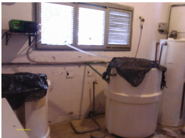
Foto 27 - Casa de química: tanques de dosagem sem tampas adequadas.
