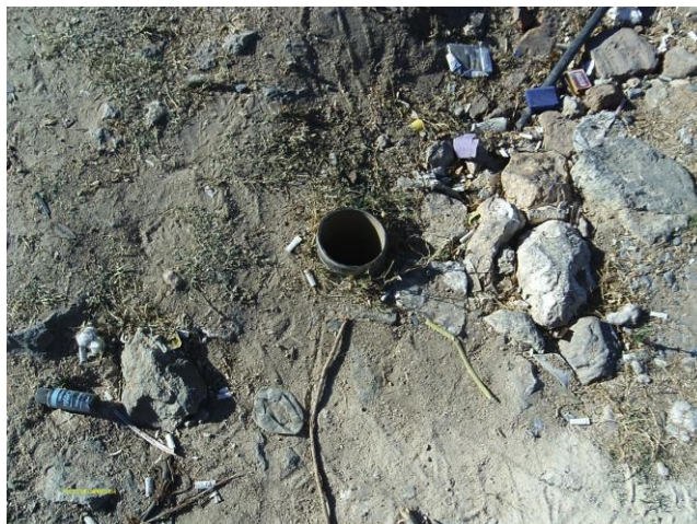
Foto 93 - Registro de Descarga na Rede: Rua Senador Paulo - sem tampa.
