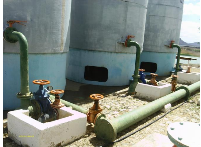
Foto 22 - Tubulações e registros dos Filtros F-01, F-02 e F-03.
