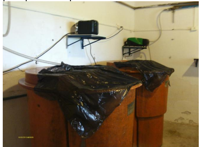
Foto 26 - Casa de química: Tanques de dosagem sem tampas adequadas.
