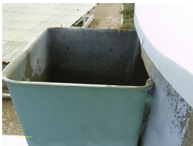
Foto 20 - Calha de saída de água sem tampa.
