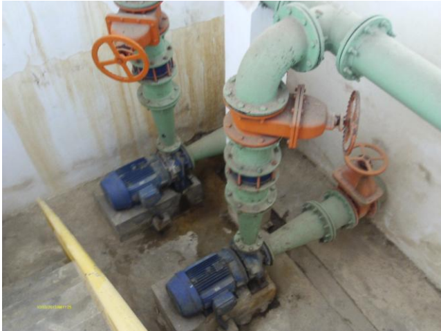
Foto 49 - EEAT-02: conjunto moto bomba.
