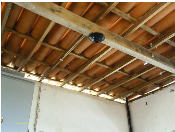
Foto 5 - Ausência de iluminação interna na casa de abrigo do QC – EECS-01.
