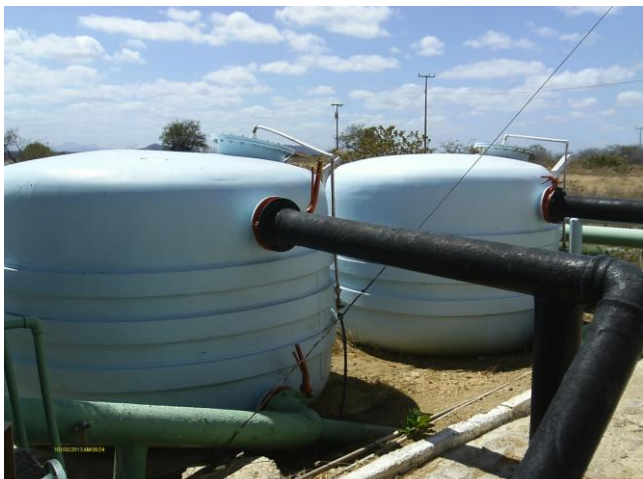
Foto 15- Filtros de pressão FP-01 e FP-02.
