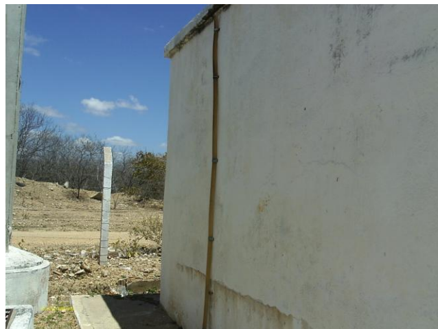
Foto 62 - RAP-02: mangueira do medidor de nível ressecada.
