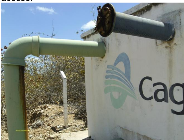
Foto 63 - RAP-02: entrada de água e tubo extravasor.
