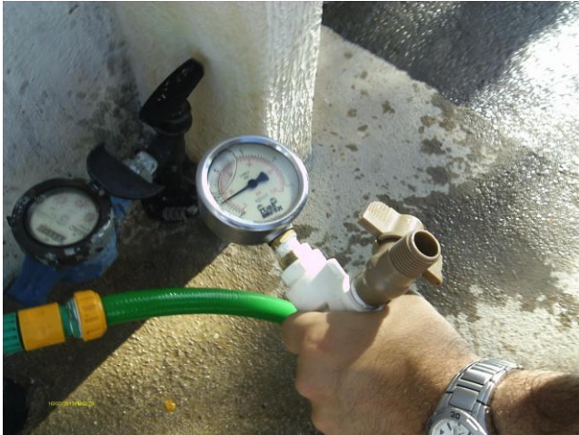
Foto 86 - Medição instantânea de pressão no endereço: Rua Luis Lobo Catunda, 64 - Flores.
