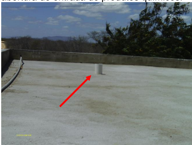
Foto 57 - RAP-01: Tubulação de ventilação inadequada.
