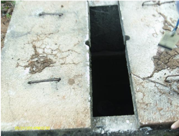
Foto 7 – Caixa de ventosa na adutora de água tratada.
