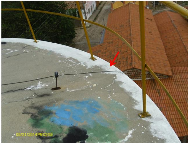
Foto 19 – REL-03: o cabo de descarga elétrica do para-raios não está isolado da infraestrutura.
