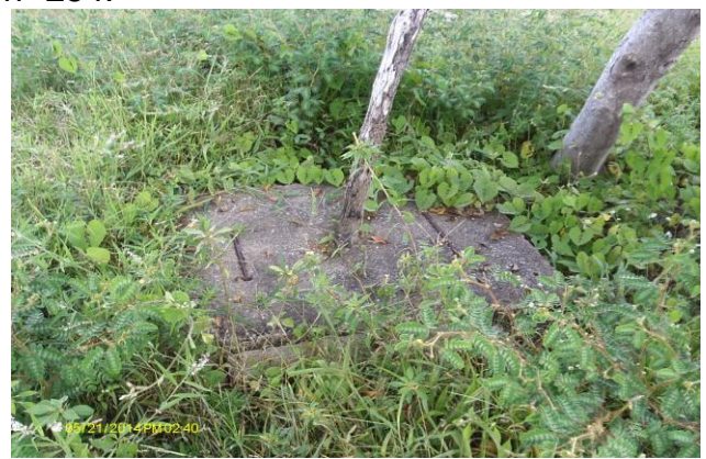
Foto 29 – Registro de descarga na Av. 23 de Agosto.
