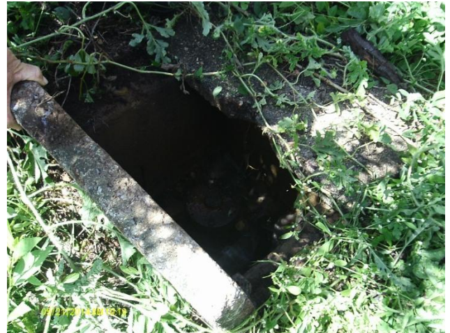
Foto 2 – Caixa de ventosa na rede de água de Torrões.
