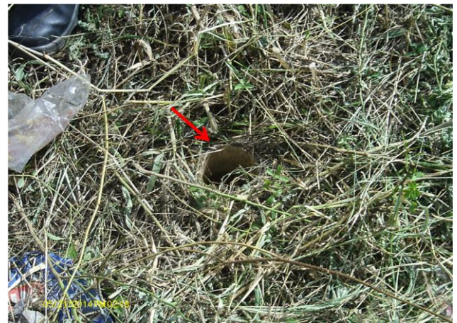
Foto 4 – Registro sem caixa de inspeção do injetamento na rede no setor 2 direto da adutora de água tratada.
