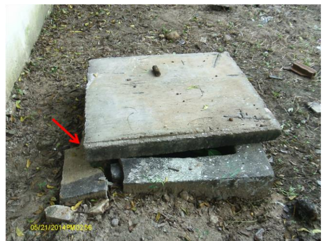
Foto 10 – Caixa de descarga danificada na área do REL-03.
