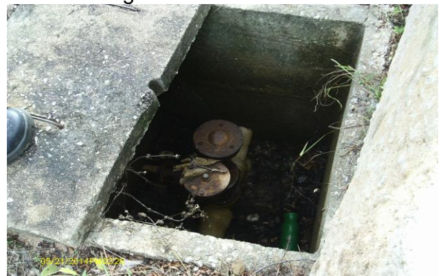
Foto 6 – Ventosa danificada na adutora de água tratada.
