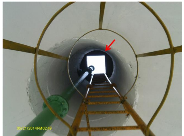
Foto 22 – REL-04: sem tampa de inspeção.
