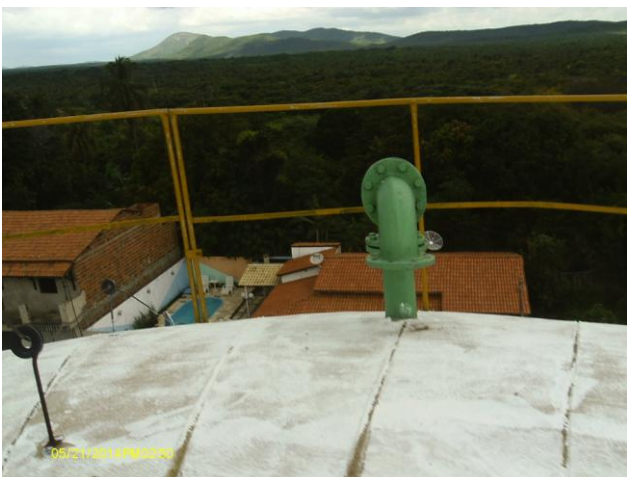
Foto 23 – REL-04: tubulações de ventilação.
