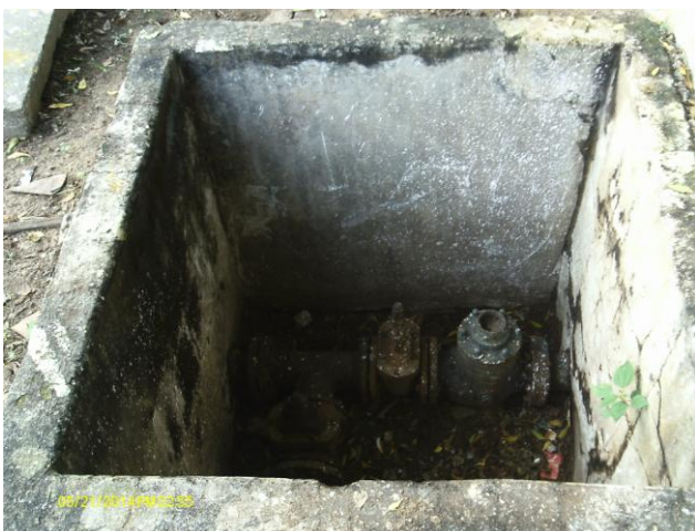
Foto 9 – Caixa de registro na área do REL-03 sem tampa ou grade de proteção.
