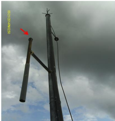
Foto 25 – REL-04: pára-raios e ausência de sinalizador noturno.
