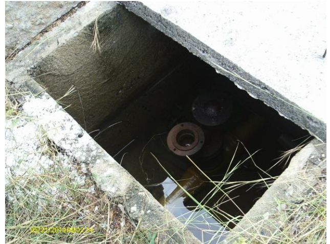
Foto 8 – Caixa de ventosa na adutora de água tratada com vazamento.
