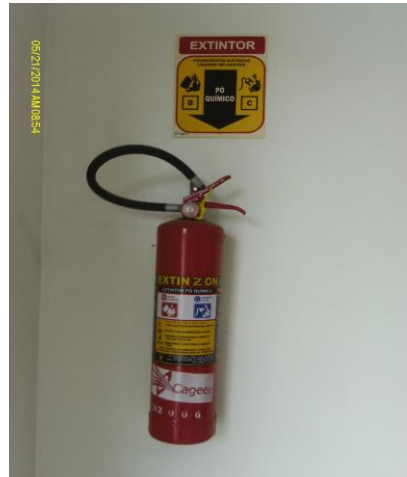
Foto 39 – Extintor de incêndio da loja de atendimento com validade até ago/2014.
