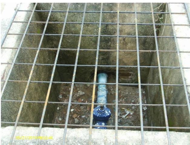
Foto 11 – Caixa de registro na área do REL-04 com grade de proteção.
