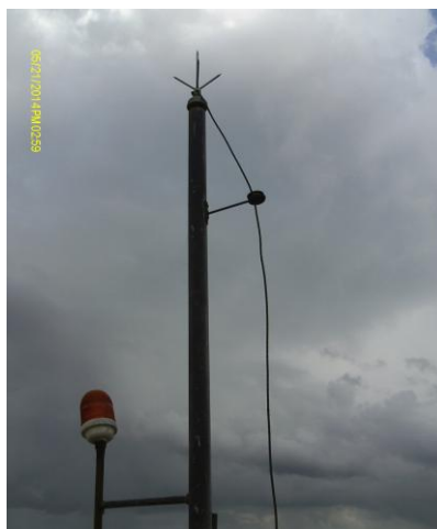
Foto 18 – REL-03: pára-raios e sinalizador noturno.
