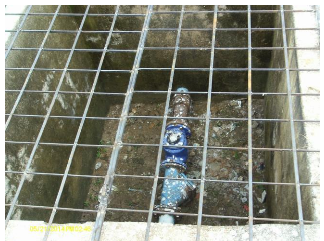
Foto 12 – Macromedidor de água tratada na área do REL-04 com grade de proteção.
