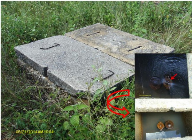
Foto 1 – Caixa de ventosa na adutora de água tratada, com vazamento (vandalismo).
