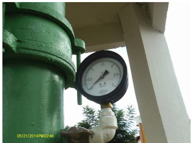
Foto 24 – REL-04: medidor de nível.
