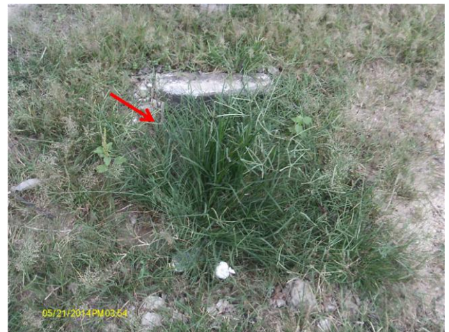
Foto 33 – Registro de descarga na Av. 23 de Agosto.
