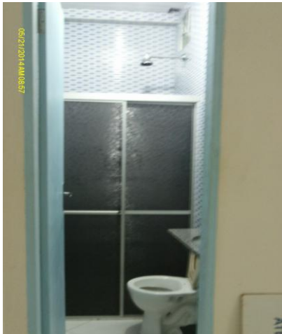
Foto 38 – Instalações sanitárias disponíveis para funcionários e usuários.
