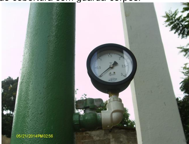
Foto 17 – REL-03: medidor de nível.
