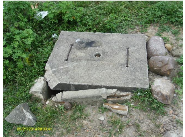
Foto 31 – Registro de descarga na Rua SDO.
