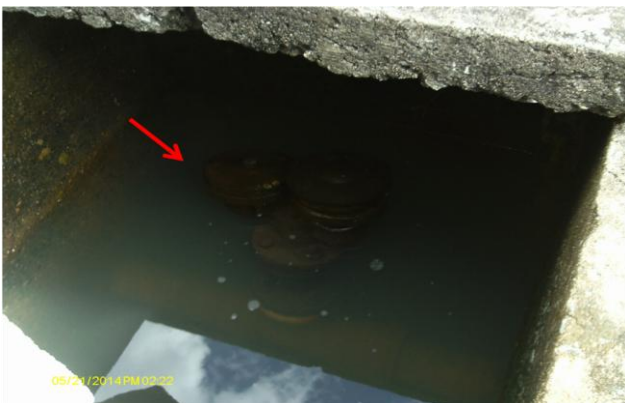
Foto 5 – Caixa de ventosa na adutora de água tratada com vazamento.
