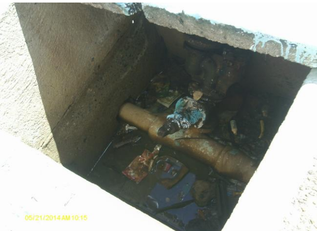
Foto 3 – Caixa de ventosa com registro danificado (travado).
