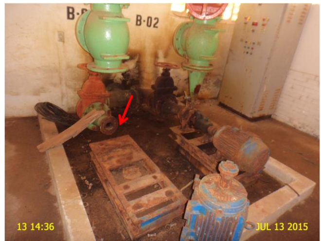
Foto 5 – EAT-02: sem bomba reserva instalada.
