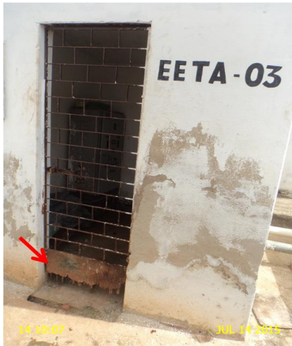
Foto 13 – EEAT-03: casa de abrigo do QC sem iluminação e portão em processo de corrosão.
