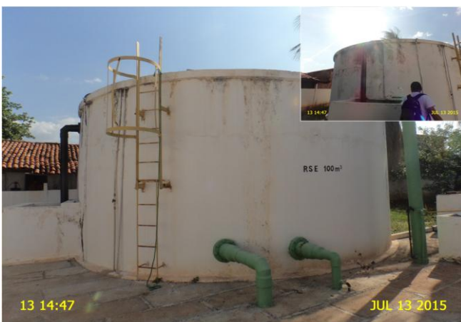
Foto 17 – RSE-01: pintura deteriorada.
