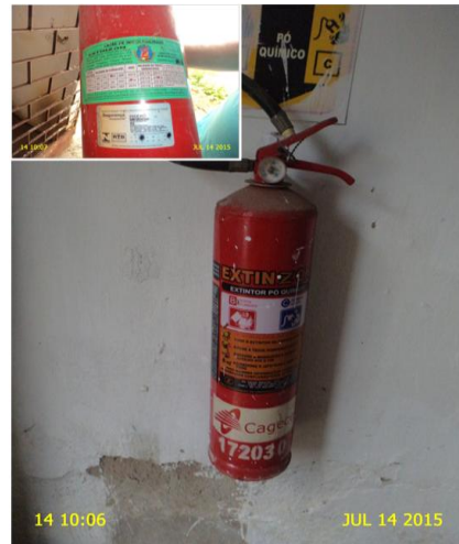
Foto 14 – EEAT-03: extintor de incêndio com carga vencida em 03/2014.
