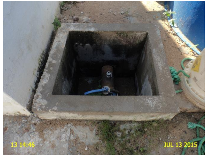
Foto 10 – ETA: caixa de inspeção sem tampa ou grade de proteção.
