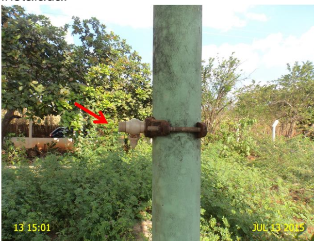
Foto 8 – REL-02: ausência de medidor de nível.
