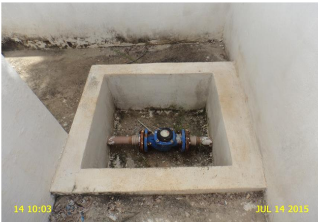
Foto 15 – RSE-02: caixa de inspeção sem tampa ou grade de proteção
