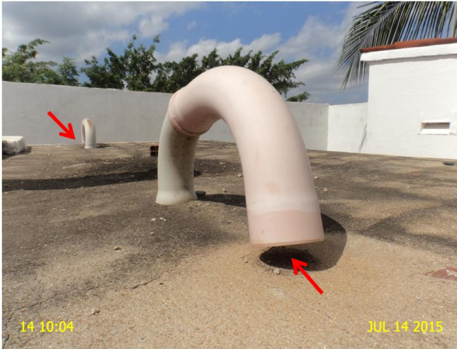
Foto 19 – RSE-02: tubulação de ventilação sem tela de proteção.
