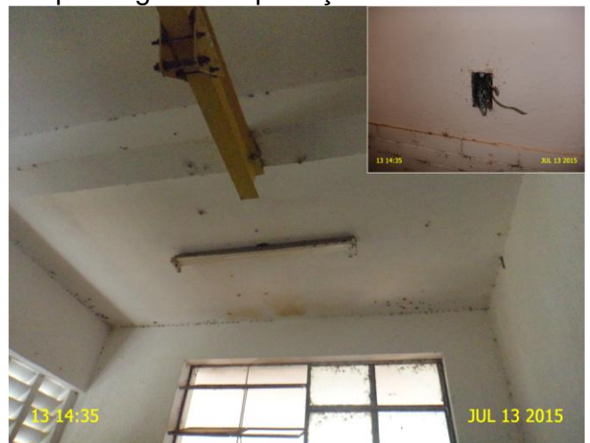
Foto 12 – EEAT-02: ausência de iluminação.
