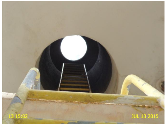
Foto 7 – REL-02: ausência de tampa de inspeção.
