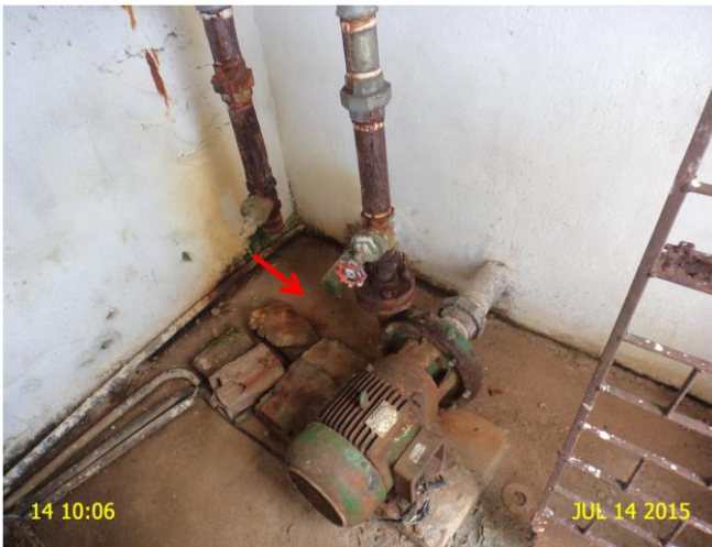
Foto 6 – EAT-03: sem bomba reserva instalada.
