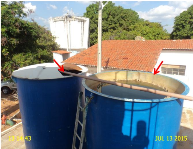
Foto 9 – F-01 e F-02: filtros com tampa aberta.
