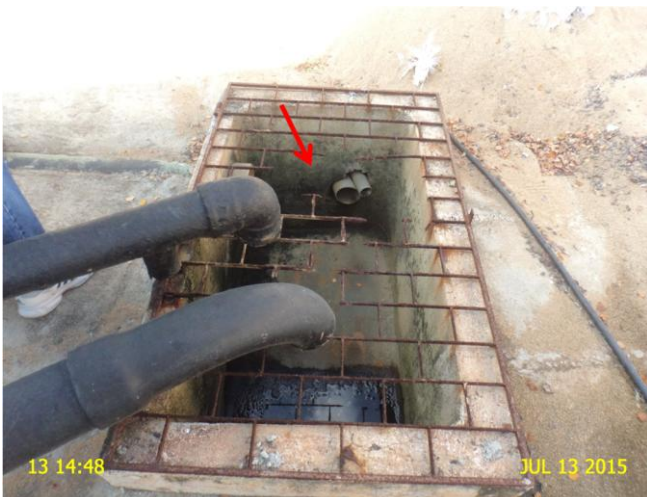
Foto 11 – ETA: caixa de inspeção com grade em processo de corrosão.
