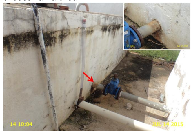
Foto 18 – RSE-02: sem identificação, pintura deteriorada e sinais de vazamento na saída do reservatório.
