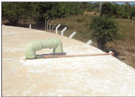
Foto 25 – Ventilação do RAP-01.
