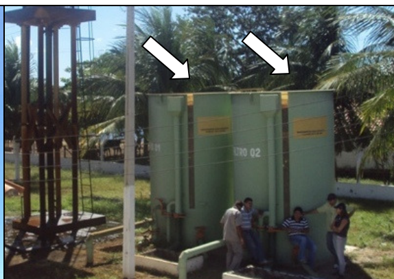
Foto 8 – Filtros sem tampa.
