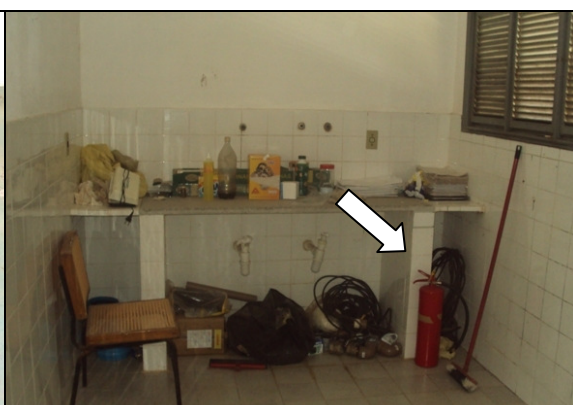
Foto 14 – Extintor de incêndio da ETA.
