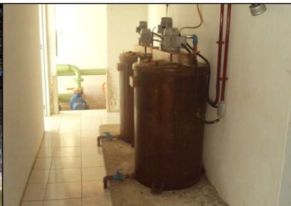
Foto 10 – Tanques de dosagem de produtos químicos.
