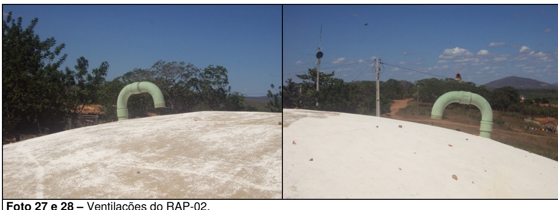
Foto 27 e 28 – Ventilações do RAP-02.
