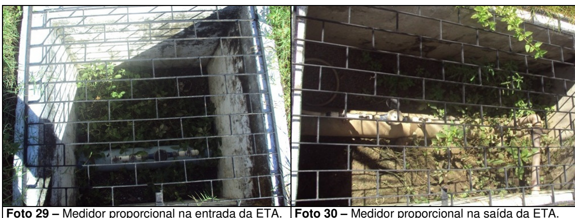
Foto 29 – Medidor proporcional na entrada da ETA.
