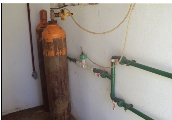
Foto 11 – Cilindros de cloro gasoso.
