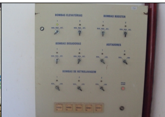
Foto 22 – Quadro de comando das elevatórias.
