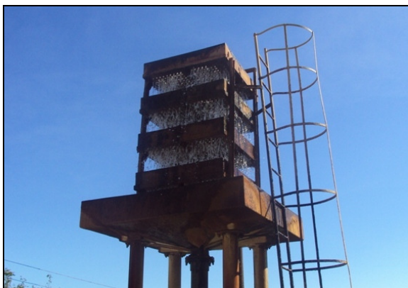
Foto 7 – Vista do aerador.
