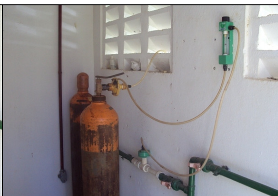
Foto 12 – Dosador de cloro gasoso.
