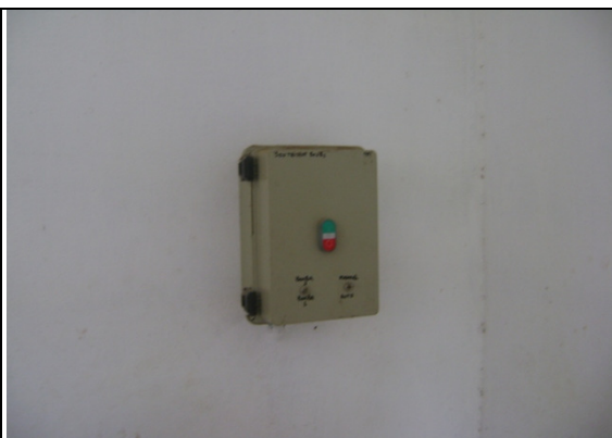
Foto 28 – EERD-01: Quadro de comando sem voltímetro, amperímetro e horímetro.
