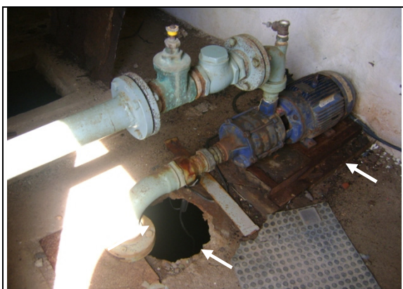
Foto 32 – EERD-02: Base do conjunto moto-bomba comprometida pela corrosão e orifício de passagem da tubulação de sucção inadequado (ver item 7.2.5).
