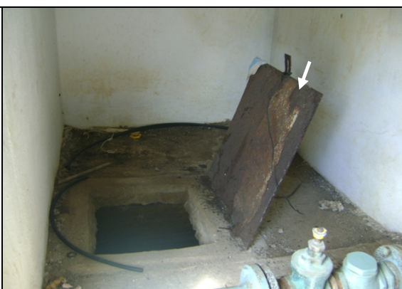
Foto 42 – REN-01: Tampa de inspeção comprometida pela corrosão.
