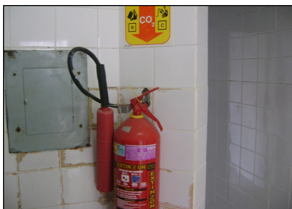
Foto 25 – Extintor de incêndio da casa de química.
