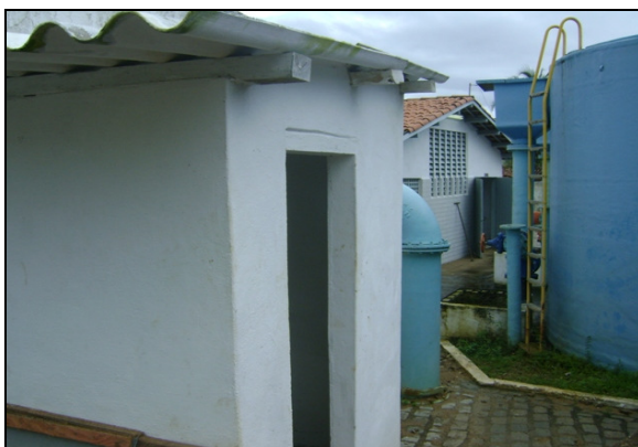
Foto 33 – EERD-03: Casa sem portão de proteção.
