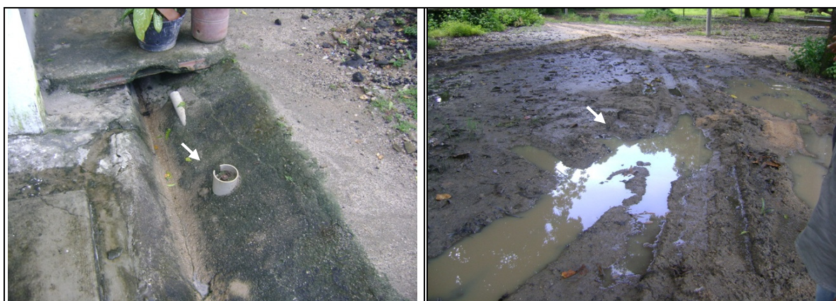
Foto 54 – Registro de descarga sem tampa de proteção, localizado na Rua Uruará.
