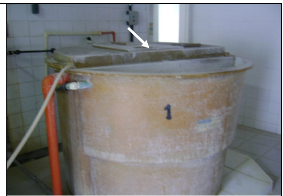
Foto 22 – Tanque de mistura da solução de cloro de sódio
