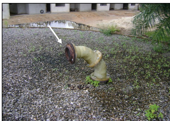
Foto 38 – RAP-01: Tubulação de ventilação inadequada.
