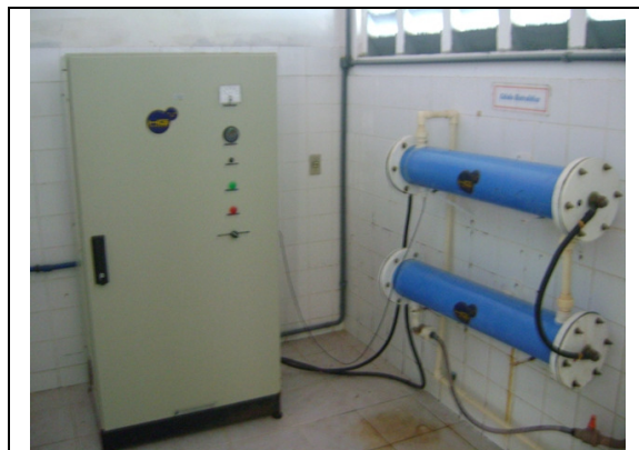
Foto 21 – Geradores de cloro.
