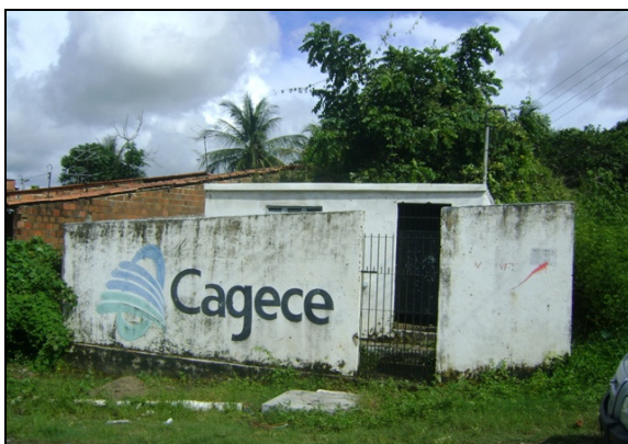
Foto 30 – EERD-02: Pintura deteriorada.
