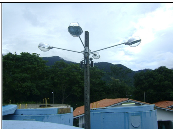
Foto 2 – ETA: Iluminação noturna da área.
