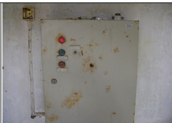
Foto 31 – EERD-02: Quadro de comando danificado.
