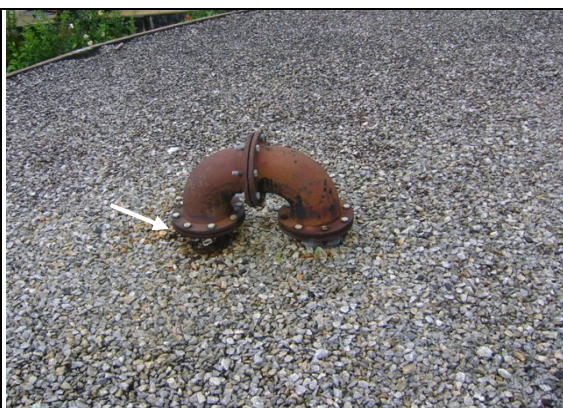
Foto 37 – RAP-01: Tubulação de ventilação sem tela de proteção.
