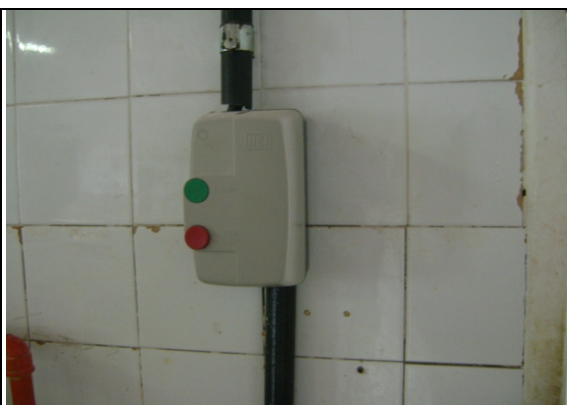
Foto 34 – EERD-03: Chave liga/desliga do conjunto moto-bomba.
