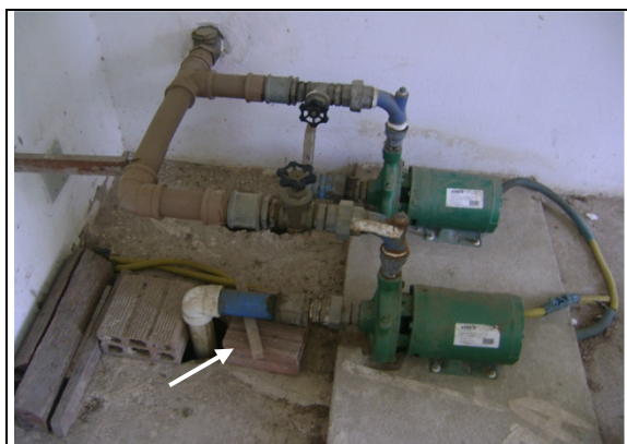
Foto 29 – EERD-01: Apoio improvisado da tubulação de sucção do conjunto moto-bomba.
