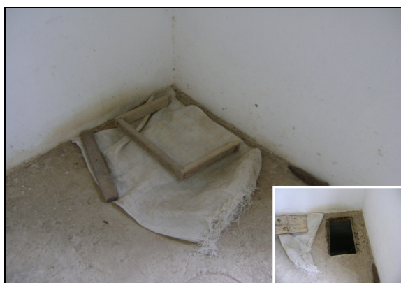
Foto 43 – REN-02: Tampa de inspeção improvisada.
