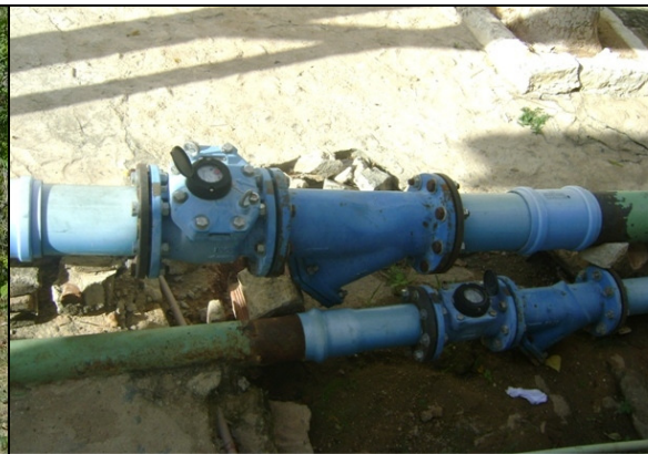
Foto 50 – Macromedidores de água tratada sem caixa de proteção, na saída da ETA.
