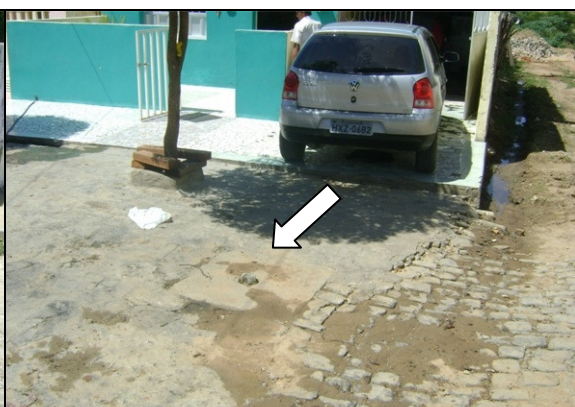
Foto 54 – Registro de descarga localizado na Rua Abílio Gurgel, Centro.
