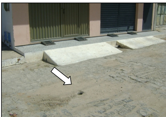
Foto 55 – Registro de descarga localizado na Rua José Carlos Sampaio, Centro.
