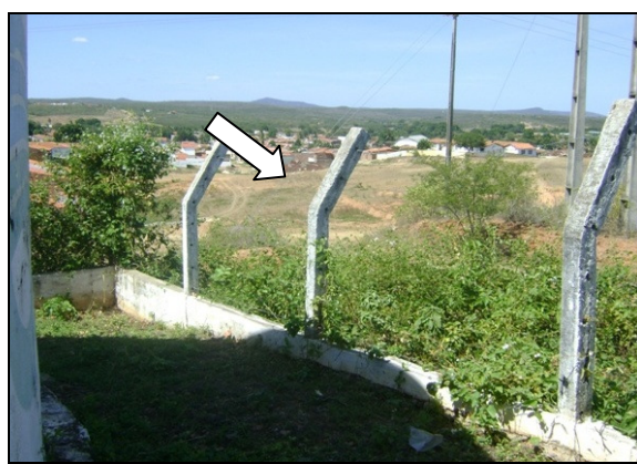
Foto 42 – Cerca de proteção danificada do RAP-02.
