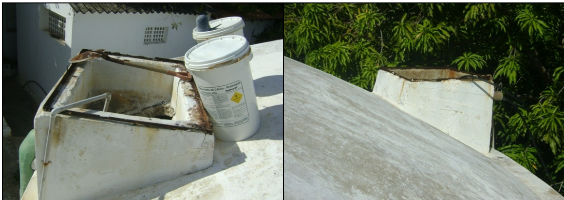
Fotos 34 e 35 – Ausência de tampas de inspeção do RAP-01.
