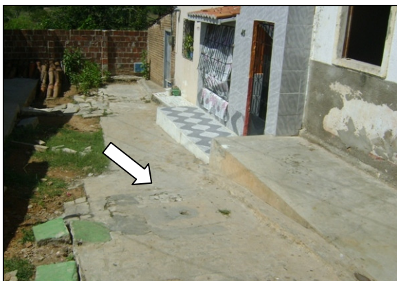
Foto 51 – Registro de descarga localizado na Vila Santa Luzia.
