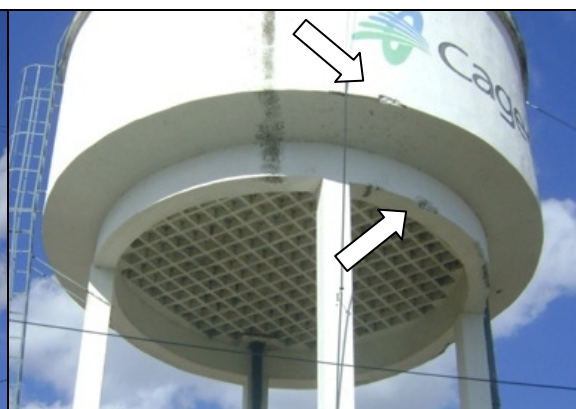
Foto 46 – Revestimento deteriorado do REL-01.
