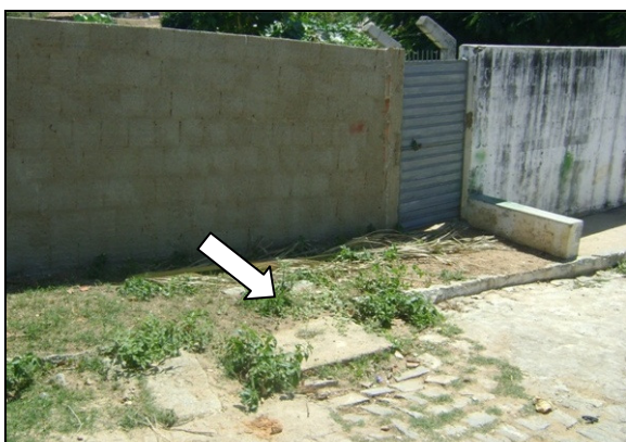
Foto 53 – Registro de descarga localizado na Rua H, COHAB.
