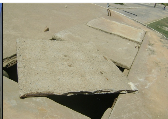
Foto 44 – Tampa de inspeção do RAP-03.
