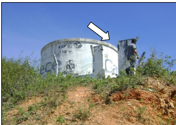
Foto 38 – Ausência de portão de acesso do RAP-02.
