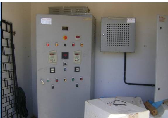
Foto 23 – Quadro de comando da EECS-01.
