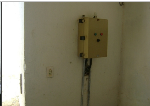
Foto 31 – Quadro da EEAT-03.
