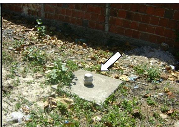
Foto 56 – Registro de descarga localizado na Rua Eládio Magalhães, Centro.
