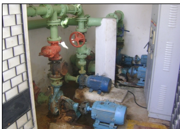
Foto 25 – Elevatórias EEAT-01 e EEAT-02.
