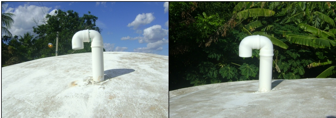
Fotos 36 e 37 – Ventilações sem tela de proteção do RAP-01.
