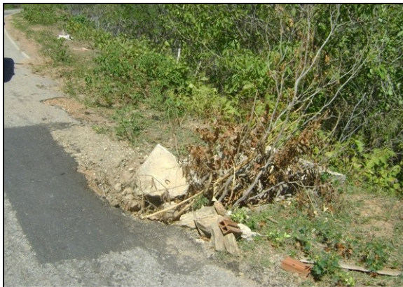
Foto 49 – Tampa da caixa de proteção da ventosa, da adutora de água bruta, quebrada.
