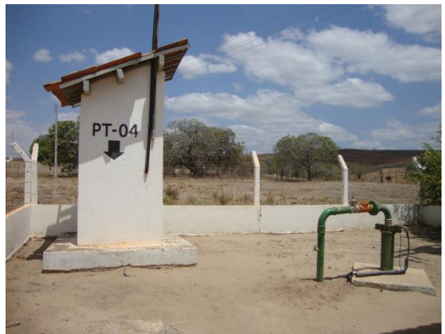
Foto 2 – Vista do PT-04 e da casa de abrigo do quadro de comando.
