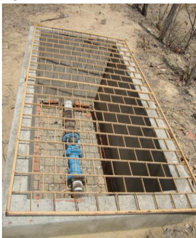
Foto 32 – Macromedidor na saída do poço PT-06.
