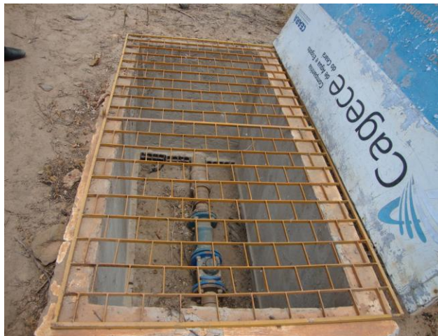
Foto 31 – Macromedidor na saída do poço PT-05.
