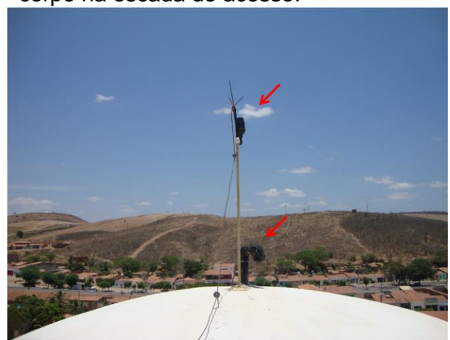
Foto 40 – REL-01: Tubulações de ventilação com tela de vedação, para-raios e sinalizador noturno.
