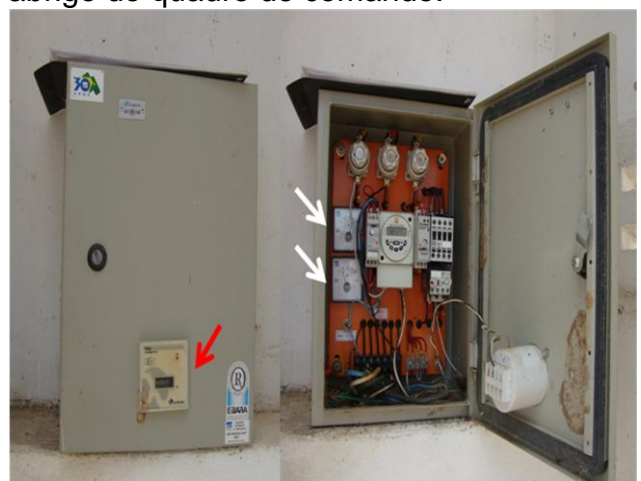
Foto 12 – Quadro de comando do PT-06.
