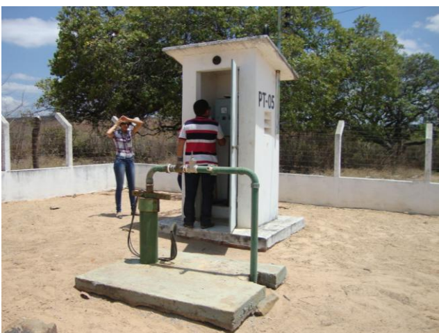
Foto 5 – Vista do PT-05 e da casa de abrigo do quadro de comando.
