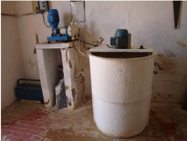
Foto 18 – Tanque de preparação e bomba dosadora de hipoclorito de cálcio.
