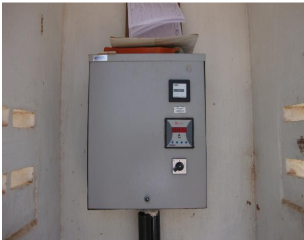
Foto 15 – Quadro de comando do PT-08.
