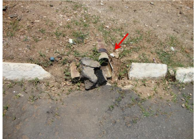
Foto 42 – REL-01: Tubo extravasor.
