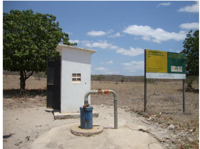
Foto 14 – Vista do PT-08 e da casa de abrigo do quadro de comando.
