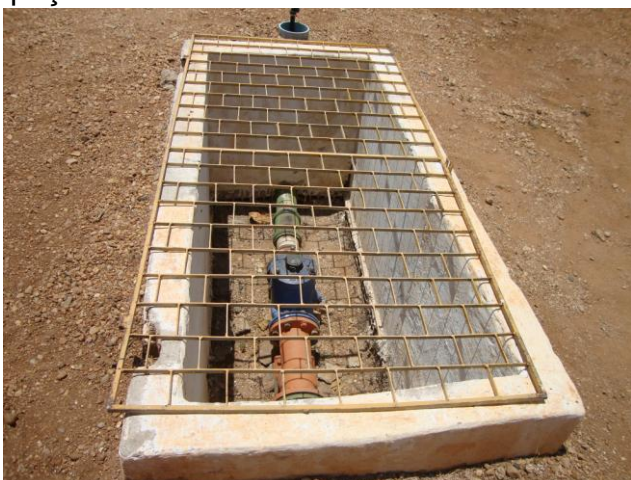
Foto 34 – Macromedidor na saída do REL-01.
