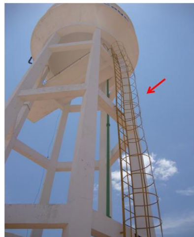
Foto 38 – Vista do REL-02 com guarda-corpo na escada de acesso.
