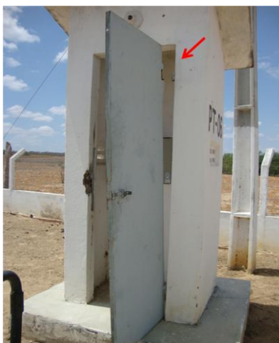
Foto 11 – Portão de acesso ao quadro de comando do PT-06 com defeito.
