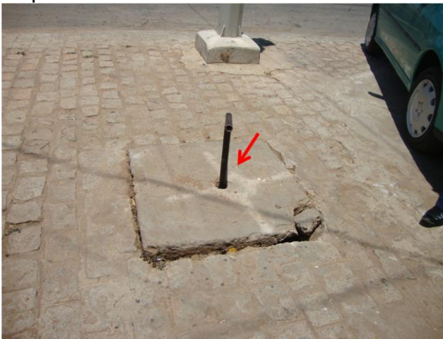
Foto 55 – Registro de descarga na Av. José Humberto Alcântara.
