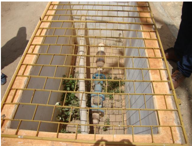
Foto 30 – Macromedidor na saída do poço PT-04.
