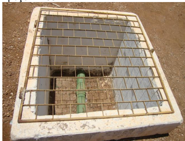
Foto 33 – Estação pitométrica na saída do REL-01.
