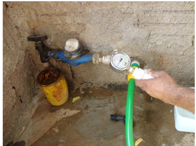
Foto 50 – Medição de pressão instantânea na Rua Francisco Jovino Gomes, s/n.
