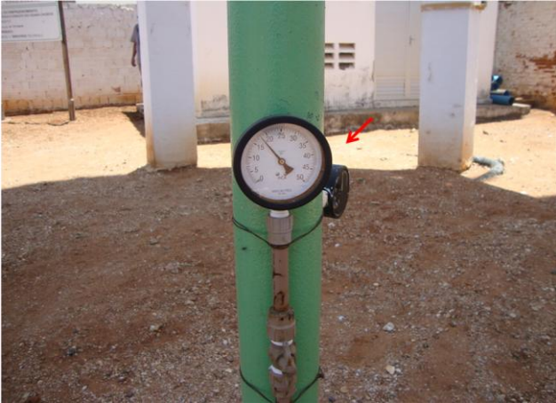
Foto 41 – REL-01: Medidor de nível.
