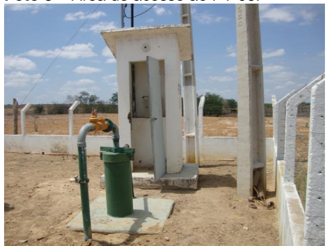
Foto 10 – Vista do PT-06 e da casa de abrigo do quadro de comando.
