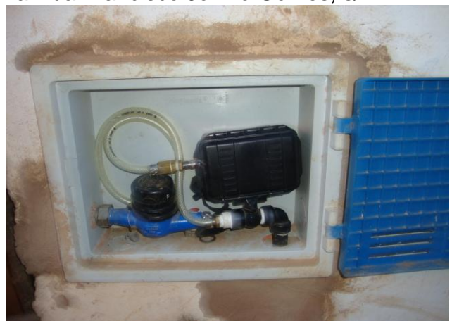
Foto 52 – Medição de pressão com instalação às 18:10h do dia 8/10/13 e retirada às 18:10h do dia 9/10/13, com aparelho datalogger Rua Projetada, nº 02 - Conjunto Tenente Arlindo Rocha.
