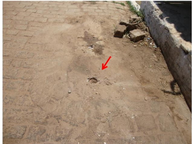
Foto 54 – Registro de descarga na Av. José Humberto Alcântara.
