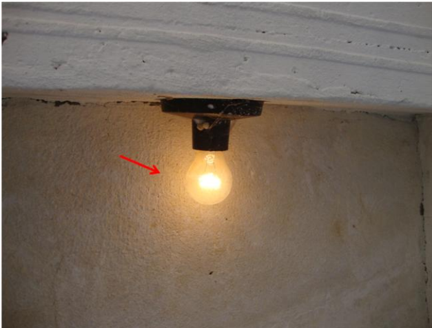
Foto 7 – Iluminação interna do PT-05.
