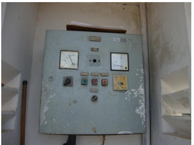
Foto 6 – Quadro de comando do PT-05.
