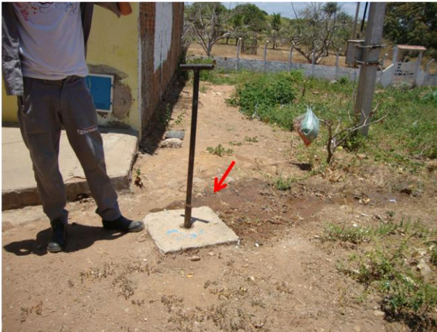
Foto 53 – Registro de descarga na Rua Exedito Almeida.
