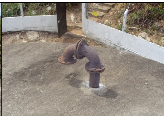
Foto 40 – Ventilação do RAP-01.
