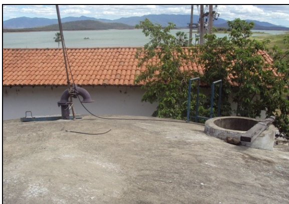
Foto 39 – Ventilação e visita do RAP-01.
