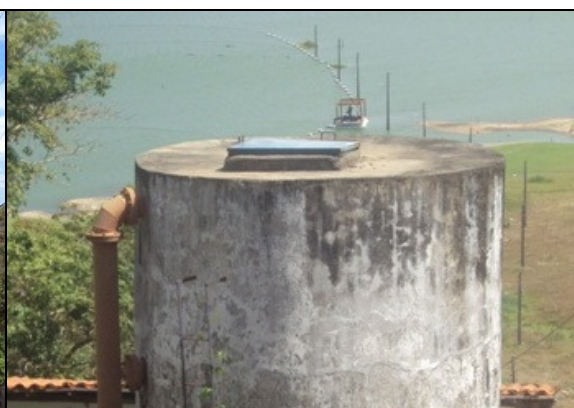
Foto 42 – Visita do RAP-02 e ausência de ventilação.
