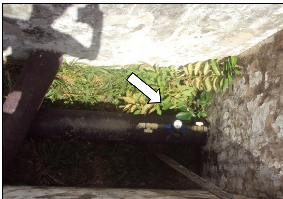
Foto 52 – Medidor proporcional na adutora de água tratada.
