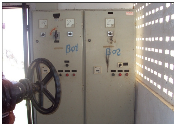
Foto 36 – Quadro da EEAT-01.
