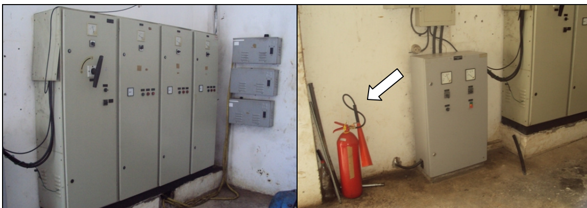
Foto 29 – Quadro da EEAB-01.
