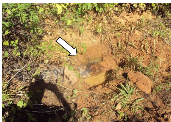
Foto 51 – Vazamento na adutora de água bruta.
