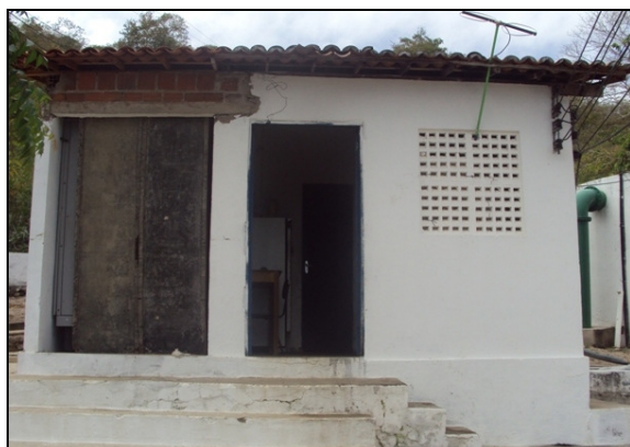
Foto 26 – Casa de comando da EECS-01 e EECS-02.
