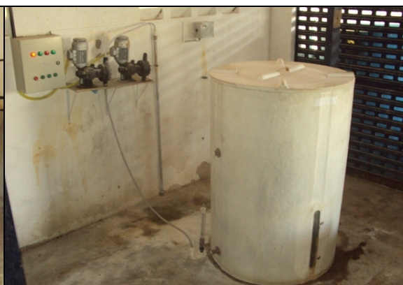
Foto 14 – Dosador de flúor.
