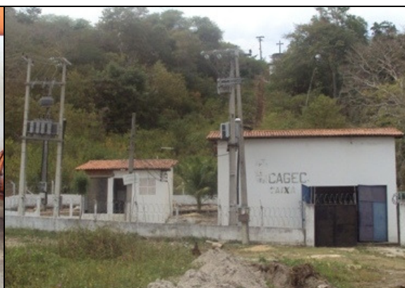
Foto 28 – Casa de comando da EEAB-01.
