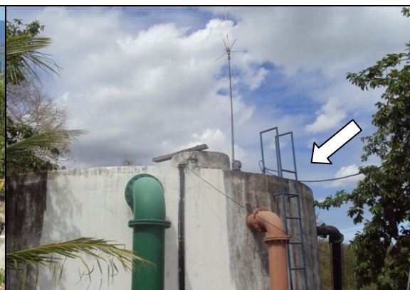
Foto 38 – Escada de acesso e para-raio do RAP-01.
