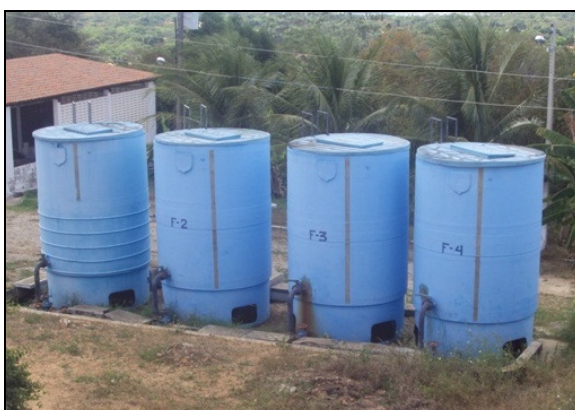
Foto 7 – Filtros em operação.
