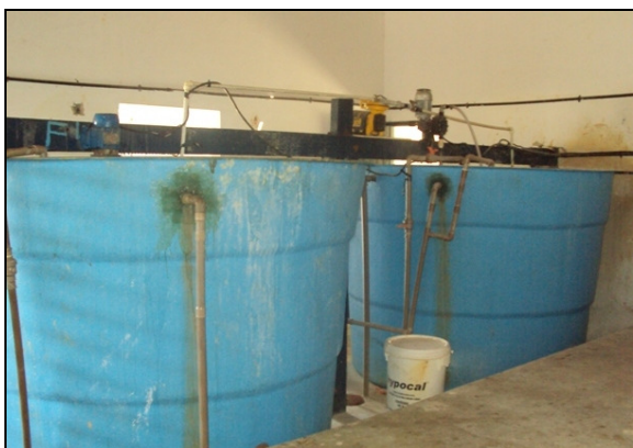
Foto 13 – Dosadores de produtos químicos.
