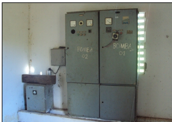
Foto 33 – Quadro da EEAB-02.
