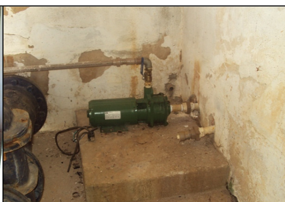
Foto 16 – Bomba dosadora de cloro.
