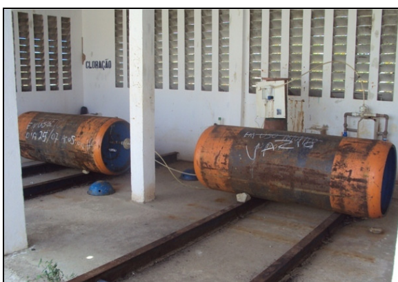
Foto 15 – Cilindros de cloro gasoso.
