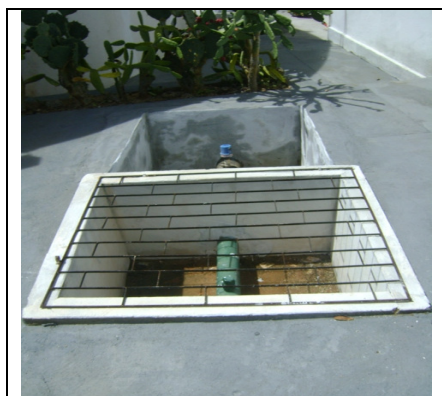
Foto 31 – EP na entrada da ETA
