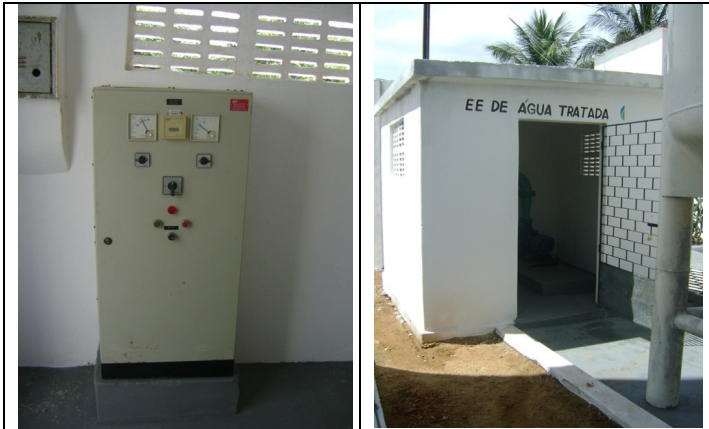
Fotos 20 e 21 – EEAT-01 - Quadro de comando e casa de proteção
