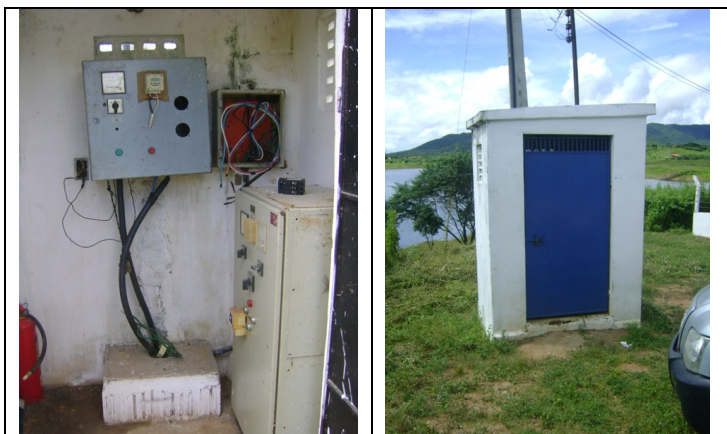
Fotos 22 e 23 – EECS-01 – Quadro de comando e casa de proteção
