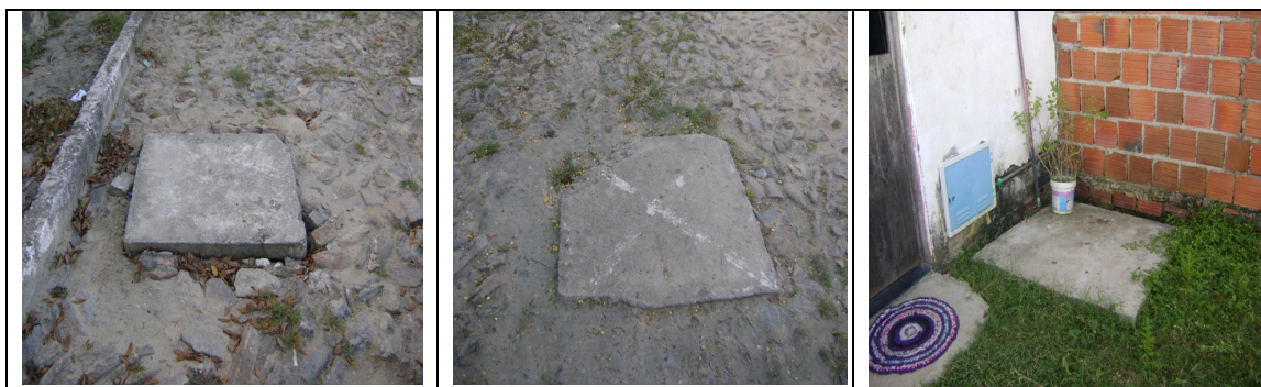
Fotos 32, 33 e 34 – Dois registros de descarga na Rua Etevaldo Paiva Nunes e um registro na Rua Catão Andrade Araújo
