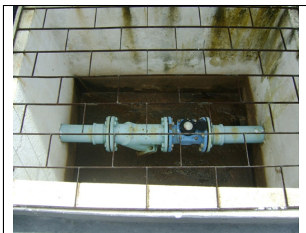
Foto 30 – Macromedidor na entrada do RAP-01
