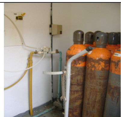
Foto 12 – Cilindros de cloro
