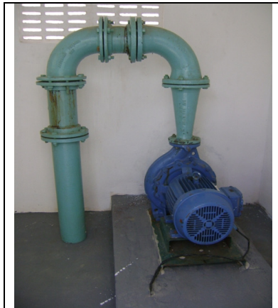
Foto 19 - EEAT-01 – conjunto motor-bomba
