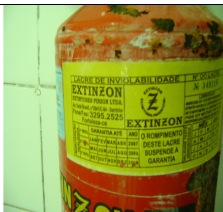
Foto 13 – Extintor de incêndio
