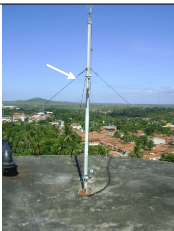
Foto 32 – REL-01: Existência de pára-raio e sinalizador noturno sem lâmpada..
