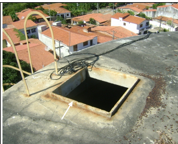
Foto 33 – REL-01: Ausência de tampa na inspeção.
