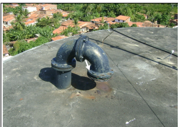
Foto 34 – REL-01: Ausência de tela de proteção na tubulação de ventilação.
