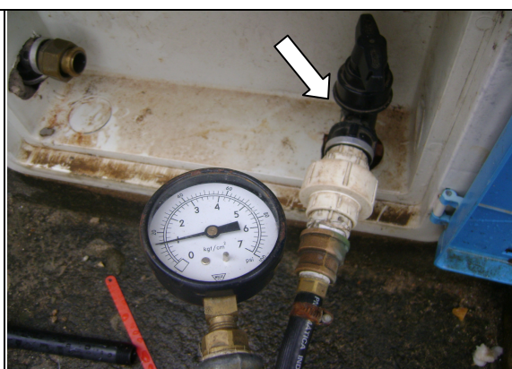
Foto 45 – Medição de pressão na Rua Cleilson Martins, nº 26, Centro.
