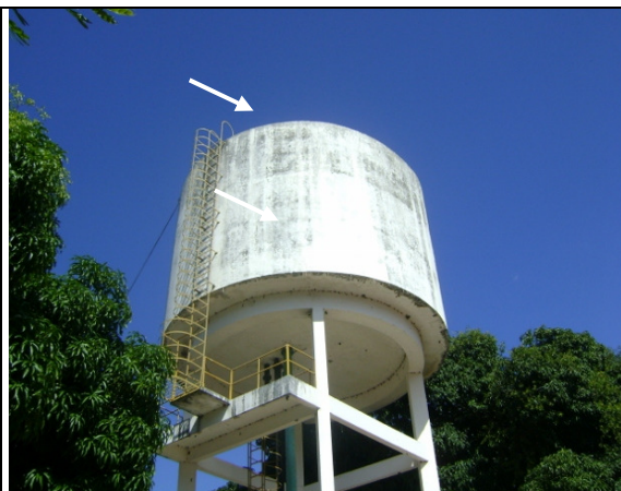
Foto 31 – REL-01: Ausência de guarda-corpo na laje superior.
