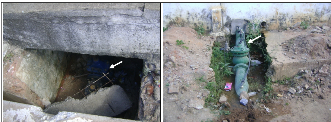
Foto 21 – Adutora de água bruta: Macromedidor desativado. Foto 22 – Adutora de água bruta: Válvula redutora de pressão sem caixa de proteção.
