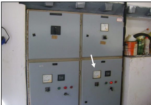
Foto 24 – EEAT-01: Quadro de comando com amperímetro danificado.
