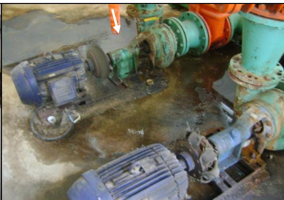
Foto 25 – EEAT-01: Conjunto moto-bomba apresentando vazamento.
