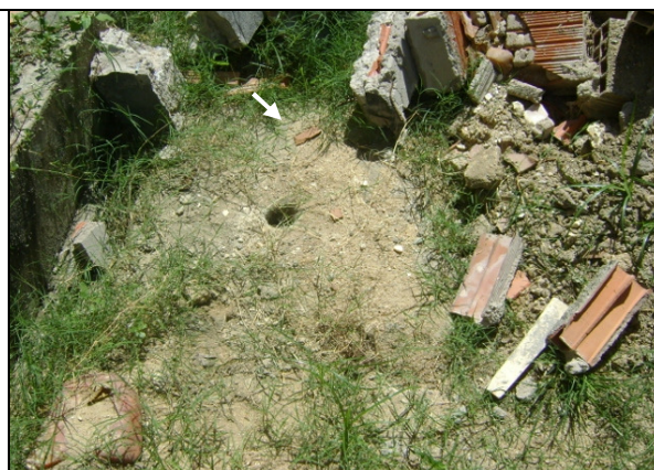
Foto 42 – Registro de descarga localizado na Rua 8 de Dezembro.
