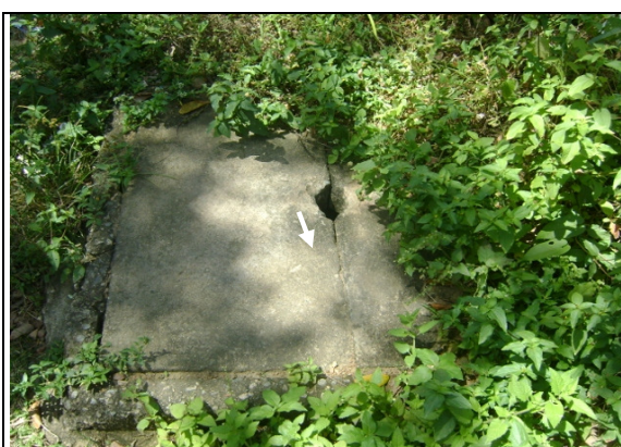
Foto 43 – Registro de descarga localizado na Rua Maria do Carmo.
