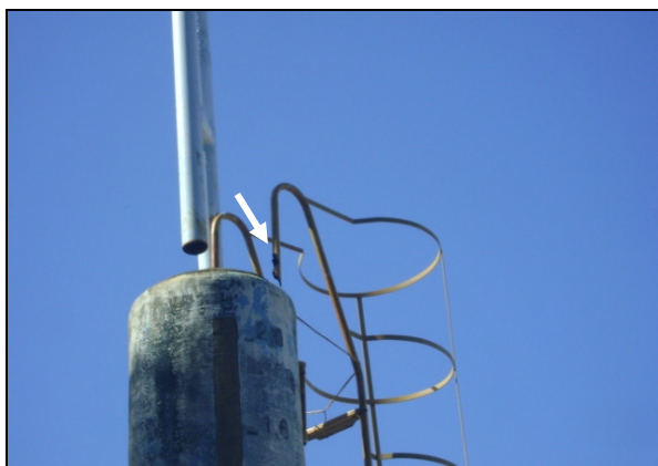
Foto 2 – Torre de equilíbrio: Escada oxidada.
