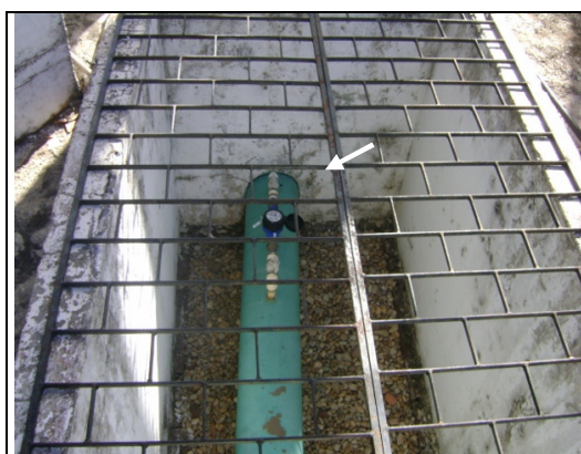
Foto 23 – Adutora de água tratada: Medidor proporcional localizado na entrada do REL-01.
