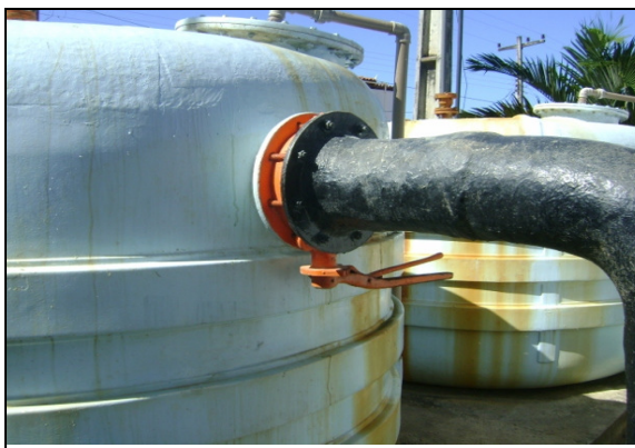
Foto 7 – Filtragem de Pressão: sem identificação.
