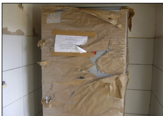
Foto 26 – EEAT-01: Quadro de comando lacrado.
