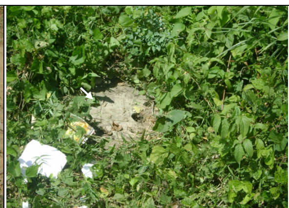
Foto 38 – Registro de descarga localizada na Rua Xavier Pires – Final.
