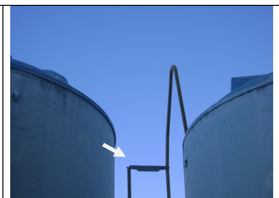
Foto 6 – Filtragem 03 e 04: Escada de acesso comprometida pela ferrugem.
