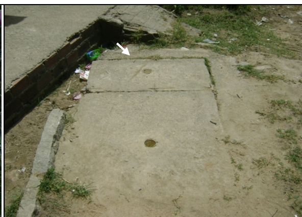
Foto 40 – Registro de descarga localizada na Rua 05.
