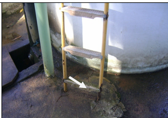
Foto 4 – Filtro 01: Escada de acesso comprometida pela ferrugem.
