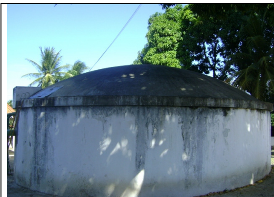
Foto 27 – RAP-01: Sem identificação, sem tubulação de ventilação e pintura deteriorada.
