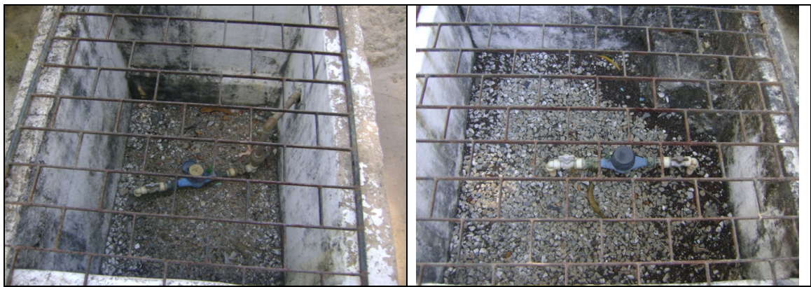
Fotos 9 e 10 – Medidores proporcionais instalados na entrada dos filtros de fluxo ascendente.
