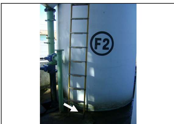
Foto 5 – Filtro 02: Escada de acesso comprometida pela ferrugem.
