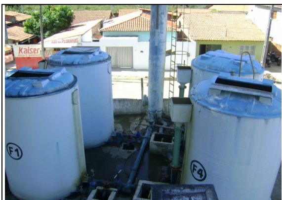
Foto 3 – Filtragem de fluxo ascendente: Existência de identificação.
