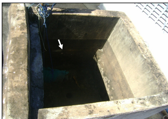
Foto 29 – RAP-01: Ausência de tampa de inspeção no extravasor.
