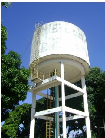
Foto 30 – REL-01: Ausência de identificação.
