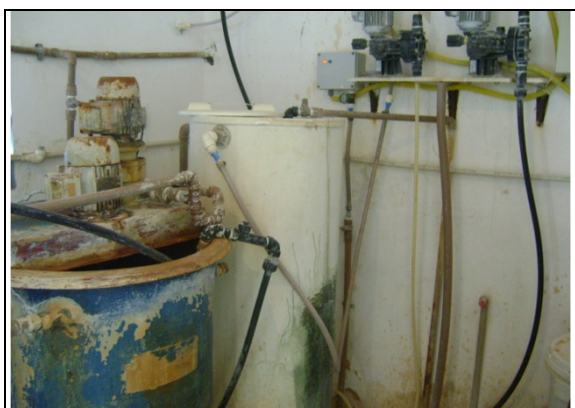
Foto 19 – Dosador de flúor..
