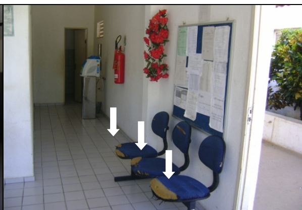
Foto 53 – Vista interna do escritório/loja: Assentos dos usuários danificados.
