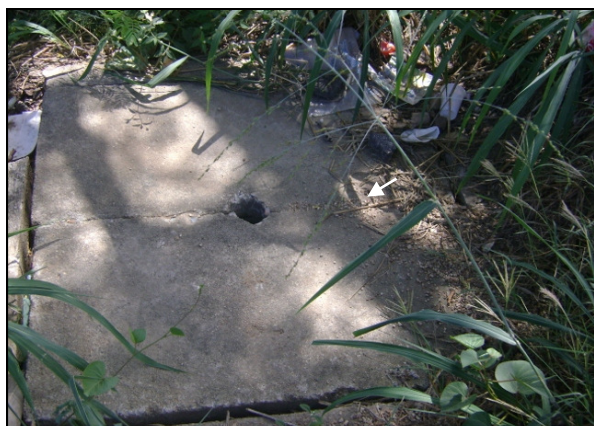
Foto 39 – Registro de descarga localizada na Rua 04.
