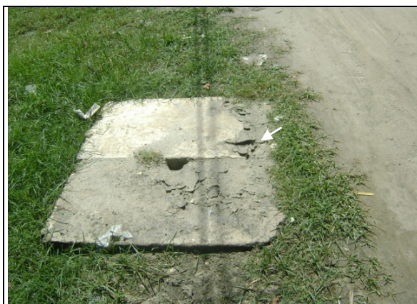
Foto 41 – Registro de descarga localizado na Rua Vila Fátima.
