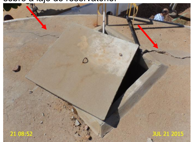
Foto 8 - RAP-01: tampa de inspeção sem vedação e rachaduras na laje superior. .
