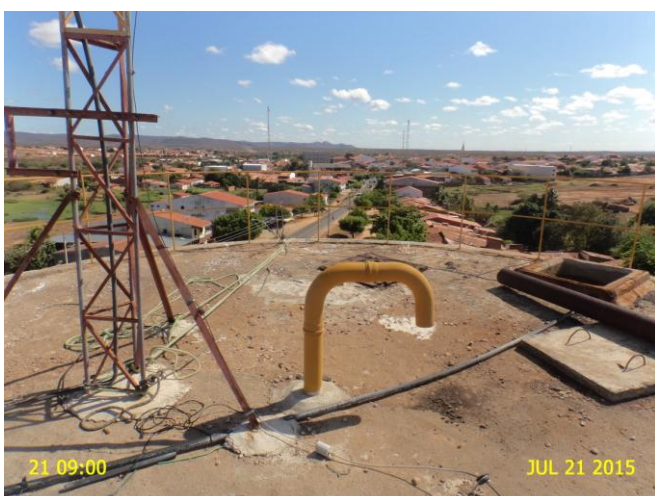
Foto 7 - REL-01: tubulação de ventilação sem tela de proteção.
