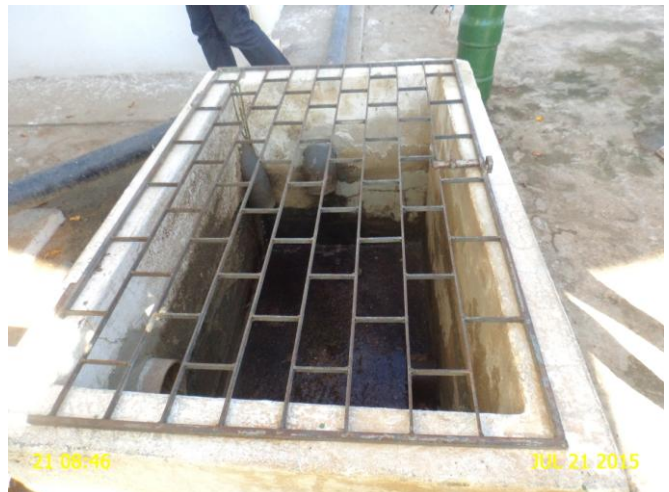
Foto 12 - F-03: registro sem vedação.
