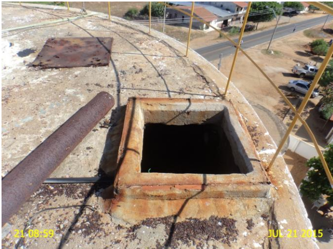
Foto 9 - REL-01: ausência de tampa de inspeção.
