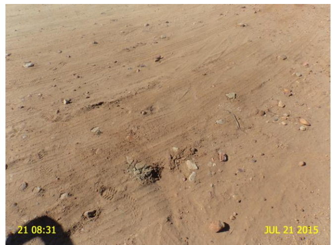
Foto 2 - AAB: ventosa com caixa soterrada.
