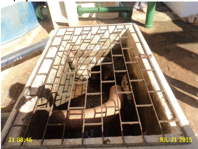
Foto 11 - F-02: registro sem vedação.
