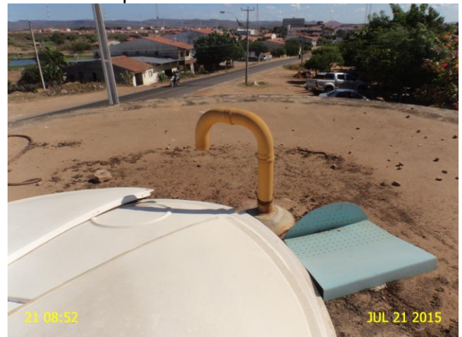
Foto 6 - RAP-01: tubulação de ventilação sem tela de proteção e acúmulo de materiais sobre a laje do reservatório.
