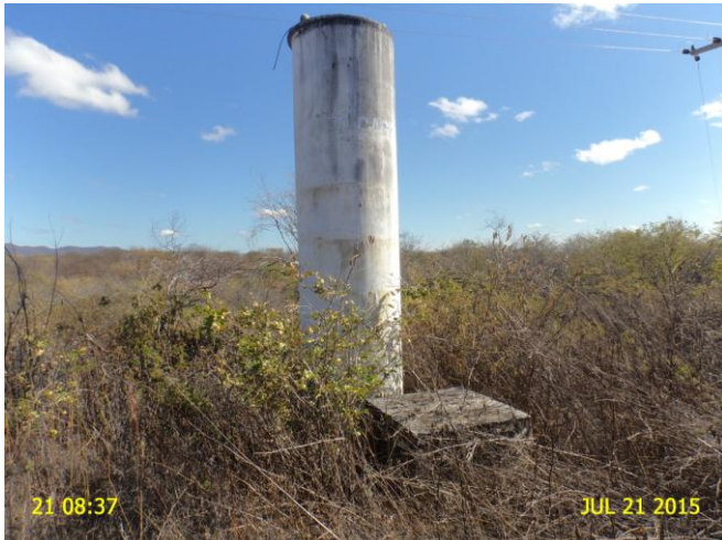
Foto 3 - AAB: torre de equilíbrio sem identificação e com pintura deteriorada.
