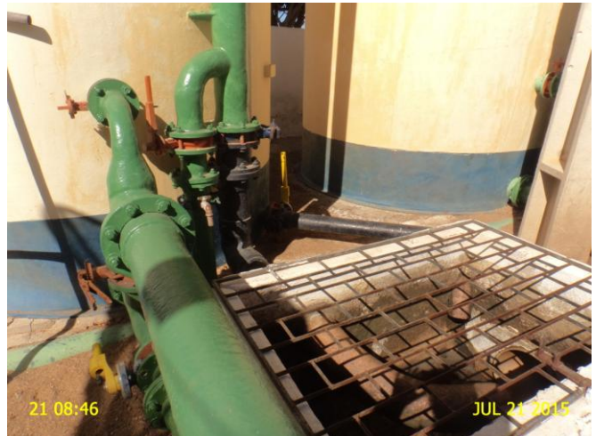
Foto 10 - F-01: registro sem vedação.
