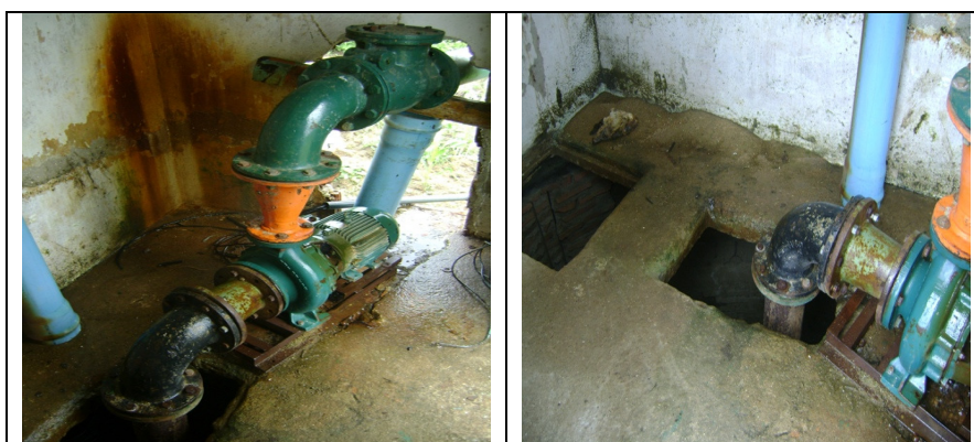
Fotos 6 e 7 – Detalhes do conjunto moto-bomba
