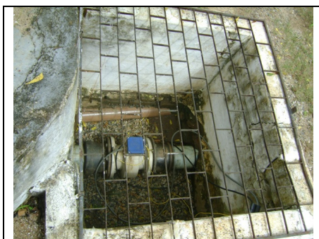
Foto 34 – Macromedidor na saída do RAP-01
