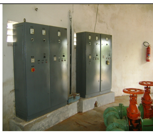
Foto 27 – Quadros de comando da EEAT-01 e da EELF-01
