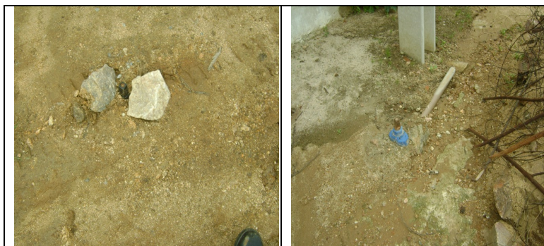
Fotos 42 e 43 – Dois registros de descarga na Rua Francisco Océlio Pitombeira
