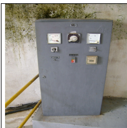
Foto 26 – Quadro de comando da EECS-01
