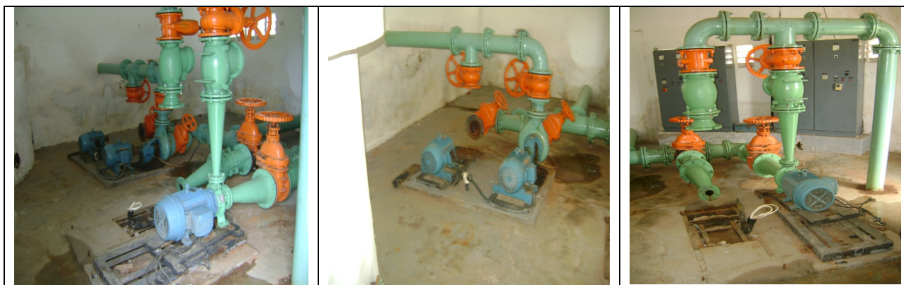
Fotos 23 a 25 – Detalhes dos conjuntos moto-bombas da EEAT-01 e da EELF-01
