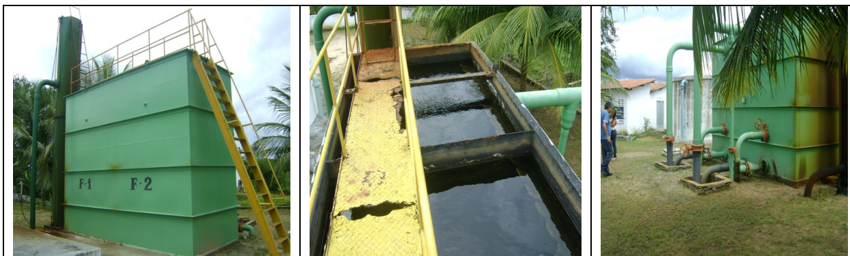
Foto 10 – Vista dos filtros e da torre de equilíbrio
