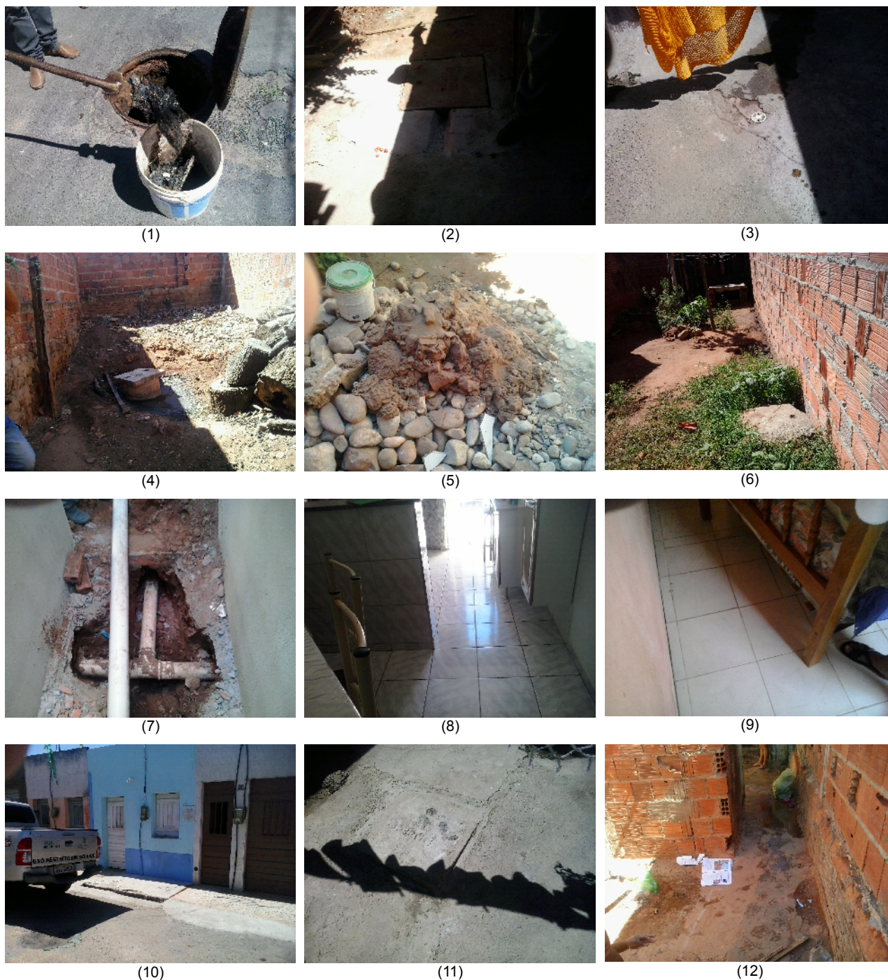
Figura 7 – Flagrantes de problemas no esgoto condominial, durante a inspeção in loco em diversas ruas.
