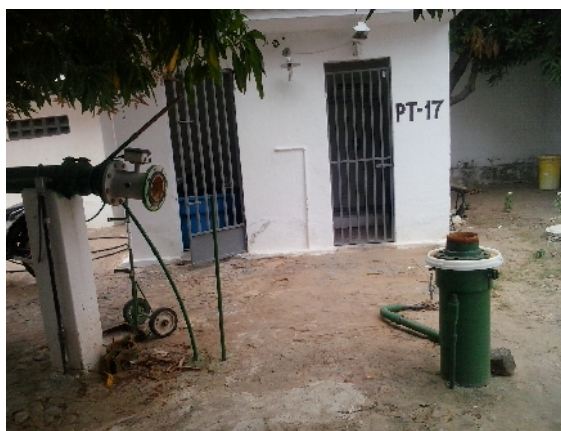
Figura 1 – Poço Tubular PT-17 (desativado).
