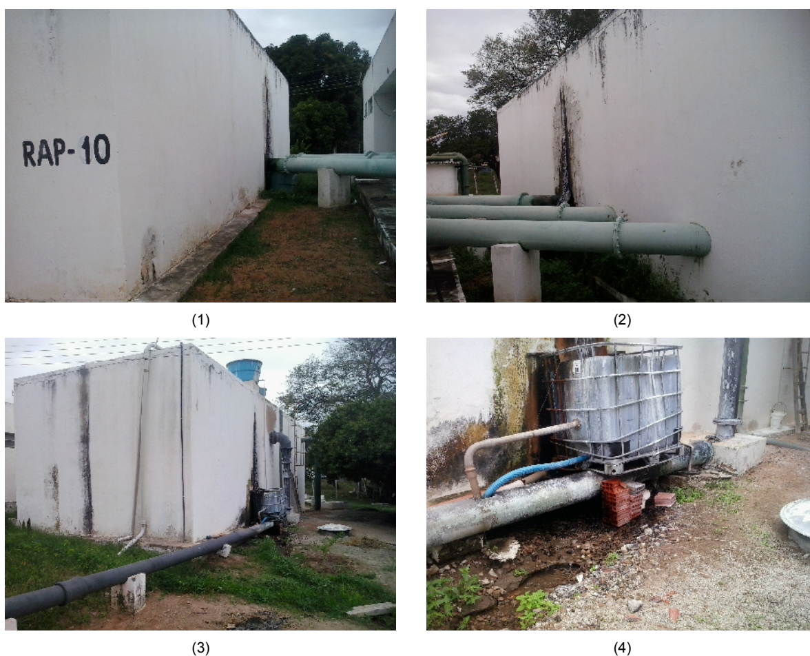
Figura 6 – RAP-10 com rachaduras e sistema de captação de vazamento, durante a inspeção in loco no Sítio dos Macacos.
