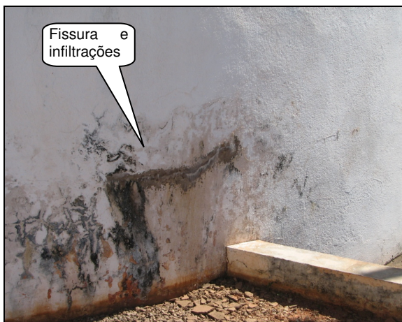
Foto 23 – RAP-01: fissura e ocorrência de infiltrações.
