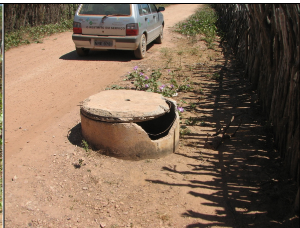
Foto 36 – Caixa de inspeção de registro de descarga da adutora de água tratada: danificada.
