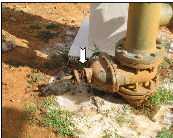
Foto 33 – REL-02: registro apresentando vazamento.
