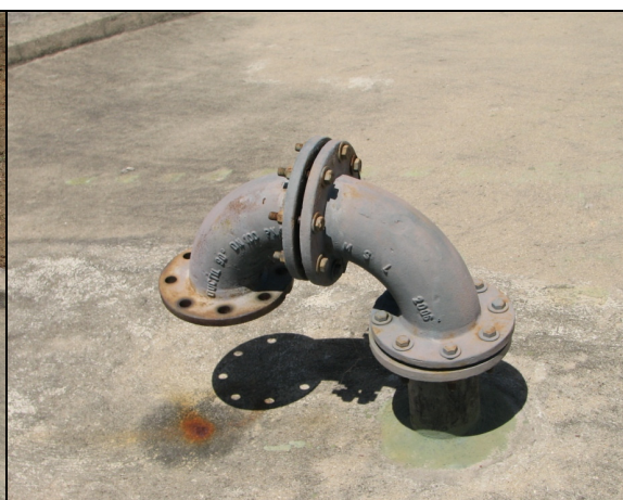
Foto 28 – RAP-02: tubulação de ventilação não telada.
