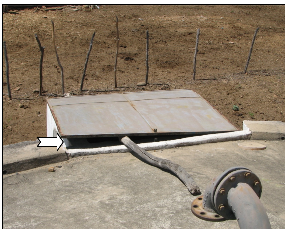
Foto 27 – RAP-02: tampa da caixa de entrada da água sem fechamento hermético.
