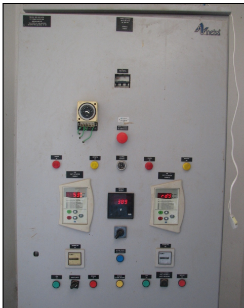
Foto 19 – Quadro de comando da EEAT-02.
