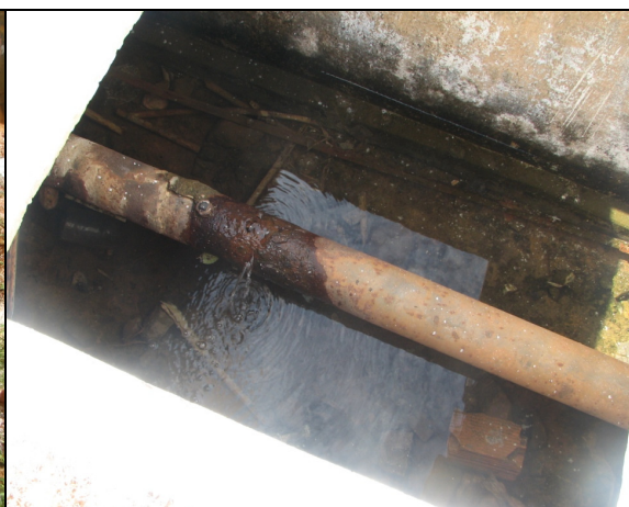
Foto 34 – REL-02: tubulação apresentando vazamento.
