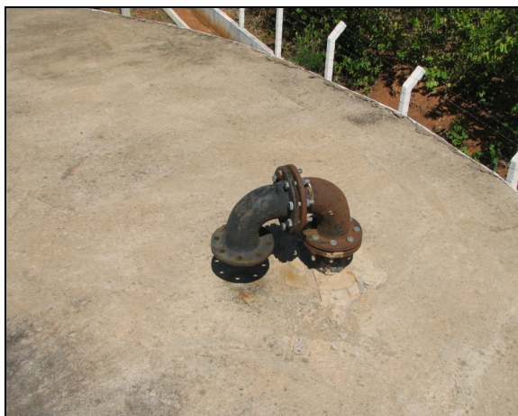
Foto 25 – RAP-01: tubulação de ventilação não telada.
