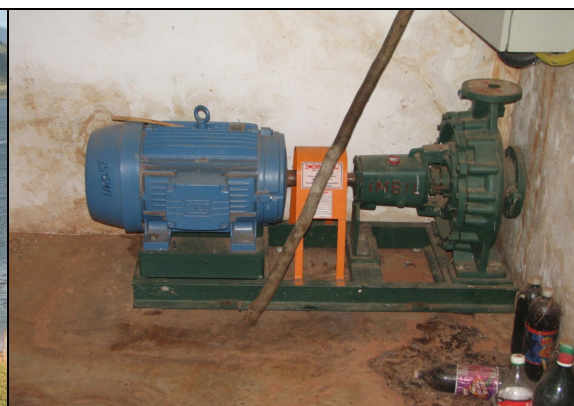
Foto 2 – Conjunto motor-bomba reserva da captação, armazenado na ETA.
