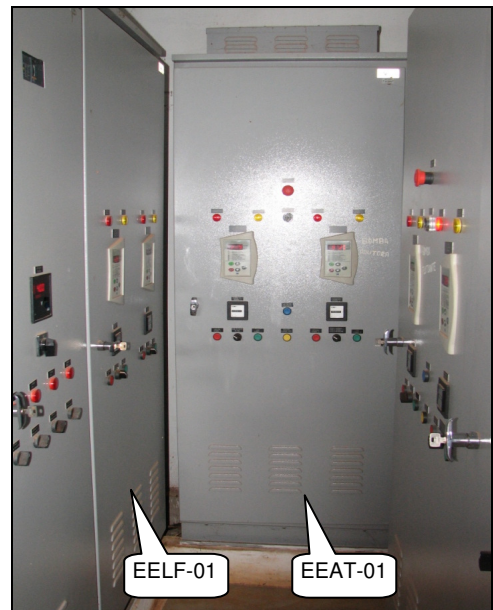
Foto 18 – Quadros de comando das EEAT-01 e EELF-01.
