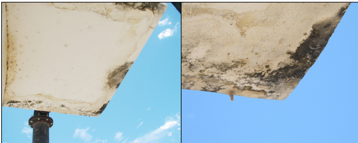
Fotos 29 e 30 – RAP-02: ocorrência de infiltrações no fundo da caixa de entrada.
