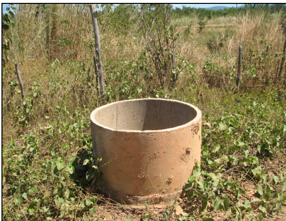
Foto 35 – Caixa de inspeção de registro de descarga da adutora de água tratada: sem tampa.
