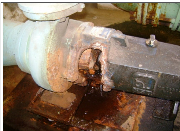
Foto 23 – Conjunto moto-bomba da EEAT-01 - com vazamento e corrosão
