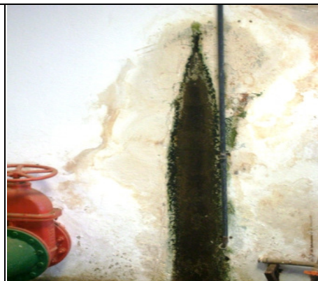
Foto 31 – RSE – sinais de vazamento
