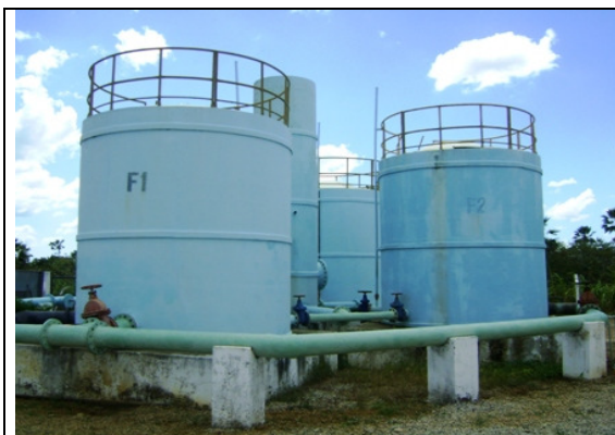
Foto 7 – Sistema de filtração da ETA de São Gonçalo do Amarante.
