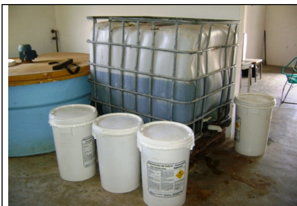
Foto 9 – Armazenamento inadequado de produtos químicos.
