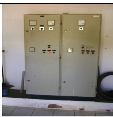
Foto 26 – Quadro de comando da EEAT-03 em boas condições
