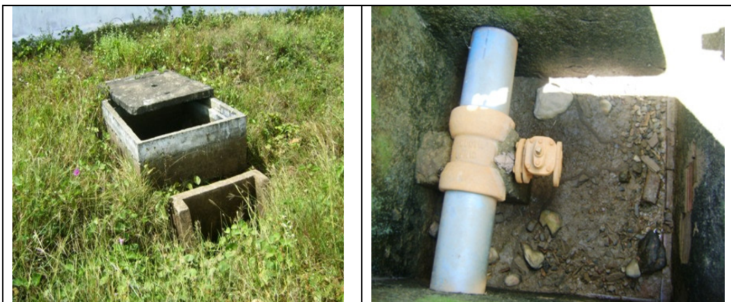
Fotos 46 e 47 – Caixas de registro de descarga da adutora de água tratada
