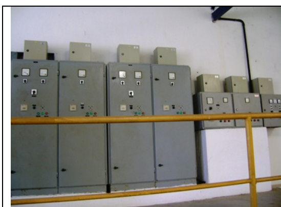
Foto 25 – Quadros de comando das elevatórias EEAB-01, EEAT-01 e EEAT-02
