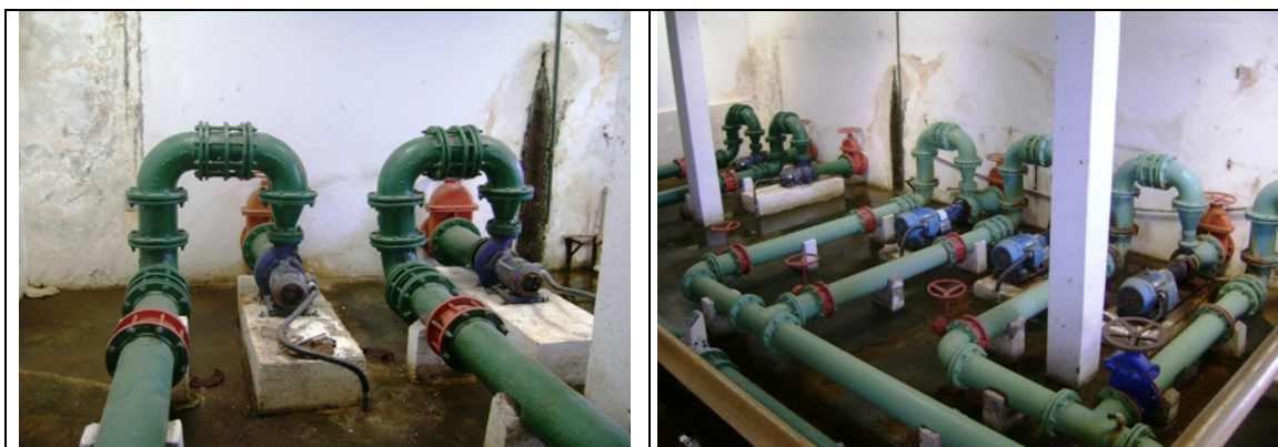
Fotos 21 e 22 – Elevatórias EEAB-01, EEAT-01 e EEAT-02 conjuntos motores-bomba
