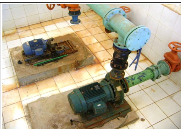
Foto 24 – EEAT-03 sem bomba reserva
