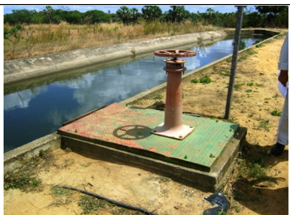
Foto 2 – Captação - canal de derivação – Açude Sítios Novos – ponto da tomada direta.
