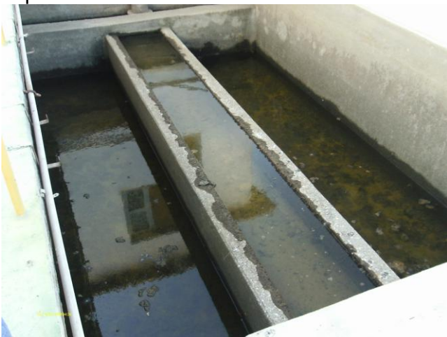
Foto 14 - ETA: Filtro F-03.
