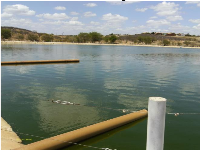
Foto 102 - ETE Maratoan: lagoa facultativa.
