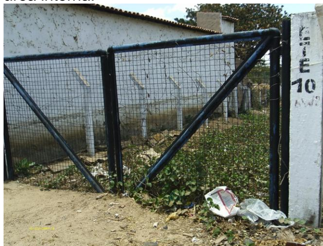
Foto 137 - ETE-10: identificação e vegetação excessiva na área interna.
