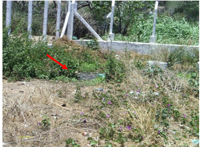
Foto 117 - Obstrução na chegada do esgoto bruto.
