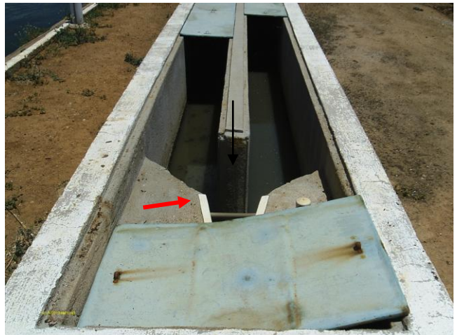
Foto 101 - ETE Maratoan: Calha Parshal.
