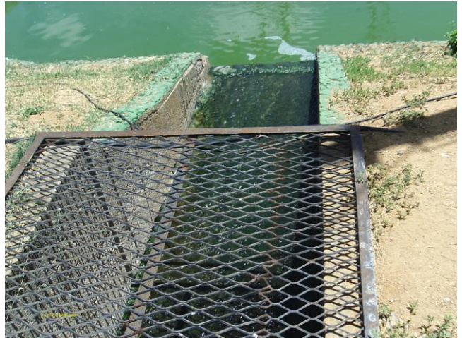
Foto 105 - ETE Maratoan: saída da lagoa de maturação.
