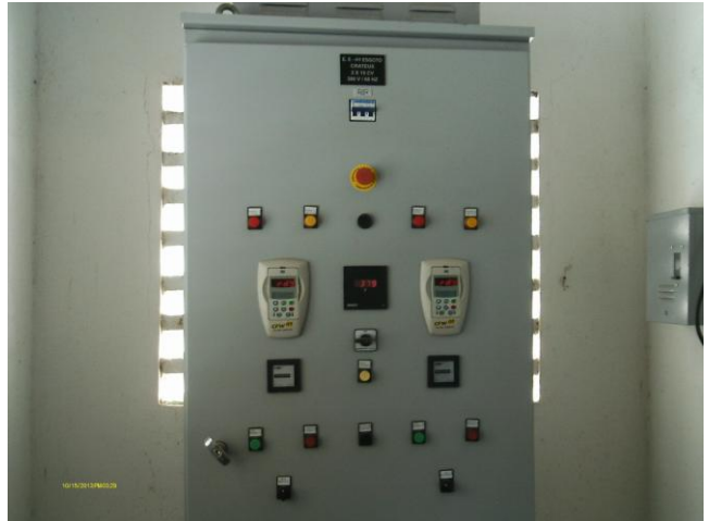
Foto 77 - EEE-H1: quadro de comando.
