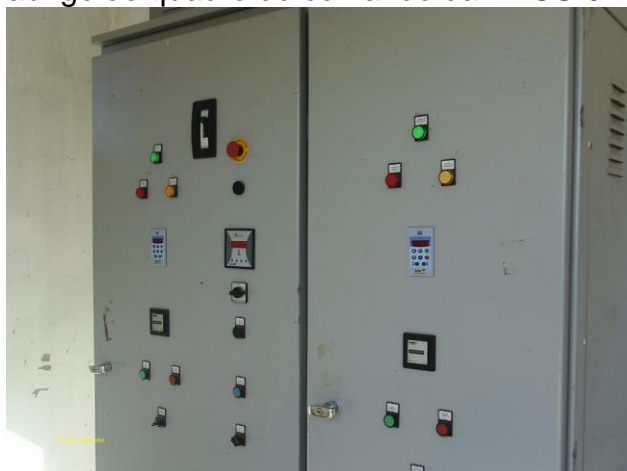
Foto 5 - Quadro de comando da EECS-01.
