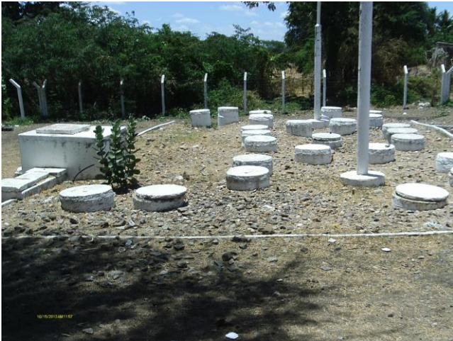
Foto 130 - ETE-07: Desinfecção desativada.
