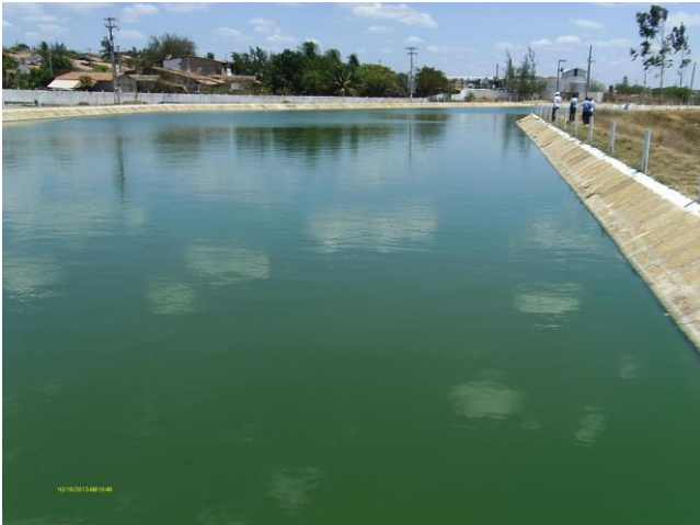
Foto 104 - ETE Maratoan: lagoa de maturação.
