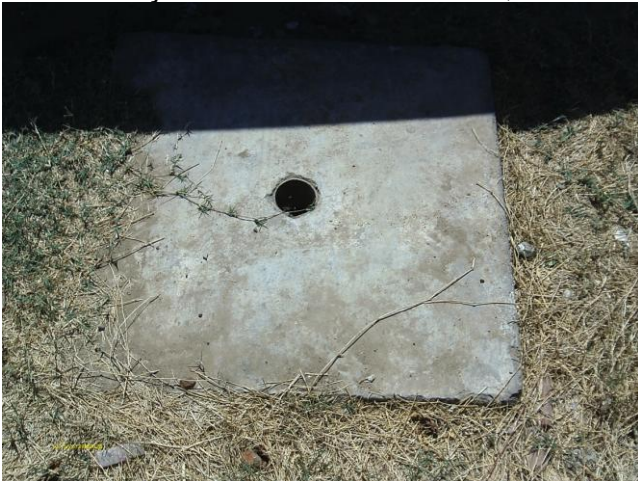
Foto 62 - Registro de descarga na rede de distribuição na Rua Maximiniano Barreto - Bairro Fátima II. (1)
