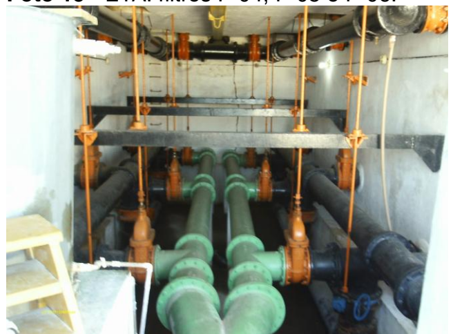
Foto 17 - ETA: tubulações dos filtros.
