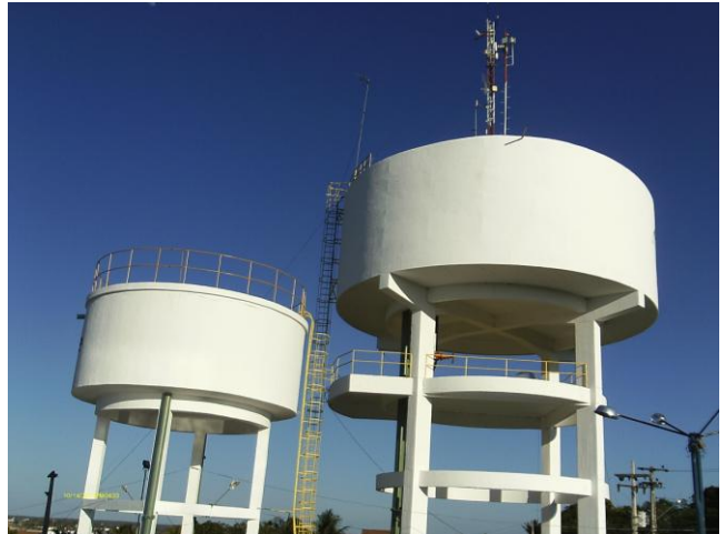
Foto 49 - REL-01 e REL-02: pára raios e sinalização noturna.
