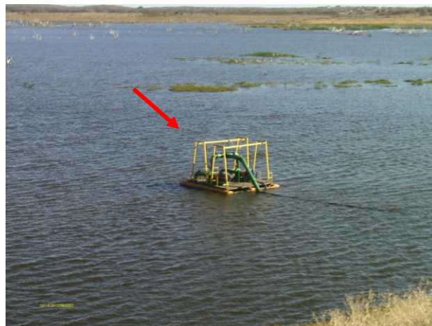
Foto 2 - Captação conjunta moto-bomba da EECS-01.
