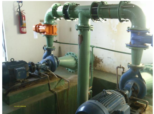
Foto 39 - EEAT-01: conjunto moto bomba.
