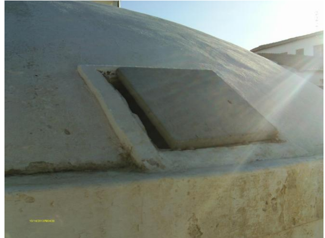
Foto 43 - RSE-01: tampa de inspeção.
