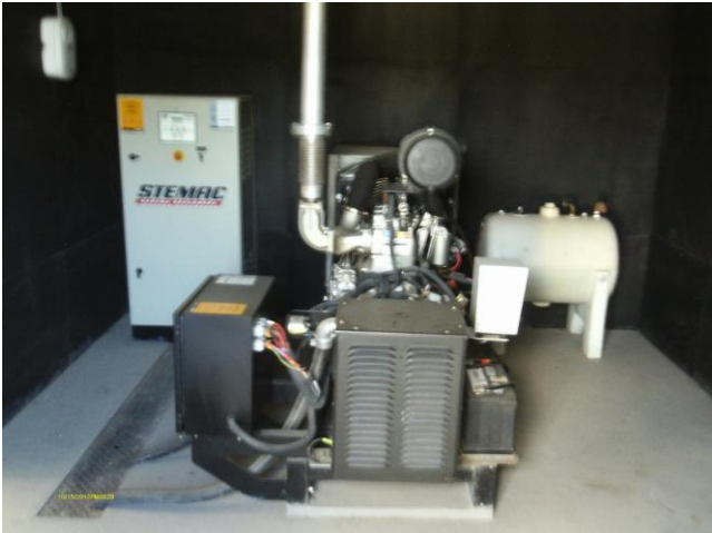
Foto 76 - EEE-H1: grupo gerador de energia elétrica.
