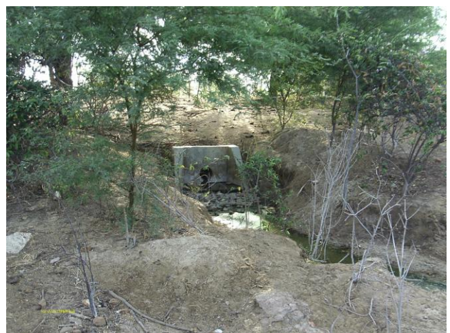
Foto 86 - ETE Revoltosos: saída do efluente tratado para o corpo receptor - Rio Poty.
