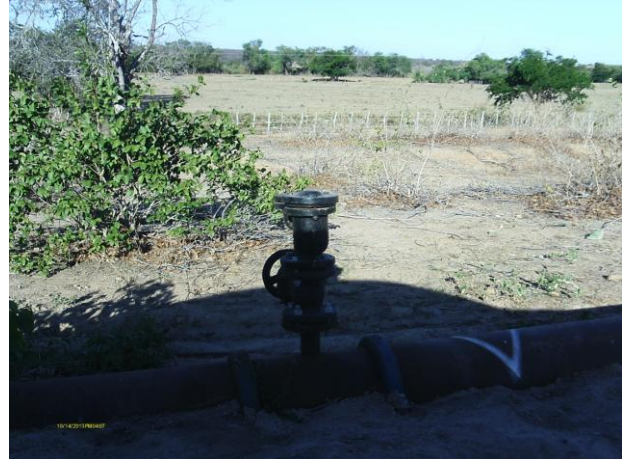
Foto 37 – AAB-01: ventosa sem proteção.
