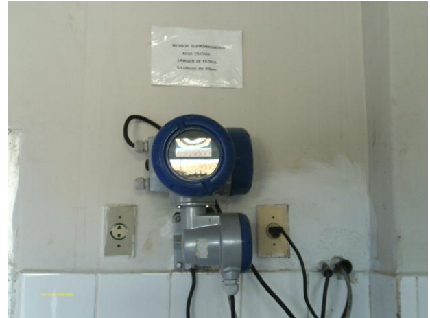
Foto 55 - Macromedidor de água tratada da lavagem de filtros.
