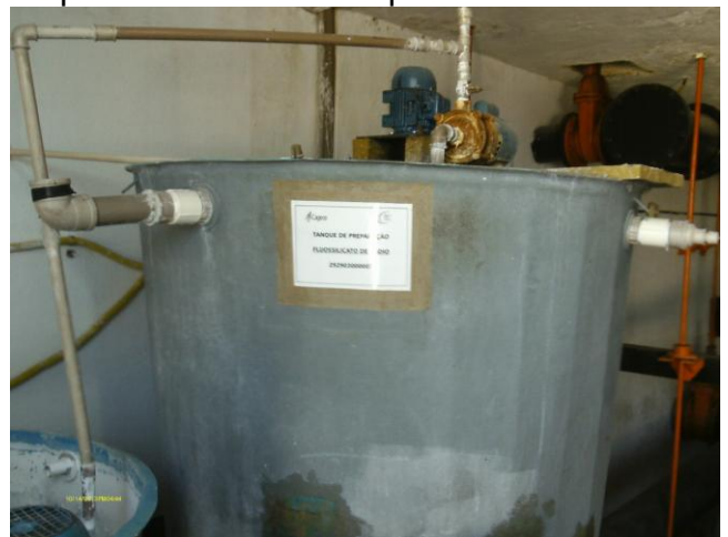
Foto 21 - Casa de química: tanque de dosagem de flúor.
