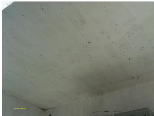
Foto 4 - Ausência de iluminação na casa de abrigo do quadro de comando da EECS-01.
