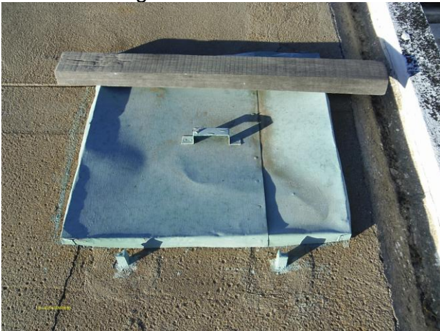
Foto 46 - RSE-02: tampa de inspeção.
