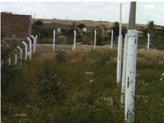
Foto 126 - ETE-05: Cerca danificada.
