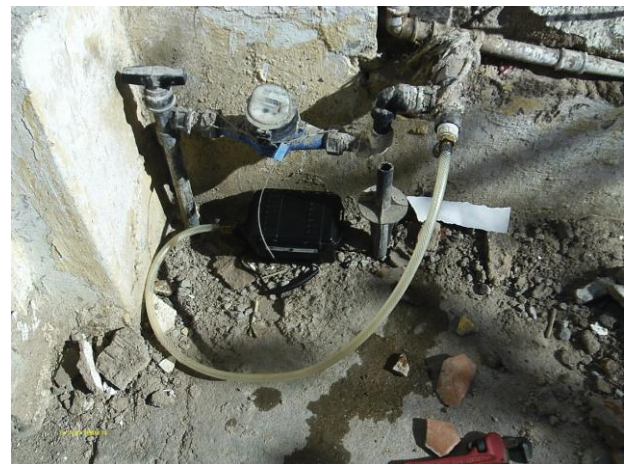
Foto 57 - Equipamento datalogger instalado no endereço: Rua Alexandre Bonfim, 399.
