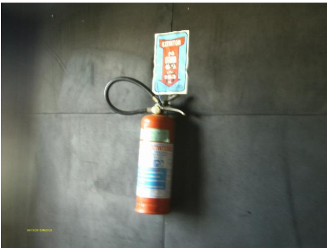
Foto 78 - EEE-H1: extintor de incêndio fora do prazo de validade.
