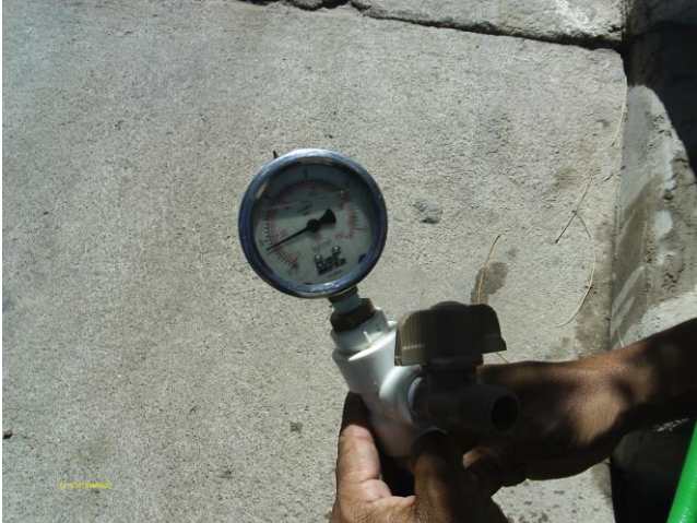
Foto 60 - Medição instantânea de pressão no endereço: Rua Gustavo Barroso, 2465.
