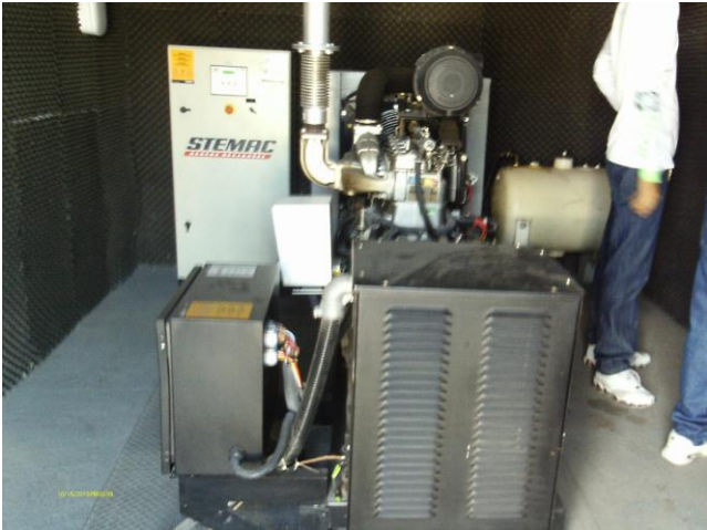
Foto 82 - EEE-G1 FINAL: grupo gerador de energia elétrica.
