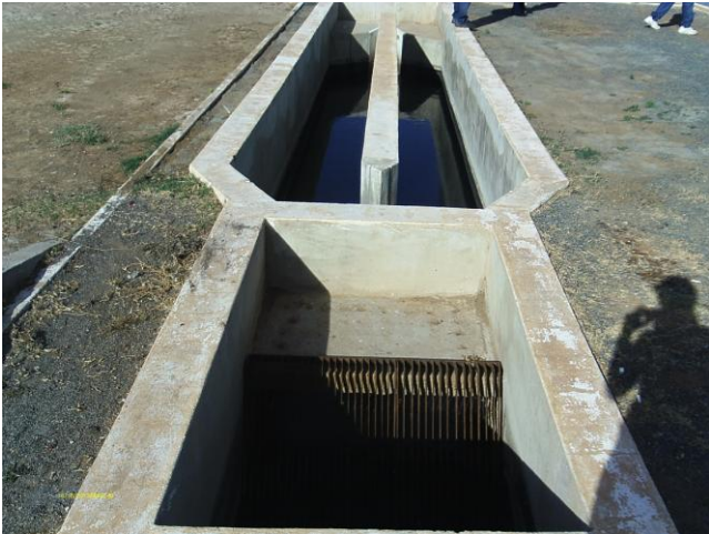
Foto 110 - ETE Revoltosos: gradeamento e Calha Parshal.
