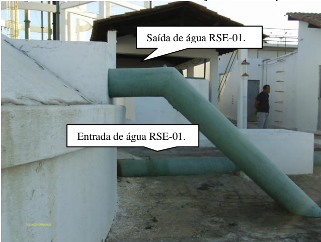
Foto 44 - RSE-01: tubulação de entrada e de saída de água.
