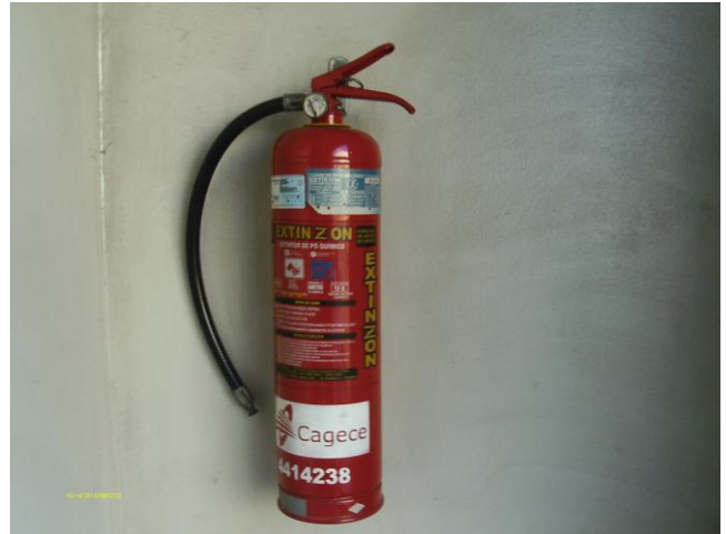
Foto 149 - Comercial: extintor de incêndio.
