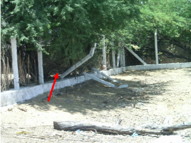
Foto 122 - ETE-03: cerca danificada.
