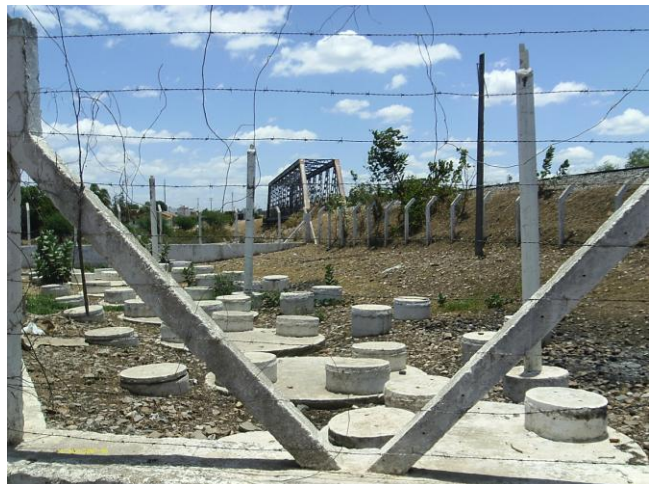
Foto 119 - ETE-02: Decanto digestores.
