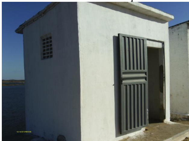
Foto 3 - Ausência de identificação na casa de abrigo do quadro de comando da EECS-01.
