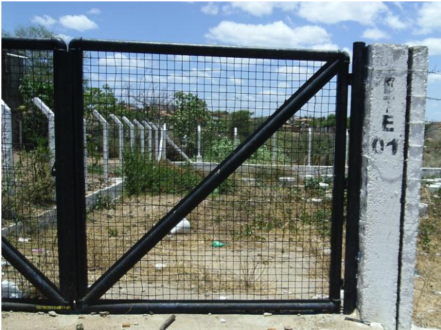
Foto 116 - ETE-01: identificação e vegetação excessiva na área interna.
