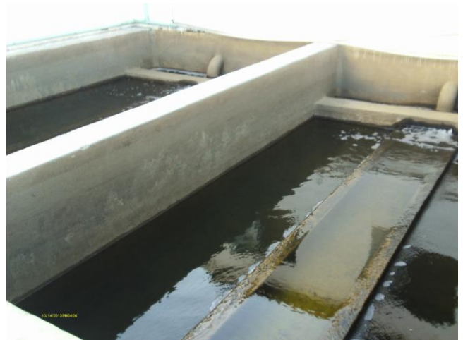
Foto 13 - ETA: filtros F-01 e F-02.
