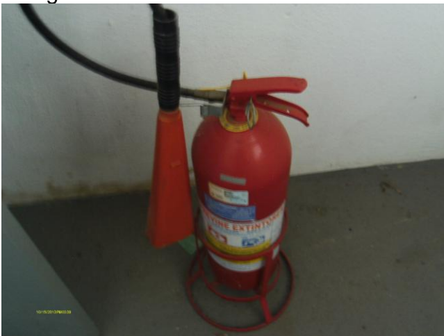
Foto 84 - EEE-G1 FINAL: extintor de incêndio fora do prazo de validade.
