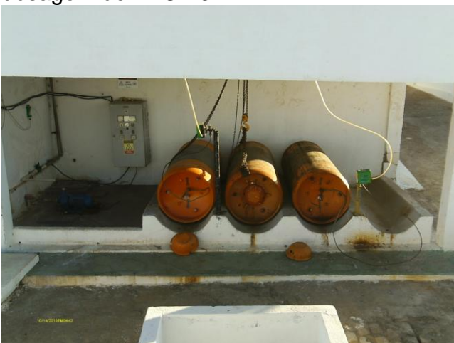
Foto 22 - Casa de química: armazenamento de cloro gasoso.
