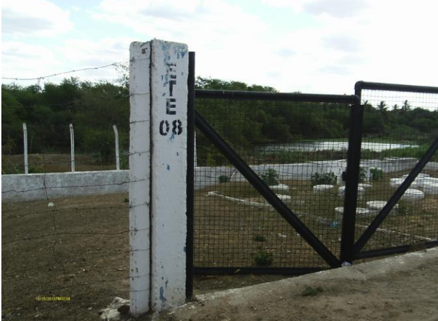
Foto 132 - ETE-08: identificação e portão quebrado.
