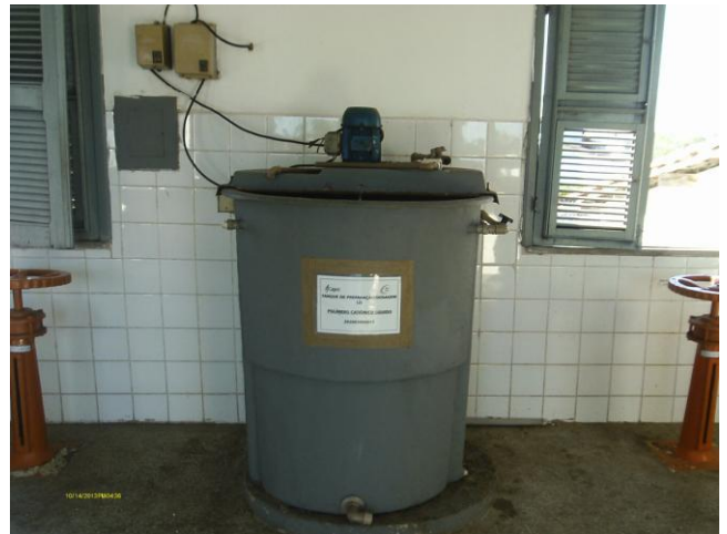
Foto 19 - Casa de química: tanque dosador de polímero catiônico líquido.
