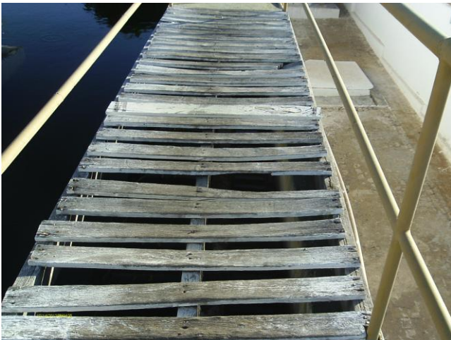
Foto 12 - ETA: passarela de madeira improvisada na área dos decantadores.
