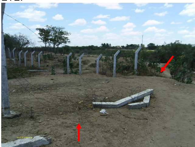
Foto 138 - ETE-10: cerca danificada.
