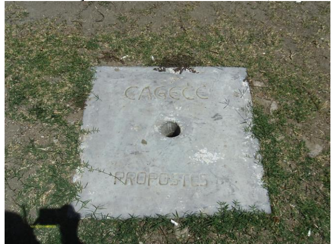
Foto 63 - Registro de descarga na rede de distribuição na Rua Jacob de Melo - Bairro São Vicente. (2)
