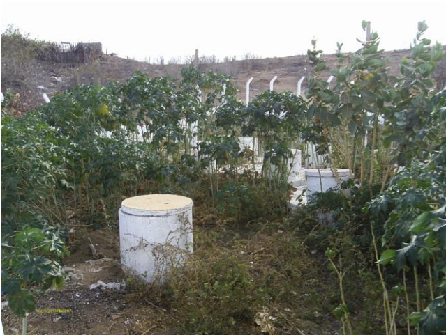
Foto 140 - ETE-12: vegetação excessiva na área interna.
