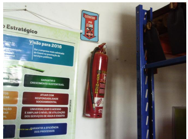
Foto 157 - Almojarifado: extintor de incêndio.
