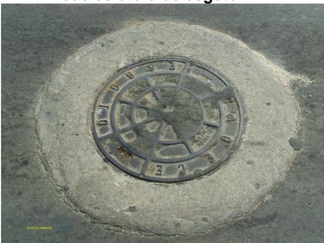
Foto 69 - Poço de visita na Avenida Frei Vidal da Penha.
