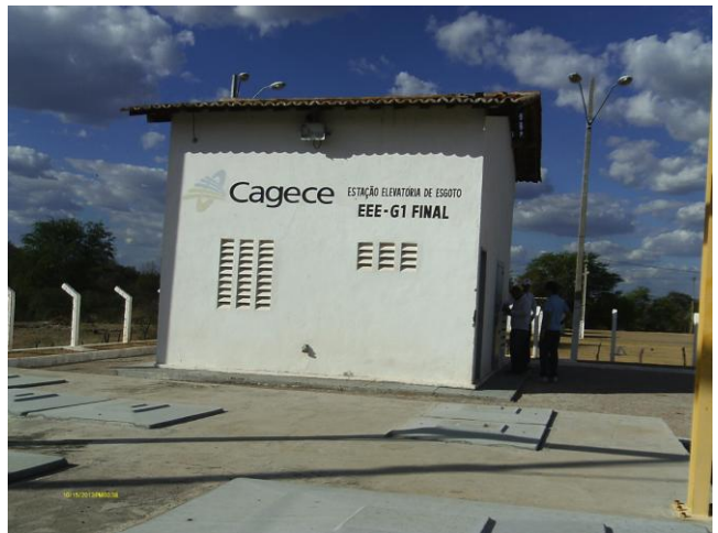
Foto 79 - EEE-G1 FINAL: identificação e poço de sucção coberto.
