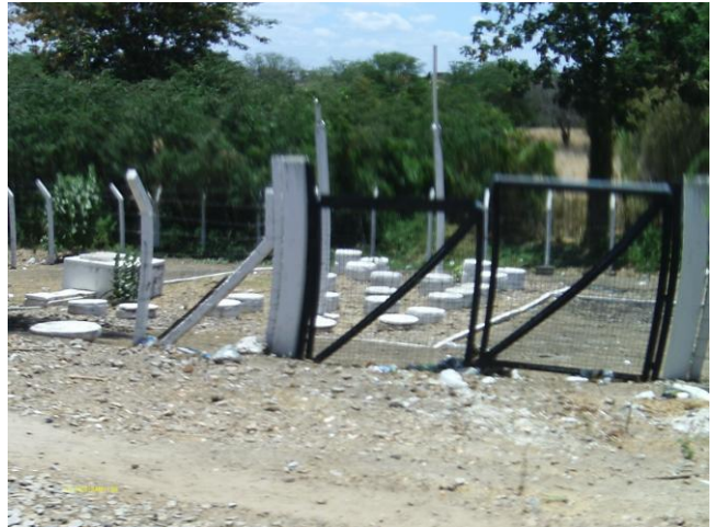
Foto 129 - ETE-07: ausência de identificação.
