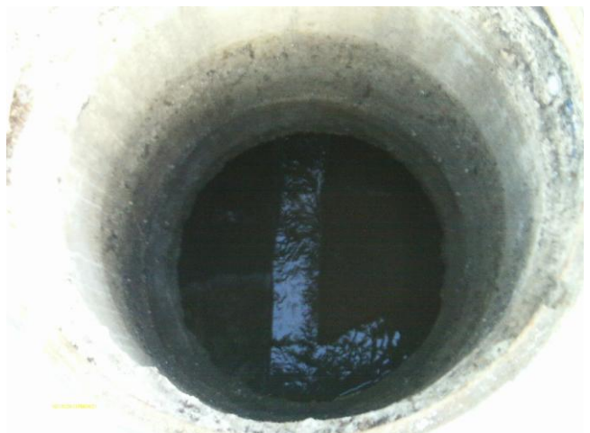
Foto 70 - Poço de visita na Avenida Frei Vidal da Penha.
