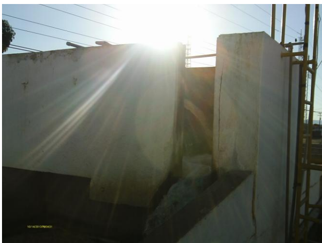
Foto 8 - ETA: entrada da água bruta.
