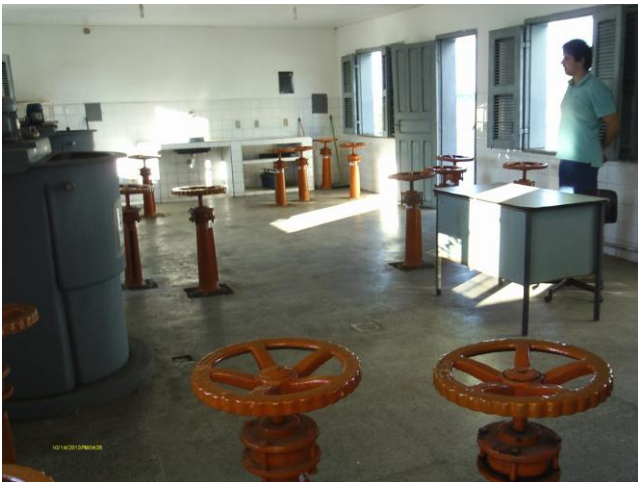
Foto 18 - ETA: registros dos filtros.
