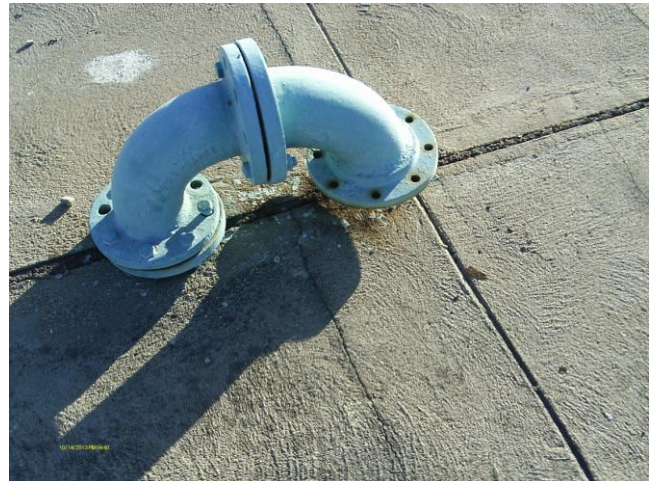
Foto 47 - RSE-02: tubulação de ventilação sem tela de proteção.
