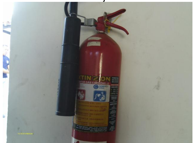
Foto 41 - EEAT-01: extintor de incêndio.
