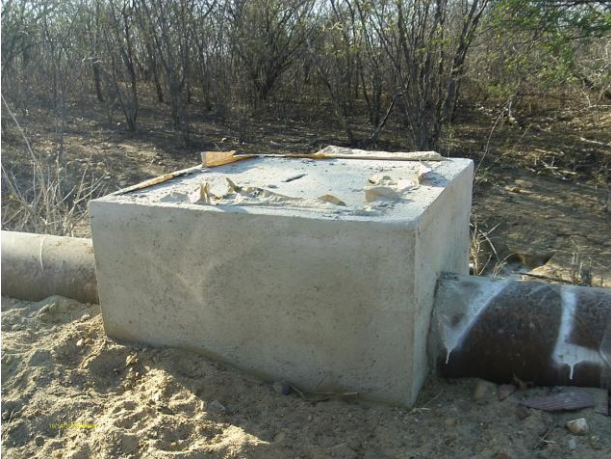
Foto 36 – AAB-01: descarga protegida por caixa.
