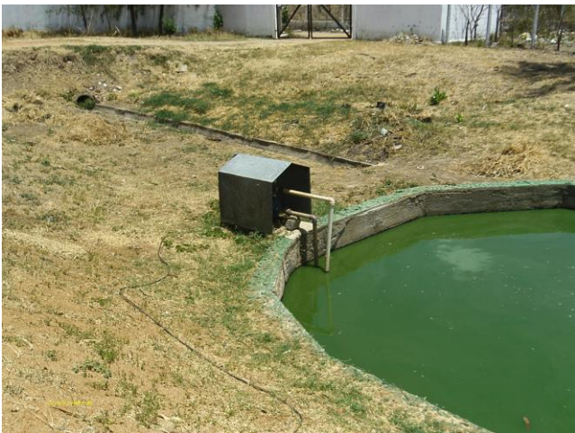
Foto 106 - ETE Maratoan: bomba de reúso.
