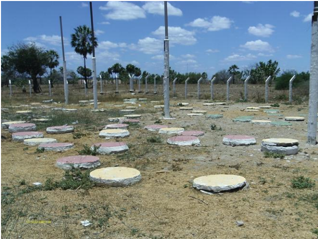
Foto 128 - ETE-06: Decanto digestores.
