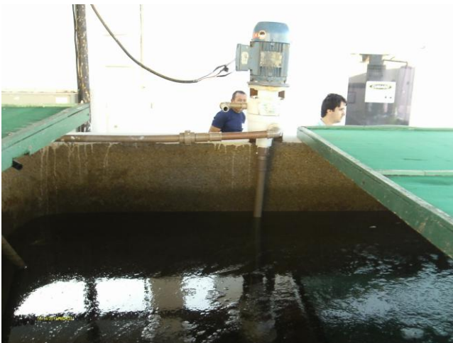
Foto 20 - Casa de química: tanque de dosagem de PAC-23.
