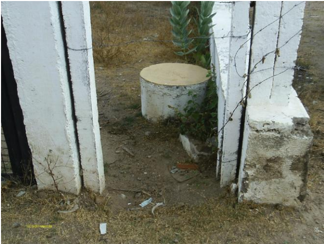
Foto 124 - ETE-04: cerca danificada.
