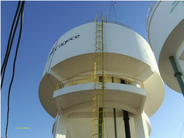
Foto 50 - REL-02: ausência de identificação, presença de escada de acesso e guarda-corpos.
