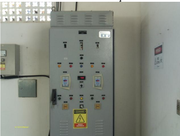
Foto 40 - EEAT-01: quadro de comando.
