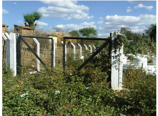
Foto 141 - ETE-13: identificação, portão quebrado e vegetação excessiva na área interna.
