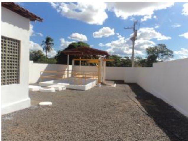
Foto 11 – EEE-Manoel Santana: ausência de iluminação.
