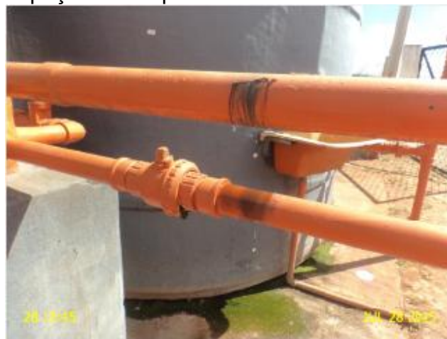
Foto 14 – ETE-Mutirão: vazamento na tubulação.
