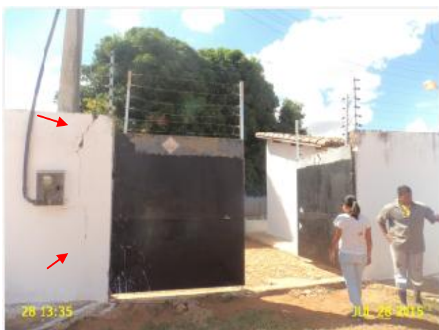
Foto 3 – ETE-Mutirão: ausência de identificação e rachadura no muro.
