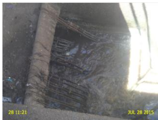
Foto 4 – ETE-Vila Fátima: gradeamento deteriorado.
