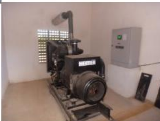
Foto 5 – EEE: ausência de bateria.
