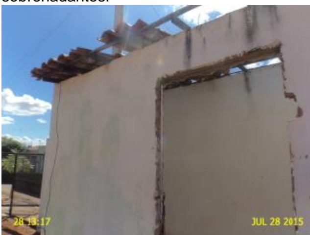
Foto 20 – ETE-PROURB: casa de abrigo deteriorada, sem telhado e sem portão.
