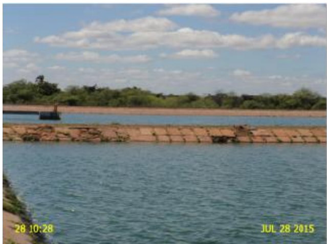
Foto 17 – ETE-Malvas: LF1 com taludes deteriorados.
