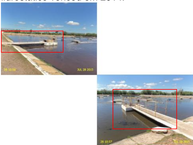
Foto 15 – ETE-Malvas: guarda corpos em processo de corrosão.
