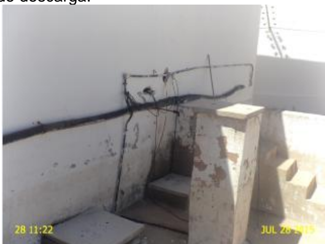
Foto 9 – EEE-Vila Fátima: reboco deteriorado e instalações elétricas inadequadas.
