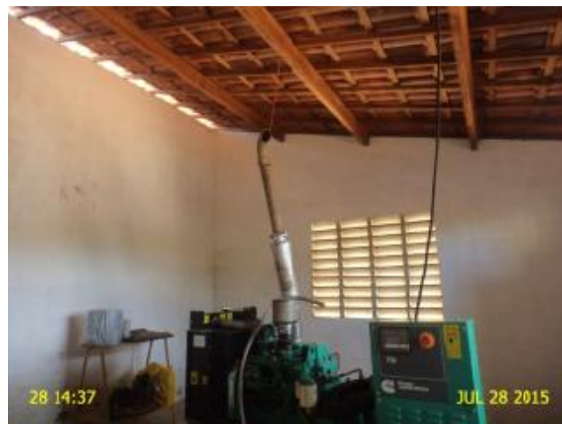
Foto 6 – EEE-Almino Loiola: ausência de bateria e cano de descarga adequado.
