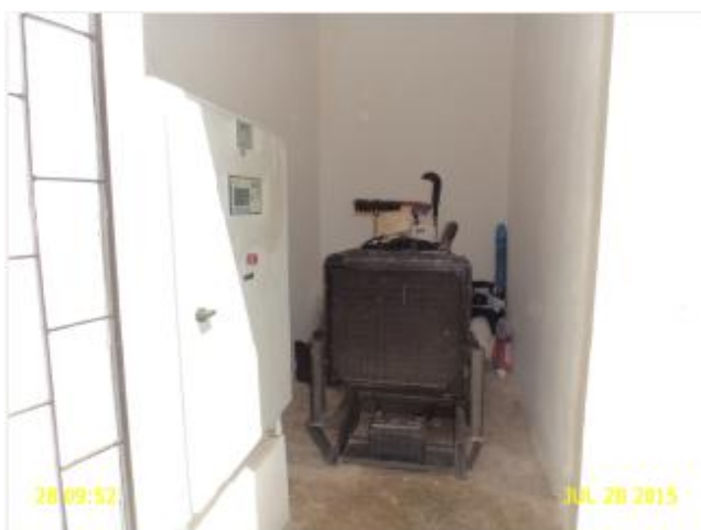
Foto 7 – EEE-Três Marias: ausência de cano de descarga.
