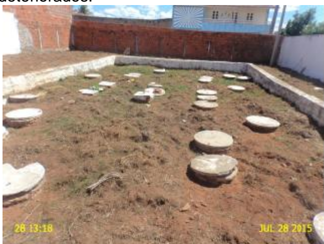
Foto 19 – ETE-PROURB: tampas deterioradas.
