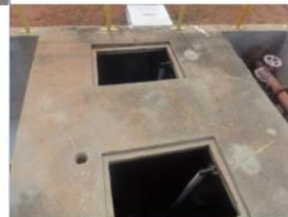
Foto 10 – EEE: poços de sucção sem tampa.
