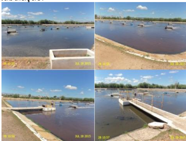
Foto 16 – ETE-Malvas: aeradores sem funcionar.
