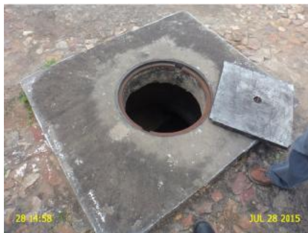
Foto 12 – EEE-Salesianos: tampa de inspeção inadequada.
