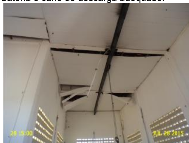
Foto 8 – EEE-Salesianos: teto deteriorado com colméia de vespas.
