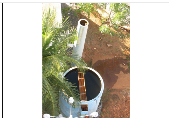
Foto 7 – Torre de nível e filtro – sem tampas.
