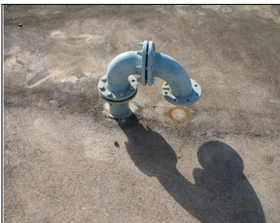
Foto 28 – RAP-01: tubulação de ventilação sem tela de proteção.
