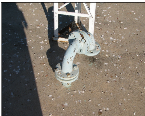
Foto 36 – REL-01: fezes de aves na laje de cobertura.
