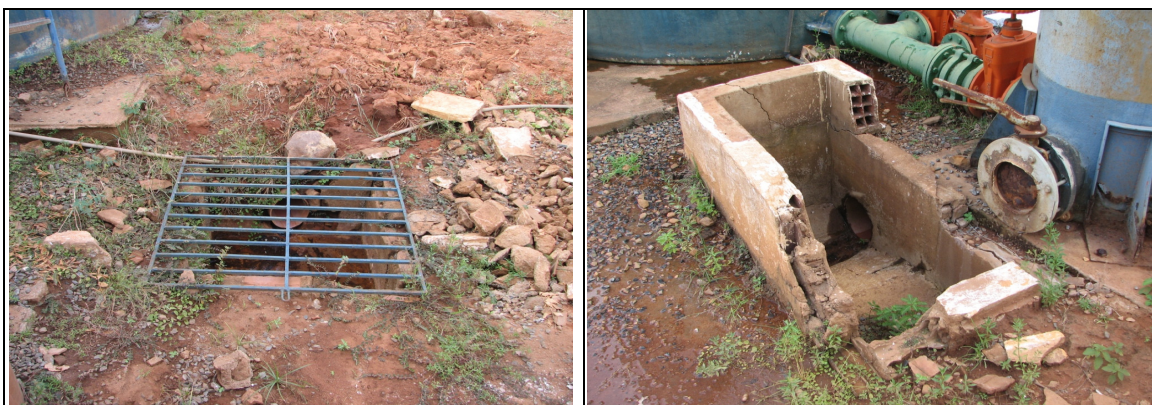
Foto 10 – Caixa de drenagem da ETA - quebrada.
