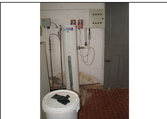
Foto 17 – Sistema de fluoretação em funcionamento.
