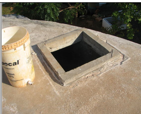
Foto 27 – RAP-01: sem tampa de inspeção.
