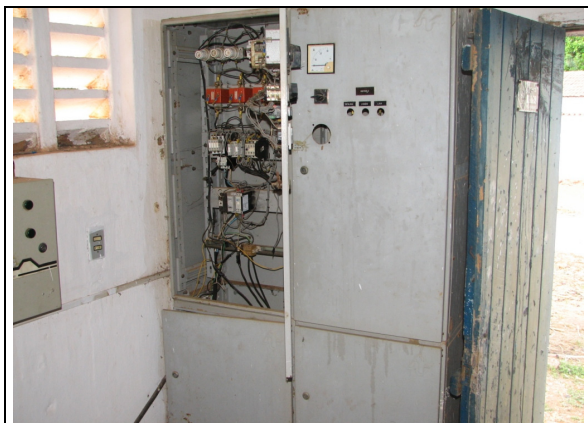
Foto 22 – EECS-01 – quadro de comando sem limpeza e pintura.
