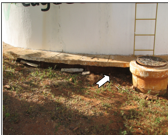
Foto 30 – RAP-01: afundamento do aterro da base do reservatório.
