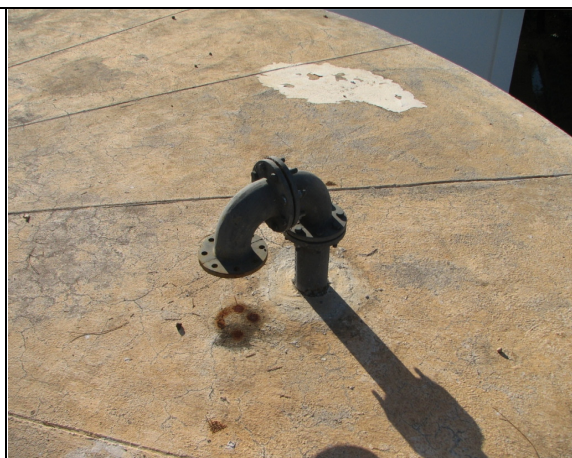
Foto 33 – RAP-02: tubulação de ventilação sem tela de proteção.
