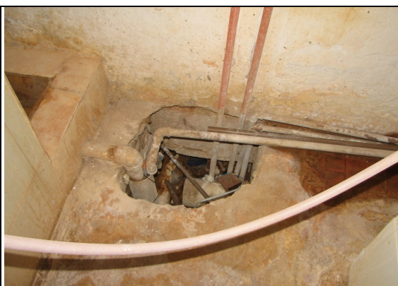
Foto 19 – Abertura no piso próxima aos tanques de dosagem.
