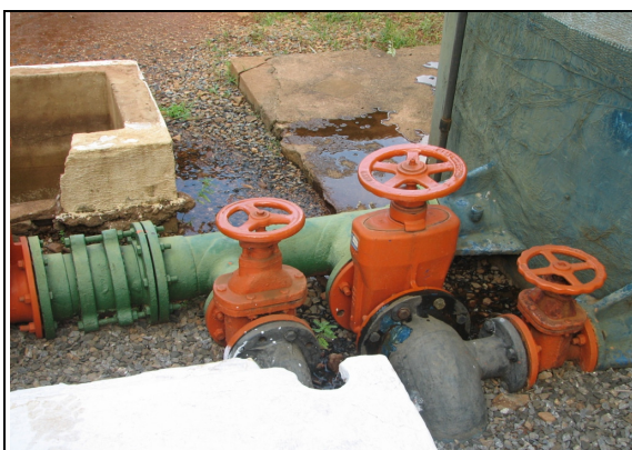
Foto 8 – Registro da junção do barrilete – com vazamento.
