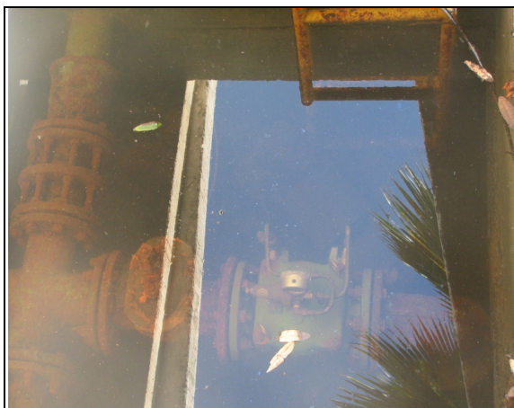
Foto 40 – Caixa de localização de registros e ventosas - inundada.
