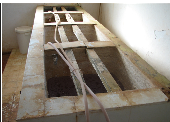
Foto 15 – Tanques de dosagem sem agitadores mecânicos.
