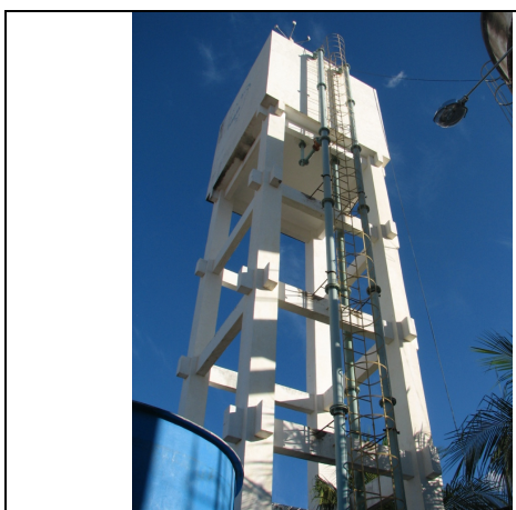
Foto 34 – REL-01: sem identificação/numeração e guarda corpo na laje de cobertura.
