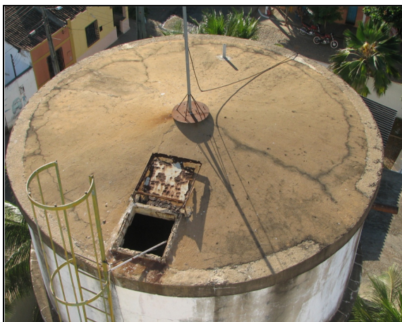
Foto 38 – REL-02: tampa de inspeção deteriorada e tubulação de ventilação inadequada.
