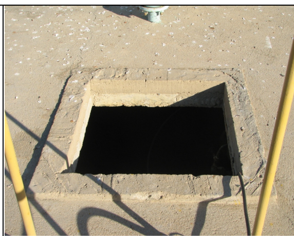
Foto 35 – REL-01: sem tampa de inspeção.
