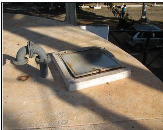
Foto 32 – RAP-02: tampa de inspeção – pintura deteriorada.
