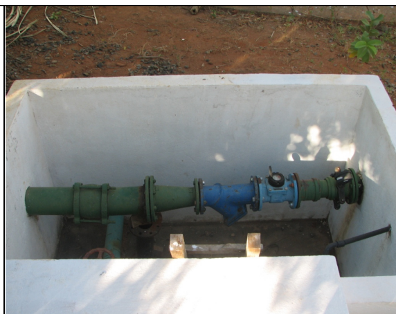
Foto 41 – Macromedidor do volume produzido na captação do Açude Municipal.
