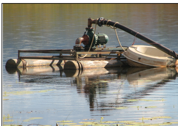
Foto 1 – Captação: flutuante e conjunto motor-bomba.
