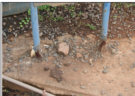
Foto 6 – Filtro – escada sem fixação de apoio.
