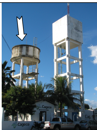
Foto 37 – REL-02: sem identificação/numeração e pintura deteriorada.
