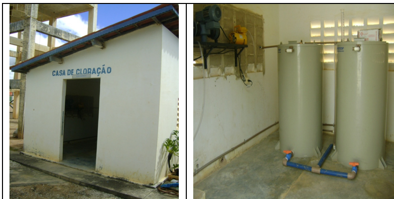
Fotos 6 e 7 – Sistema de cloração
