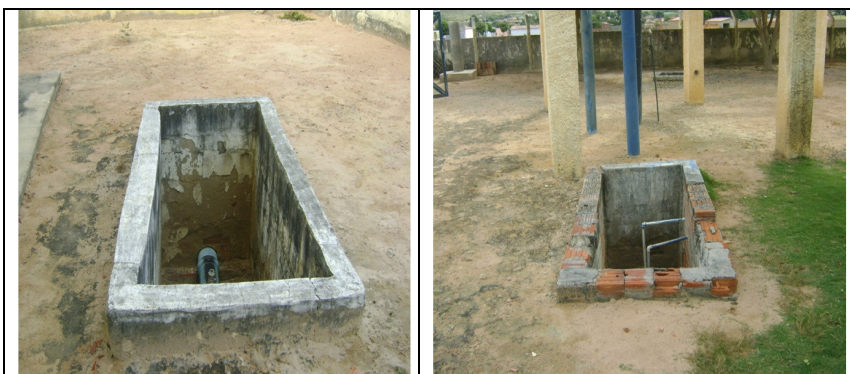
Fotos 11 e 12 – Caixas de proteção sem tampas
