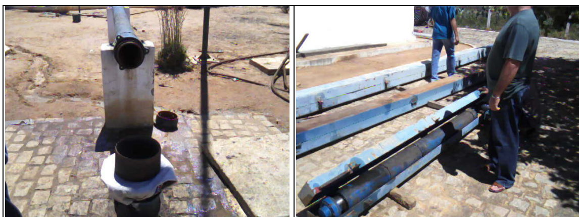
Fotos 4 e 5 – O poço PT-04 e a bomba de multi-estágios em manutenção
