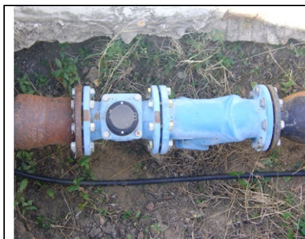
Foto 54 – Macromedidor na saída da EEAT-02
