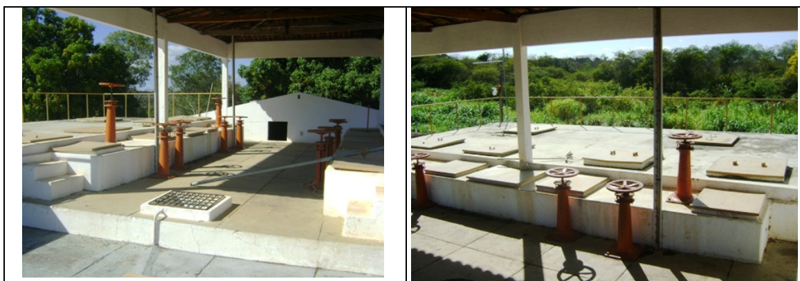
Fotos 5 e 6 – Vistas dos filtros
