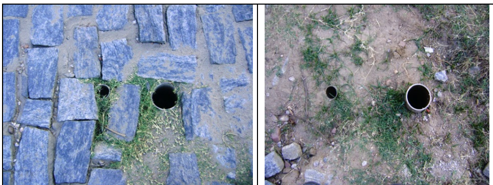
Fotos 56 e 57 – Registros de descarga nas Ruas Antonio Martins Bandeira e Joel Silva Nunes
