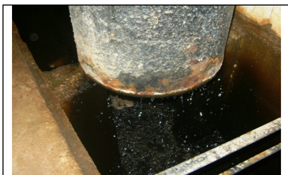
Foto 7 – Vazamento nos registros dos filtros
