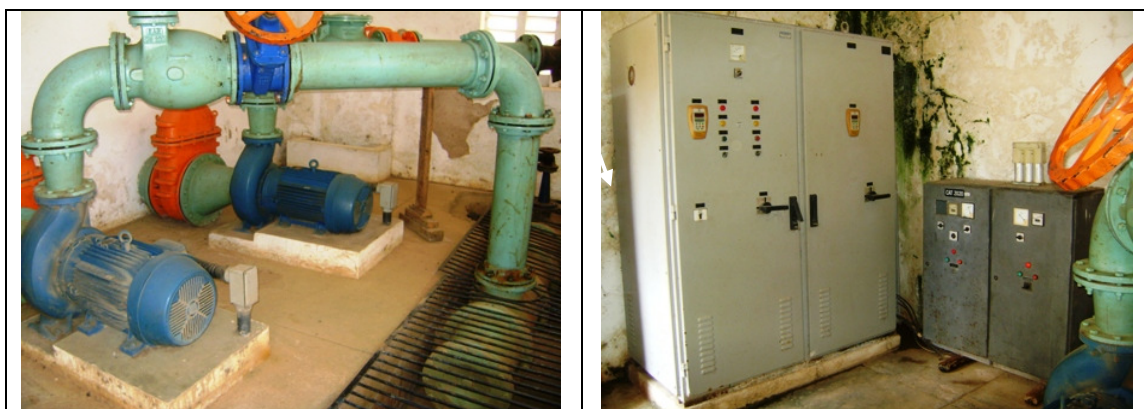
Fotos 19 e 20 – EEAT-01: motores-bomba e quadro de comando
