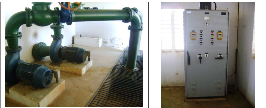
Fotos 17 e 18 – EEAB-01: motores-bomba e quadro de comando
