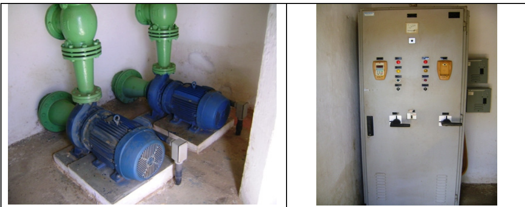
Fotos 21 e 22 – EEAT-02: motores-bomba e quadro de comando
