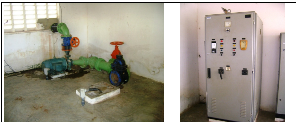
Fotos 25 e 26 – EEAT-04: motores-bomba e quadro de comando
