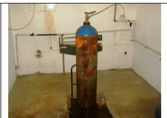
Foto 9 – Sistema de dosagem de cloro gasoso inoperante
