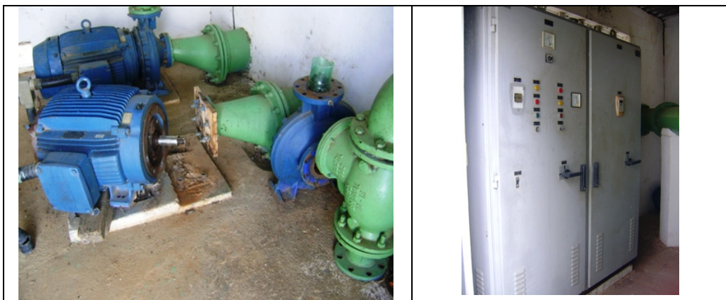
Fotos 23 e 24 – EEAT-03: motores-bomba e quadro de comando
