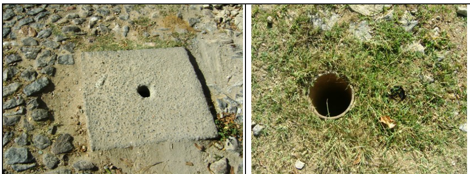
Fotos 62 e 63 – Registros de descarga na Rua Jaca Paraiba
