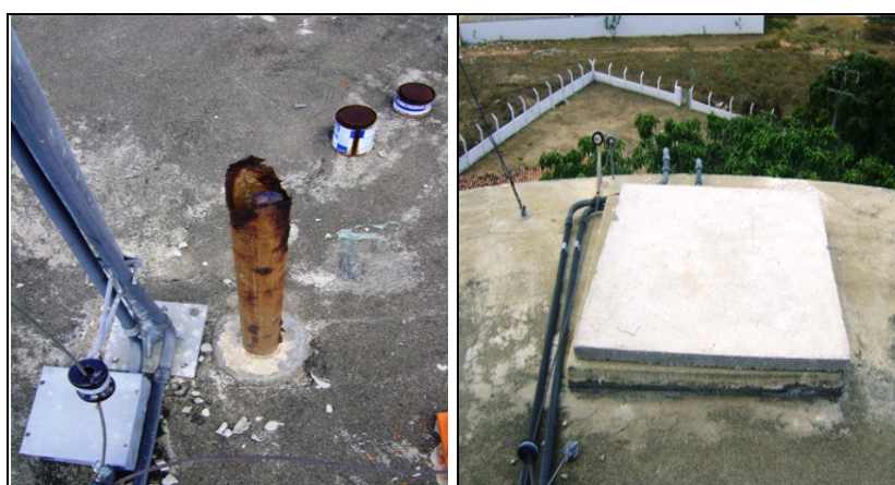
Fotos 43 e 44 – Vistas superiores do REL-01
