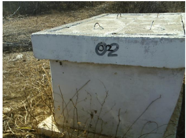
Foto 31 - AAB-01: descarga com caixa de proteção instalada na adutora.
