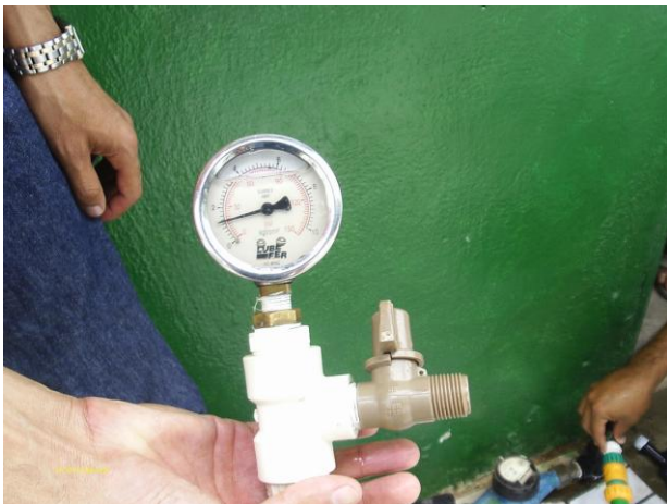
Foto 57 - Medição instantânea de pressão na rede de distribuição na Rua 7, FNS 2125.
