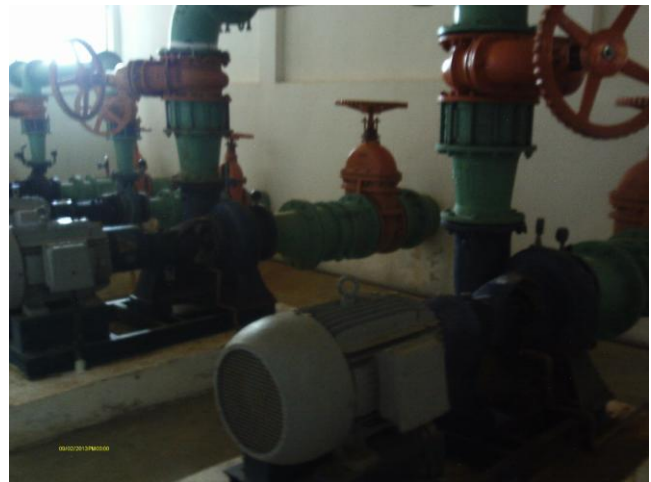
Foto 39 - EELF-01: conjunto moto bomba.
