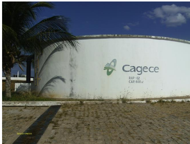
Foto 42 - RAP-02: pintura deteriorada.
