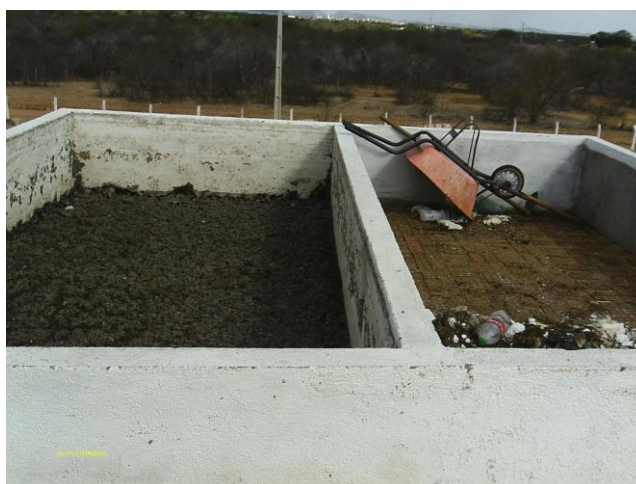
Foto 98 - ETE: leitos de secagem.
