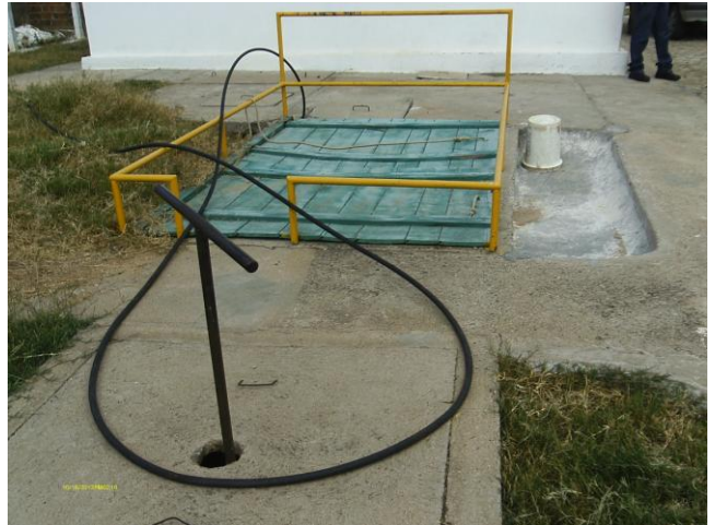
Foto 84 - EEE-02: poço de sucção com c.
