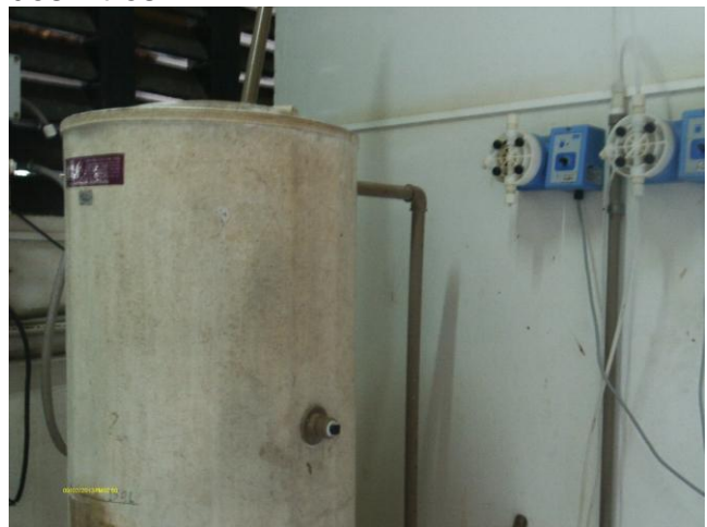
Foto 18 - Casa de química: tanque de dosagem.
