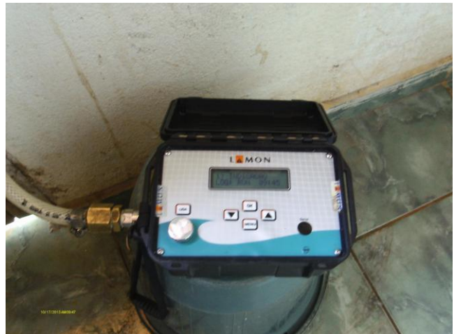
Foto 54 - Aparelho de medição contínua de pressão datalogger instalado em uma residência na Rua SDO, 242 - Santa Rita.
