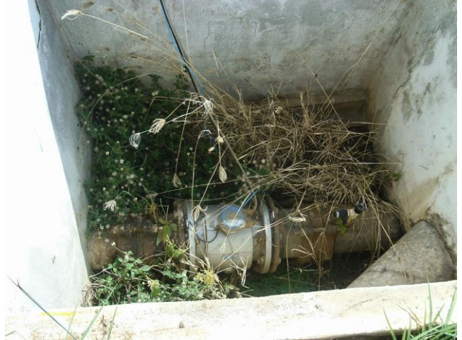
Foto 8 - ETA: medidor instalado na chegada da água bruta.
