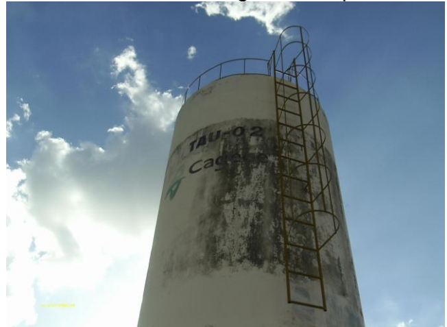
Foto 35 - TAU-02: pintura deteriorada e escada com guarda corpo.
