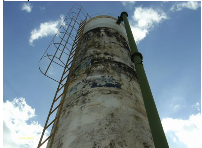
Foto 33 - TAU-01: pintura deteriorada e escada de acesso com guarda corpo.
