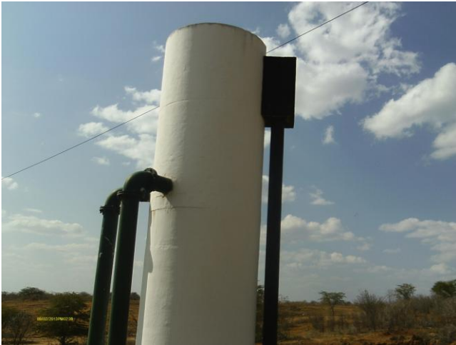
Foto 9 - ETA: torre de equilíbrio.
