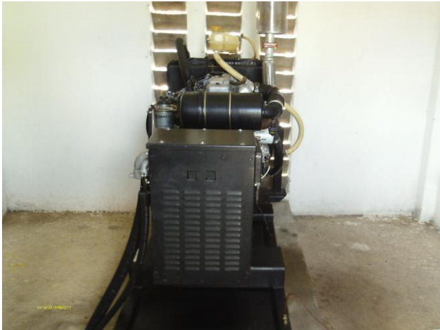
Foto 87 - EEE-02: grupo gerador de energia elétrica.
