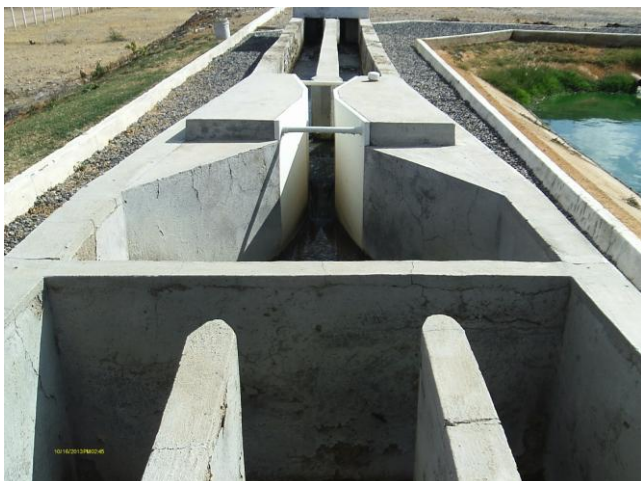
Foto 93 - ETE: gradeamento e calha Parsall.
