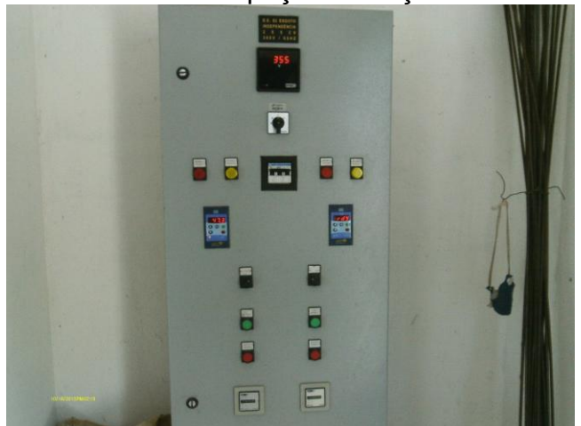
Foto 86 - EEE-02: quadro de comando das bombas.
