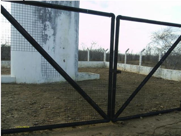
Foto 34 - TAU-02: portão danificado.
