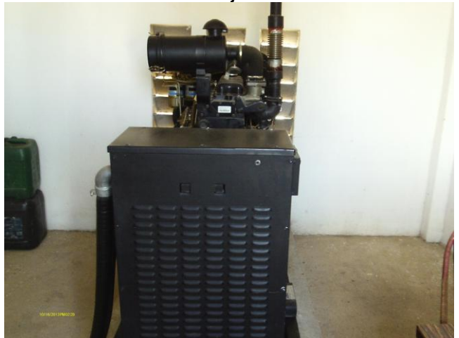
Foto 80 - EEE-01: grupo gerador de energia elétrica.
