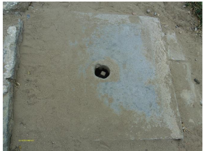
Foto 62 - Registro de descarga na rede de distribuição: Rua Pelo Sinal (1).
