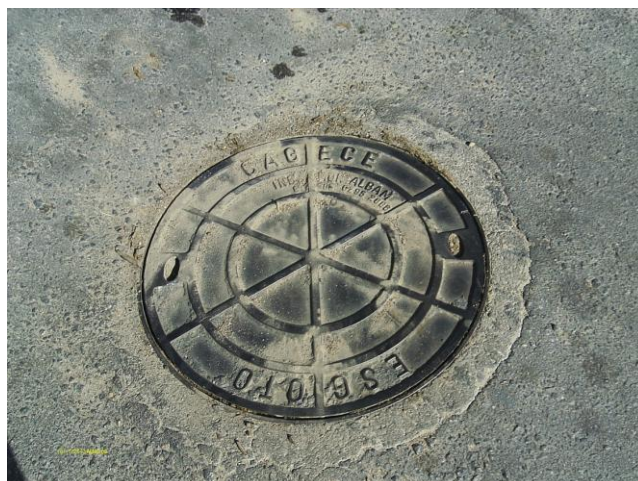
Foto 73 - PV na Rua Santa Terezinha.
