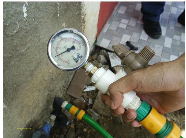
Foto 58 - Medição instantânea de pressão na rede de distribuição na Rua Rua Marechal Humberto.
