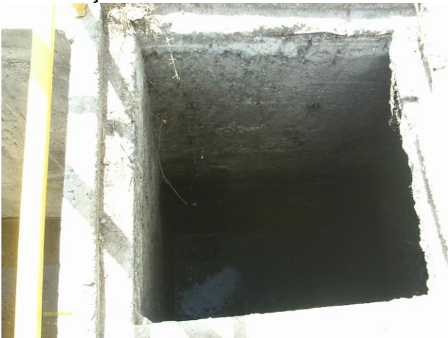
Foto 77 - EEE-01: poço de sucção.
