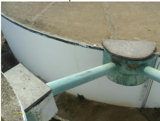
Foto 43 - RAP01: entrada de água.
