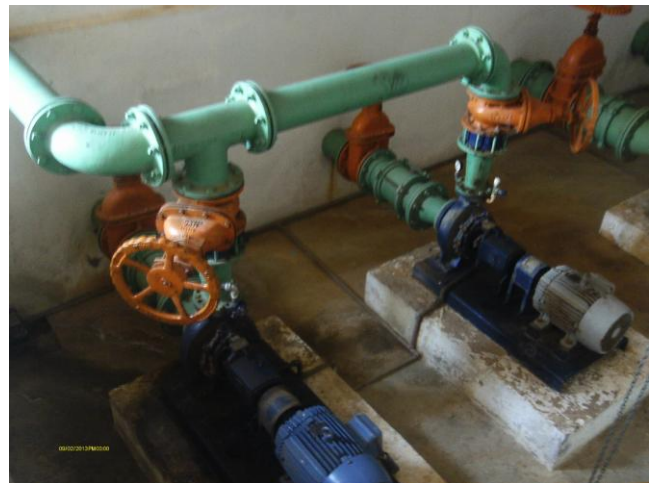
Foto 37 - EEAT-01: conjunto moto bomba.
