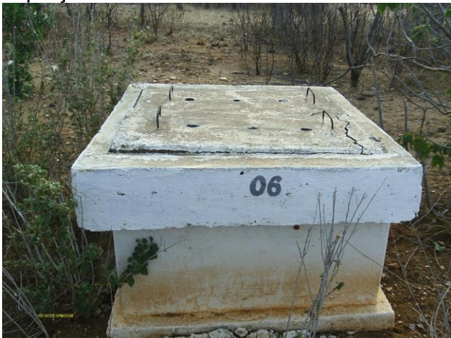
Foto 32 - AAB-01: ventosa com caixa de proteção instalada na adutora.
