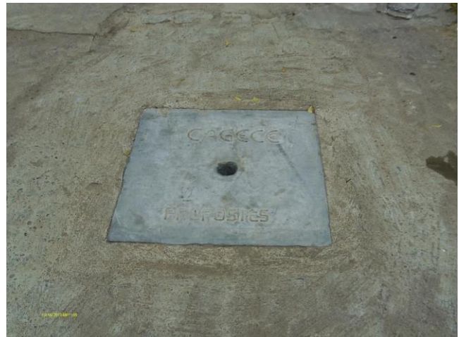
Foto 66 - Registro de descarga na rede de distribuição na Rua 1 - Conjunto Novo (5).
