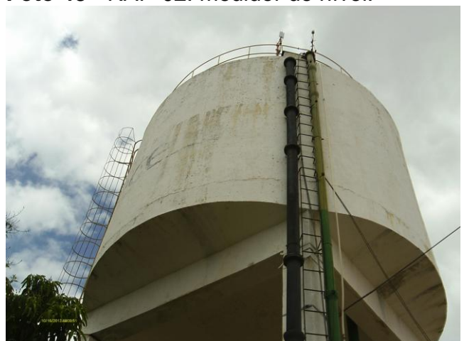
Foto 50 - REL-01: pintura deteriorada, identificação apagada, guarda corpo, para-raios e tubulação.
