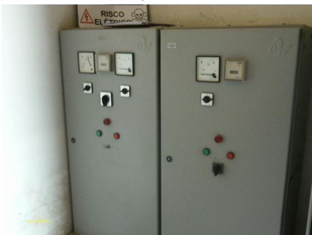
Foto 40 - EELF-01: quadro de comando.
