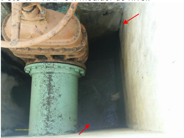
Foto 49 - RAP-02: vazamento na estrutura.
