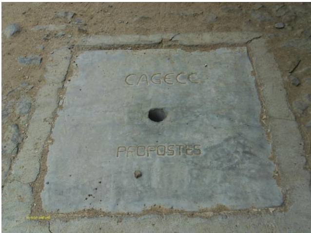
Foto 65 - Registro de descarga na rede de distribuição na Rua da Liberdade (4).
