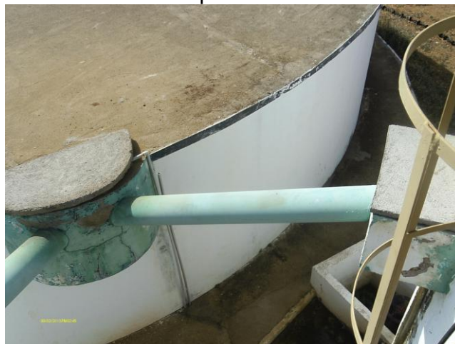
Foto 44 - RAP-02: entrada de água.
