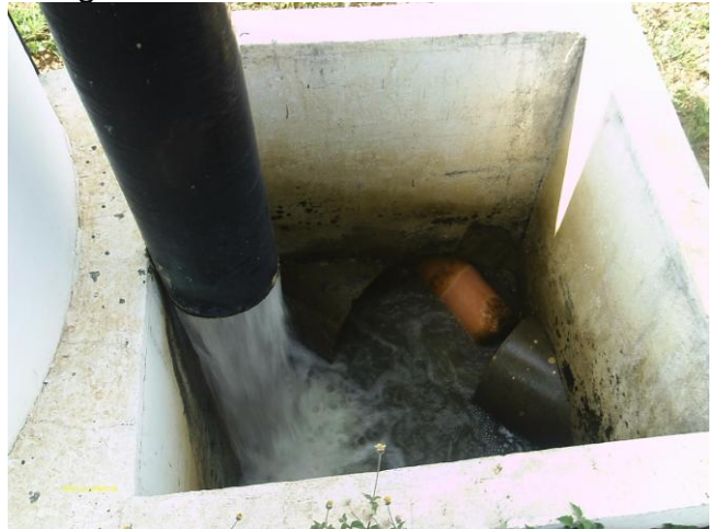
Foto 10 - ETA: descarga de fundo da torre de equilíbrio.
