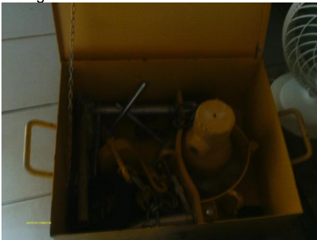
Foto 21 - Casa de química: kit de emergência do cloro gasoso.
