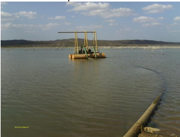
Foto 3 - EECS-01: conjunto moto-bomba.
