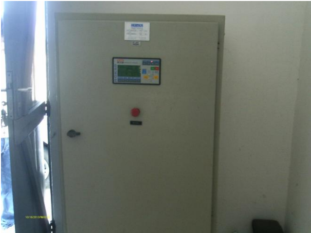
Foto 81 - EEE-01: quadro de comando do grupo gerador de energia elétrica.
