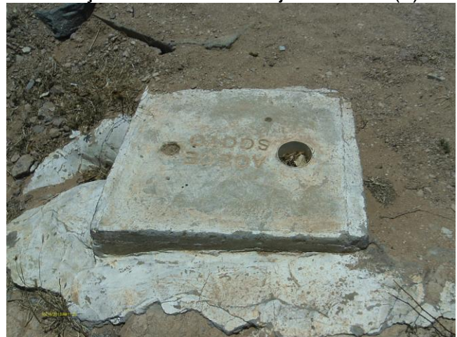
Foto 68 - Registro de descarga na rede de distribuição na Rua Miguel Eusébio (7).
