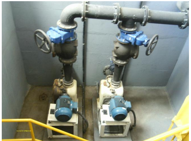
Foto 78 - EEE-01: conjunto moto bomba.
