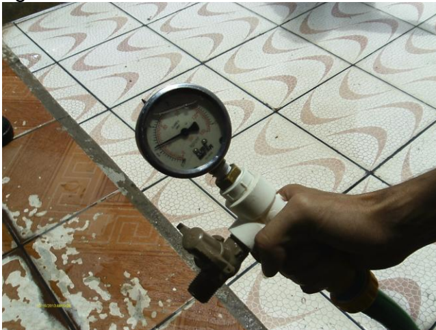
Foto 55 - Medição instantânea de pressão na rede de distribuição na Rua C, Cohab.
