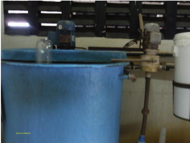
Foto 19 - Casa de química: tanque de dosagem.
