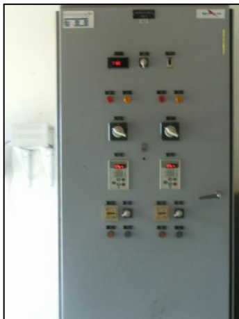
Foto 38 - EEAT-01: quadro de comando.
