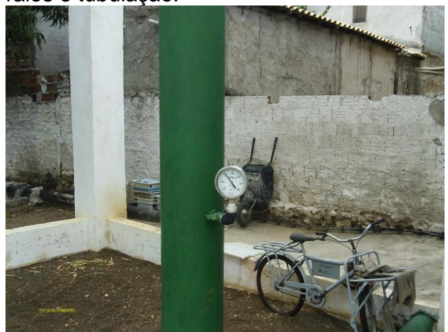
Foto 52 - REL-01: medidor de nível.
