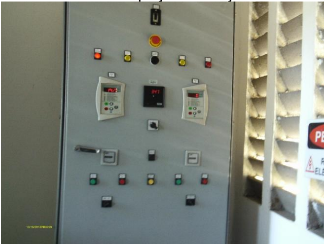
Foto 79 - EEE-01: quadro de comando das bombas.
