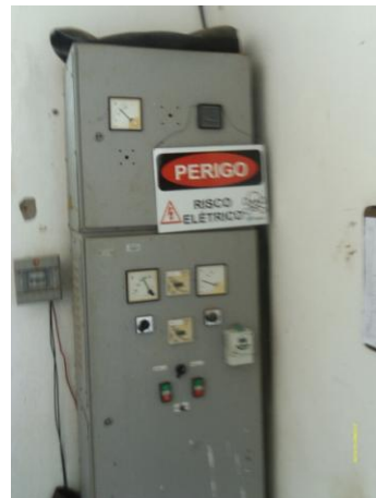
Foto 4 - EECS-01: Quadro de comando.
