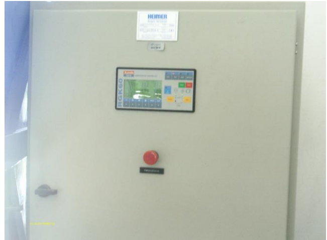
Foto 88 - EEE-02: quadro de comando do grupo gerador de energia elétrica.
