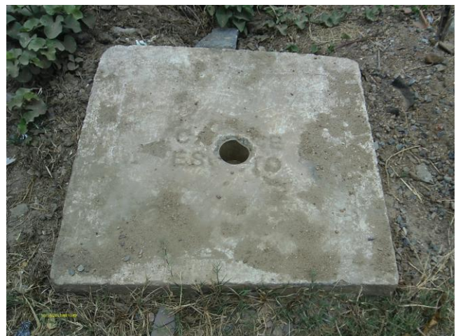
Foto 64 - Registro de descarga na rede de distribuição na Rua 7 de setembro (3).
