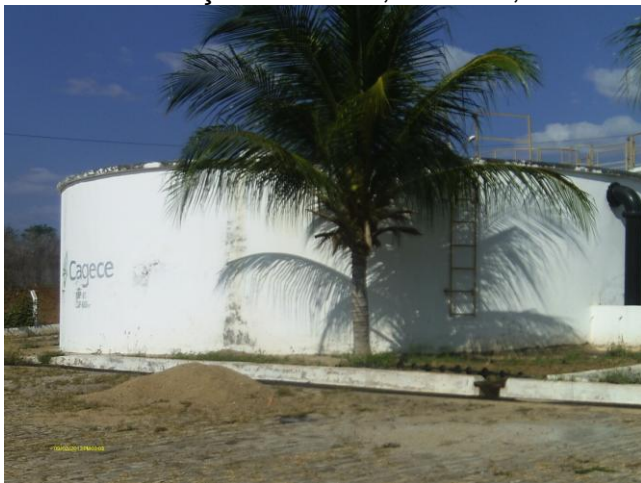
Foto 41 - RAP-01: pintura deteriorada.
