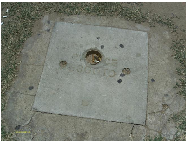
Foto 69 - Registro de descarga na rede de distribuição na Rua Luis Ubirajara (8).
