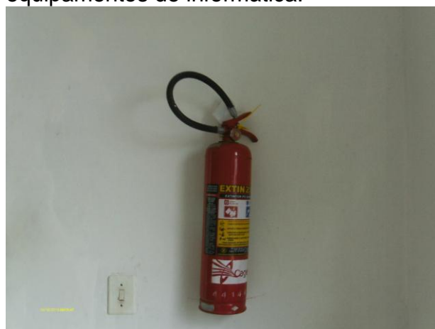
Foto 102 - Comercial: extintor de incêndio.
