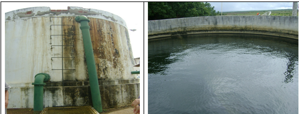
Fotos 12 e 13 – Vistas frontal e superior do pré-filtro
