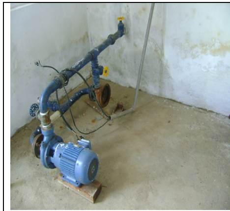
Foto 27 – Vista do booster-01
