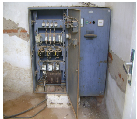
Foto 31 – Quadro de comando da EEAT-02
