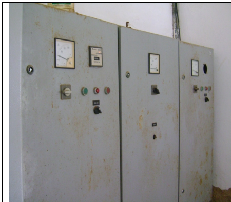
Foto 28 – Quadro de comando da EEAT-01
