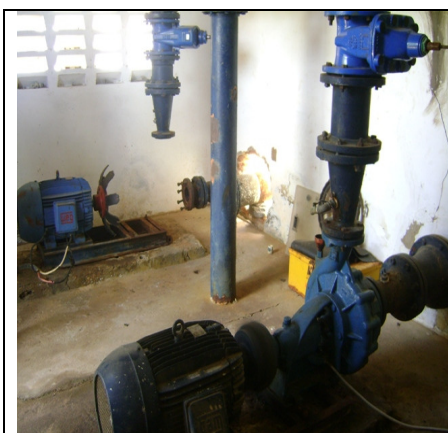
Foto 25 - EEAT-01 – conjunto motor-bomba
