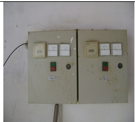
Foto 29 – Quadro de comando do booster-01
