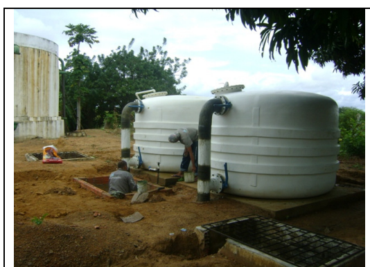
Foto 9 – Vista dos filtros de pressão
