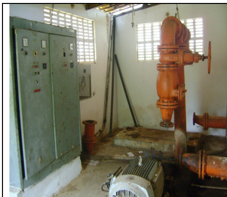
Foto 30 – Quadro de comando da EECS-01
