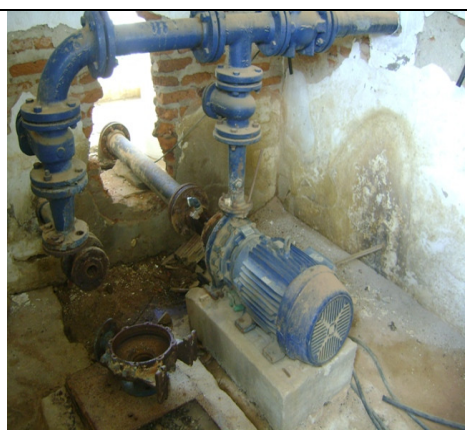
Foto 26 - EEAT-02 – conjunto motor-bomba
