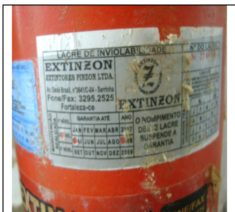
Foto 20 – Extintor de incêndio
