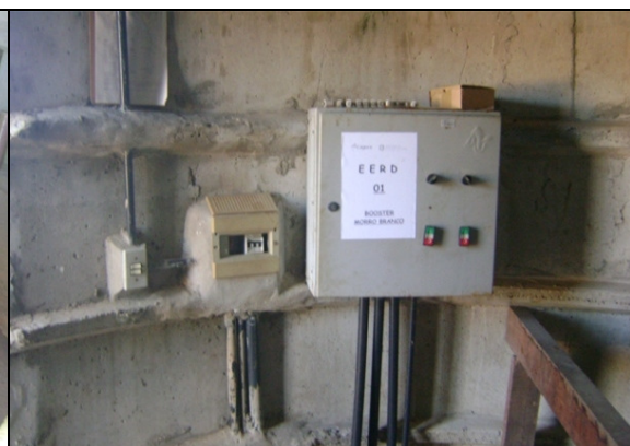
Foto 28 – Quadro de comando da EERD-01.
