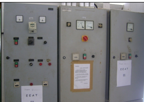
Foto 25 – Quadros de comando das EEAT-01 e EEAT-02.
