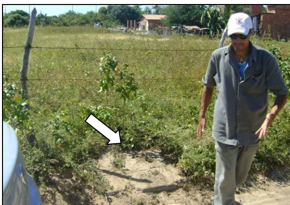
Foto 41 – Registro de descarga soterrado, localizado na Rua SDO 04, Novo Planalto.
