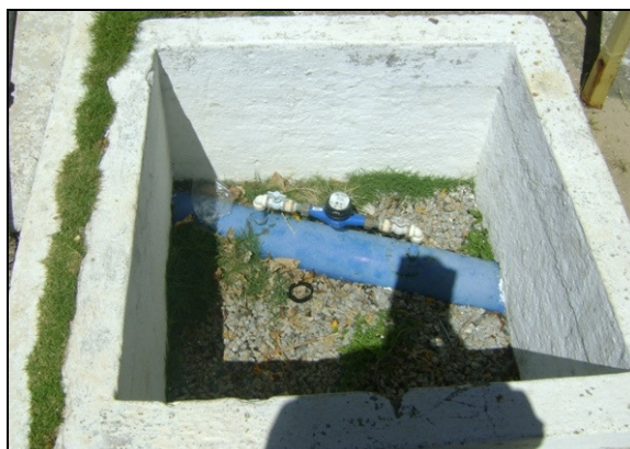
Foto 38 – Caixa do medidor proporcional da adutora de água tratada, na entrada do REL-01, sem tampa de proteção.
