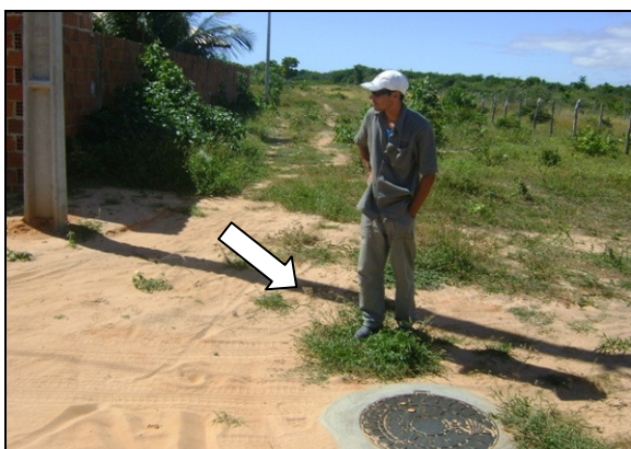
Foto 45 – Registro de descarga soterrado, localizado na Rua Luiza C. Nogueira, Novo Planalto.
