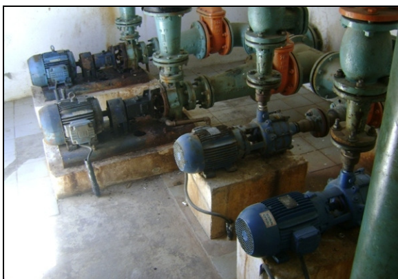
Foto 24 – Elevatória EEAT-01 e EEAT-02.
