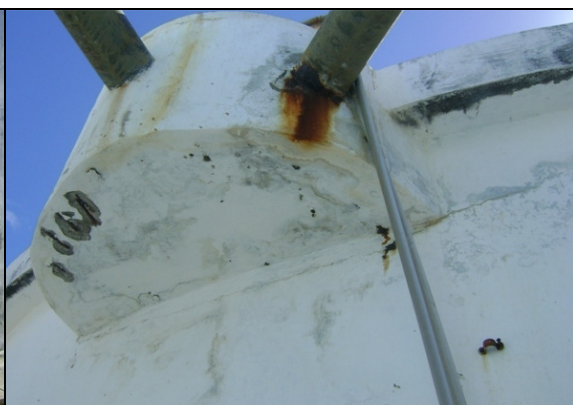
Foto 31 – Revestimento deteriorado do RAP-01.
