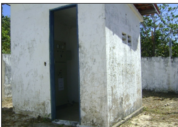
Foto 22 – Prédio de abrigo do quadro de comando da EECS-01.
