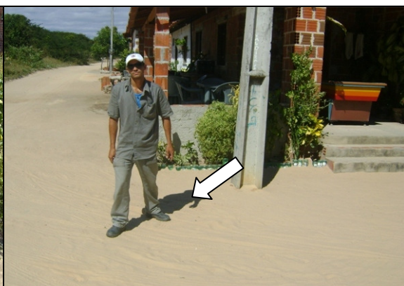
Foto 42 – Registro de descarga soterrado, localizado na Rua Chico Xavier, Centro.
