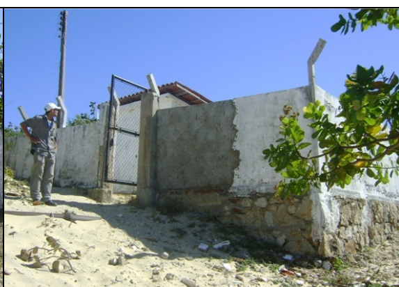
Foto 23 – Muro de proteção do prédio de abrigo do quadro de comando da EECS-01.
