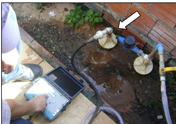
Foto 51 – Medição de pressão sem hidrômetro, na Rua Raimundo Paulo, 734, Mutirão (Morro Branco).
