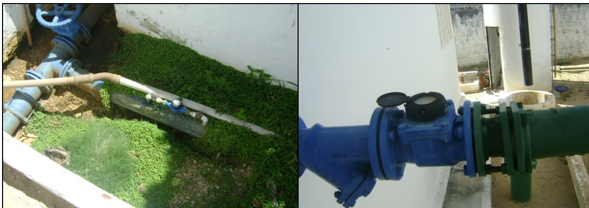
Foto 39 – Caixa do medidor proporcional da adutora de água tratada na saída do REL-01, sem tampa de proteção.
