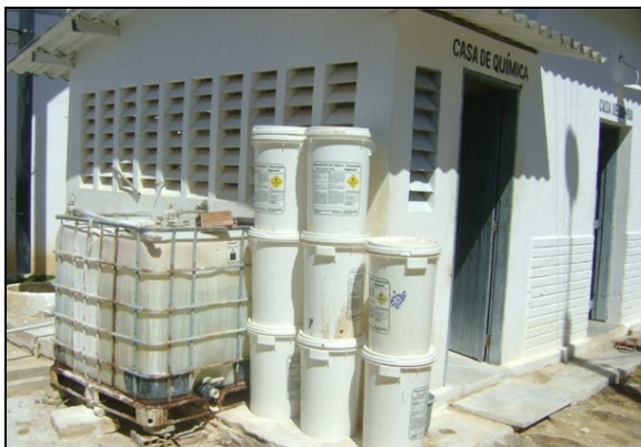
Foto 8 – Vista da casa de química e dos produtos químicos armazenados inadequadamente.
