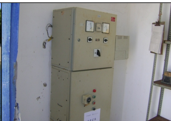
Foto 21 – Quadro de comando da EECS-01.
