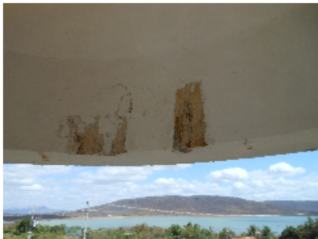
Foto 49 - REL-01: vazamento na estrutura.
