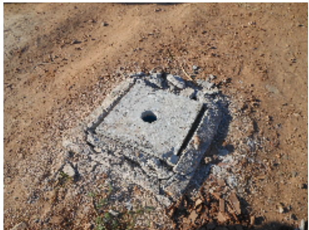
Foto 69 - Registro de descarga na rede de distribuição: Rua Cel. João Batista.
