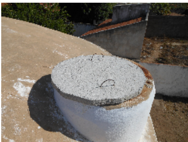
Foto 52 - RAP-02: tampa de proteção
