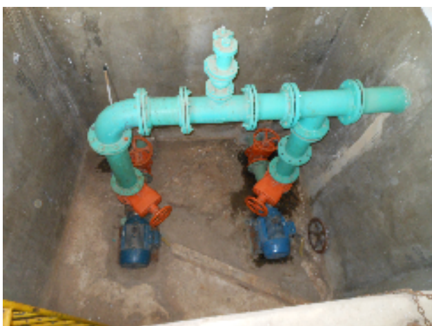
Foto 29 - EEAT-03: conjunto moto-bomba.
