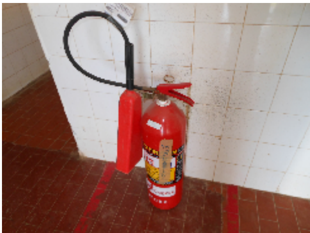
Foto 27 - EEAT-01 e EEAT-02: extintor de incêndio dentro do prazo de validade.
