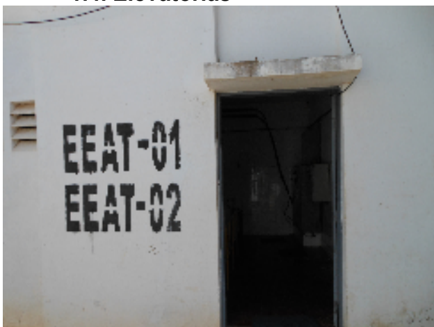
Foto 23 - EEAT-01 e EEAT-02: identificação.
