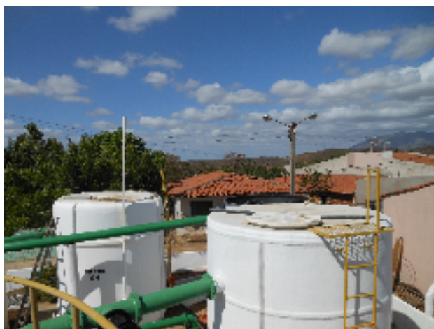
Foto 10 - ETA/Filtração: vista superior dos filtros.
