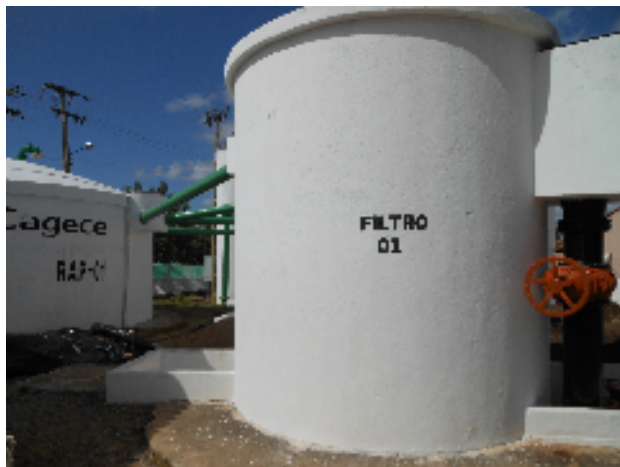
Foto 6 - ETA/Filtração: filtro F-01.
