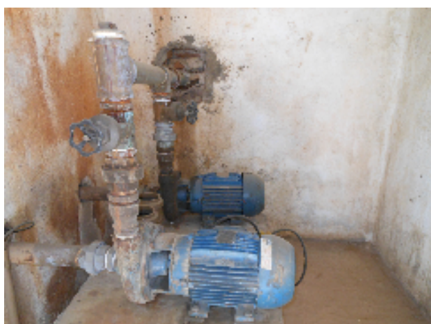
Foto 38 - EEAT-05: conjunto moto-bomba.
