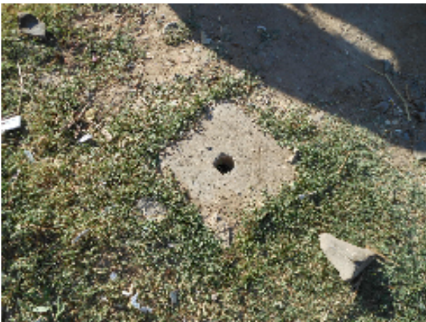
Foto 68 - Registro de descarga na rede de distribuição: Rua Marambaia.
