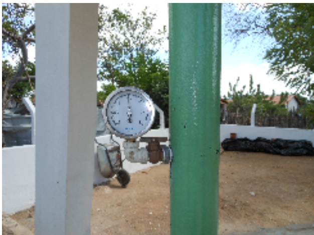
Foto 48 - REL-01: manômetro funcionando.
