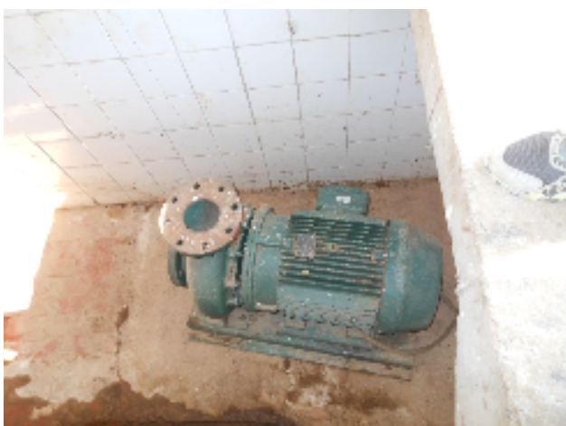
Foto 35 - EEAT-04: bomba reserva.
