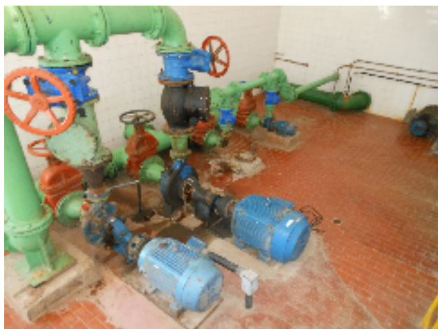
Foto 24 - EEAT-01 e EEAT-02: conjunto moto-bomba, ausência de bomba reserva na EEAT-02.
