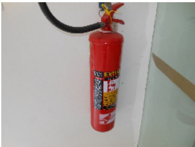
Foto 76 -Comercial/Escritório/Almoxarifado: extintor de incêndio dentro do prazo de validade da recarga.
