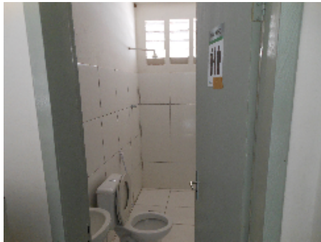
Foto 75 - Comercial/Escritório: instalações sanitárias.
