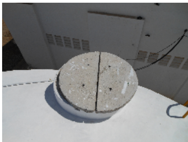
Foto 41 - RAP-01: tampa de proteção.
