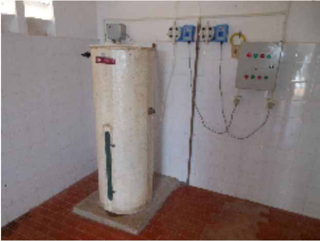
Foto 11 - ETA/Casa de química: sistema de fluoretação.
