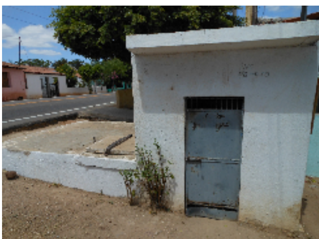
Foto 37 - EEAT-05: Casa de bomba e cisterna sem identificação.
