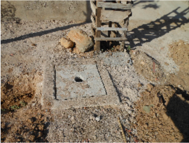
Foto 66 - Registro de descarga na rede de distribuição: Campo do Milan.
