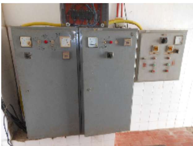
Foto 25 - EEAT-01 e EEAT-02: QC com horímetro da EEAT-02 danificado.
