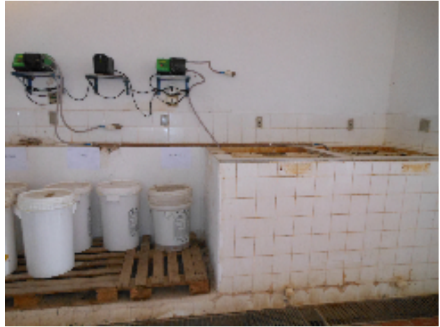
Foto 12 - ETA/Casa de química: tanques dosadores.
