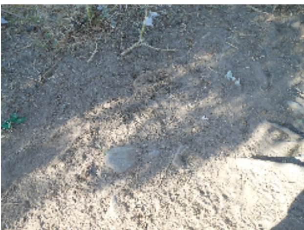
Foto 70 - Registro de descarga na rede de distribuição: Rua José Carneiro de Araújo (soterrado).
