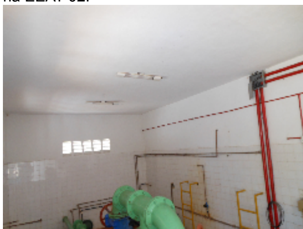
Foto 26 - EEAT-01 e EEAT-02: iluminação interna.
