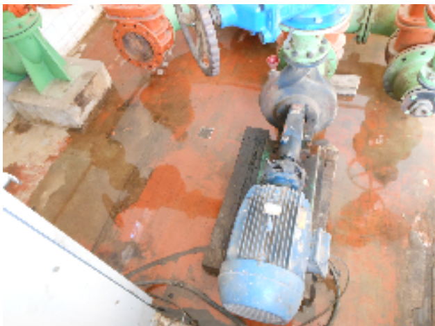
Foto 33 - EEAT-04: conjunto moto-bomba.
