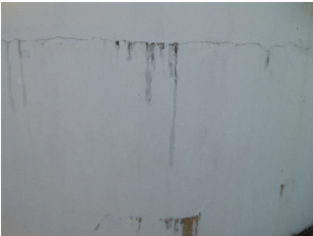
Foto 44 - RAP-01: vazamento na estrutura.
