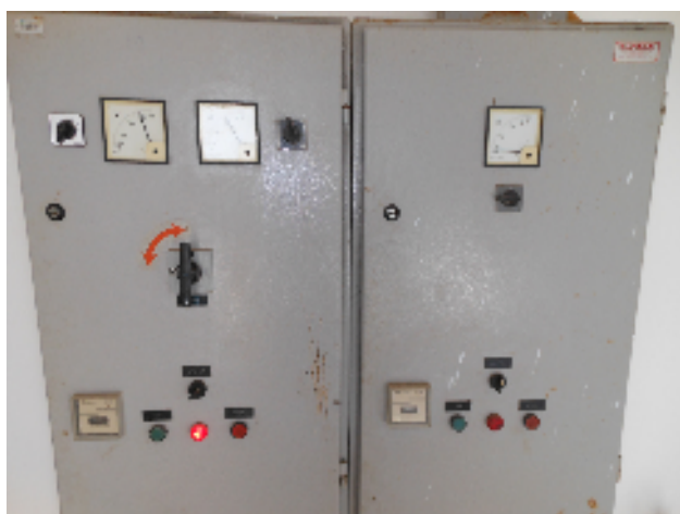
Foto 30 - EEAT-03: quadro de comando.
