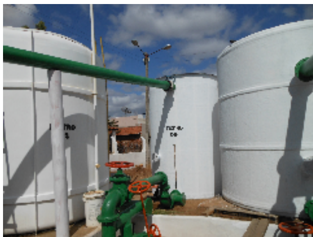
Foto 8 - ETA/Filtração: filtros F-04 e F-05.
