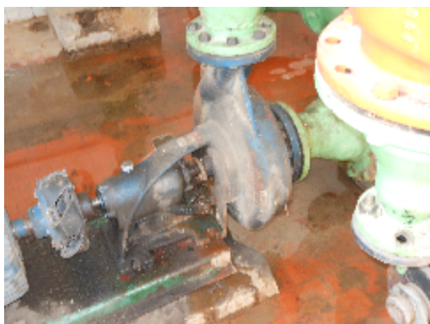
Foto 36 - EEAT-04: bomba com vazamento na gaxeta.
