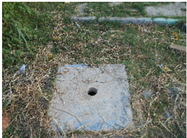
Foto 65 - Registro de descarga na rede de distribuição: Rua Manoel Jarbas Aguiar.
