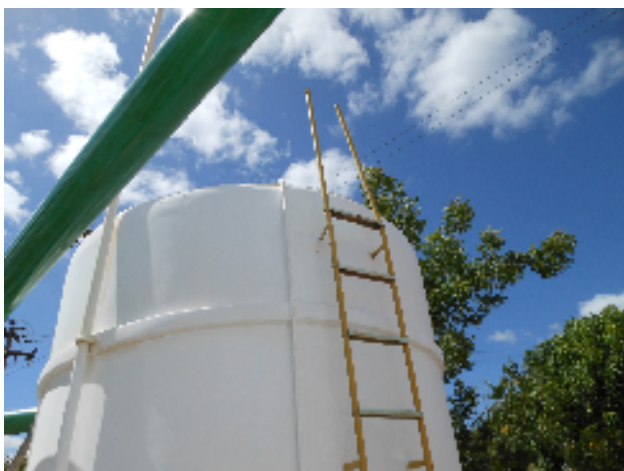
Foto 9 - ETA/Filtração: escada de acesso do F-04 danificada.
