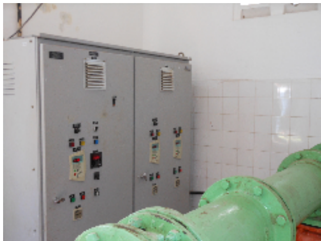
Foto 34 - EEAT-04: quadro de comando.
