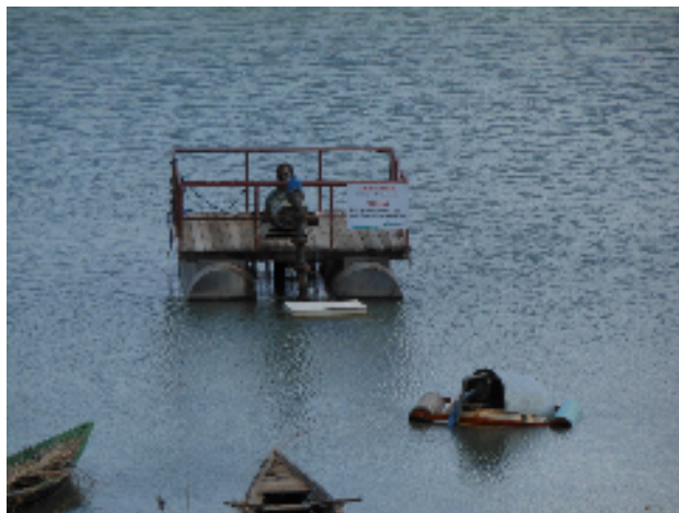
Foto 2 - Manancial/Captação superficial: flutuante.
