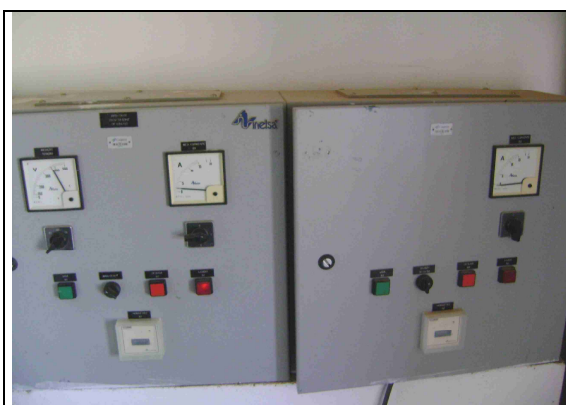
Foto 13 – Quadro de comando da EEAB-01 - situado na mesma edificação da elevatória EEAT-01.
