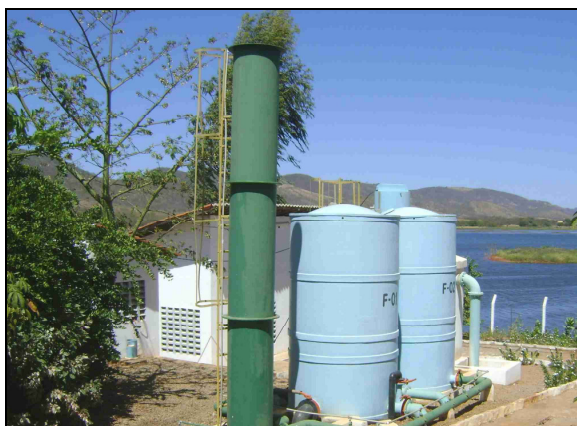
Foto 3 – Vista dos filtros - ETA de Granjeiro.
