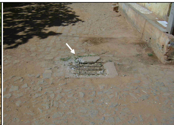
Foto 27 – Registro de descarga com tampa danificada, localizado na Rua São José.
