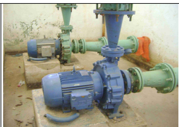
Foto 14 – Conjunto moto-bomba da EEAT-01.
