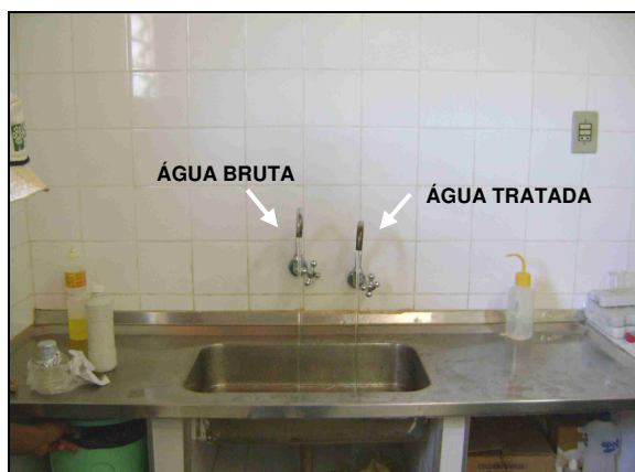
Foto 5 – Vista das torneiras de água bruta e tratada - laboratório.
