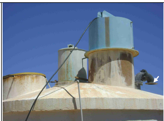
Foto 18 – Tubulação de ventilação sem tela de proteção – RAP-01.
