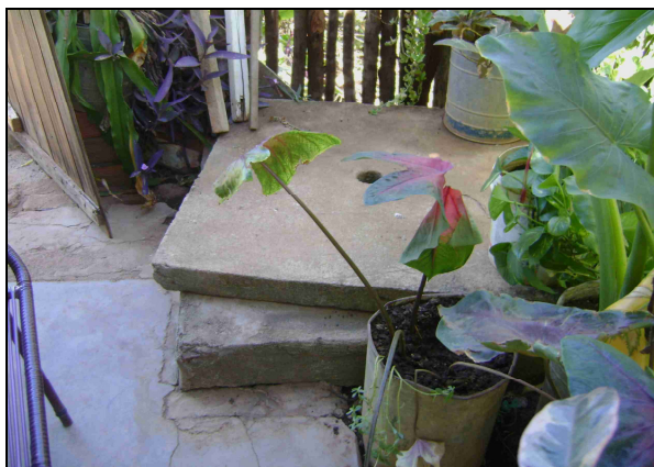
Foto 28 – Registro de descarga localizada na Rua Padre Cícero.
