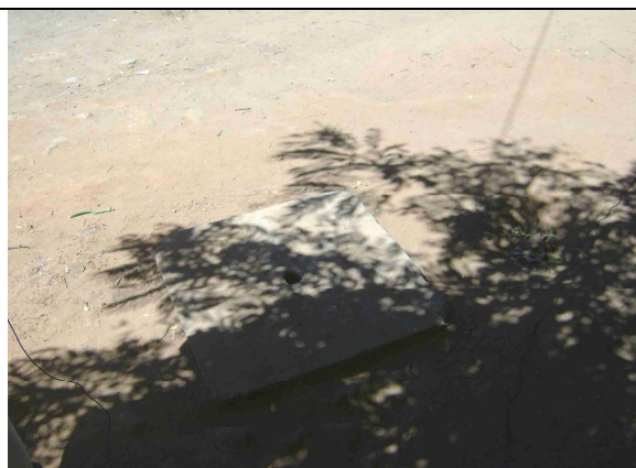
Foto 29 – Registro de descarga localizada na Rua Davi Granjeiro.
