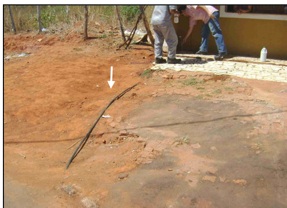
Foto 30 – Ligação predial exposta na Estrada do Caririaçu, FNS 27, Bairro Novo Granjeiro.
