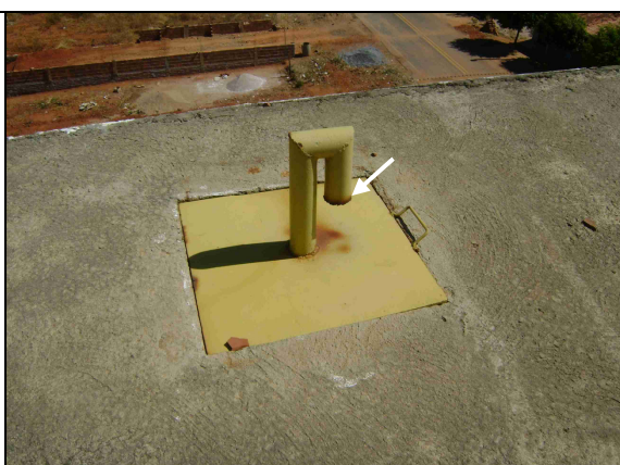
Foto 22 – Tubulação de ventilação sem tela de proteção – REL-01.
