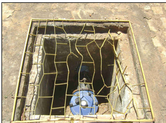
Foto 24 – Macromedidor com grade de proteção danificada.
