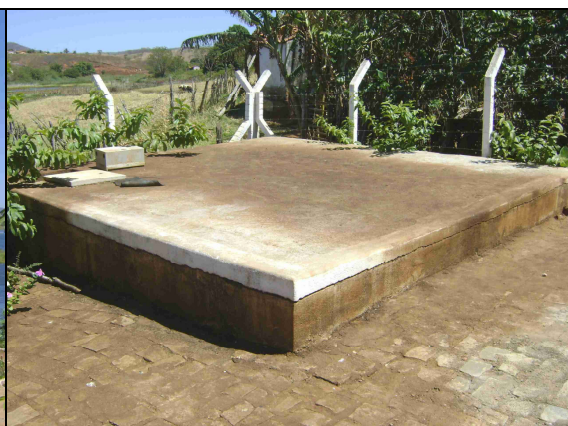
Foto 4 – Caixa de recepção das águas de lavagem dos filtros..
