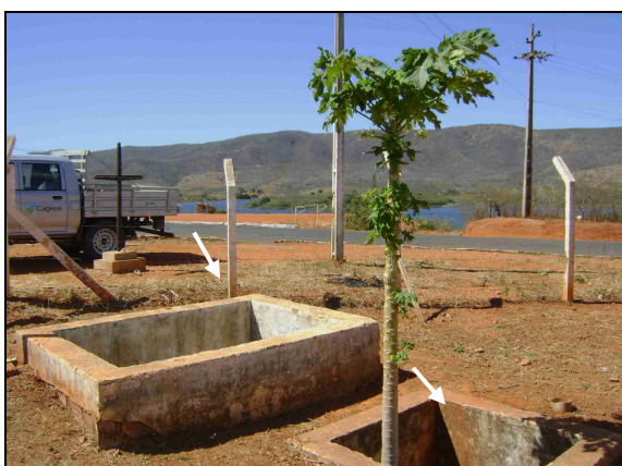
Foto 21 – Ausência de grades ou tampa de proteção - REL-01.
