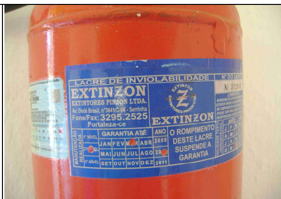
Foto 16 – Extintor de incêndio com prazo de validade vencido – EEAT-01.
