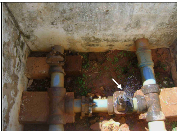
Foto 20 – Vazamento no registro de manobra, que é utilizado para lavagem dos filtros da ETA – REL-01.
