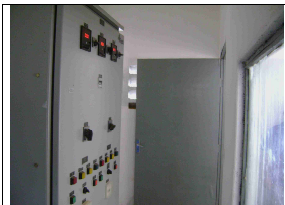
Foto 15 – Quadro de comando da EEAT-01.
