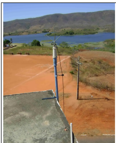
Foto 23 – Vista do pára-raios sem sinalizador noturno – REL-01 e laje superior sem guarda-corpo.
