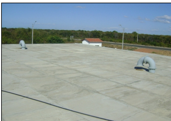
Fotos 42 e 43 – Tubulações de ventilação do RAP-01.
