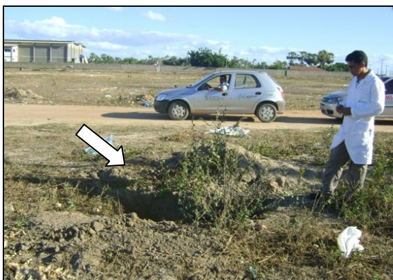
Foto 56 – Registro de descarga, sem caixa de proteção, localizado na Rua Antônio Calixto, Nossa Senhora de Lourdes.
