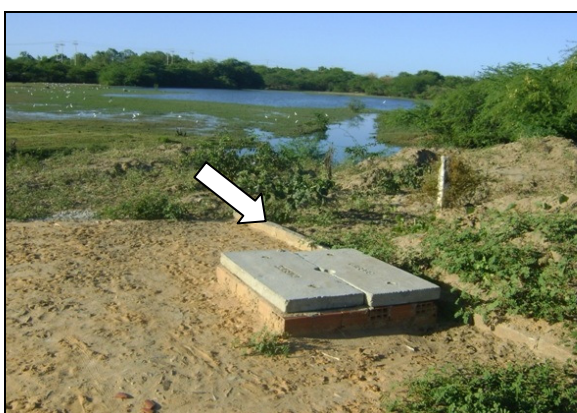
Foto 60 – Registro de descarga localizado na Rua Isabel Gurgel, Várzea da Matriz.
