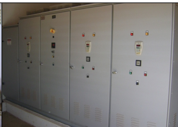
Foto 26 – Quadro de comando da EEAB-01.
