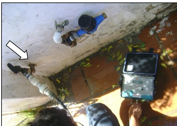
Foto 66 – Medição de pressão sem hidrômetro, na Travessa Nossa Senhora dos Prazeres, 100 - Centro.
