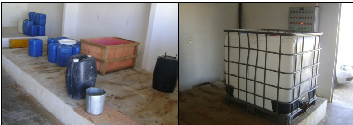
Fotos 13 e 14 – Produtos químicos da ETA.
