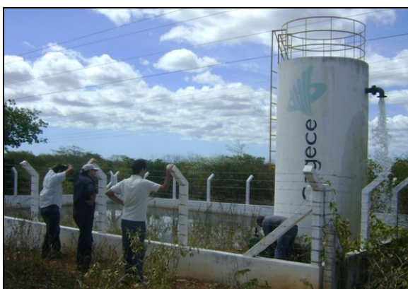
Foto 49 – Problemas operacionais na torre de Equilíbrio 1, da adutora de água bruta.
