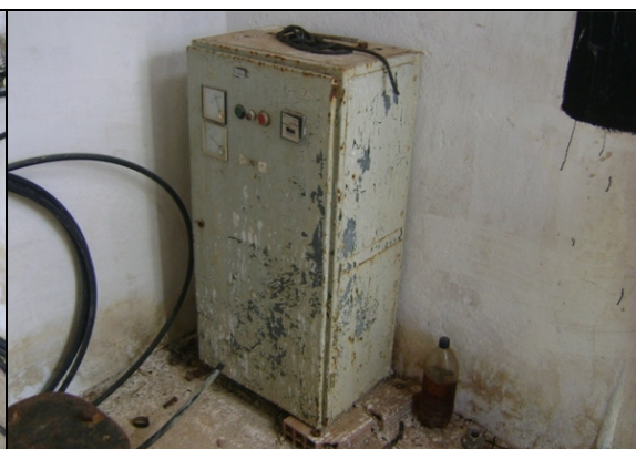
Foto 35 – Quadro de comando da EERD-01.
