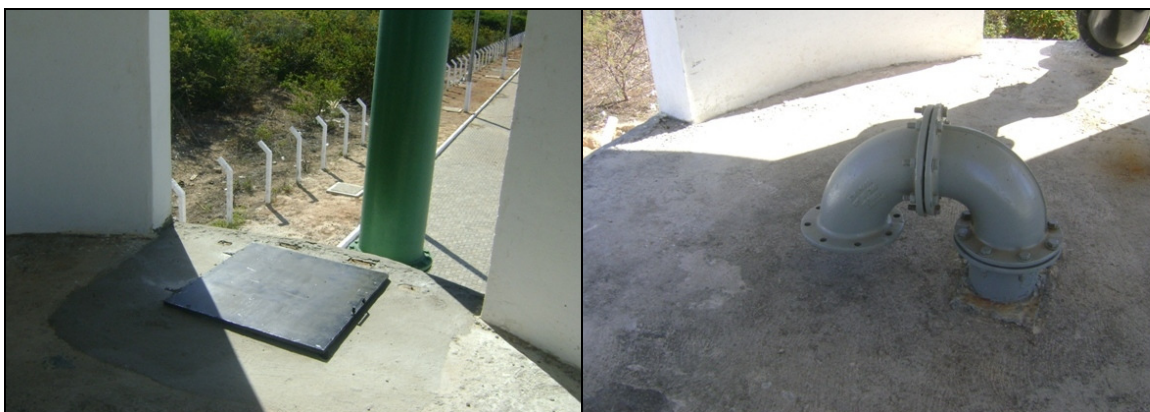
Foto 47 – Tapa de inspeção do RAP-02.
