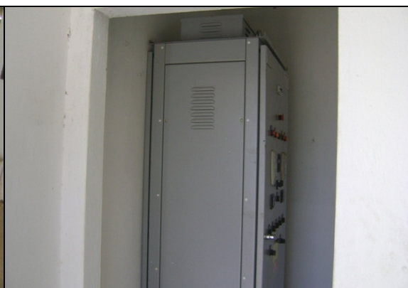
Foto 29 – Quadro de comando da EELF-01.
