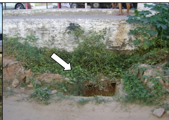
Foto 57 – Registro de descarga, sem tampa de proteção, localizado na Rua Irmã Núbia Alves, Farias Brito.
