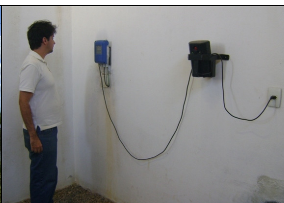
Foto 50 – Medidor eletromagnético de água bruta na entrada da ETA.
