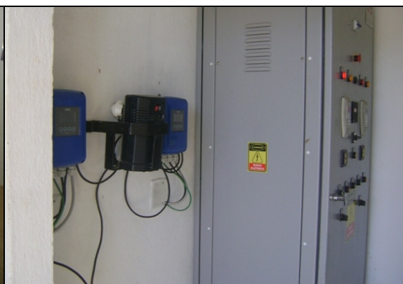
Foto 32 – Quadro de comando da EEAT-01.
