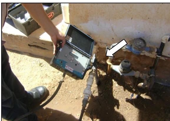
Foto 68 – Medição de pressão sem hidrômetro, na Vila São José, 66 - Distrito.
