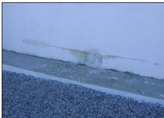
Foto 44 – Infiltração na base do RAP-01.
