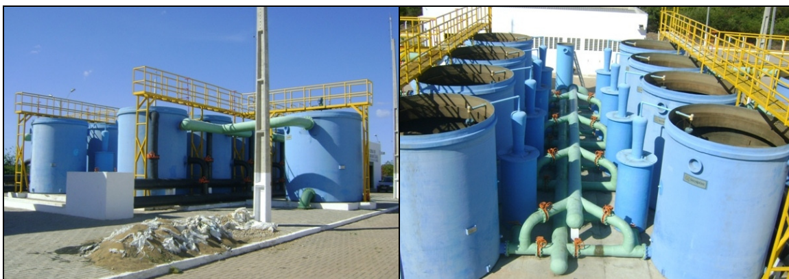
Fotos 6 e 7 – Vistas dos filtros.
