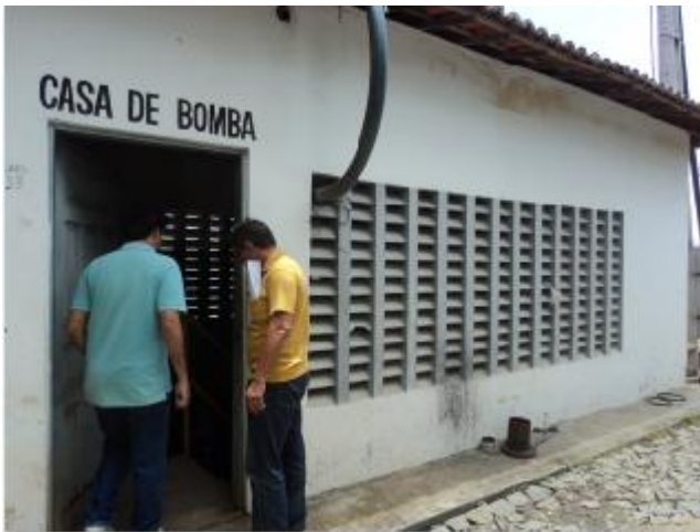
Foto 3 – EEAT-02: ausência de identificação.
