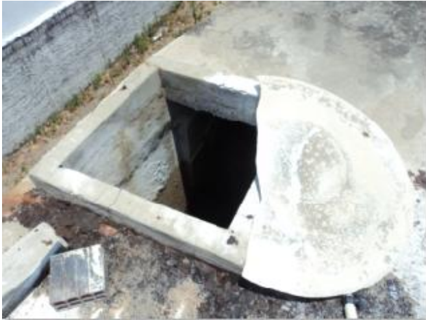
Foto 11 – RAP-06: ausência de tampa de inspeção.
