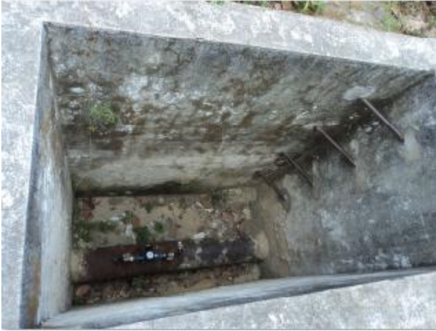
Foto 1 – AAT: caixa do medidor de entrada sem tampa ou grade de proteção.
