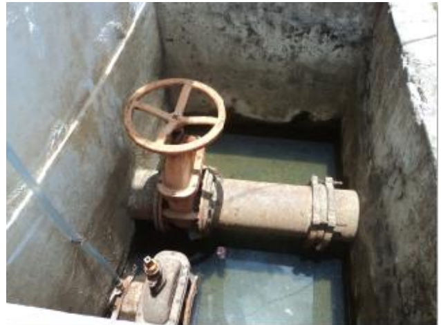
Foto 14 – RAP-06: caixa sem grade de proteção com acúmulo de água devido a um vazamento no registro.
