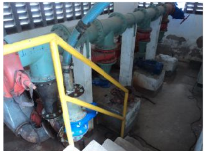
Foto 4 – EEAT-02: conjunto moto-bomba.
