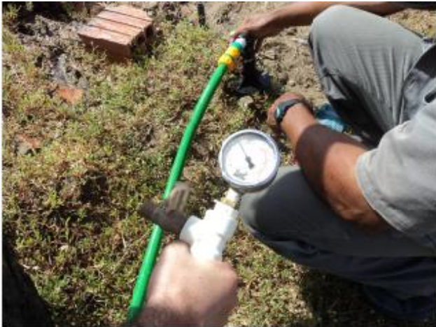
Foto 17 – Medição instantânea de pressão na R. João Evangelista, nº 9 – Bairro Alto da Boa Vista.
