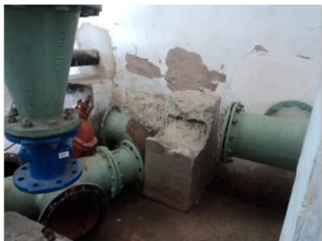
Foto 7 – EEAT-02: pintura e reboco deteriorados.
