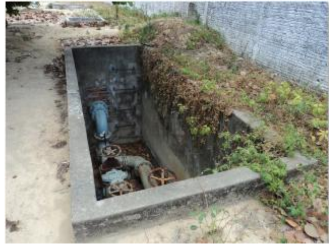
Foto 2 – AAT: caixa do registro e da válvula redutora de pressão sem tampa ou grade de proteção.
