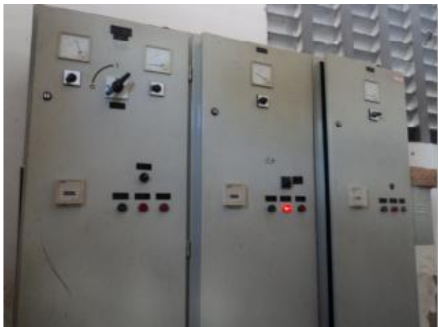
Foto 5 – EEAT-02: quadro de comando.
