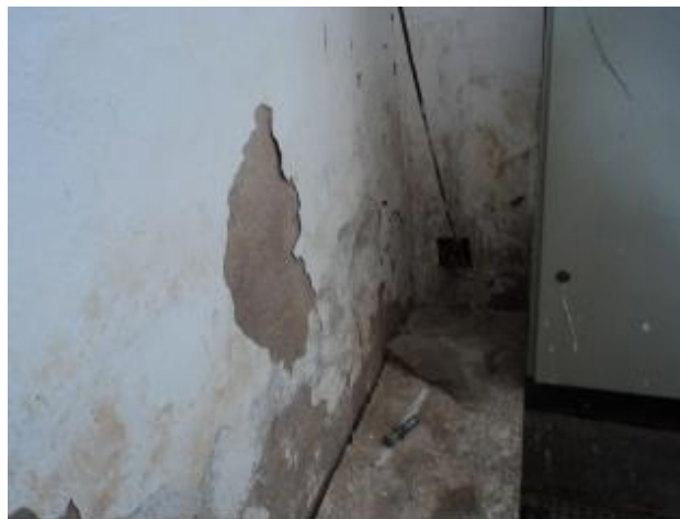
Foto 6 – EEAT-02: pintura e reboco deteriorados.
