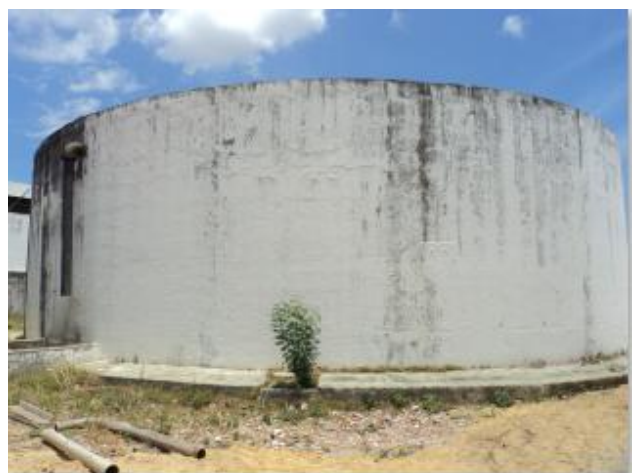
Foto 9 – RAP-06: pintura deteriorada e ausência de identificação.
