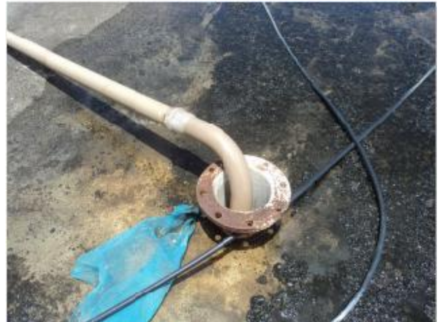
Foto 12 – RAP-06: tubulação de ventilação sem tela de proteção.
