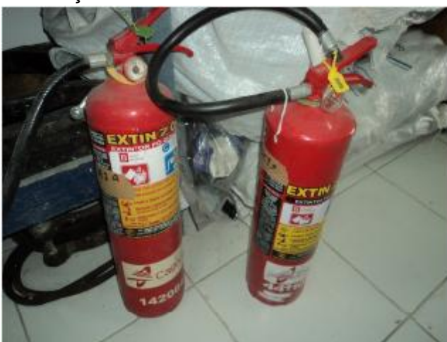
Foto 37 – Loja de atendimento: extintor de incêndio.
