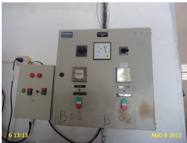
Foto 3 – EEAT-01: quadro de comando sem amperímetro.
