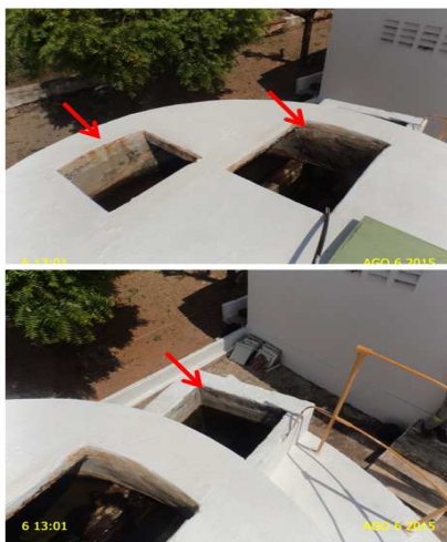
Foto 1 – F-01: ausência de tampa no filtro e na calha de saída de água.
