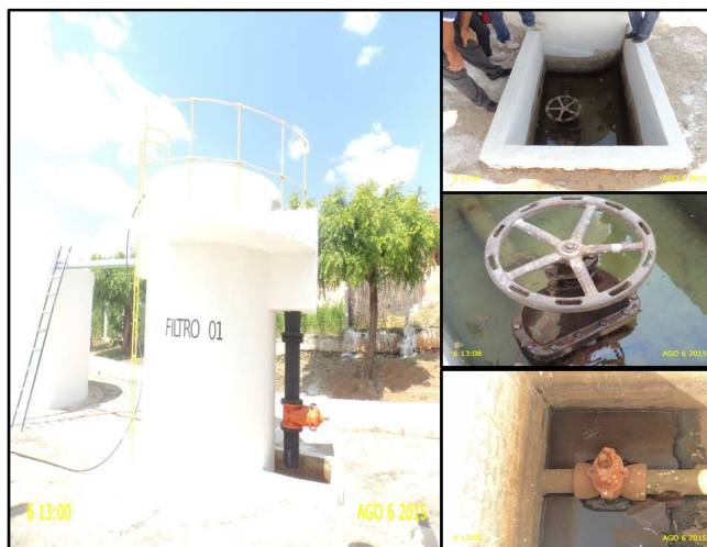
Foto 6 – F-01: com vazamento.
