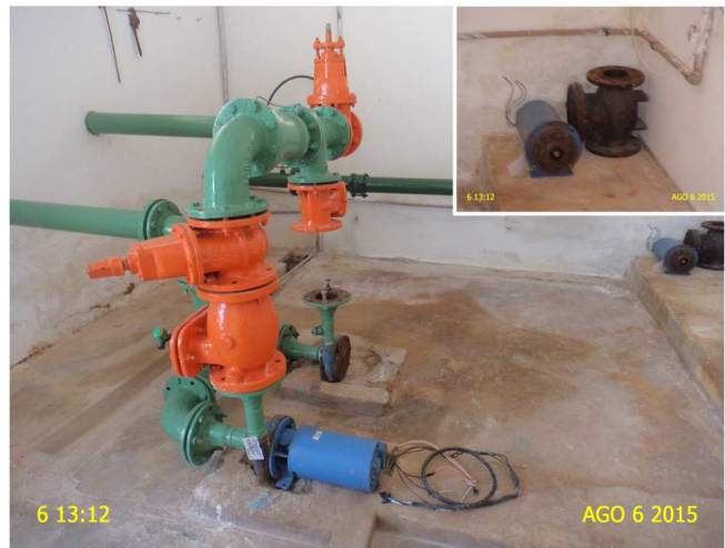
Foto 2 – EEAT-01: bom reserva não instalada.
