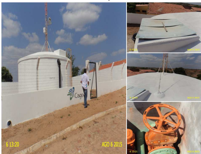
Foto 7 – RAP-02: sem tubulação de ventilação, tampa sem adequada vedação e registro com vazamento.
