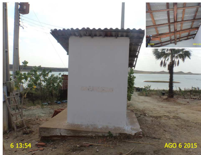
Foto 9 – Quadro de comando: área sem delimitação e sem iluminação.
