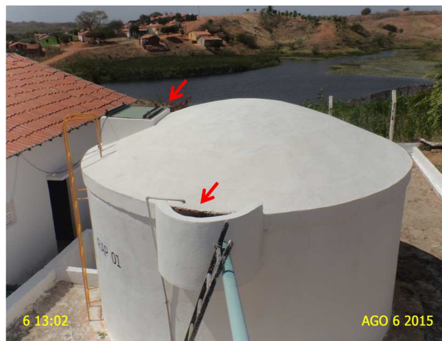
Foto 4 – RAP-01: sem tubulação de ventilação, tampa sem adequada vedação e calha de passagem de água sem tampa.
