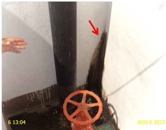
Foto 8 – RAP-01: com sinais de vazamento na parede.
