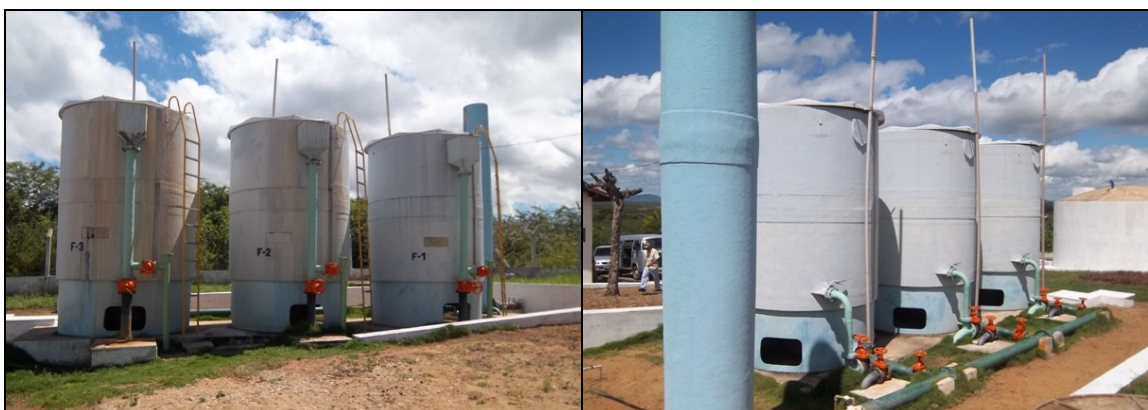
Fotos 4 e 5 – Vistas dos filtros.
