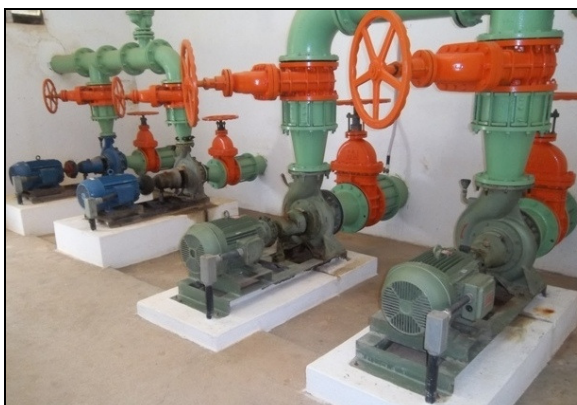
Foto 21 – Elevatórias EELF-01 e EEAT-01.
