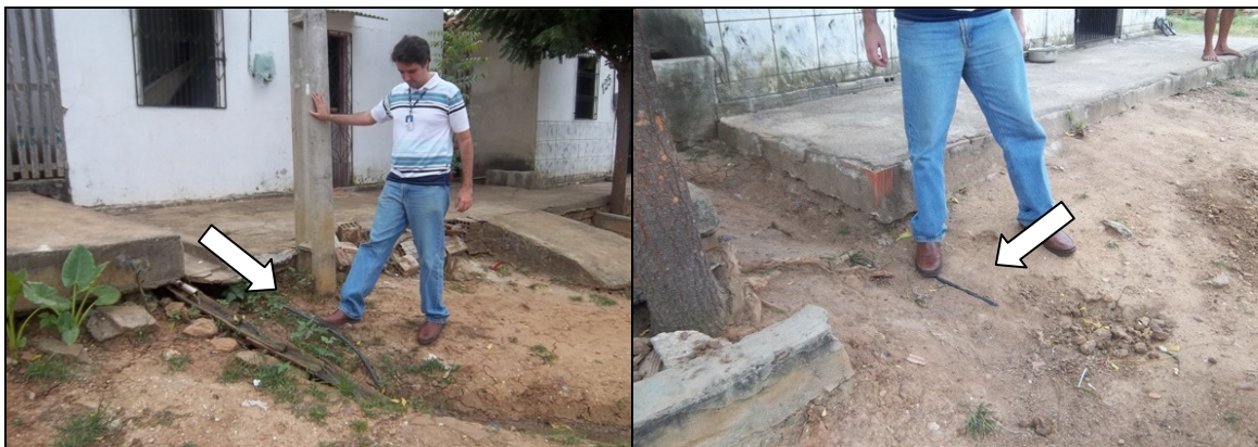
Fotos 57 e 58 – Ligações expostas localizado na Rua Lílio Ferreira Aquino, Andrades.
