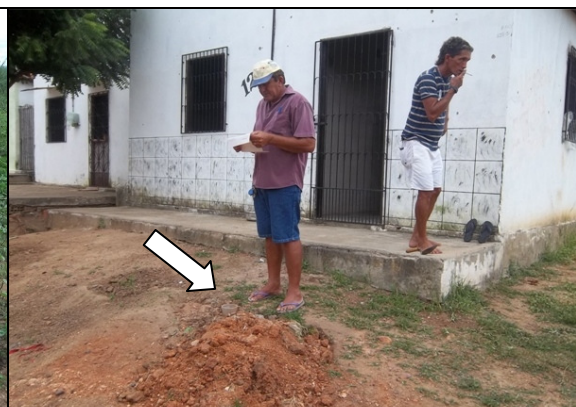
Foto 50 – Registro de descarga sem caixa de proteção, localizado na Rua Lilio Ferreira Aquino, Andrades.
