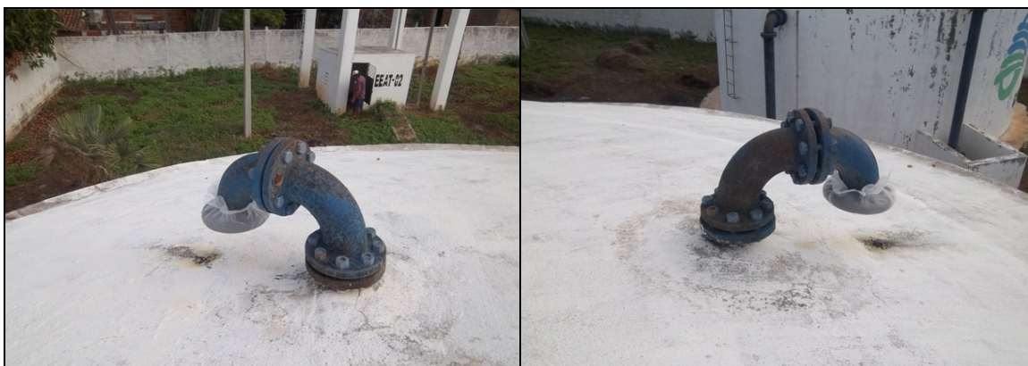
Fotos 37 e 38 – Tubulações de ventilação do RAP-03.
