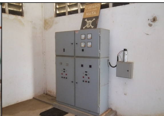
Foto 22 – Quadros de comando da EELF-01 e EEAT-01.
