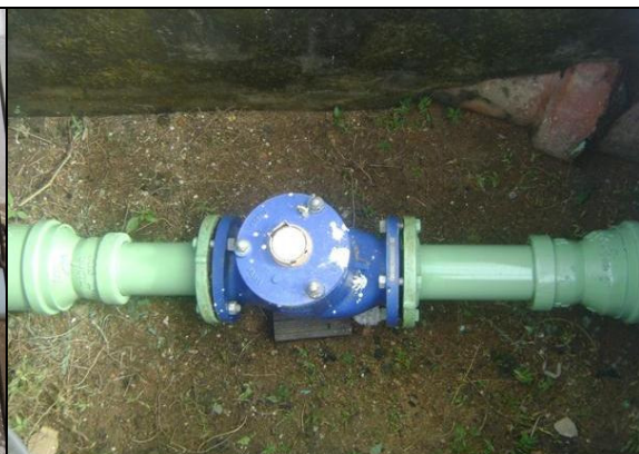
Foto 47 – Macromedidor de água tratada, localizado na saída da ETA.
