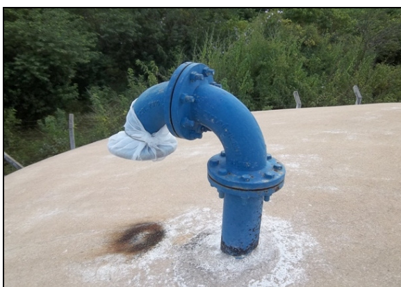
Fotos 30 e 31 – Tubulações de ventilação do RAP-01.
