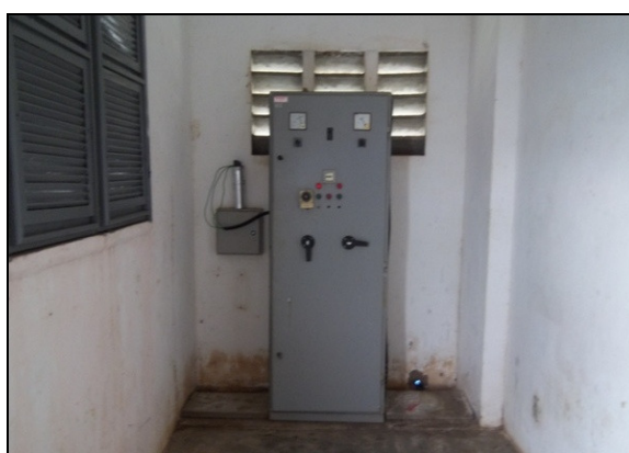
Foto 20 – Quadro de comando da EECS-01.
