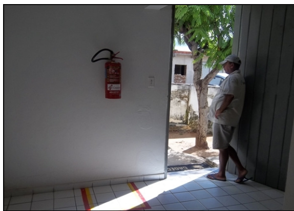
Foto 64 – Extintor de incêndio do escritório.
