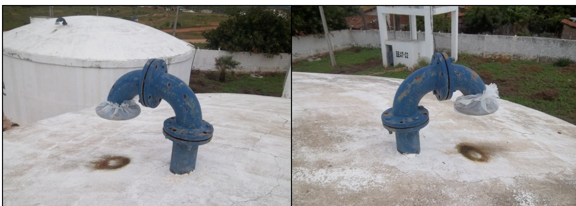
Fotos 41 e 42 – Tubulações de ventilação do RAP-04.
