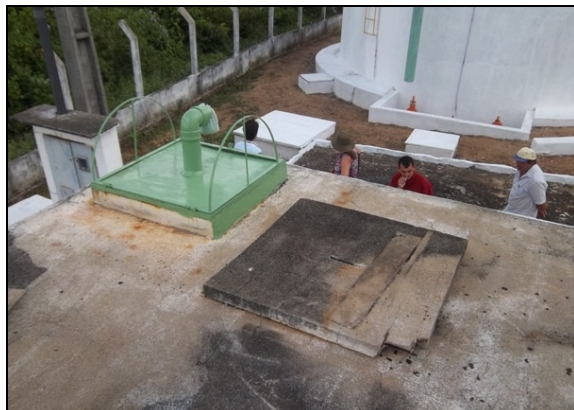
Foto 34 – Tubulação de ventilação e inspeção do RAP-02.
