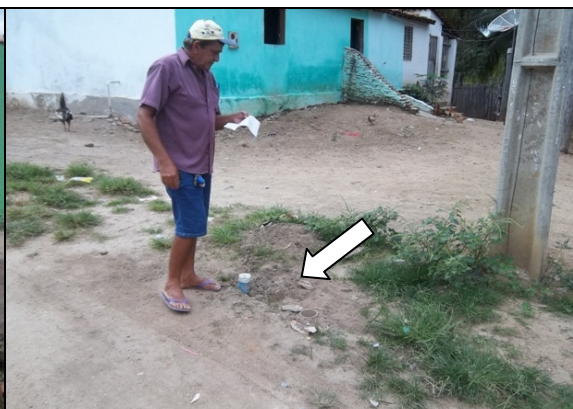
Foto 52 – Registro de descarga sem caixa de proteção, localizado na Rua Vicente Ferreira, Centro.
