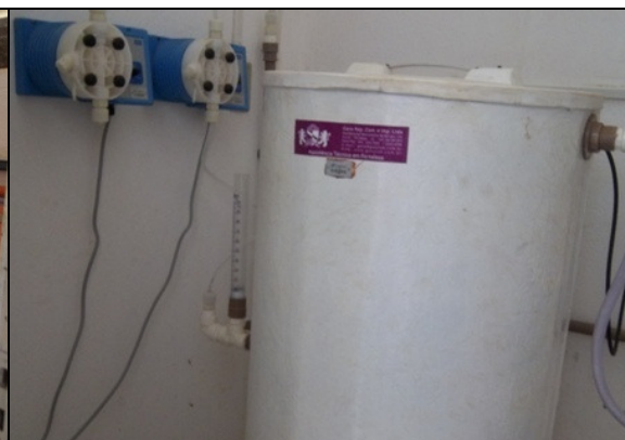
Foto 8 – Dosador de flúor.
