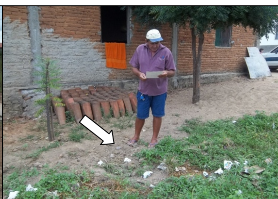
Foto 56 – Registro de descarga sem caixa de proteção, localizado na Av. Raimundo Simão de Souza, Lindelândia.
