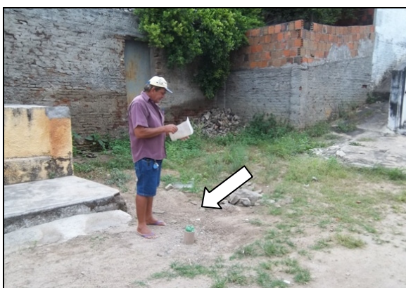
Foto 53 – Registro de descarga sem caixa de proteção, localizado na Rua Nossa Senhora da Conceição, Centro.
