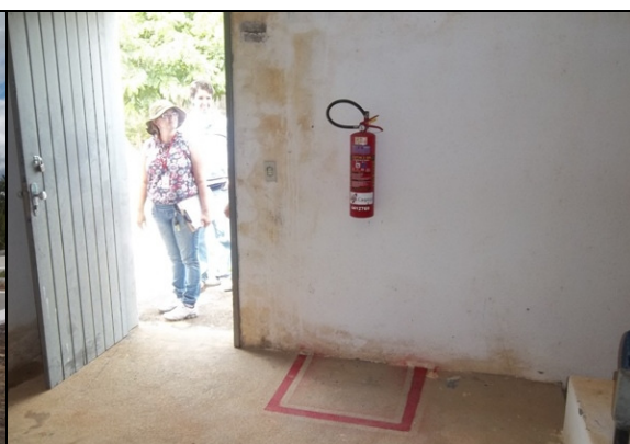
Foto 24 – Extintor de incêndio das elevatórias EELF-01 e EEAT-01.
