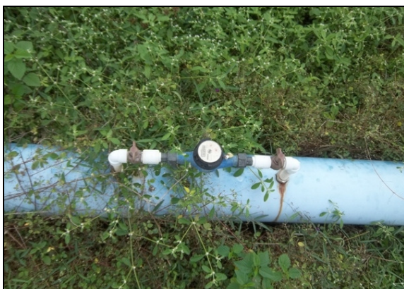
Foto 45 – Medidor proporcional de água bruta, localizado na saída da captação, sem caixa de proteção.
