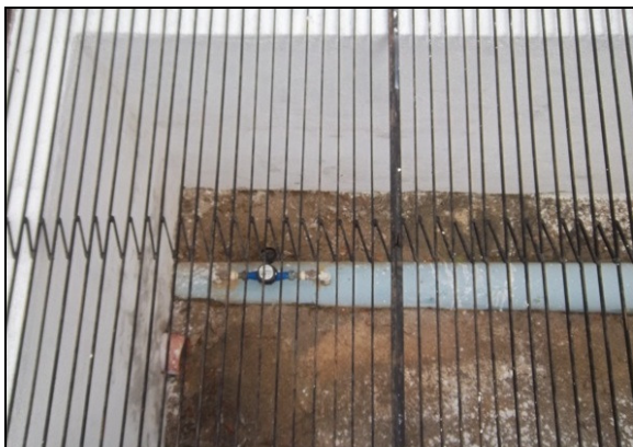
Foto 46 – Medidor proporcional de água tratada, localizado na saída da ETA.
